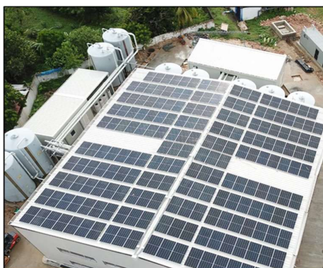
Vista General planta desalinizadora 50 L/s
