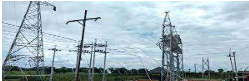
Ilustración: Subestación Tibú- César
