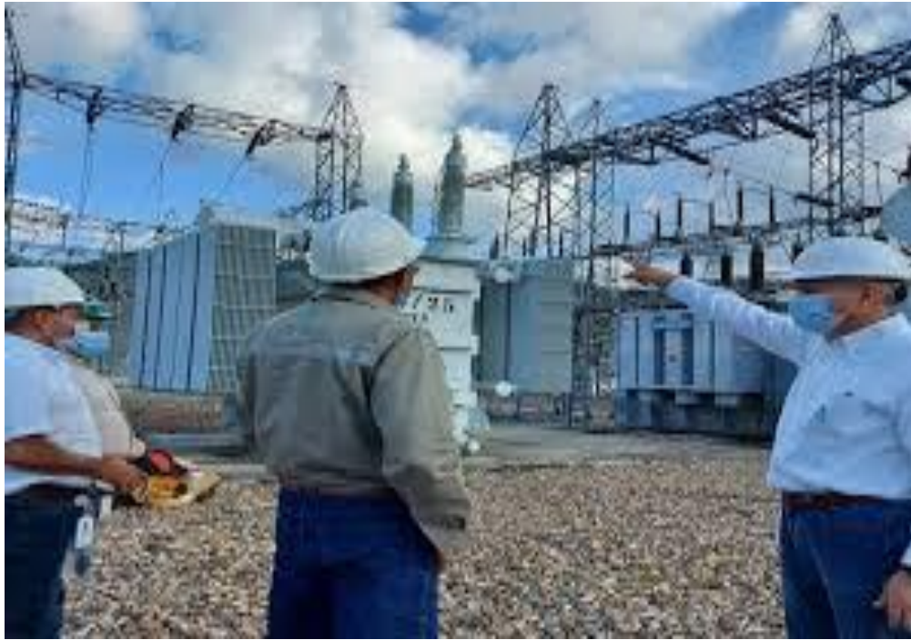
Ilustración No. 67: Subestación Tibú- César
