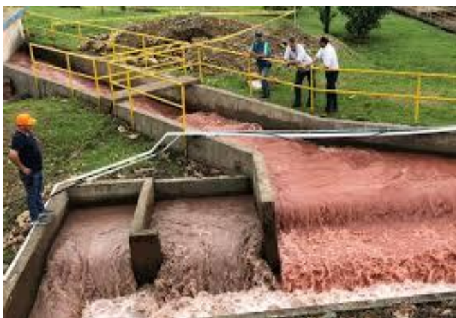
Gráfica 8. Modernización de la Planta de Tratamiento de Agua Potable PTAP La Esmeralda
