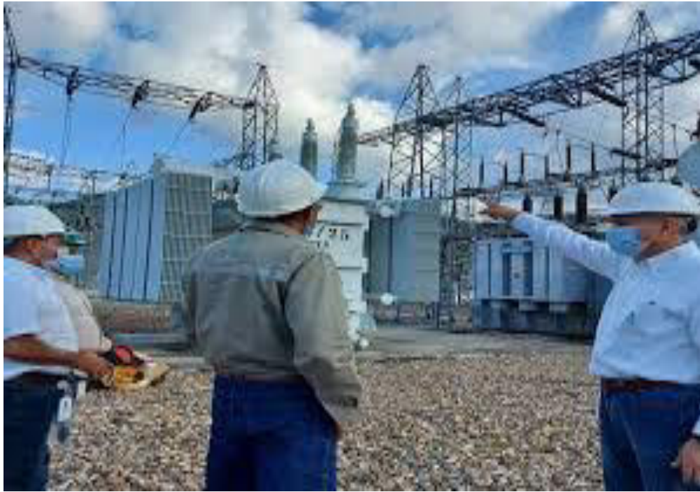
Ilustración No. 67: Subestación Tibú- César
