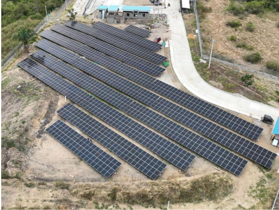
Módulos fotovoltaicos de la PTAR, 15/11/2024.
