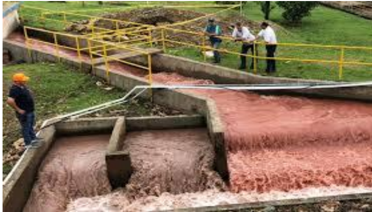
Ilustración No. 24: Modernización de la planta de tratamiento de agua potable PTAP La Esmeralda
