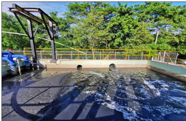
Tratamiento del agua
