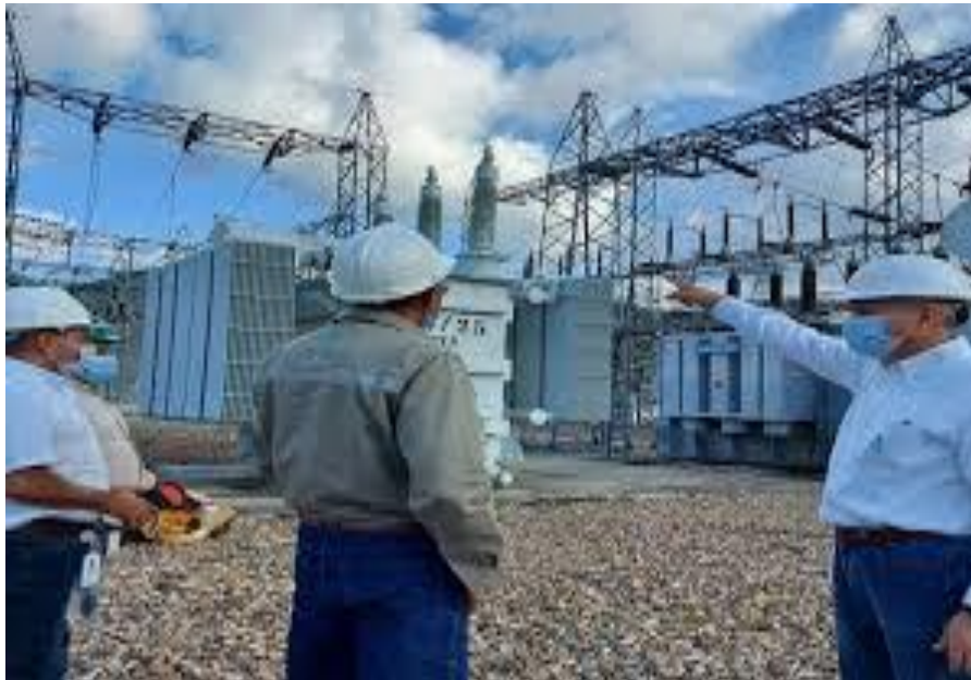
Ilustración No. 25: Subestación Tibú- César
