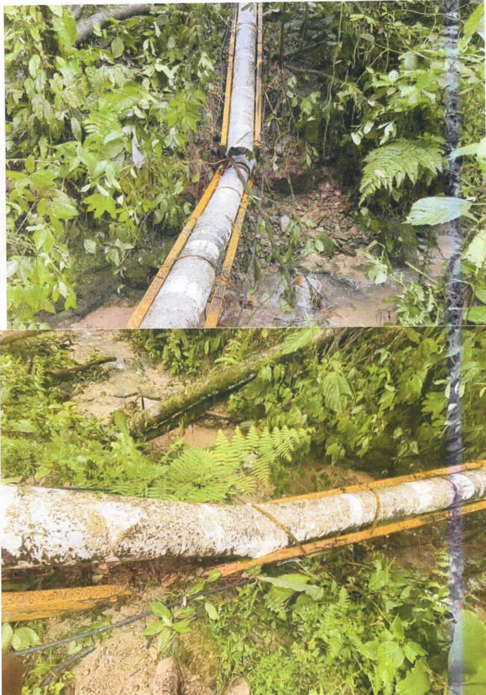
Línea que se abastecía del Chontataco y que sufrió la caída de la cercha metálica.
