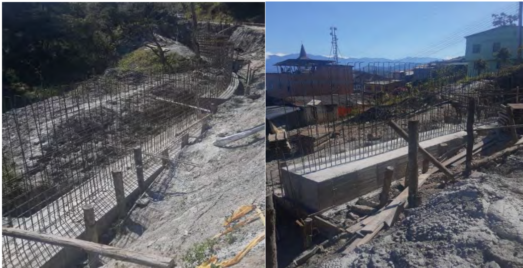
Registro Fotografico No 1 – No 2. Amarre de acero de las elevaciones del vástago, del muro de contención de 30 Metros.
