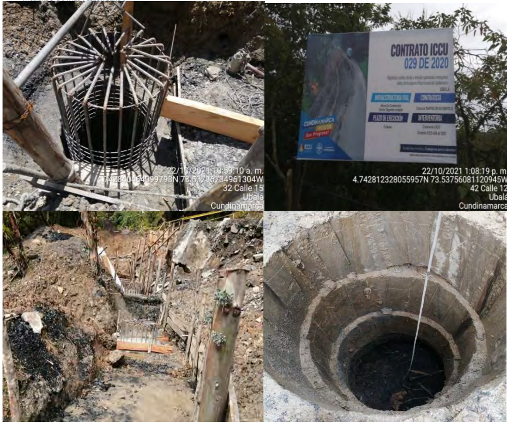
IMAGEN No 1 – No 2. Registro Fotografico. Fundida de los 4 Caisson del muro de contención de 45 metros.
