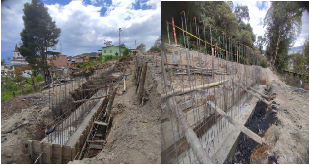
Registro Fotografico No 1 – No 2. Fundida de la viga, del muro de contención de 30 Metros.
