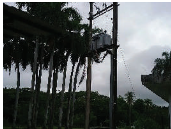
Ilustración 167 subestación tipo poste en H. Fuente. Equipo de diagnóstico
