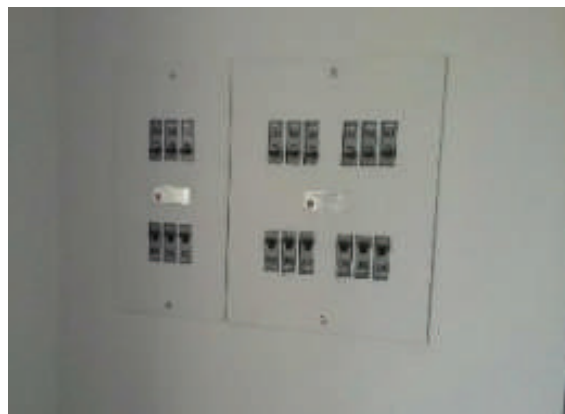
Ilustración 256 tablero de distribución. Fuente. Equipo de diagnóstico.
