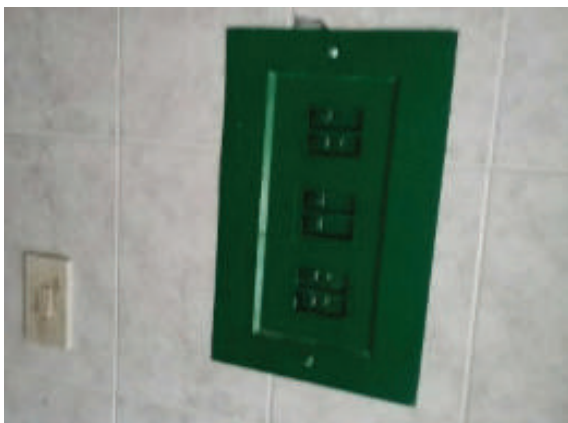
Ilustración 221 tablero de distribución. Fuente. Equipo de diagnóstico.
