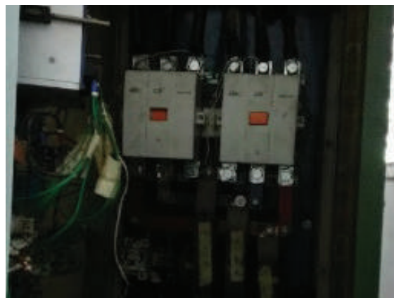
Ilustración 198 transferencia automática. Fuente. Equipo de diagnóstico.
