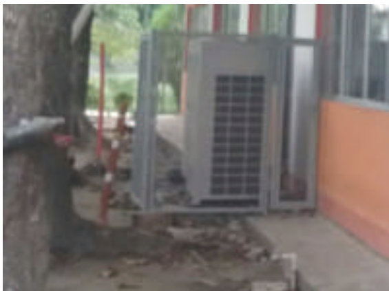
Ilustración 212 condensadora aire acondicionado. Fuente. Equipo de diagnóstico.
