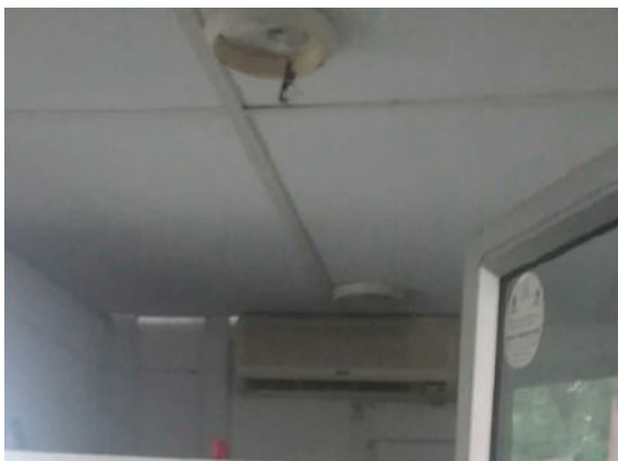
Ilustración 175 punto de iluminación en mal estado. Fuente. Equipo de diagnóstico
