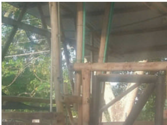
Ilustración 183 tubería PVC expuesta, tubería MT sin marcar. Fuente. Equipo de diagnóstico.
