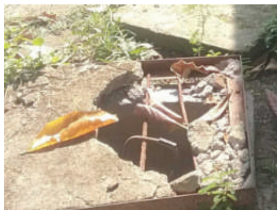
Ilustración 219 tapa de caja de inspección. Fuente. Equipo de diagnóstico.
