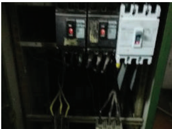
Ilustración 197 tablero general. Fuente. Equipo de diagnóstico
