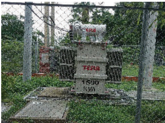
Ilustración 164 transformador de potencia. Fuente. Equipo de diagnóstico.
