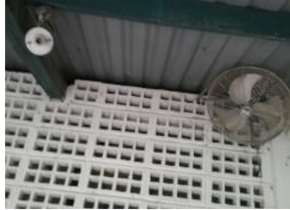
Ilustración 229 punto de iluminación desajustado. Fuente. Equipo de diagnóstico
