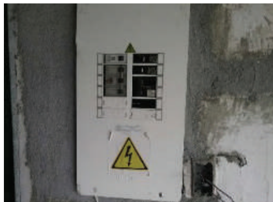
Ilustración 227 tablero de distribución. Fuente. Equipo de diagnóstico.
