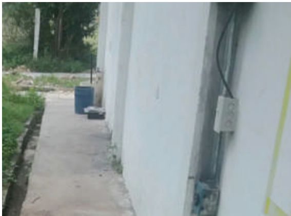
Ilustración 173 tomacorriente trifásica. Fuente. Equipo de diagnóstico.
