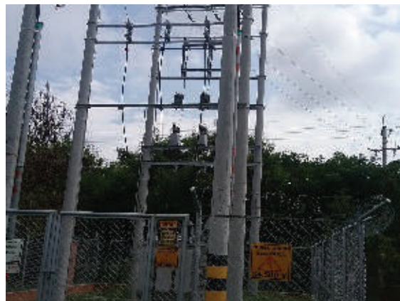
Ilustración 165 subestación. Fuente. Equipo de diagnóstico.
