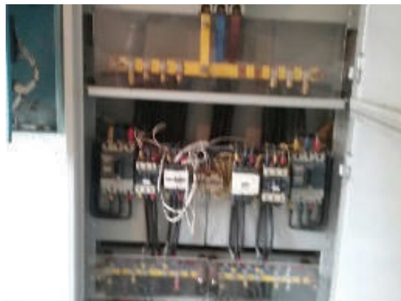
Ilustración 238 tablero general. Fuente. Equipo de diagnóstico.
