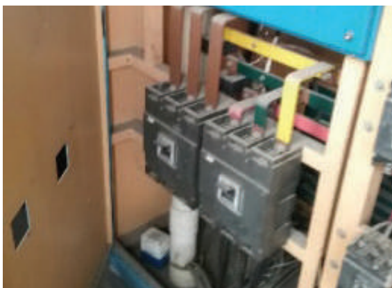
Ilustración 260 tablero general, barrajes desprotegidos. Fuente. Equipo de diagnóstico.
