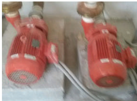
Ilustración 171 bombas de agua potable. Fuente. Equipo de diagnóstico.
