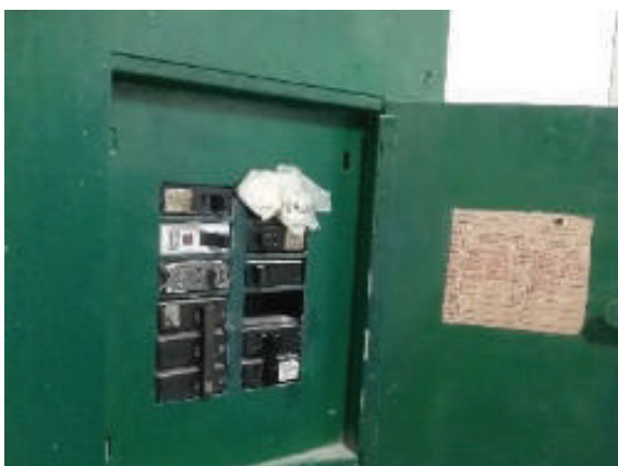
Ilustración 218 tablero de distribución. Fuente. Equipo de diagnóstico.
