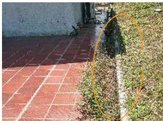
Ilustración 227. Evidencia invasión vegetal cunetas Bloque 29 Fuente. Equipo de diagnóstico
