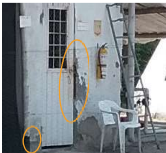
Ilustración 242. Evidencia deterioro avanzado muros Bloque 32 Fuente. Equipo de diagnóstico
