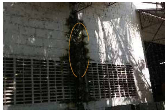
Ilustración 269. Evidencia de humedad Bloque 37 Fuente. Equipo de diagnóstico
