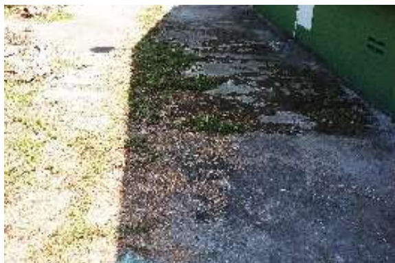
Ilustración 254. Evidencia invasión vegetal andenes Bloque 34 Fuente: Equipo de diagnóstico
