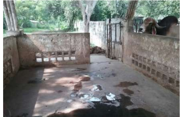
Ilustración 344. Espacio 3 Bloque 4 Fuente Equipo Diagnostico
