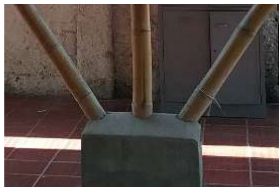
Ilustración 228. Interacción entre estructuras Bloque 29 Fuente. Equipo de diagnóstico
