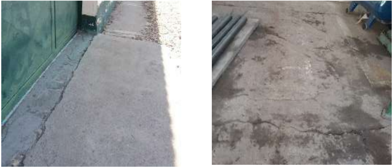
Ilustración 270. Evidencia fisuras andenes Bloque 37 Fuente: Equipo de diagnóstico
