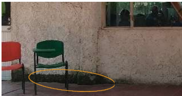
Ilustración 226. Evidencia de humedad Bloque 29 Fuente. Equipo de diagnóstico
