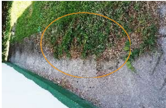
Ilustración 313 Evidencia invasión vegetal andenes Bloque 49 Fuente. Equipo de diagnóstico
