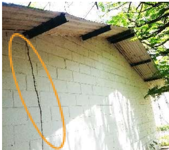
Ilustración 220. Evidencia posibles asentamientos diferenciales Bloque 28 Fuente. Equipo de diagnóstico
