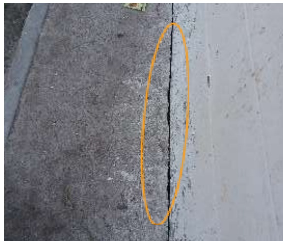
Ilustración 293. Evidencia posibles asentamientos diferenciales Bloque 42 Fuente. Equipo de diagnóstico
