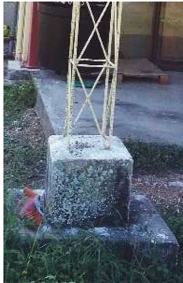
Ilustración 302. Interacción entre estructuras Bloque 43 Fuente. Equipo de diagnóstico
