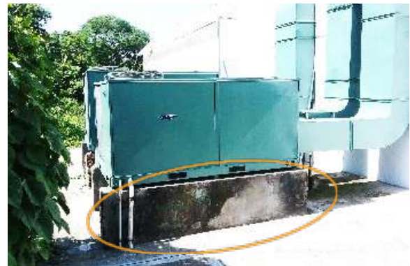
Ilustración 259. Evidencia de humedad Bloque 35 Fuente. Equipo de diagnóstico
