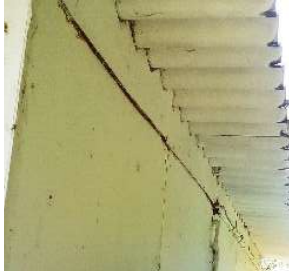
Ilustración 314. Evidencia Corrosión y exposición de tuberías Bloque 49 Fuente. Equipo de diagnóstico
