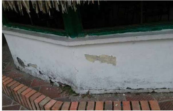
Ilustración 413. Detalle de grietas en muro del bloque 18. Fuente. Equipo de diagnóstico.
