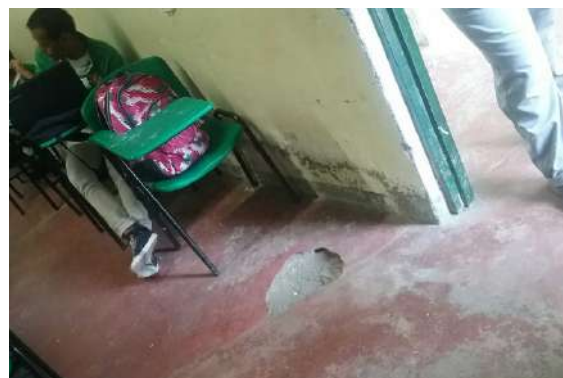
Ilustración 387. Espacio 3, detalle del desgaste en piso y muro. Fuente: Equipo de diagnóstico
