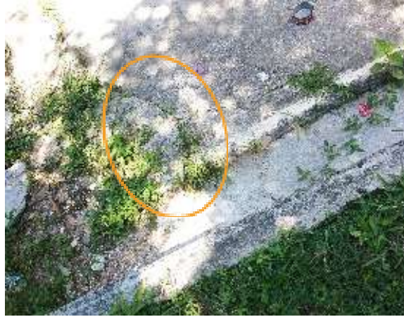
Ilustración 219. Evidencia invasión vegetal andenes Bloque 28 Fuente. Equipo de diagnóstico
