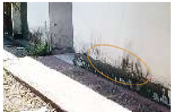
Ilustración 247. Evidencia de humedad Bloque 33 Fuente. Equipo de diagnóstico
