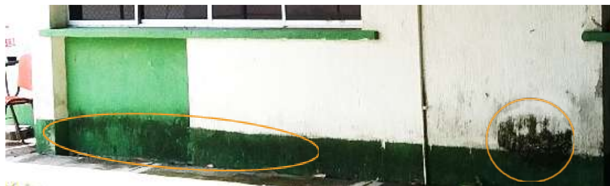
Ilustración 253. Evidencia de humedad Bloque 34 Fuente. Equipo de diagnóstico
