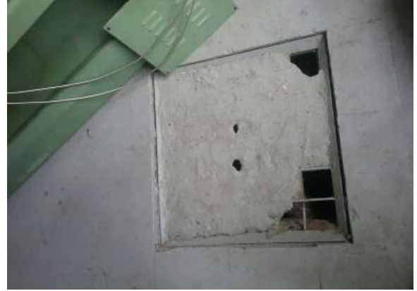
Ilustración 303 Sistema de desagües Bloque 44. Fuente: Equipo de diagnóstico
