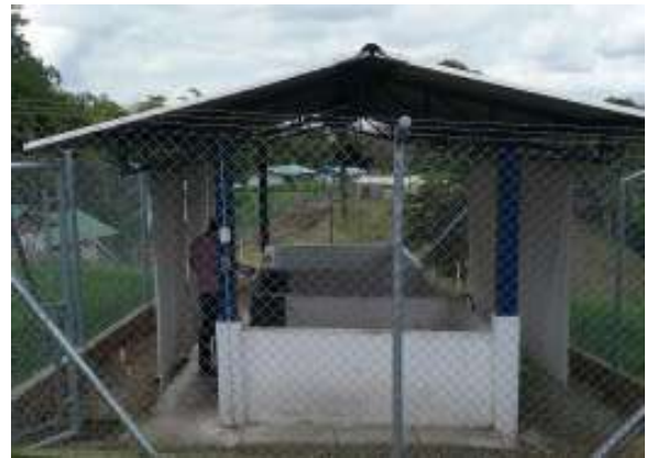
Ilustración 263 Sistema de desagües de aguas lluvias Bloque 27. Fuente: Equipo de diagnóstico
