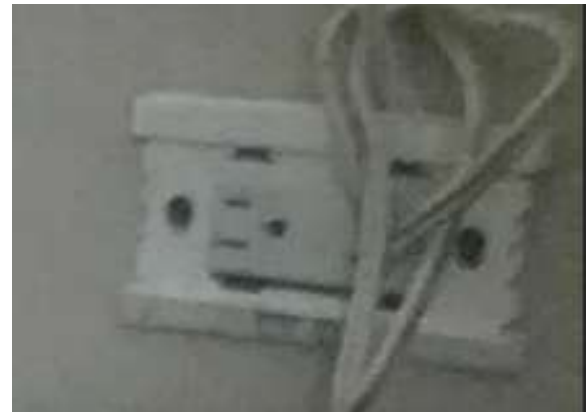
Ilustración 124. Tomacorrientes bloque 34. Fuente: Equipo diagnóstico.
