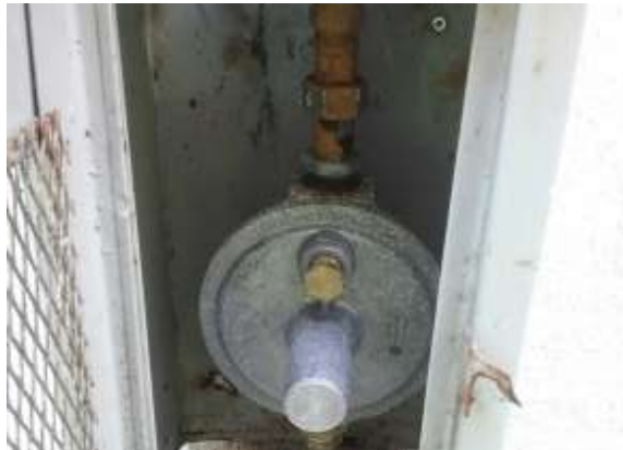
Ilustración 338 Estado de la acometida de gas en Bloque 56. Fuente. Equipo de diagnostico
