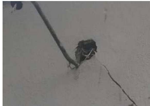
Ilustración 152. Salida eléctrica bloque 42. Fuente: Equipo diagnóstico
