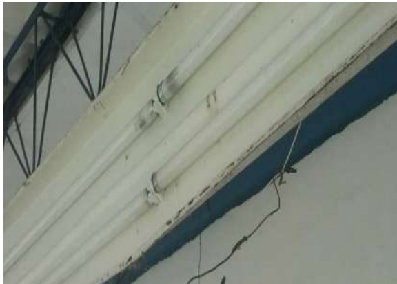
Ilustración 204. Luminaria bloque 58. Fuente: Equipo diagnóstico.
