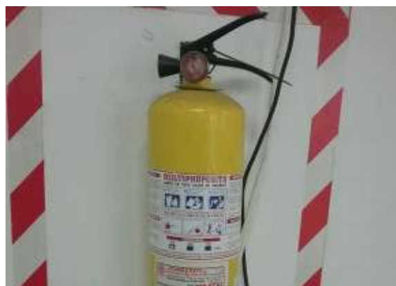
Ilustración 306 Extintores en pasillos del bloque 44 Fuente: Equipo de diagnóstico
