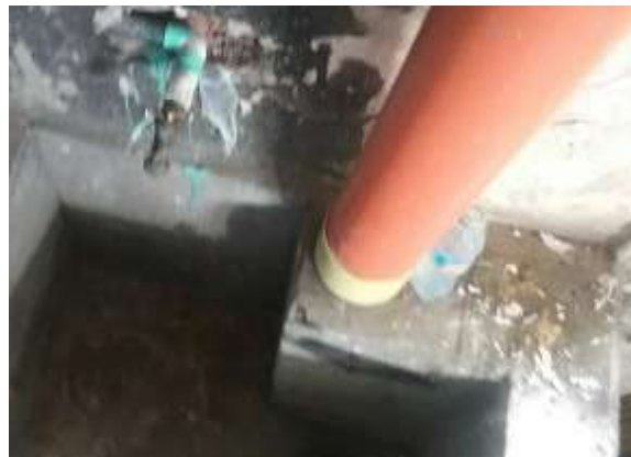
Ilustración 305 Desagües interiores de Aguas Negras en Baños y Cocina Bloque 44. Fuente: Equipo de diagnóstico
