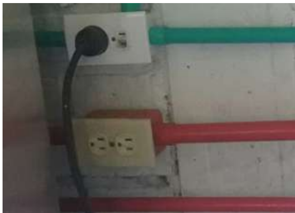
Ilustración 131. Tomacorriente bloque 36. Fuente: Equipo diagnóstico.
