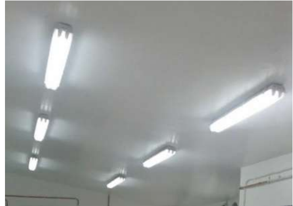
Ilustración 126. Luminarias bloque 34. Fuente: Equipo diagnóstico.
