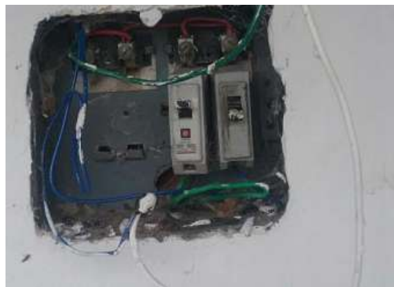
Ilustración 190. Acometida bloque 53. Fuente: Equipo diagnóstico.
