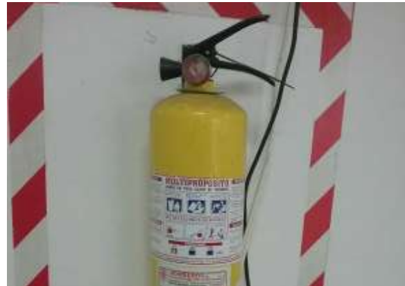
Ilustración 323 Extintores en pasillos del bloque 51 Fuente: Equipo de diagnóstico
