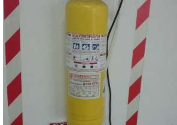
Ilustración 294 Extintores en pasillos del bloque 38 Fuente: Equipo de diagnóstico
