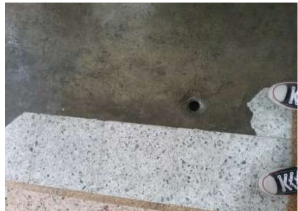
Ilustración 292 Desagües interiores de Aguas Negras en Baños y Cocina Bloque 38 Fuente: Equipo de diagnóstico
