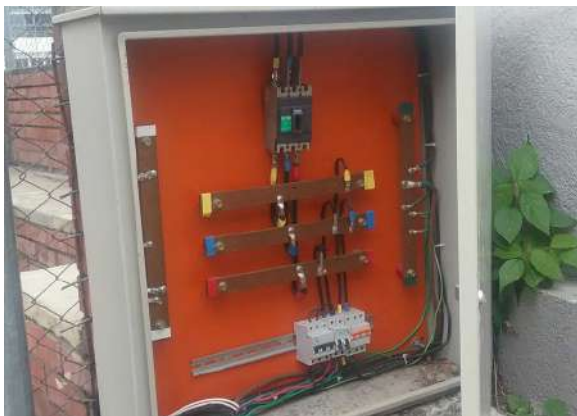
Ilustración 84. Acometida Fuente: Equipo Diagnostico
