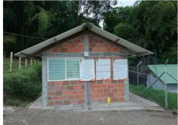
Ilustración 265 Cubiertas sin sistema de desagües Bloque 28 Fuente: Equipo de diagnóstico
