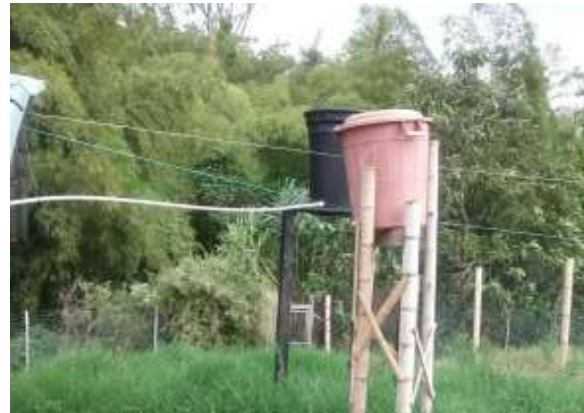
Ilustración 267. Tanques elevados Bloque 29, material plástico, volumen 1 m 3 . Fuente: Equipo de diagnóstico.
