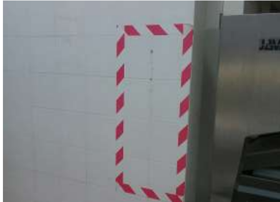
Ilustración 337 Señalización de Extintor contra incendio sin equipo Bloque 56 Fuente: Equipo de diagnóstico
