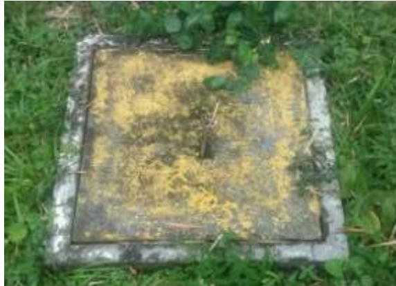
Ilustración 286 Caja de inspección aguas negras exterior bloque 37. Fuente: Equipo de diagnóstico
