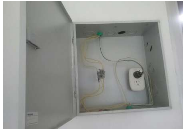
Ilustración 65. Tomacorrientes Fuente: Equipo Diagnostico.
