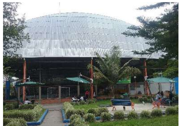
Ilustración 285 Cubiertas sin sistema de desagües Bloque 37. Fuente: Equipo de diagnóstico
