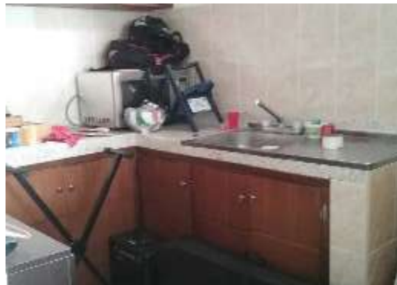
Ilustración 242 Salidas o puntos hidráulicos de conexión Bloque 14 Fuente: Equipo de diagnóstico
