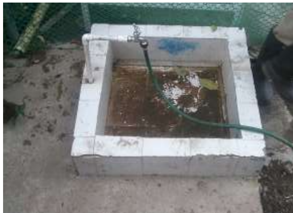
Ilustración 316 Salidas o puntos hidráulicos de conexión Bloque 48 Fuente: Equipo de diagnóstico
