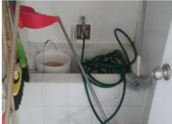
Ilustración 335 Salidas o puntos hidráulicos de conexión Bloque 56 Fuente: Equipo de diagnóstico
