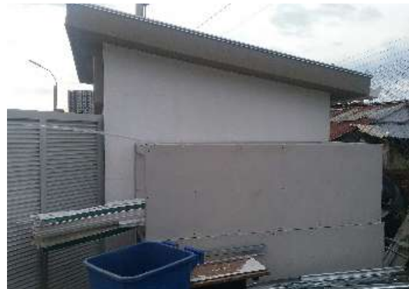
Ilustración 250 Sistema de desagües de aguas lluvias Bloque 19. Fuente: Equipo de diagnóstico
