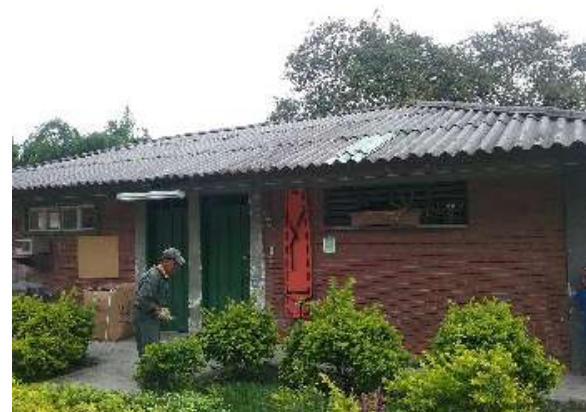
Ilustración 238 Cubiertas sin sistema de desagües Bloque 13 Fuente: Equipo de diagnóstico
