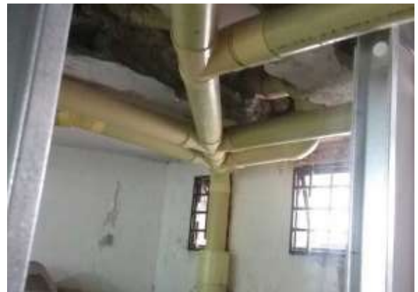
Ilustración 304 Sistema de desagües Bloque 44. Fuente: Equipo de diagnóstico
