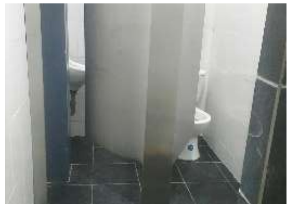
Ilustración 296 Instalaciones hidráulicas Bloque 39. Fuente: Equipo de diagnóstico
