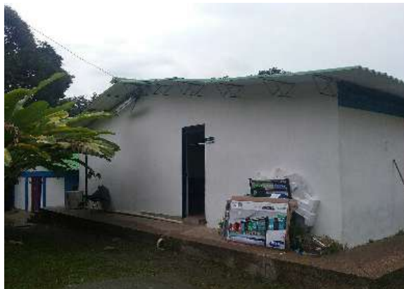
Ilustración 341 Estado de los canales y bajantes de aguas lluvias en el Bloque 57
