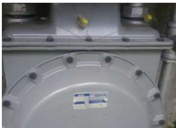
Ilustración 279 Estado de la acometida de gas en Bloque 34. Fuente. Equipo de diagnostico
