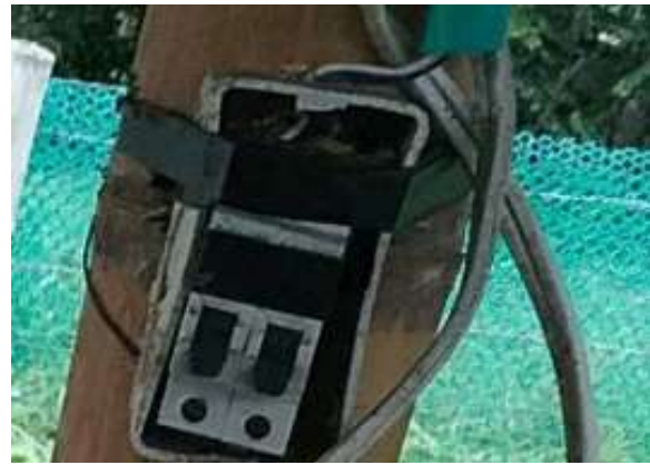
Ilustración 175. Control maquinaria bloque 49. Fuente: Equipo diagnóstico.
