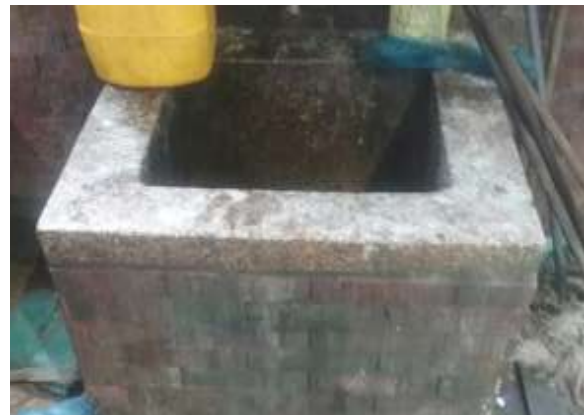
Ilustración 302 Instalaciones hidráulicas Bloque 44 Fuente: Equipo de diagnóstico
