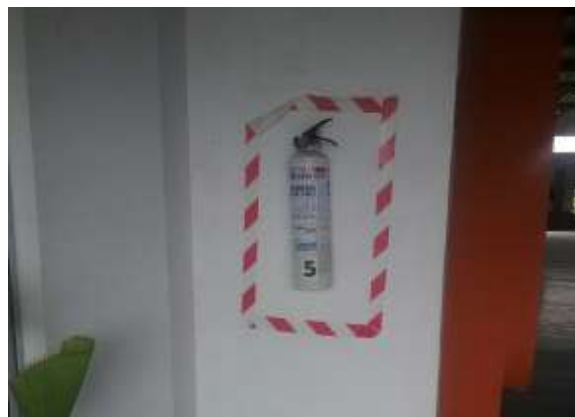
Ilustración 219. Extintores en pasillos del bloque 4 Fuente: Equipo de diagnóstico
