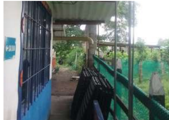
Ilustración 317 Estado de los canales y bajantes de aguas lluvias en el Bloque 48
