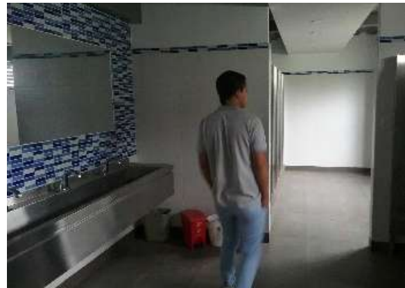
Ilustración 226. Instalaciones hidráulicas en baños de Bloque 9. Fuente: Equipo de diagnóstico
