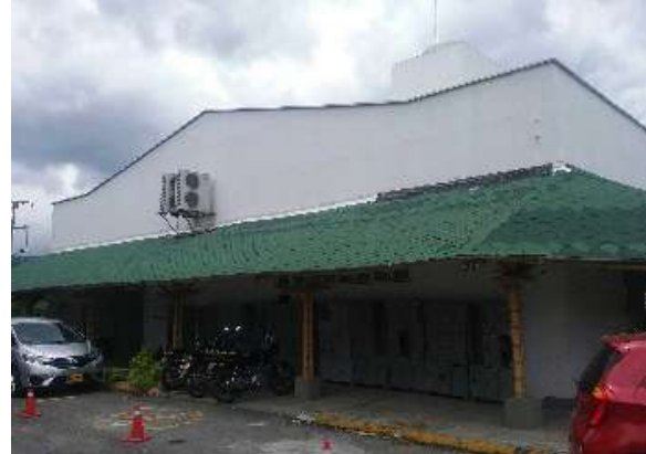
Ilustración 225. Cubiertas sin sistema de desagües Bloque 8 Fuente: Equipo de diagnóstico
