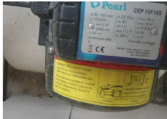
Ilustración 241 Equipo de bombeo Bloque 14. Fuente: Equipo de diagnóstico
