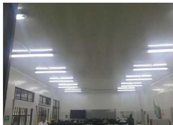
Ilustración 142. Luminarias bloque 38. Fuente: Equipo diagnóstico.
