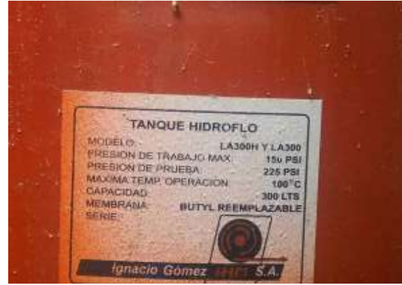
Ilustración 288 Equipo de bombeo Bloque 38. Fuente: Equipo de diagnóstico
