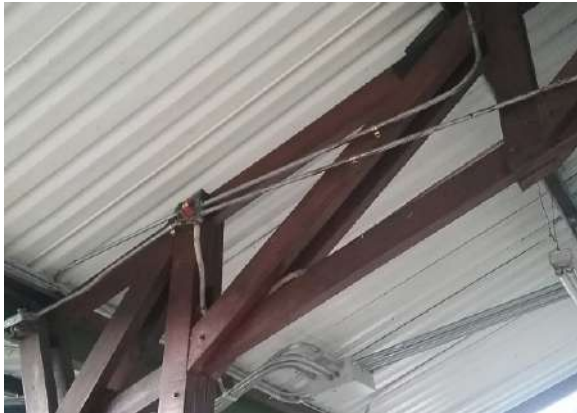
Ilustración 95. Tubería Fuente: Equipo Diagnostico
