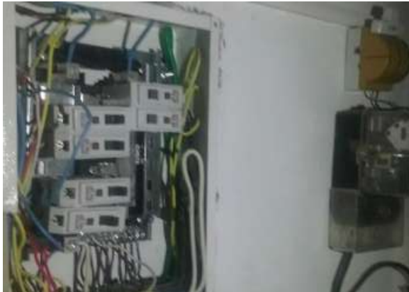
Ilustración 79. Acometida Fuente: Equipo Diagnostico
