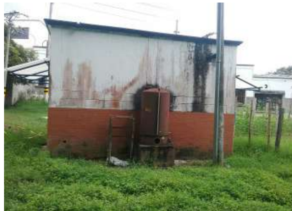
Ilustración 301 Sistema de desagües de aguas lluvias Bloque 43. Fuente: Equipo de diagnóstico
