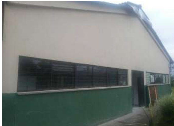
Ilustración 312 Estado de canales y bajantes de las cubiertas de Bloque 47 Fuente: Equipo de diagnóstico
