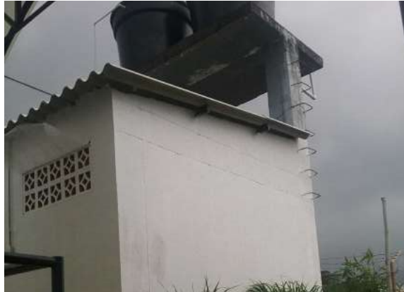
Ilustración 344. Tanque elevado de agua potable Bloque 60, material plástico, volumen 1 m 3 . Fuente: Equipo de diagnóstico.
