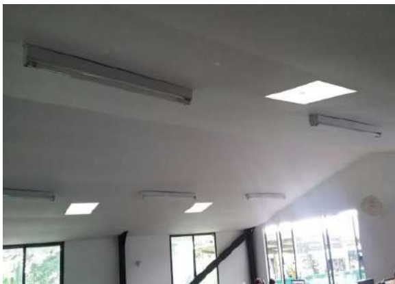
Ilustración 172. Iluminación bloque 48. Fuente: Equipo diagnóstico.
