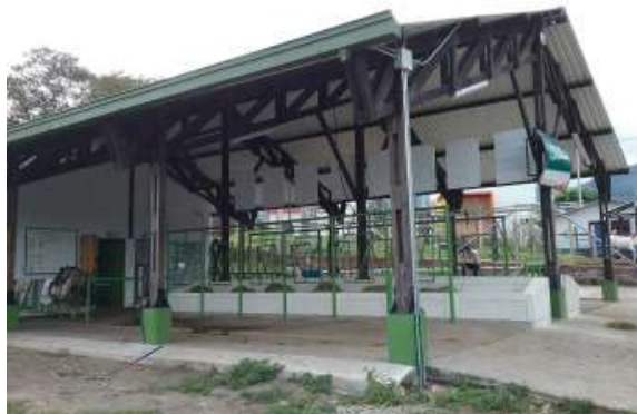
Ilustración 254 Cubiertas sin sistema de desagües Bloque 22 Fuente: Equipo de diagnóstico
