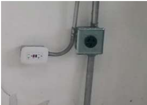
Ilustración 123. Tomacorrientes bloque 34. Fuente: Equipo diagnóstico.
