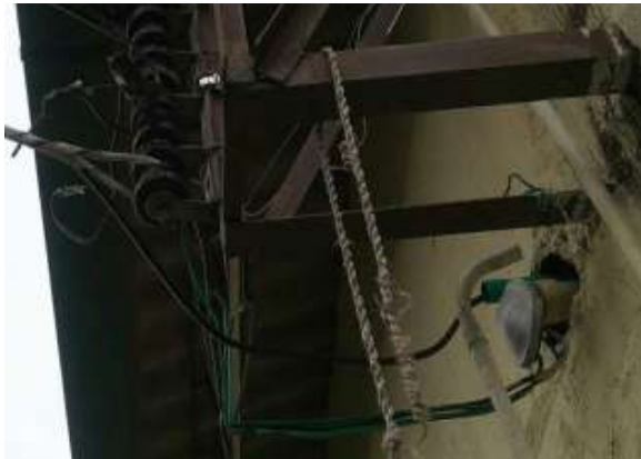
Ilustración 166. Acometida bloque 47. Fuente: Equipo diagnóstico.
