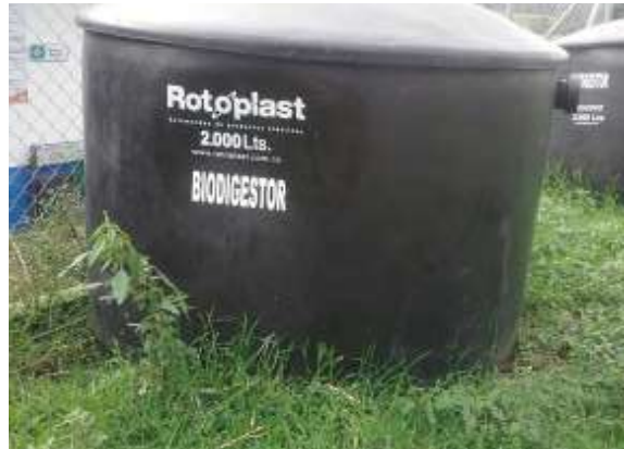
Ilustración 258. Tanque en superficie de agua no potable Bloque 24, material plástico, volumen 1 m 3 . Fuente: Equipo de diagnóstico.
