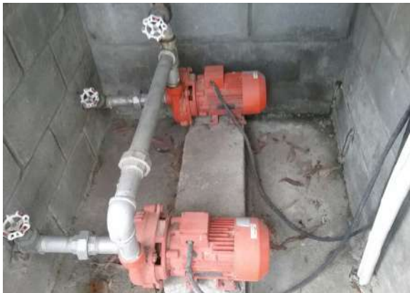
Ilustración 9. Bombas Fuente: Equipo Diagnostico
