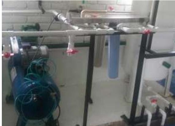
Ilustración 282 Estado actual de equipos de bombeo en el Bloque 36
