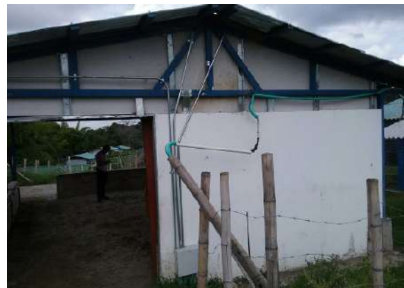
Ilustración 259 Sistema de desagües de aguas lluvias Bloque 24. Fuente: Equipo de diagnóstico
