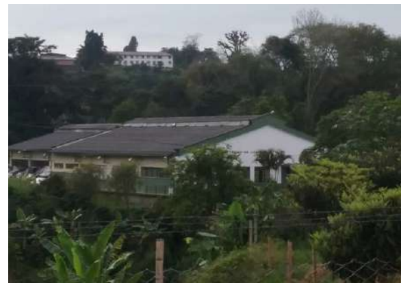
Ilustración 347 Estado de los canales y bajantes de aguas lluvias en el Bloque 60
