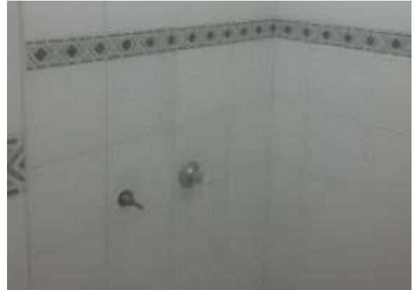
Ilustración 284 Instalaciones hidráulicas Bloque 37. Fuente: Equipo de diagnóstico
