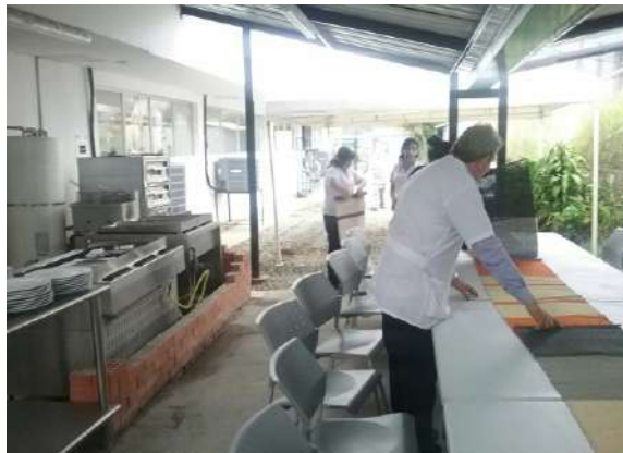
Ilustración 348 Estado de la acometida de gas en Bloque 56. Fuente. Equipo de diagnostico
