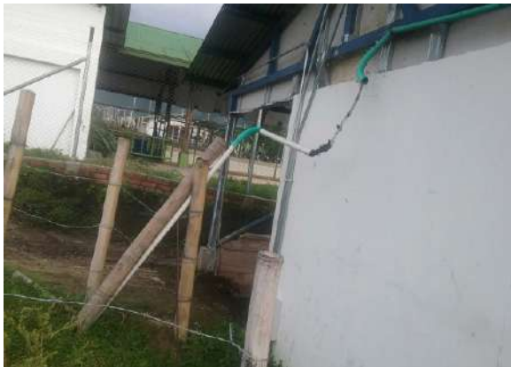
Ilustración 103. Acometida Fuente: Equipo Diagnostico
