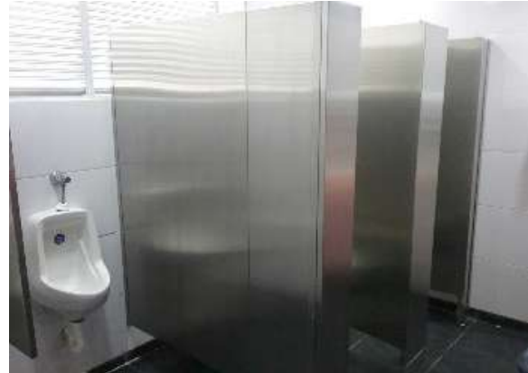
Ilustración 231. Instalaciones hidráulicas en baños de Bloque 10. Fuente: Equipo de diagnóstico
