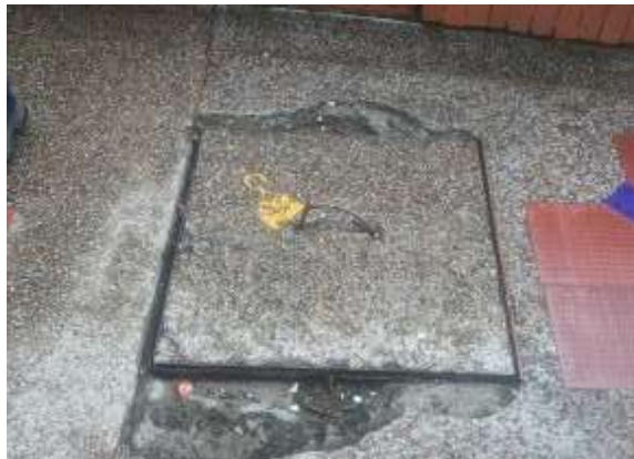
Ilustración 297 Cubiertas sin sistema de desagües Bloque 39 Fuente: Equipo de diagnóstico
