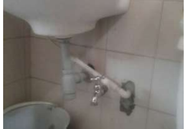
Ilustración 307 Instalaciones hidráulicas Bloque 45 Fuente: Equipo de diagnóstico
