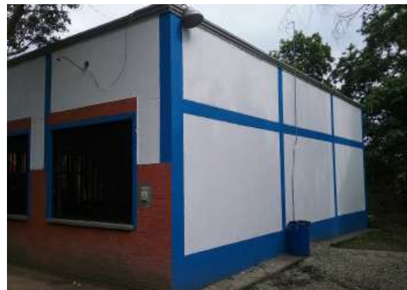
Ilustración 300 Sistema de desagües de aguas lluvias Bloque 42. Fuente: Equipo de diagnóstico
