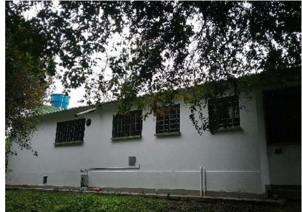
Ilustración 334. Tanque elevado de agua potable Bloque 56, material plástico, volumen 1 m 3 . Fuente: Equipo de diagnóstico.
