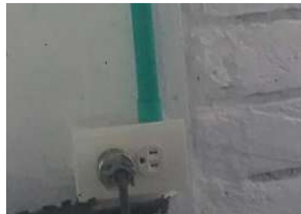
Ilustración 132. Tomacorriente bloque 36. Fuente: Equipo diagnóstico.
