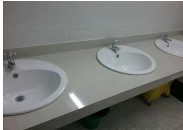
Ilustración 290 Instalaciones hidráulicas Bloque 38 Fuente: Equipo de diagnóstico
