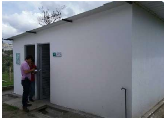
Ilustración 257 Sistema de desagües de aguas lluvias Bloque 23. Fuente: Equipo de diagnóstico
