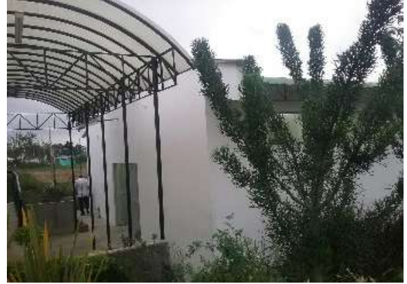
Ilustración 325 Sistema de desagües de aguas lluvias Bloque 52. Fuente: Equipo de diagnóstico
