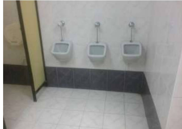
Ilustración 275 Instalaciones hidráulicas Bloque 34 Fuente: Equipo de diagnóstico
