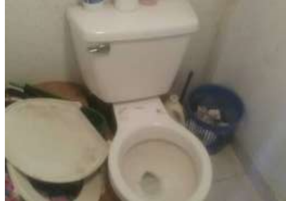
Ilustración 216. Instalaciones hidráulicas Bloque 1 Fuente: Equipo de diagnóstico
