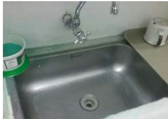
Ilustración 311 Instalaciones hidráulicas en baños de Bloque 47. Fuente: Equipo de diagnóstico
