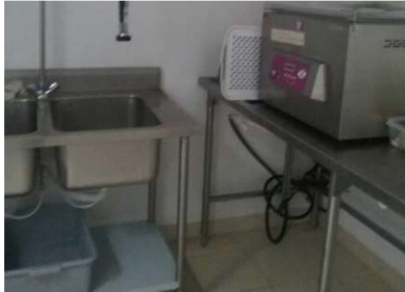
Ilustración 346 Salidas o puntos hidráulicos de conexión Bloque 60 Fuente: Equipo de diagnóstico
