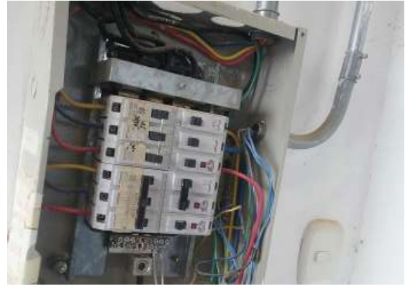
Ilustración 63. Tablero eléctrico. Fuente: Equipo Diagnostico.
