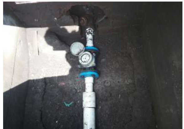
Ilustración 214. Medidores agua potable de ½" localizados en Bloque 1 y Bloque 54. Fuente: Equipo de diagnóstico.
