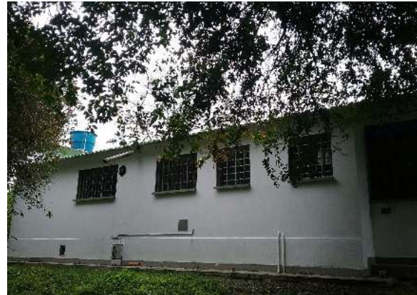
Ilustración 336 Estado de los canales y bajantes de aguas lluvias en el Bloque 56
