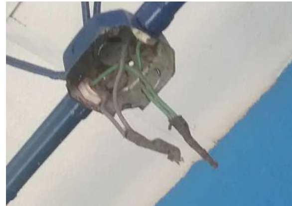
Ilustración 205. Luminaria bloque 58. Fuente: Equipo diagnóstico.
