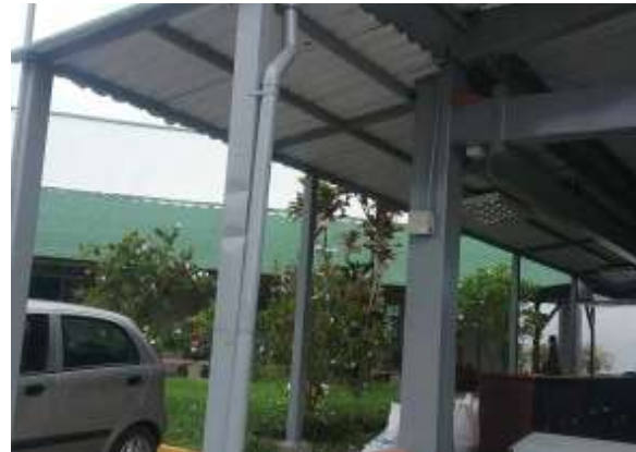
Ilustración 228. Estado de canales y bajantes de las cubiertas de Bloque 9 Fuente: Equipo de diagnóstico
