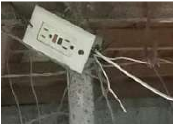
Ilustración 207. Tomacorrientes bloque 59 Fuente: Equipo diagnóstico.
