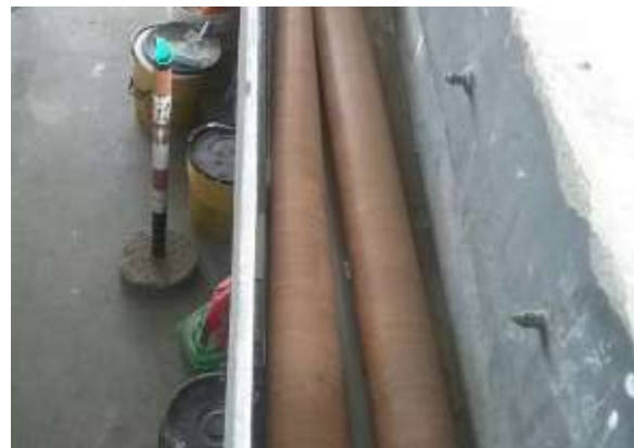
Ilustración 227. Salidas o puntos hidráulicos en el Bloque 9. Fuente: Equipo de diagnóstico
