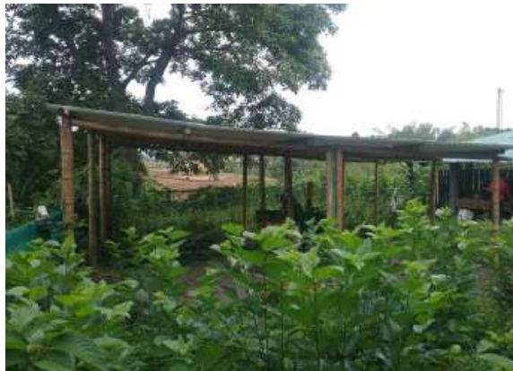
Ilustración 318 Sistema de desagües de aguas lluvias Bloque 49. Fuente: Equipo de diagnóstico
