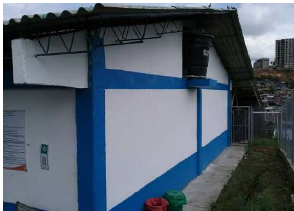
Ilustración 260. Tanque en superficie de agua no potable Bloque 24, material plástico, volumen 1 m 3 . Fuente: Equipo de diagnóstico.
