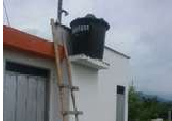
Ilustración 240. Tanques elevados de agua potable Bloque 14, material plástico, volumen 1 m 3 . Fuente: Equipo de diagnóstico.
