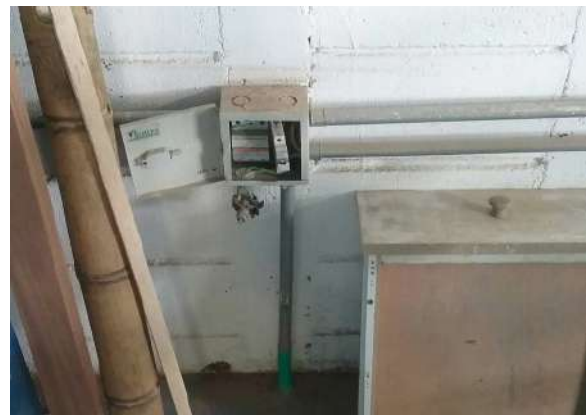
Ilustración 61. Tablero eléctrico. Fuente: Equipo Diagnostico.
