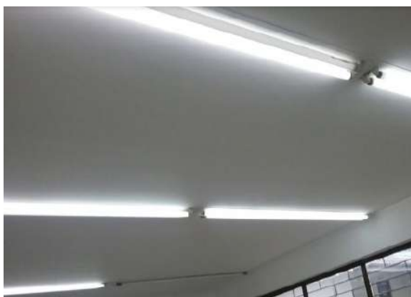
Ilustración 169. Luminarias bloque 47. Fuente: Equipo diagnóstico.
