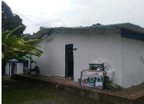
Ilustración 342 Sistema de desagües de aguas lluvias Bloque 58. Fuente: Equipo de diagnóstico
