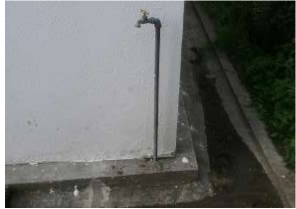
Ilustración 253 Instalaciones hidráulicas Bloque 22. Fuente: Equipo de diagnóstico
