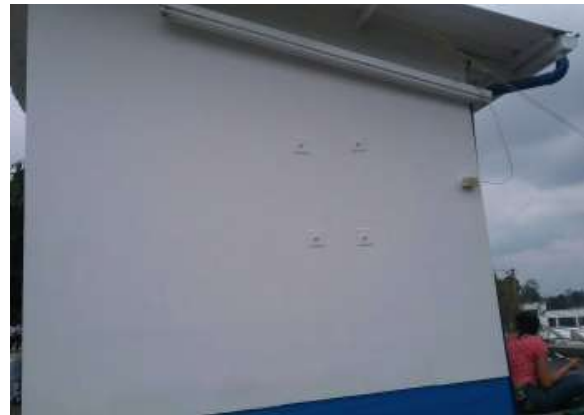
Ilustración 298 Sistema de desagües de aguas lluvias Bloque 40. Fuente: Equipo de diagnóstico
