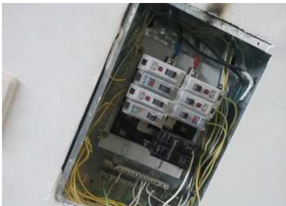
Ilustración 60. Tablero eléctrico. Fuente: Equipo Diagnostico.
