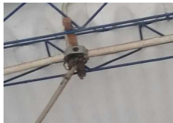
Ilustración 170. Luminarias bloque 47. Fuente: Equipo diagnóstico.
