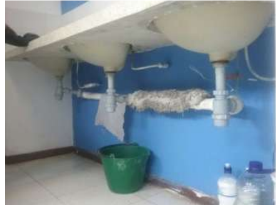
Ilustración 221. Instalaciones hidráulicas Bloque 6 Fuente: Equipo de diagnóstico
