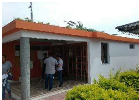
Ilustración 243 Estado de las cubiertas y desagües de aguas lluvias en el Bloque 14
