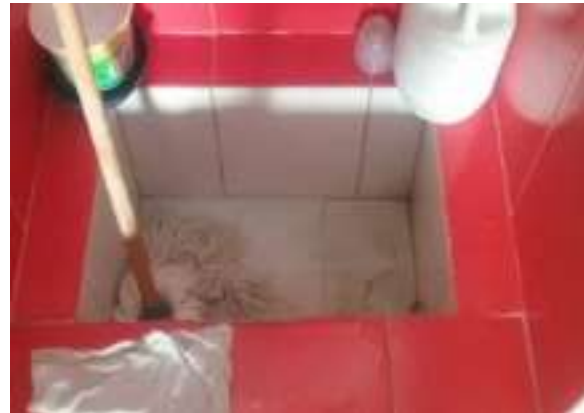
Ilustración 244 Instalaciones hidráulicas Bloque 15 Fuente: Equipo de diagnóstico
