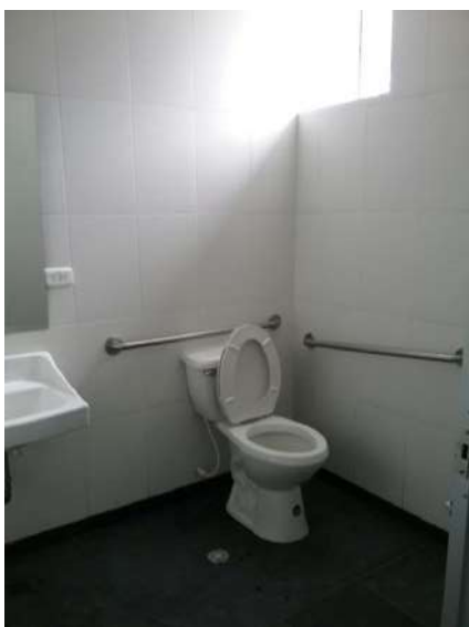
Ilustración 180. Espacio 4 Bloque 54. Fuente. Equipo de diagnóstico.
