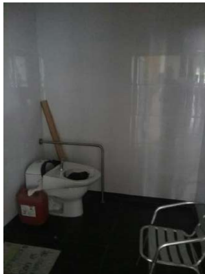
Ilustración 179. Espacio 15 Bloque 10. Fuente. Equipo de diagnóstico.
