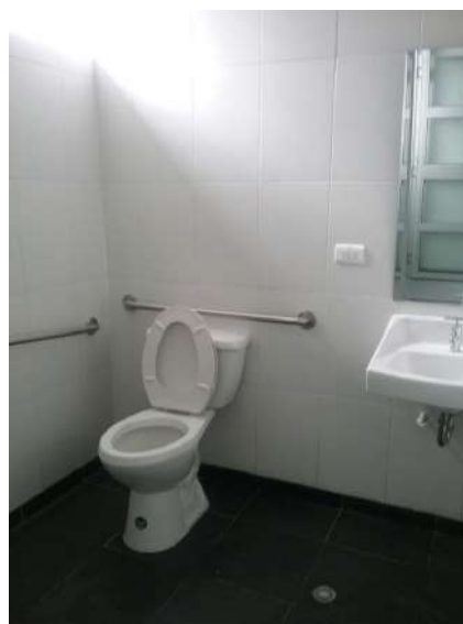
Ilustración 181. Espacio 12 Bloque 54. Fuente. Equipo de diagnóstico.
