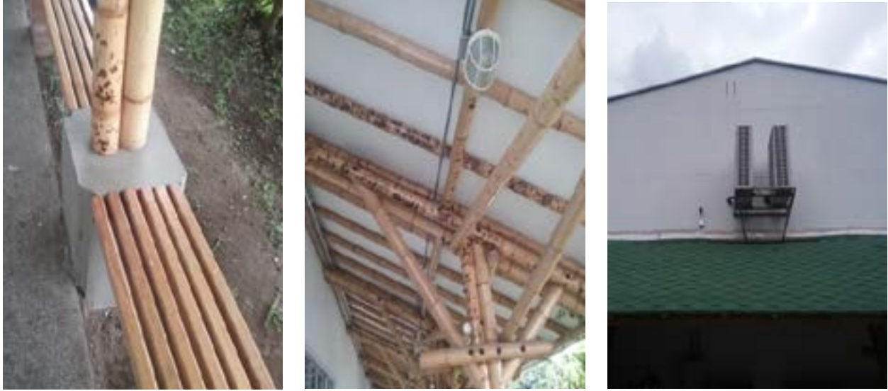
Ilustración 48. Sistema estructural de cubierta en corredor de zona exterior Fuente. Equipo de Diagnóstico
