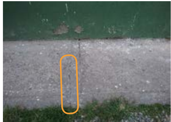
Ilustración 141. Parte de andén perimetral Fuente. Equipo de Diagnóstico
