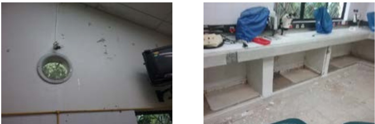
Ilustración 90. Humedad en muros de fachada de mampostería Fuente. Equipo de Diagnóstico
