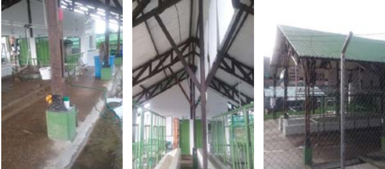
Ilustración 70. Estructura cercha en madera Fuente. Equipo de Diagnóstico
