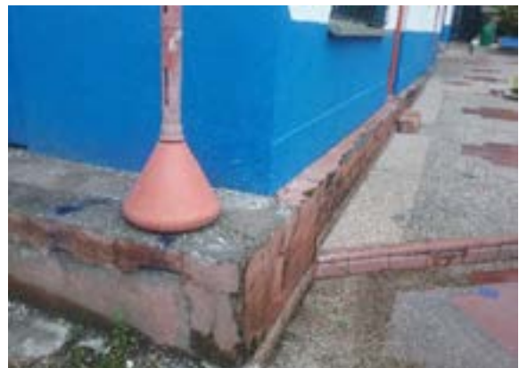
Ilustración 109. Desgaste parte del andén Fuente. Equipo de Diagnóstico
