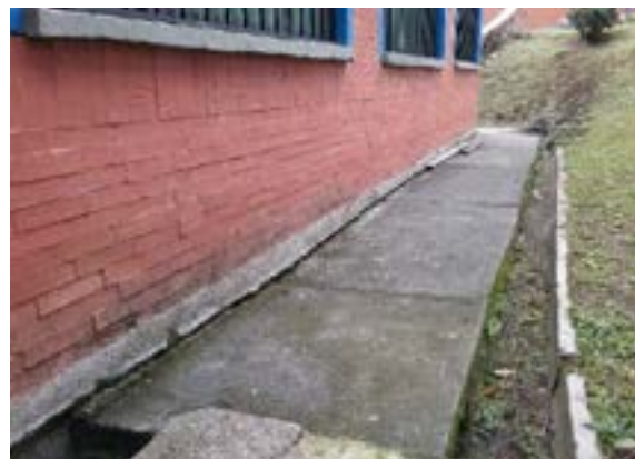
Ilustración 117. Asentamiento en andén perimetral Fuente. Equipo de Diagnóstico
