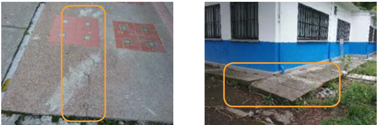
Ilustración 89. Grietas y asentamientos en andén Fuente. Equipo de Diagnóstico
