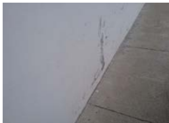
Ilustración 150. Fisuras en pañete Fuente. Equipo de Diagnóstico
