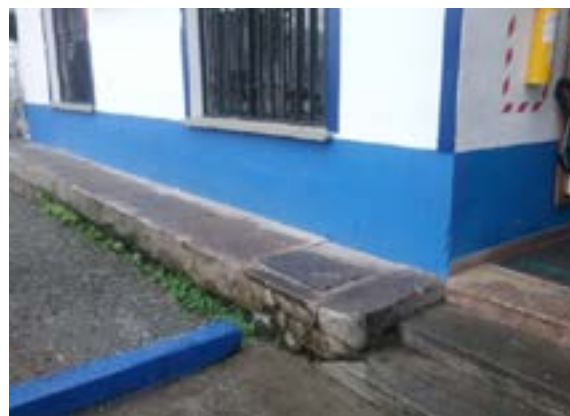
Ilustración 107. Fisuras en elementos horizontales Fuente. Equipo de Diagnóstico
