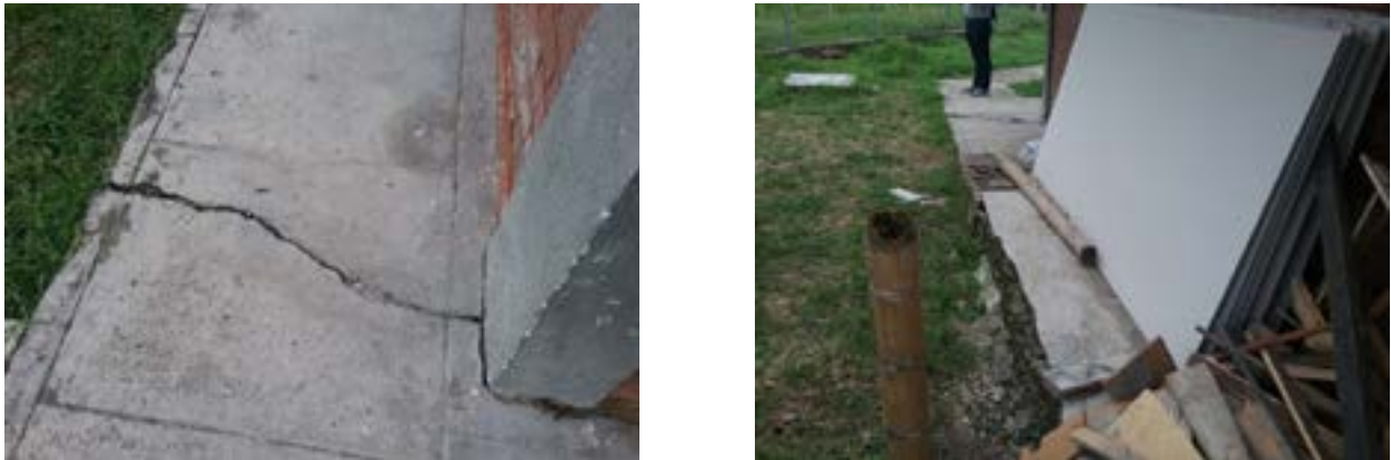
Ilustración 58. Problemas en andén perimetral Fuente. Equipo de Diagnóstico
