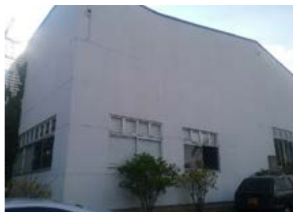
Ilustración 220. Bloque No. 6. Fuente: Equipo de diagnóstico.
