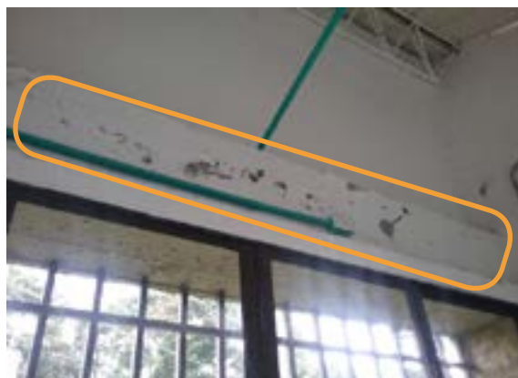
Ilustración 130. Humedad en espacio (mantenimiento de computadores) Fuente. Equipo de Diagnóstico
