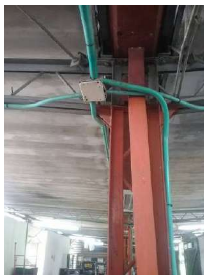
Ilustración 175. Tubería. Fuente: Equipo diagnóstico
