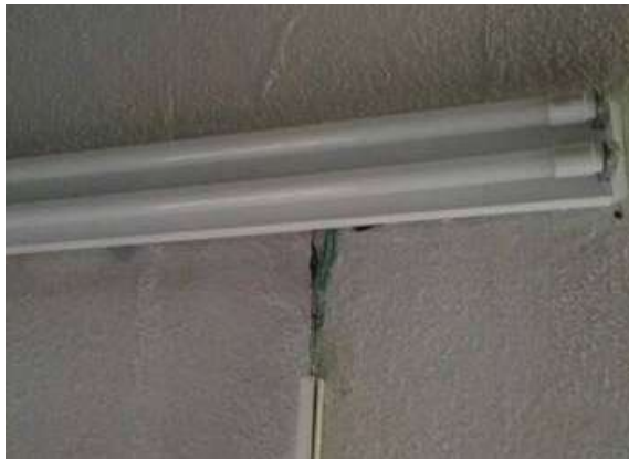
Ilustración 15. Iluminación (Canaleta deteriorada). Fuente: equipo de diagnóstico
