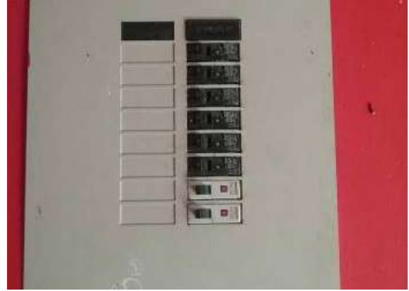
Ilustración 117. Tablero de distribución. Fuente: equipo de diagnóstico.
