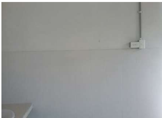
Ilustración 253. Tablero Fuente: Equipo diagnóstico.
