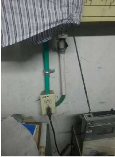
Ilustración 192. Conductores. Fuente: Equipo diagnóstico
