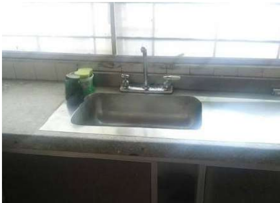
Ilustración 370 Lavamanos tipo llave. Fuente: equipo de diagnóstico.
