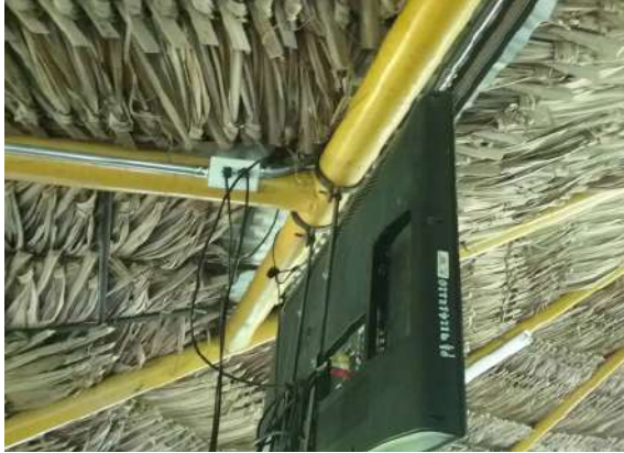
Ilustración 83. Tubería EMT sin marcar. Fuente: equipo de diagnóstico.
