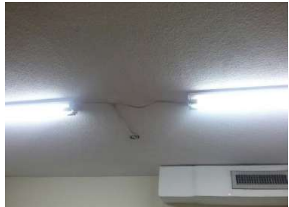
Ilustración 16. Iluminación (Conductores expuestos). Fuente: equipo de diagnóstico.
