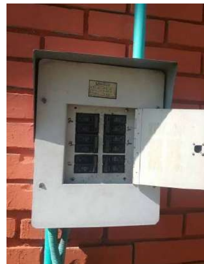
Ilustración 153. Tablero de distribución (Tubería PVC expuesta). Fuente: equipo de diagnóstico
