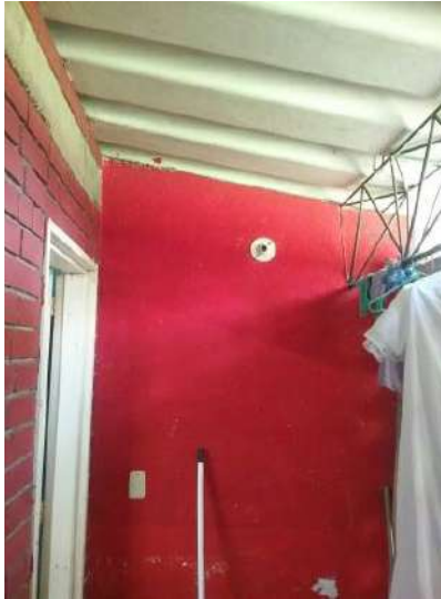
Ilustración 120. Iluminación (Lámpara ausente). Fuente: equipo de diagnóstico.
