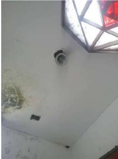
Ilustración 25. Iluminación (luminaria desprendida). Fuente: equipo de diagnóstico.
