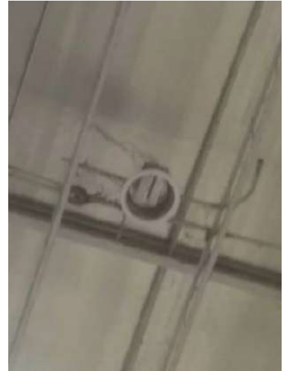
Ilustración 27. Iluminación (lámparas no instaladas). Fuente: equipo de diagnóstico.
