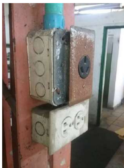
Ilustración 178. Tomacorriente. Fuente: Equipo diagnóstico
