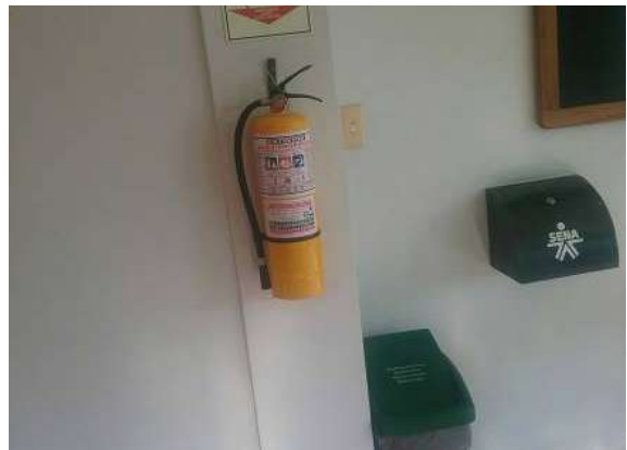
Ilustración 353 Extintor tipo multipropósito. Fuente: equipo de diagnóstico.
