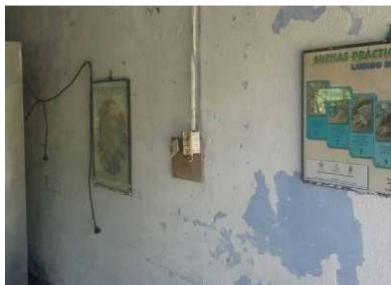
Ilustración 241. Tomacorriente. Fuente: Equipo diagnostico
