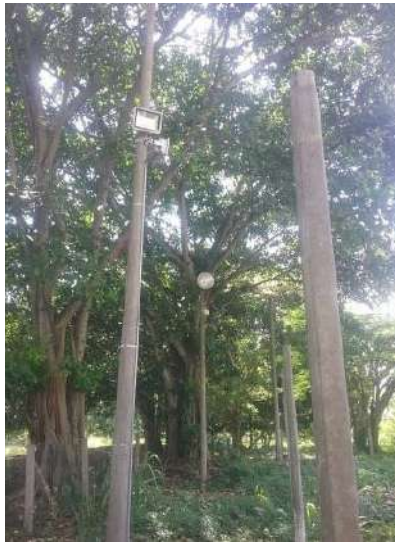
Ilustración 226. Luminarias. Fuente: Equipo diagnóstico.
