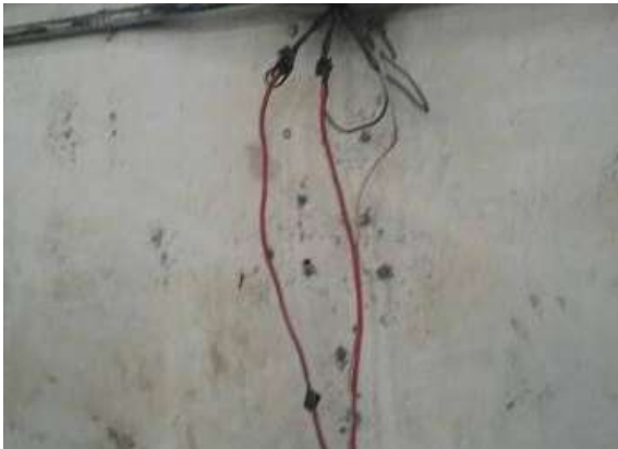
Ilustración 144. Caja de paso (conductores eléctricos expuestos). Fuente: equipo de diagnóstico.
