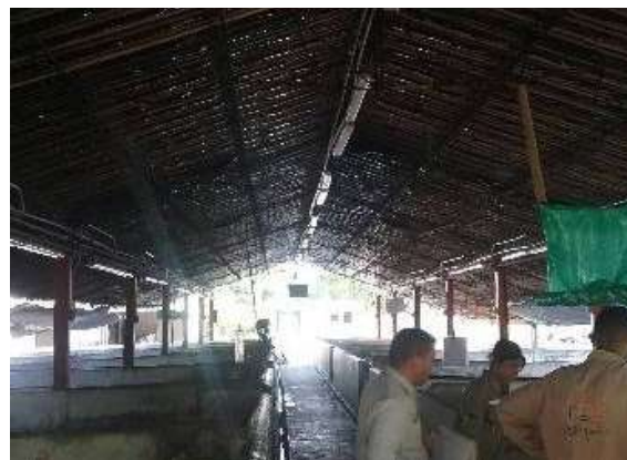
Ilustración 274. Iluminación bloque 49. Fuente: equipo de diagnóstico.
