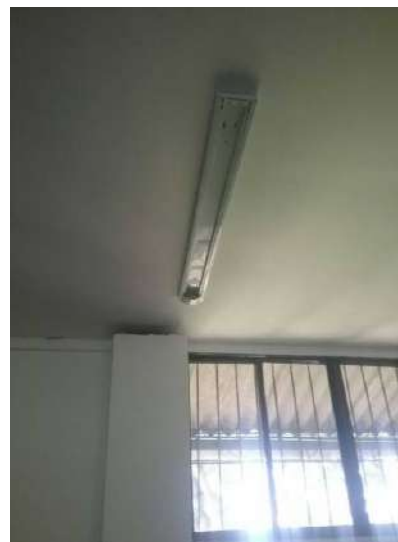
Ilustración 220. Luminarias. Fuente equipo diagnostico
