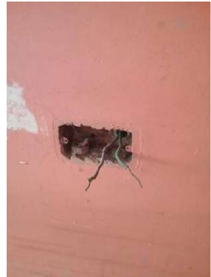
Ilustración 49. Salida para tomacorriente. Fuente: equipo de diagnóstico
