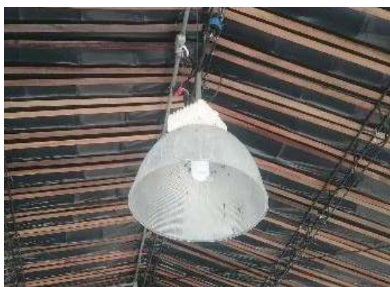
Ilustración 297. Iluminación. Bloque 60. Fuente: equipo de diagnóstico.
