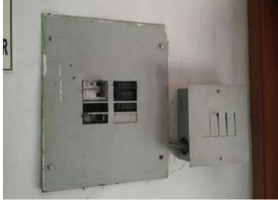
Ilustración 71 Tablero de distribución (conductores eléctricos expuestos). Fuente: equipo de diagnóstico.
