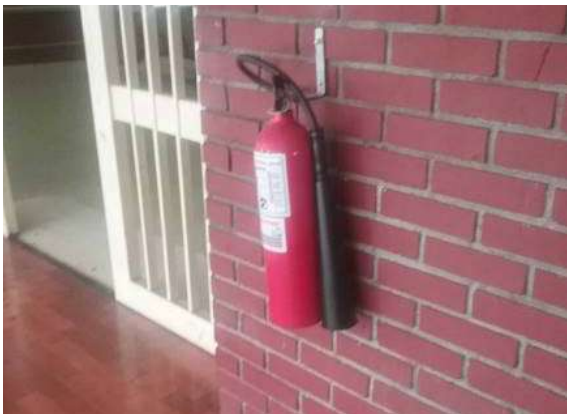
Ilustración 352 Extintor tipo CO2. Fuente: equipo de diagnóstico.
