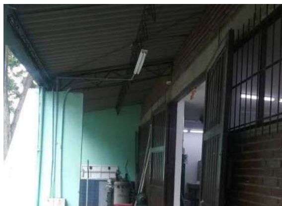
Ilustración 224. Tubería. Fuente: Equipo diagnóstico.
