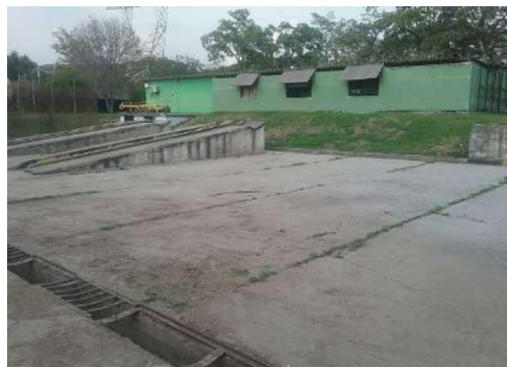
Ilustración 165. Sin instalaciones eléctricas. Fuente: Equipo diagnóstico
