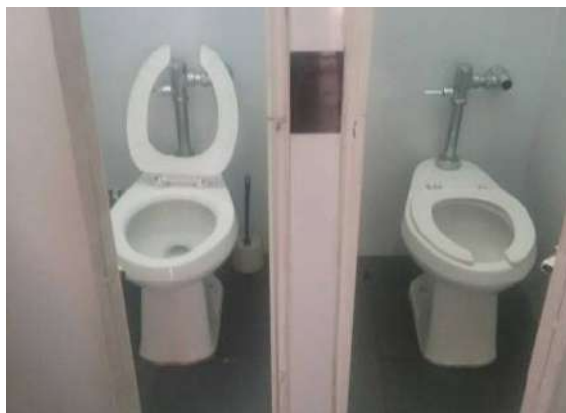
Ilustración 347 Punto hidráulico en 2" para retretes tipo push. Fuente: equipo de diagnóstico.
