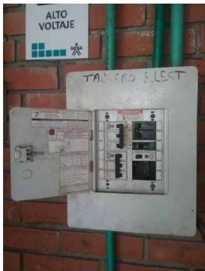
Ilustración 153. Tablero de distribución (Tubería PVC expuesta). Fuente: equipo de diagnóstico
