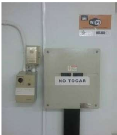
Ilustración 18. Tablero de distribución. Fuente: equipo de diagnóstico.
