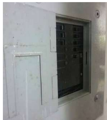
Ilustración 19. Tablero de distribución. Fuente: equipo de diagnóstico.
