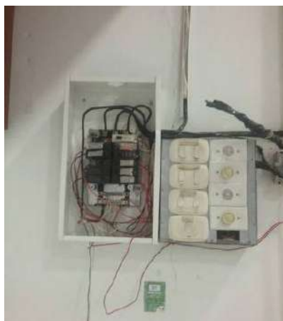
Ilustración 17. Tablero de distribución (auditorio). Fuente: equipo de diagnóstico.
