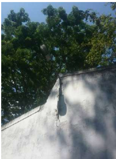
Ilustración 219. Luminarias. Fuente equipo diagnostico
