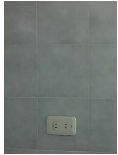
Ilustración 43. Tomacorriente (Baño). Fuente: equipo de diagnóstico.
