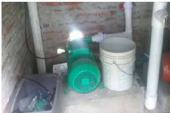
Ilustración 475 Equipo de bombeo para riego. Fuente: equipo de diagnóstico.
