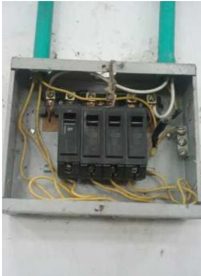
Ilustración 142. Tablero de distribución. Fuente: equipo de diagnóstico
