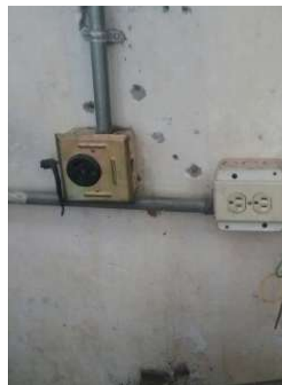
Ilustración 149. Salida para tomacorriente (Conductores eléctricos expuestos). Fuente: equipo de diagnóstico.
