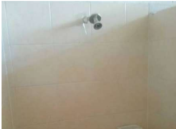
Ilustración 356 Punto hidráulico para ducha. Fuente: equipo de diagnóstico.
