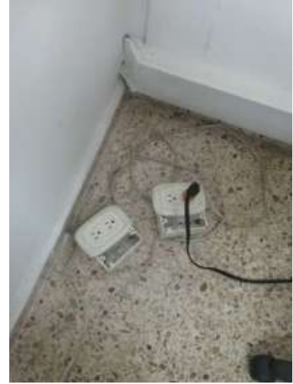
Ilustración 12. Extensión eléctrica. Fuente: equipo de diagnóstico.
