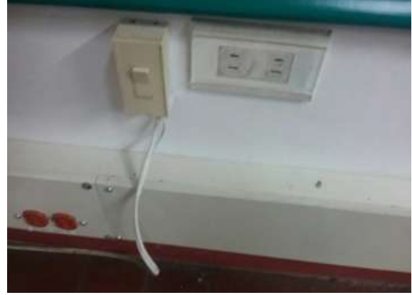
Ilustración 40. Tomacorriente (sin puesta a tierra). Fuente: equipo de diagnóstico.
