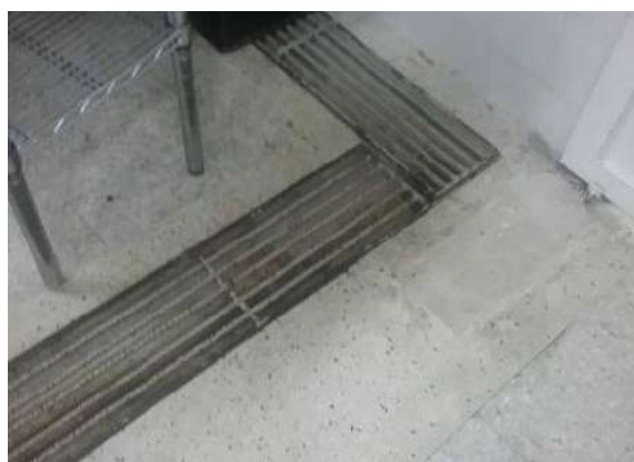
Ilustración 359 Sifón de piso en acero. Fuente: equipo de diagnóstico.
