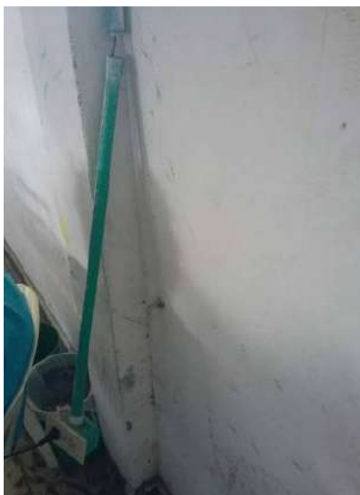
Ilustración 202. Tomacorriente. Fuente: Equipo diagnóstico
