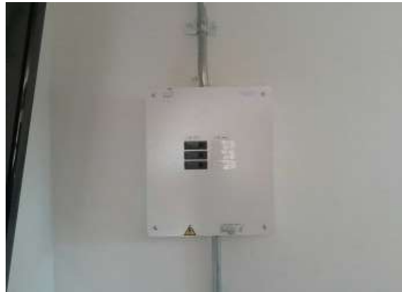
Ilustración 88 Tablero de distribución (tubería EMT sin marcar). Fuente: equipo de diagnóstico.
