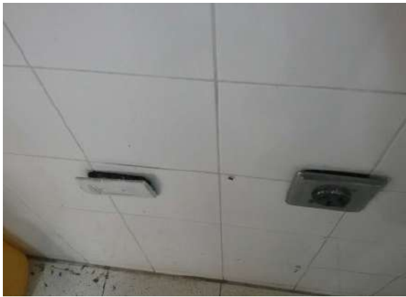
Ilustración 72. Tomacorriente. Fuente: equipo de diagnóstico.
