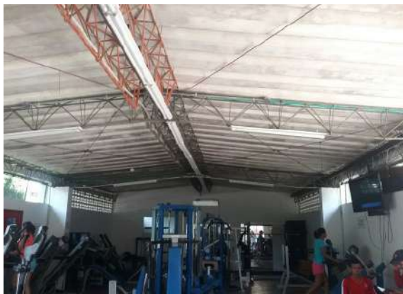
Ilustración 138. Iluminación (Tubería PVC expuesta). Fuente: equipo de diagnóstico.
