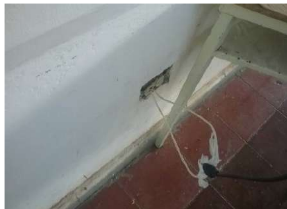
Ilustración 248. Tomacorriente. Fuente: Equipo diagnóstico
