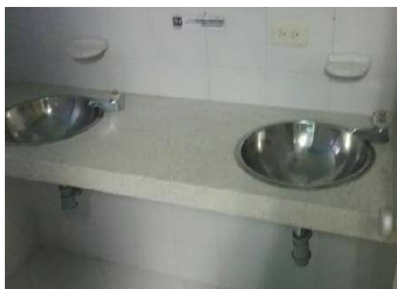
Ilustración 408 Sifón de lavamanos en PVCS de 2". Fuente: equipo de diagnóstico.
