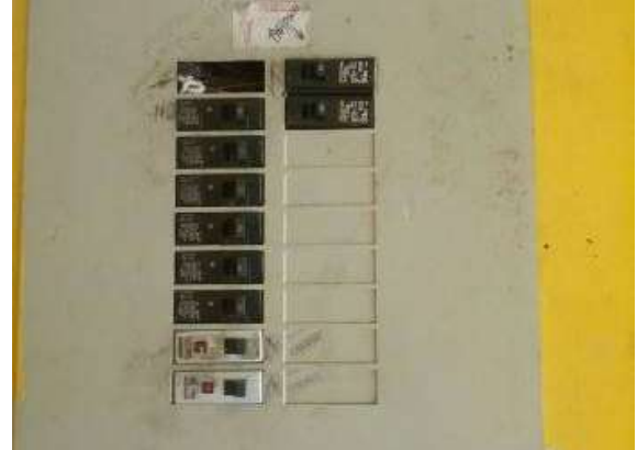
Ilustración 124. Tablero de distribución. Fuente: equipo de diagnóstico.
