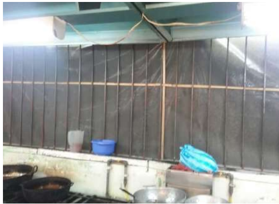
Ilustración 75 iluminación (Conductores eléctricos expuestos). Fuente: equipo de diagnóstico.
