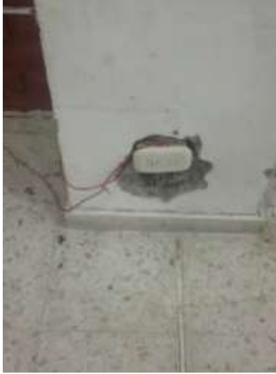
Ilustración 20. Tomacorriente (Conductores expuestos). Fuente: equipo de diagnóstico.
