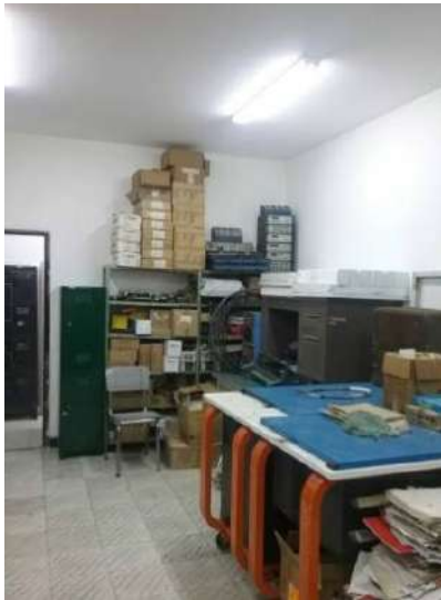
Ilustración 225. Luminarias. Fuente: Equipo diagnóstico.
