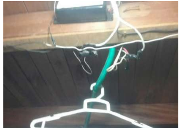
Ilustración 196. Luminarias. Fuente: Equipo diagnóstico.
