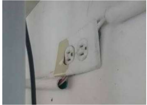
Ilustración 58. Tomacorriente. Fuente: equipo de diagnóstico
