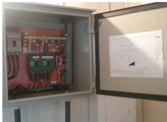
Ilustración 38. Tablero de distribución. Fuente: equipo de diagnóstico.
