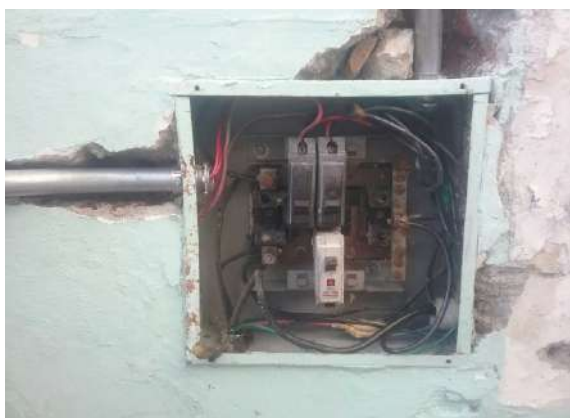
Ilustración 221. Tubería. Fuente Equipo diagnóstico
