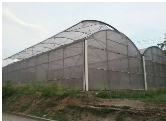
Ilustración 211. . Invernadero sin instalaciones eléctricas. Fuente: Equipo diagnóstico.
