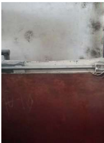
Ilustración 148. Salida para tomacorriente (Conductores eléctricos expuestos). Fuente: equipo de diagnóstico.
