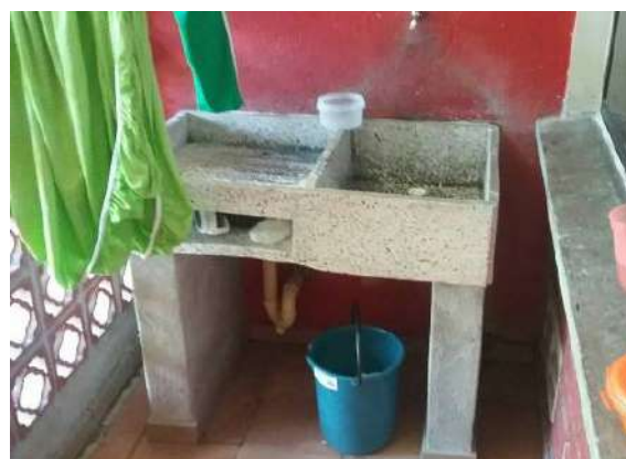
Ilustración 409 Sifón de lavadero en PVCS de 2". Fuente: equipo de diagnóstico.
