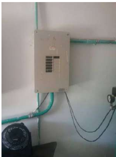
Ilustración 154. Tablero de distribución (Tubería PVC expuesta). Fuente: equipo de diagnóstico
