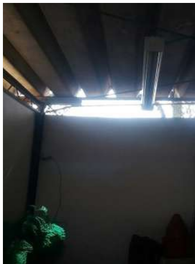
Ilustración 170. Luminarias. Fuente: Equipo diagnóstico
