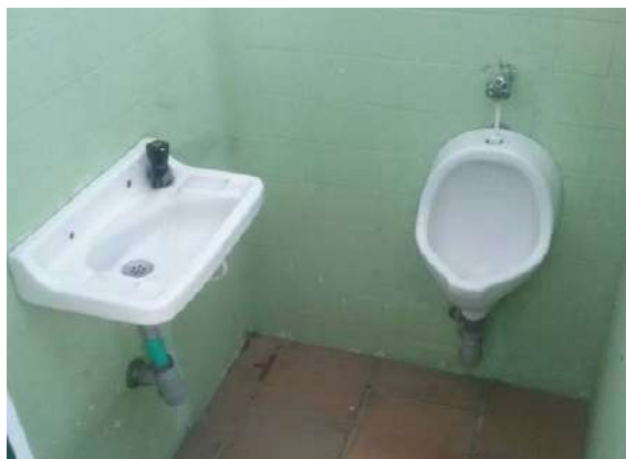
Ilustración 450 Sifón de lavamanos y orinal en PVC de 2". Fuente: equipo de diagnóstico.
