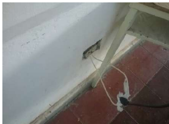
Ilustración 257. Tomacorriente. Fuente: Equipo diagnóstico.
