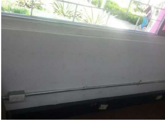
Ilustración 97. Tomacorriente (tubería EMT sin marcar). Fuente: equipo de diagnóstico.
