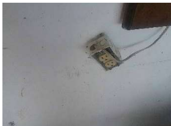
Ilustración 310. Tomacorrientes bloque 64. Fuente: equipo de diagnóstico.
