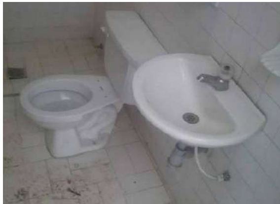
Ilustración 474 Sifón de piso en 3"y Lavamanos en PVCS de 2". Fuente: equipo de diagnóstico.
