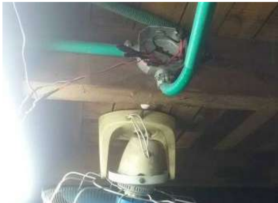
Ilustración 195. Luminarias. Fuente: Equipo diagnóstico.
