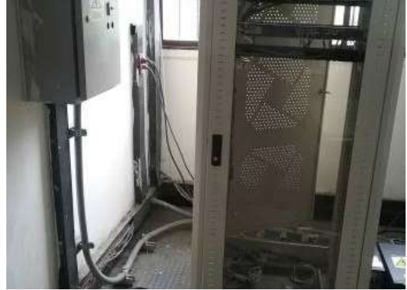
Ilustración 111. Tablero de distribución. Fuente: equipo de diagnóstico.
