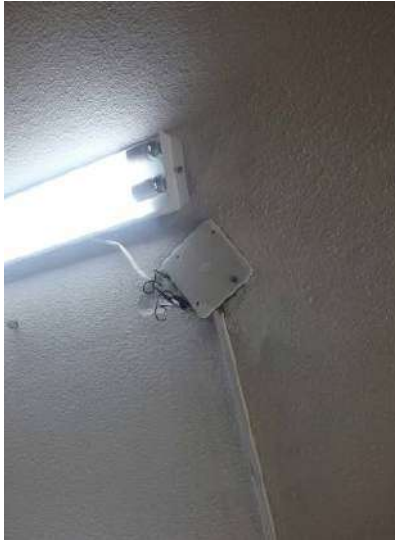
Ilustración 26. Iluminación (Conductores eléctricos expuestos). Fuente: equipo de diagnóstico.
