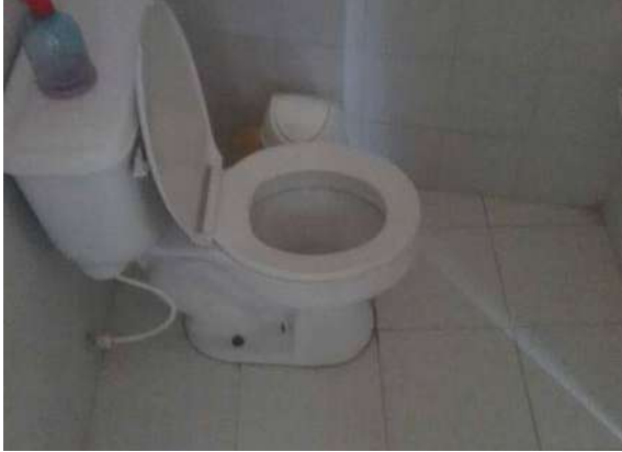
Ilustración 413 desagüe de retrete tipo tanque. Fuente: equipo de diagnóstico.
