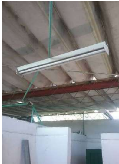
Ilustración 182. Luminarias. Fuente: Equipo diagnóstico.
