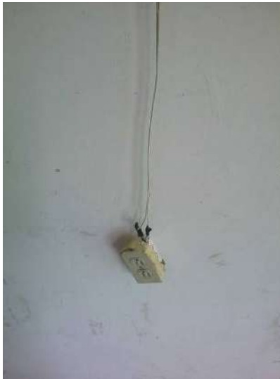
Ilustración 47. Tomacorriente (Suspendido por conductores). Fuente: equipo de diagnóstico.
