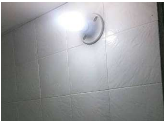
Ilustración 326. Bloque 70. Iluminación. Fuente: equipo de diagnóstico.
