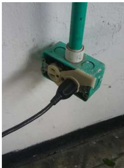
Ilustración 201. Tomacorriente. Fuente: Equipo diagnóstico
