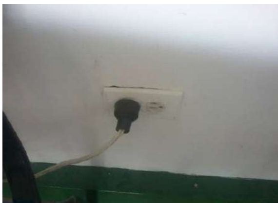
Ilustración 168. Tomacorriente. Fuente. Equipo diagnostico
