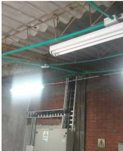
Ilustración 161. Iluminación (Tubería PVC expuesta).
