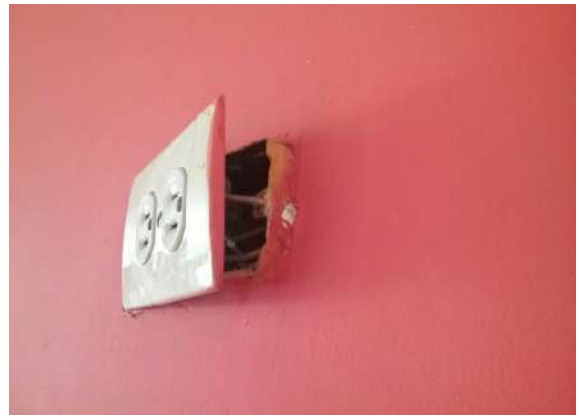
Ilustración 73. Tomacorriente. Fuente: equipo de diagnóstico.
