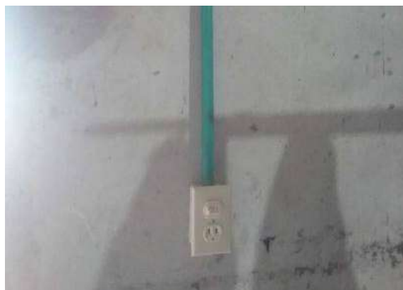
Ilustración 240. Tomacorriente. Fuente: Equipo diagnostico
