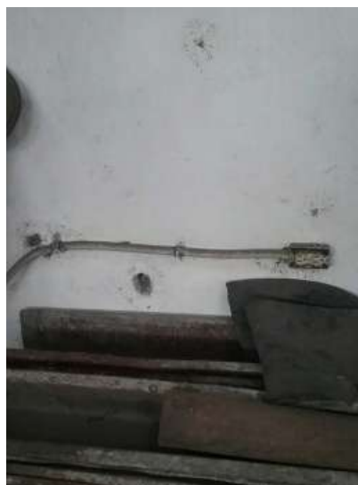
Ilustración 147. Tomacorriente. Fuente: equipo de diagnóstico.
