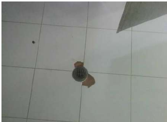
Ilustración 417 Sifón de piso en aluminio de 2". Fuente: equipo de diagnóstico.
