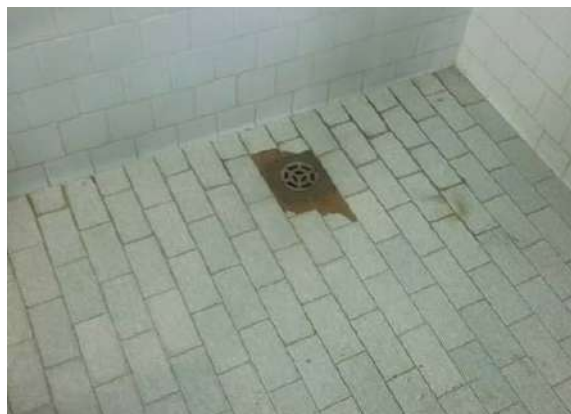
Ilustración 454 Sifón de piso en bronce de 3". Fuente: equipo de diagnóstico.
