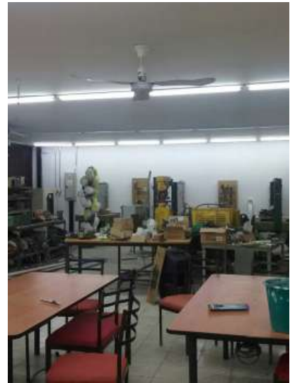
Ilustración 227. Luminarias. Fuente: Equipo diagnóstico.
