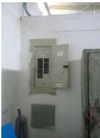
Ilustración 176. Tablero. Fuente: Equipo diagnóstico
