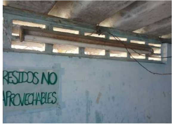
Ilustración 35. Iluminación (Deshabilitada). Fuente: equipo de diagnóstico
