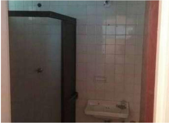
Ilustración 44. Iluminación (Lámpara no instalada). Fuente: equipo de diagnóstico.
