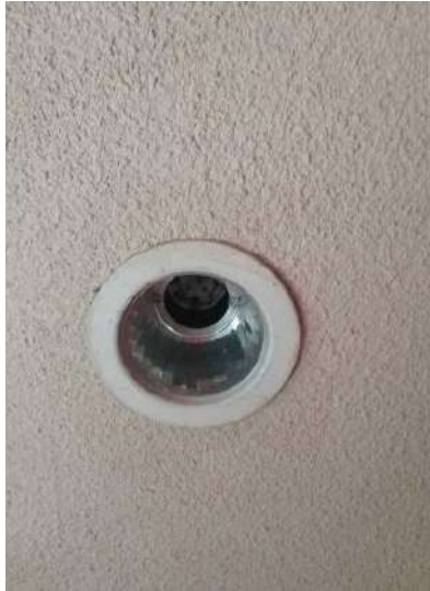
Ilustración 121. Iluminación (Lámpara ausente). Fuente: equipo de diagnóstico
