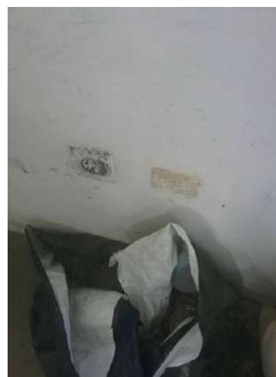
Ilustración 180. Tomacorriente. Fuente: Equipo diagnóstico
