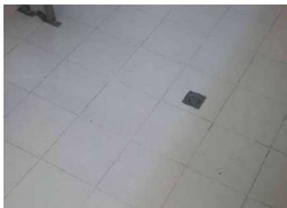
Ilustración 438 Sifón de piso en aluminio de 2". Fuente: equipo de diagnóstico.
