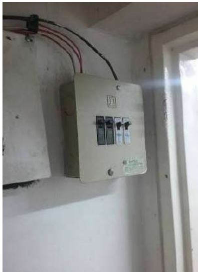
Ilustración 54. Tablero de distribución (conductores eléctricos expuestos). Fuente: equipo de diagnóstico.
