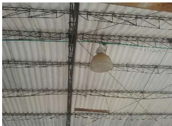
Ilustración 290. Bloque 57. Iluminación. Fuente: equipo de diagnóstico
