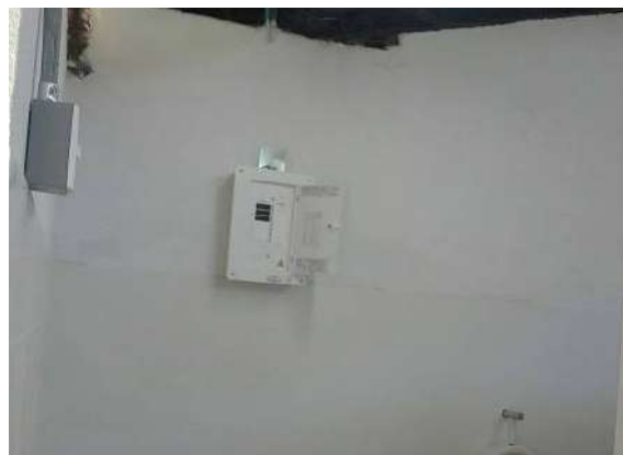
Ilustración 254. Tablero. Fuente: Equipo diagnóstico.
