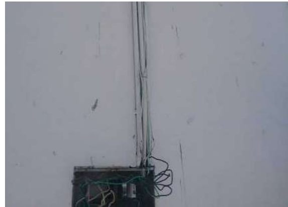
Ilustración 246. Tablero. Fuente: Equipo diagnóstico
