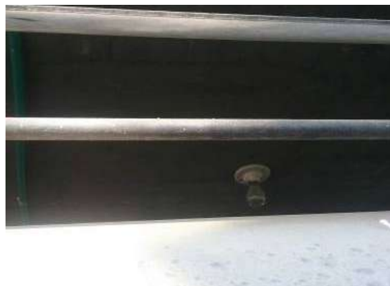
Ilustración 209. Luminarias. Fuente: Equipo diagnóstico.
