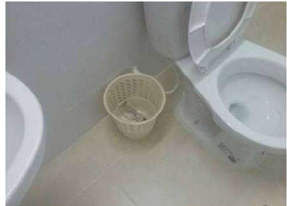
Ilustración 357 Punto hidráulico para retrete. Fuente: equipo de diagnóstico.
