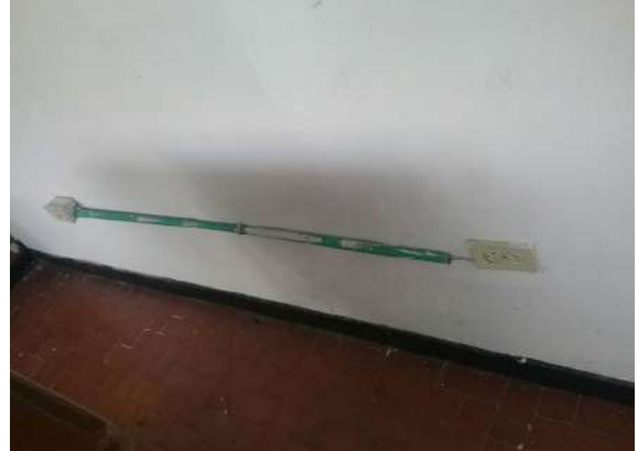
Ilustración 65. Tomacorriente (Tubería PVC expuesta). Fuente: equipo de diagnóstico.
