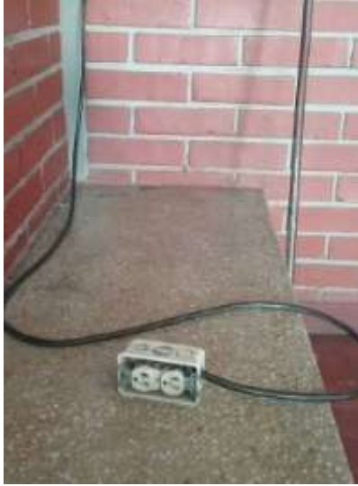
Ilustración 10. Extensión eléctrica. Fuente: equipo de diagnóstico.
