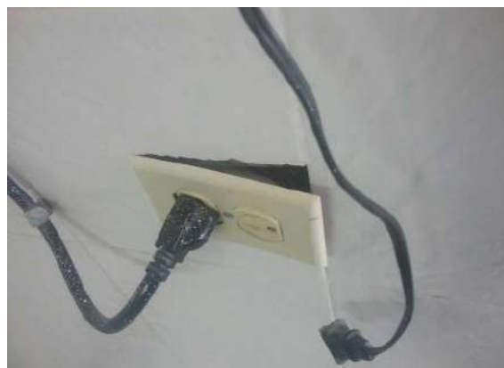
Ilustración 158. Tomacorriente. Fuente: equipo de diagnóstico.
