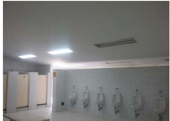
Ilustración 104. Iluminación (lámparas no funcionales). Fuente: equipo de diagnóstico
