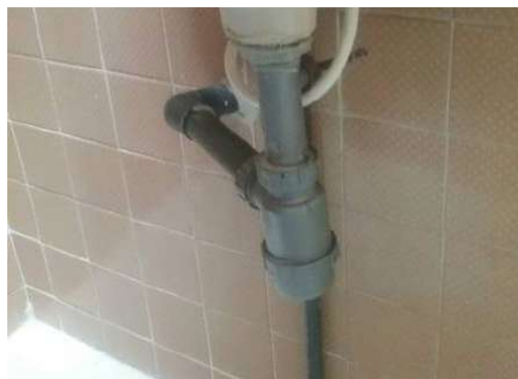
Ilustración 343 Sifón de lavamanos en PVCS de 2". Fuente: equipo de diagnóstico.
