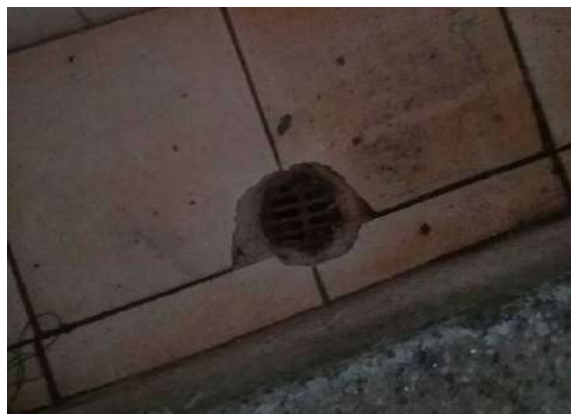
Ilustración 429 Sifón de lavamanos en bronce de 2". Fuente: equipo de diagnóstico
