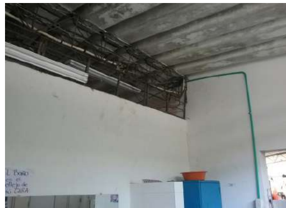
Ilustración 139. Conductores eléctricos expuestos. Fuente: equipo de diagnóstico.
