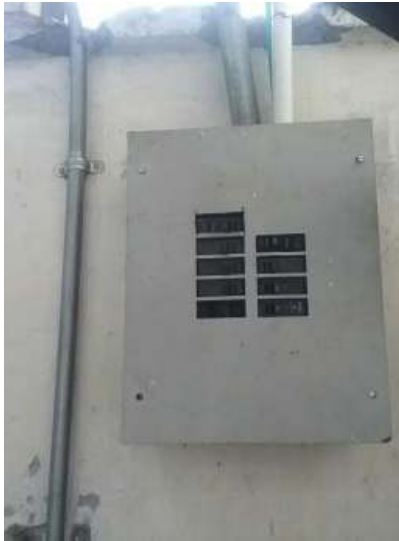
Ilustración 141. Tablero de distribución. Fuente: equipo de diagnóstico.
