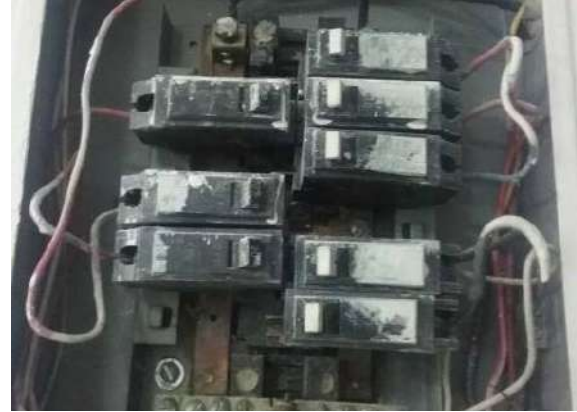
Ilustración 230. Tablero. Fuente: Equipo diagnóstico
