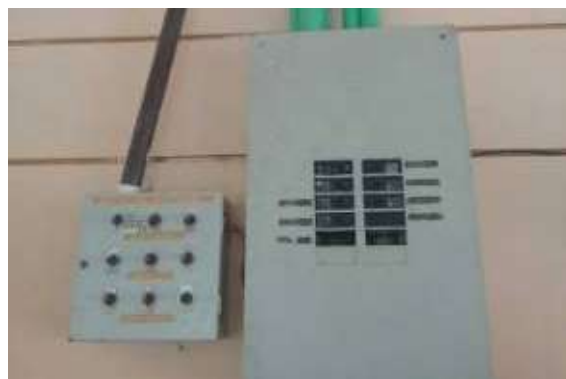
Ilustración 29. Tablero de distribución (Tubería PVC expuesta). Fuente: equipo de diagnóstico.
