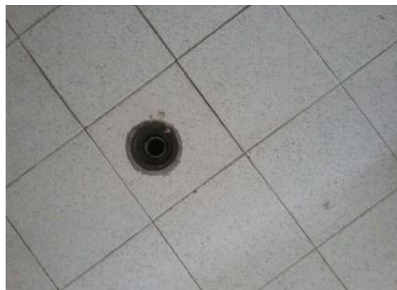
Ilustración 430 sifón de piso de 2". Fuente: equipo de diagnóstico.
