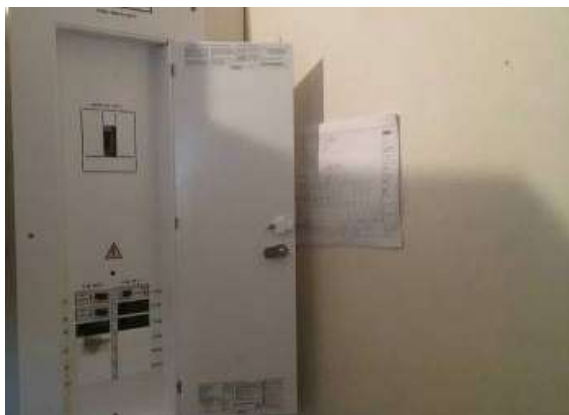
Ilustración 37. Tablero de distribución. Fuente: equipo de diagnóstico.
