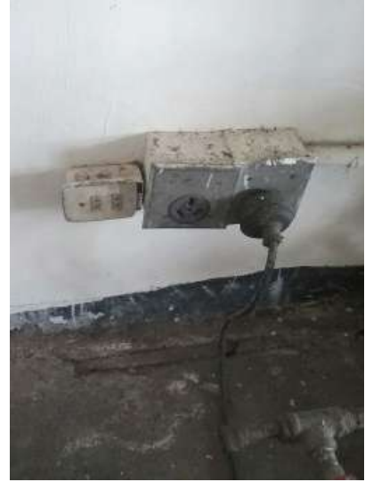
Ilustración 194. Tomacorriente. Fuente: Equipo diagnóstico.
