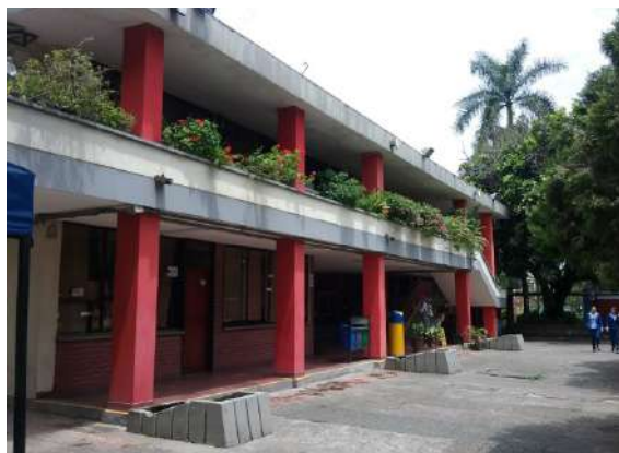
Ilustración 341 Gárgolas y cajas de recolección de aguas lluvias. Fuente: equipo de diagnóstico.
