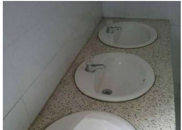
Ilustración 458 Lavamanos tipo llave. Fuente: equipo de diagnóstico.
