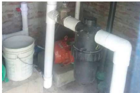
Ilustración 476 Equipo de bombeo para riego. Fuente: equipo de diagnóstico.
