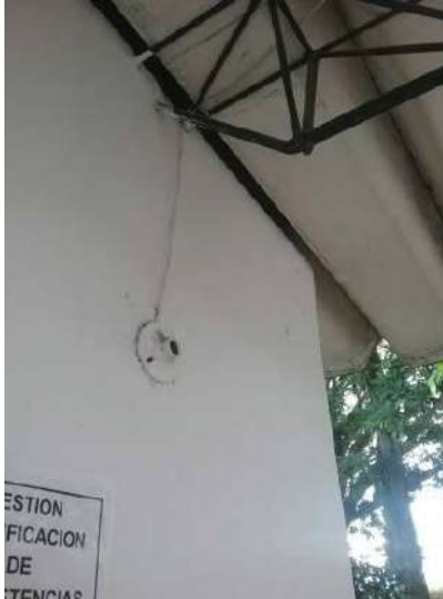
Ilustración 60. Ilustración 61 Iluminación (sin luminaria, conductores eléctricos expuestos).
