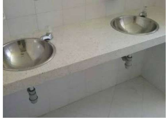
Ilustración 405 Lavamanos tipo llave. Fuente: equipo de diagnóstico.
