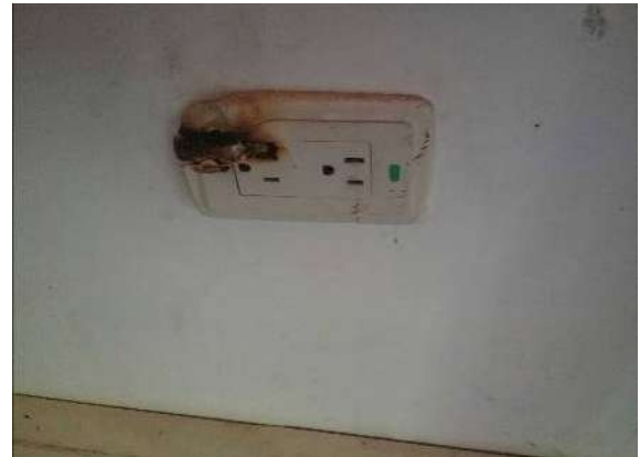
Ilustración 278. Tomacorriente bloque 50. Fuente: equipo de diagnóstico.
