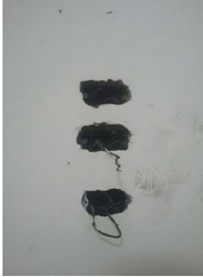
Ilustración 22. Salidas tomacorrientes. Fuente: equipo de diagnóstico.
