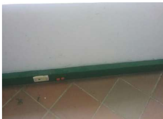
Ilustración 169. Tomacorriente. Fuente: Equipo diagnostico
