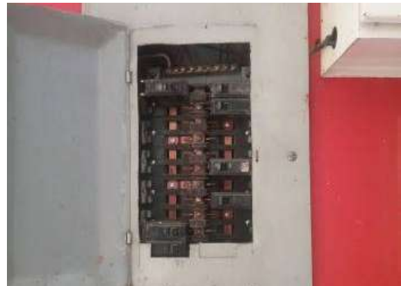
Ilustración 8. Tablero de distribución (Partes energizadas expuestas).
