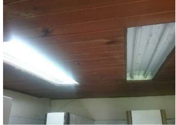
Ilustración 312. Iluminación bloque 64. Fuente: equipo de diagnóstico
