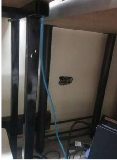
Ilustración 11. Salida para tomacorriente. Fuente: equipo de diagnóstico.
