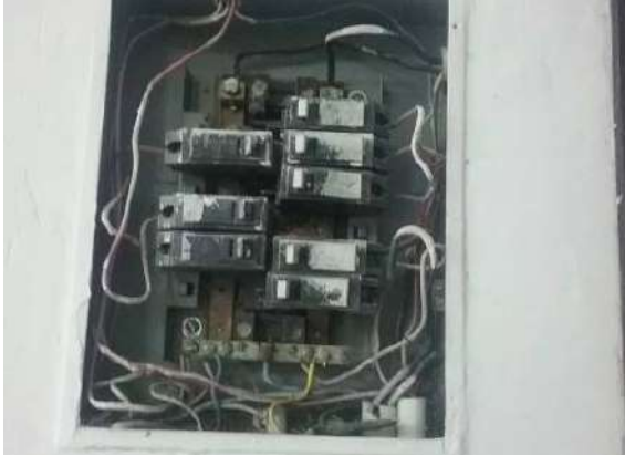
Ilustración 229. Tablero. Fuente: Equipo diagnóstico
