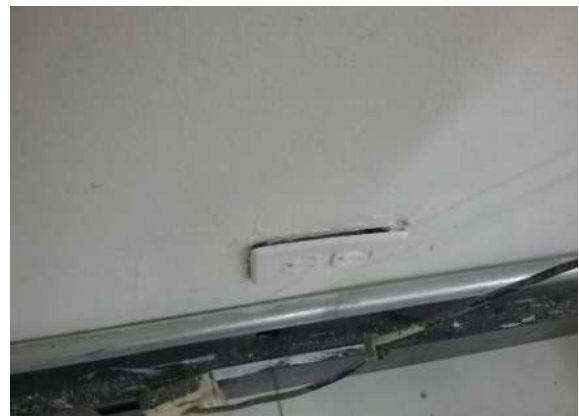
Ilustración 91. Tomacorriente. Fuente: equipo de diagnóstico.
