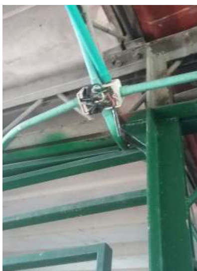
Ilustración 179. Conductores. Fuente: Equipo diagnóstico
