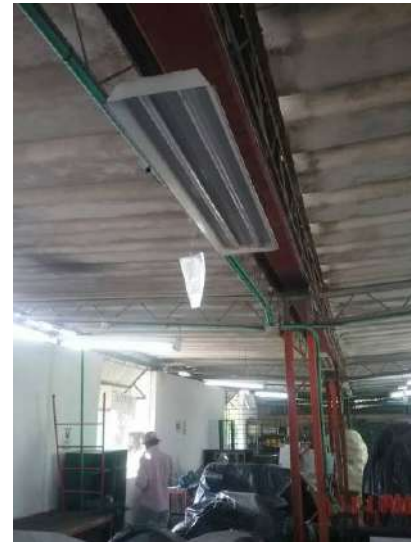
Ilustración 183. Luminarias. Fuente: Equipo diagnóstico.
