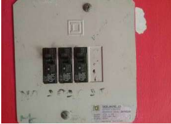
Ilustración 116. Tablero de distribución. Fuente: equipo de diagnóstico.
