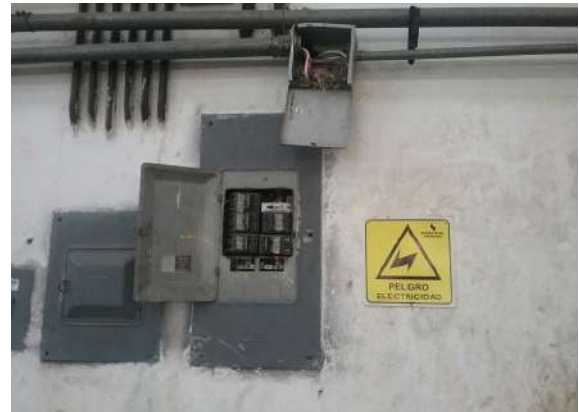
Ilustración 145. Caja de paso (conductores eléctricos expuestos). Fuente: equipo de diagnóstico
