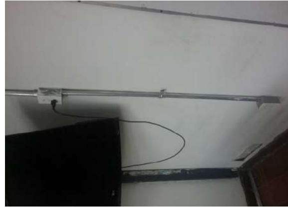
Ilustración 98. Tomacorriente (tubería EMT sin marcar). Fuente: equipo de diagnóstico.
