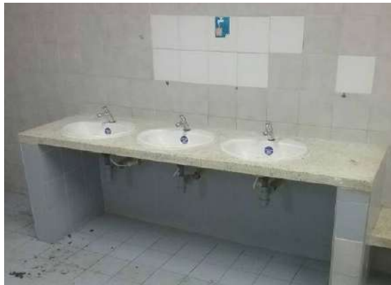
Ilustración 403 Sifón de piso, lavamanos y caja de inspección. Fuente: equipo de diagnóstico.
