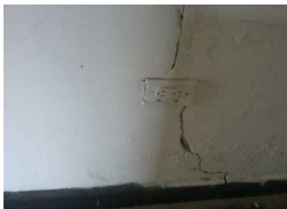
Ilustración 309. Tomacorrientes bloque 64. Fuente: equipo de diagnóstico.
