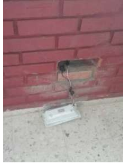
Ilustración 23. Tomacorriente (Desprendida de pared). Fuente: equipo de diagnóstico.
