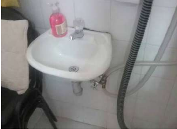
Ilustración 410 Lavamanos tipo llave. Fuente: equipo de diagnóstico.
