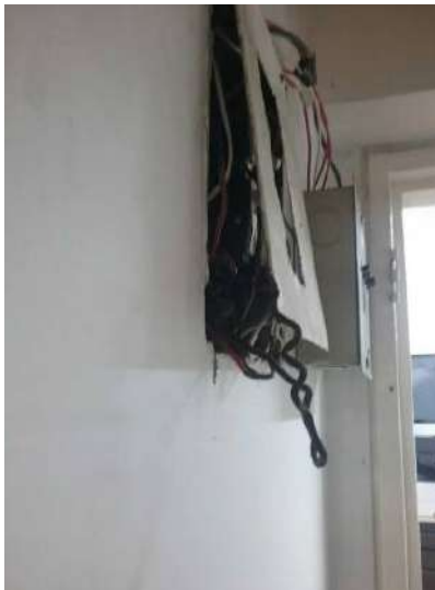
Ilustración 55. Tablero de distribución (conductores eléctricos expuestos). Fuente: equipo de diagnóstico.
