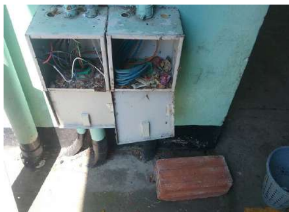
Ilustración 222. Tablero. Fuente equipo diagnóstico
