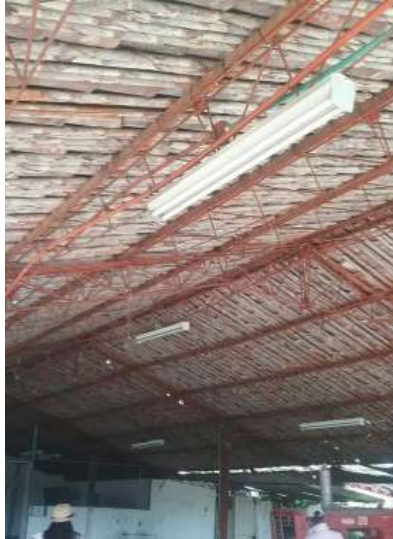
Ilustración 205. Luminarias. Fuente: Equipo diagnóstico.
