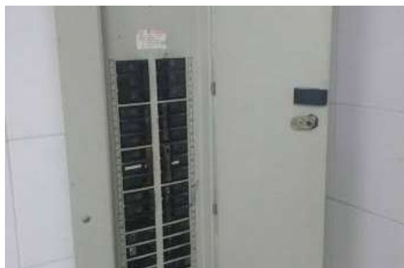
Ilustración 28. Tablero de distribución. Fuente: equipo de diagnóstico.
