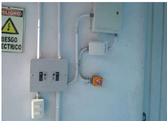
Ilustración 263. Tablero. Equipo diagnóstico
