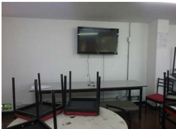
Ilustración 90. Tomacorriente (tubería EMT sin marcar). Fuente: equipo de diagnóstico.
