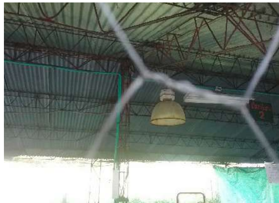
Ilustración 270. Iluminación bloque 47. Fuente: equipo de diagnóstico.
