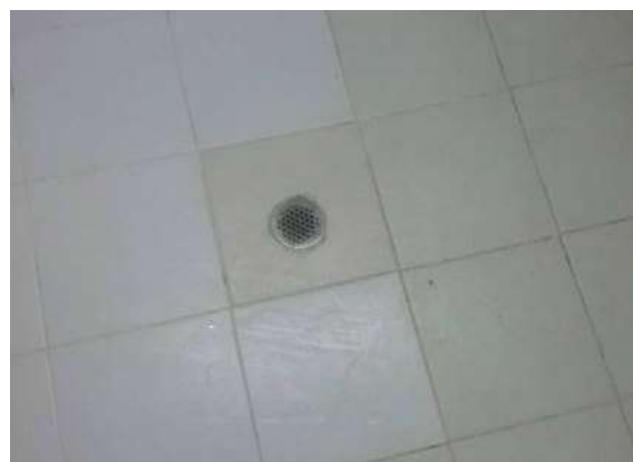
Ilustración 439 Sifón de piso en aluminio de 3". Fuente: equipo de diagnóstico.
