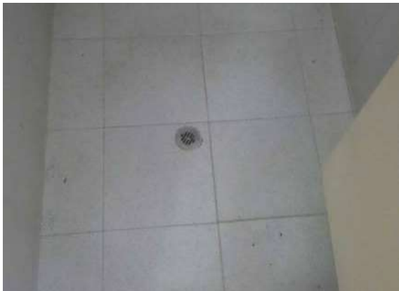
Ilustración 393 Sifón de piso en aluminio de 2". Fuente: equipo de diagnóstico.
