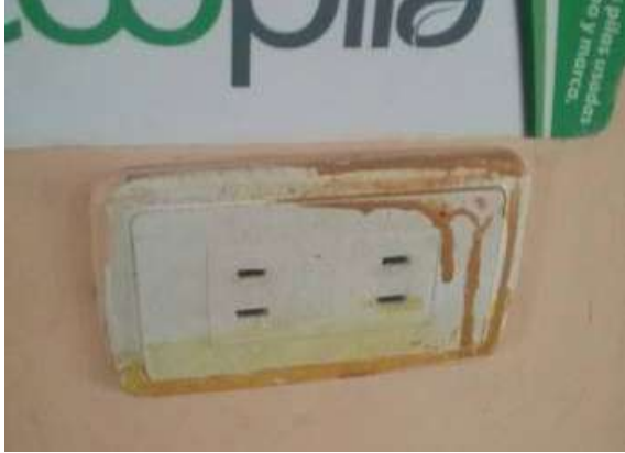
Ilustración 30. Tomacorriente (Tubería PVC expuesta). Fuente: equipo de diagnóstico.
