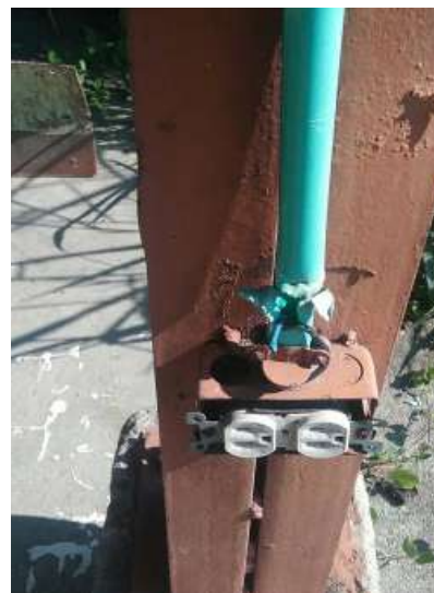
Ilustración 203. Tomacorriente. Fuente: Equipo diagnóstico
