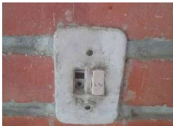
Ilustración 289. Bloque 57. Iluminación. Fuente: equipo de diagnóstico.
