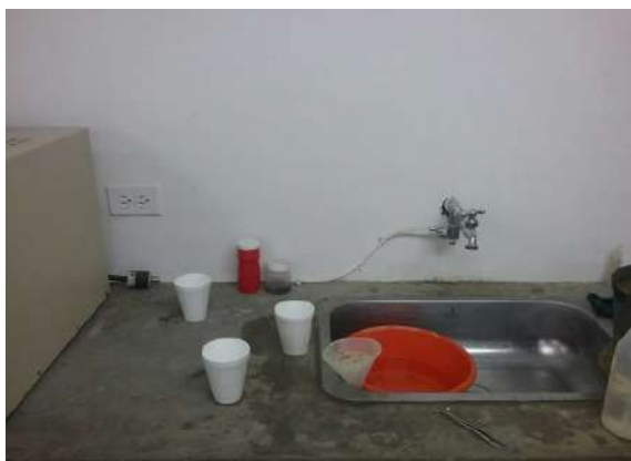
Ilustración 256. Tomacorriente. Fuente: Equipo diagnóstico
