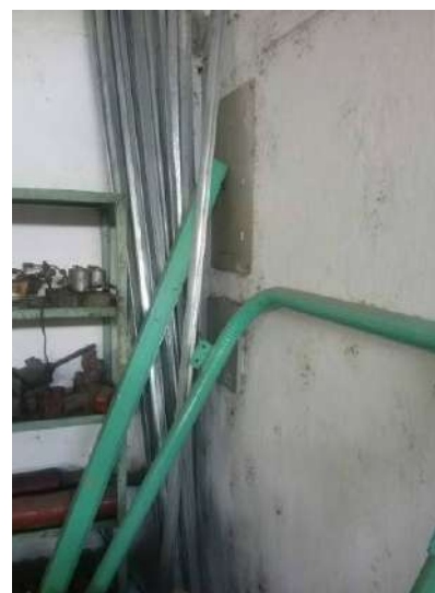
Ilustración 177. Tablero. Fuente: Equipo diagnóstico
