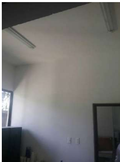
Ilustración 218. Luminarias. Fuente equipo diagnostico
