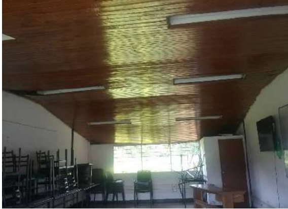
Ilustración 311. Iluminación bloque 64. Fuente: equipo de diagnóstico
