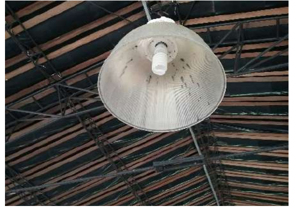
Ilustración 305. Iluminación. Bloque 63. Fuente: equipo de diagnóstico.
