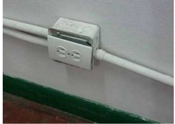
Ilustración 31. Tomacorriente (sin puesta a tierra). Fuente: equipo de diagnóstico.
