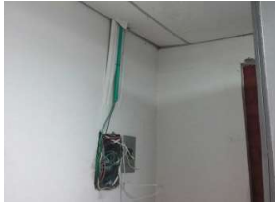
Ilustración 129 Tableros de distribución (Conductores eléctricos expuestos). Fuente: equipo de diagnóstico.
