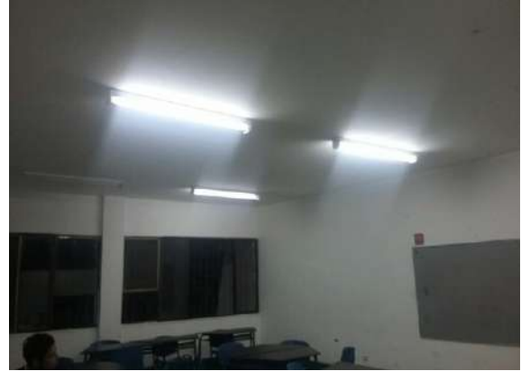
Ilustración 234. Luminarias. Fuente: Equipo diagnóstico.
