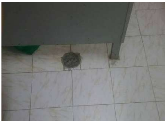
Ilustración 342 Sifón de piso en aluminio de 3". Fuente: equipo de diagnóstico.
