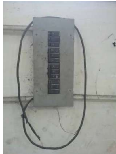
Ilustración 143 Tablero de distribución (conductores eléctricos expuestos). Fuente: equipo de diagnóstico
