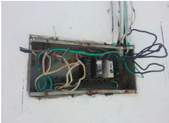
Ilustración 245. Tablero. Fuente: Equipo diagnóstico
