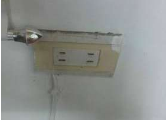
Ilustración 39. Tomacorriente (conductores expuestos, sin puesta a tierra). Fuente: equipo de diagnóstico.
