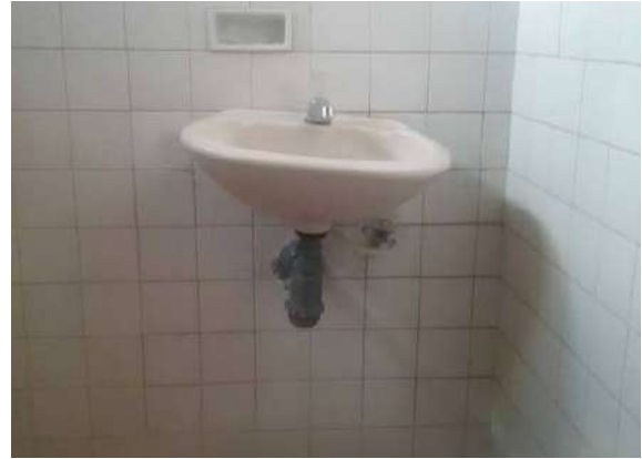
Ilustración 375 Sifón de lavamanos en PVC en 2". Fuente: equipo de diagnóstico.
