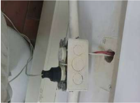
Ilustración 57. Tomacorriente. Fuente: equipo de diagnóstico
