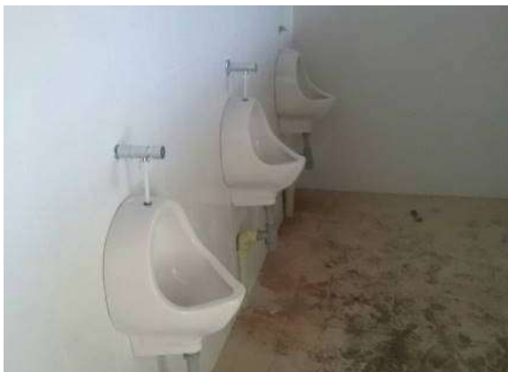
Ilustración 486 Sifón de Orinal en PVC de 2". Fuente: equipo de diagnóstico.
