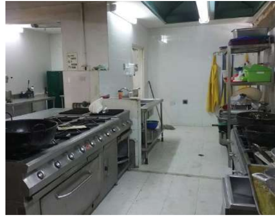
Ilustración 73. Espacio No.2. Fuente: Equipo de diagnóstico.
