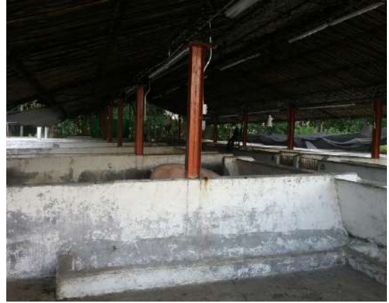
Ilustración 304. Espacio No.1. Fuente. Equipo de diagnóstico.
