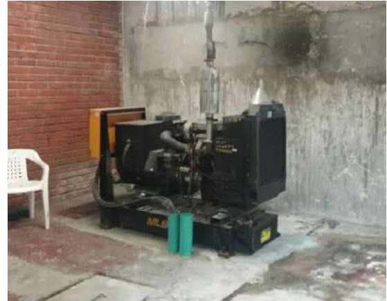
Ilustración 175. Espacio 47. Fuente: Equipo diagnóstico
