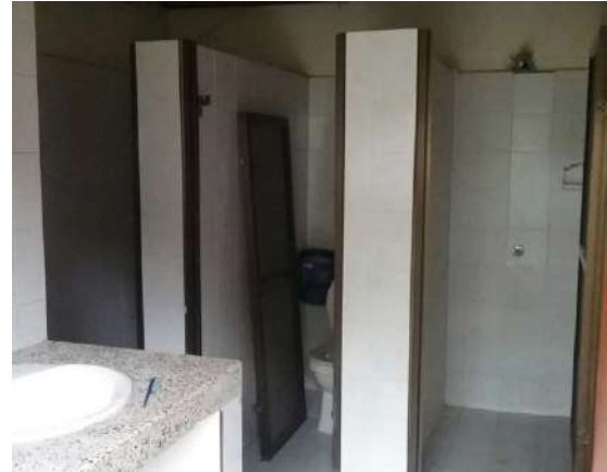
Ilustración 384. Espacio 9. Fuente: Equipo diagnóstico.
