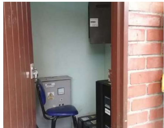
Ilustración 141. Espacio 9. Fuente: Equipo diagnóstico.
