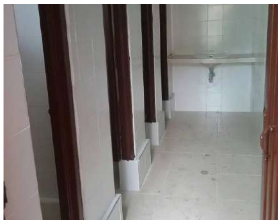
Ilustración 119. Espacio No. 9. Fuente: Equipo de diagnóstico.
