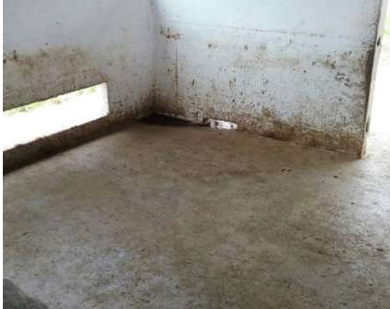
Ilustración 389. Espacio No.1. Fuente. Equipo de diagnóstico.
