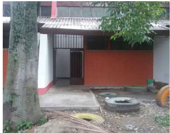
Ilustración 7 Problemática general de accesibilidad Fuente: equipo diagnóstico
