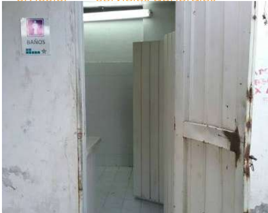
Ilustración 215. Espacio No.4. Fuente. Equipo de diagnóstico.
