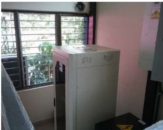
Ilustración 33. Espacio No.15. Fuente. Equipo de diagnóstico.
