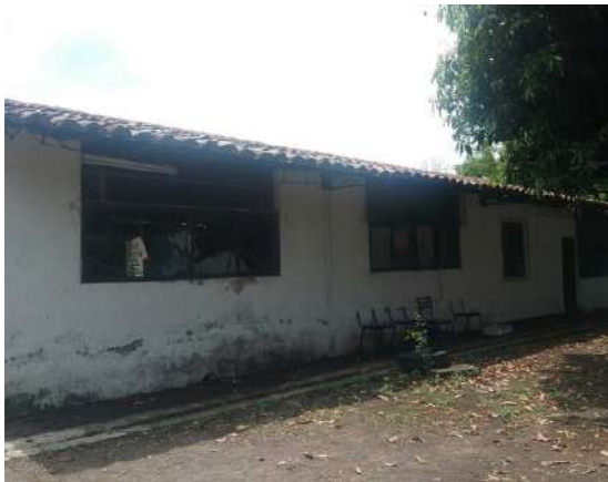
Ilustración 6. Problemática general de accesibilidad Fuente. Equipo de diagnóstico.
