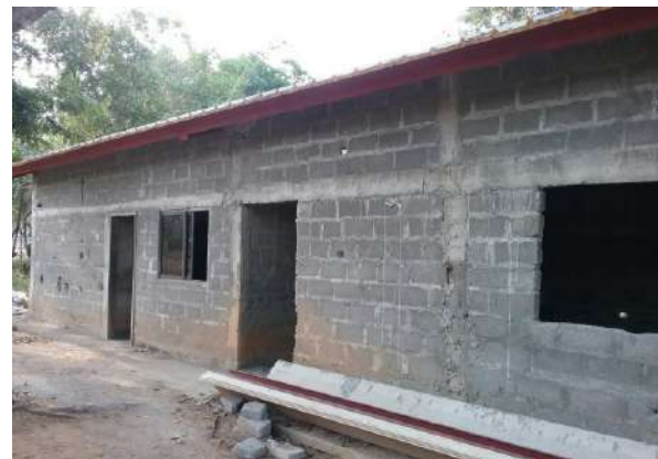
Ilustración 393. Fachadas Bloque 38. Fuente: Equipo de diagnóstico
