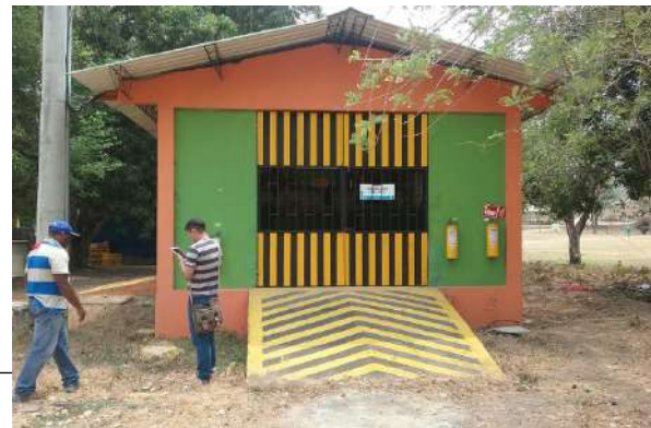
Ilustración 376. Fachadas Bloque 34. Fuente: equipo de diagnóstico
