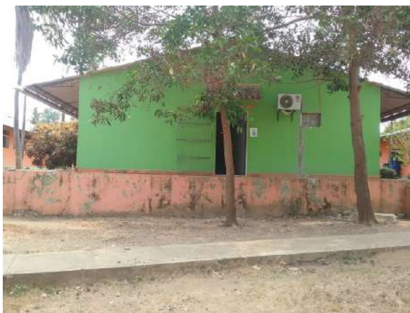
Ilustración 206. Fachadas Bloque 3 Fuente: Equipo de diagnóstico
