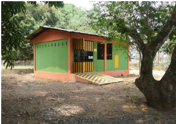
Ilustración 375. Fachadas Bloque 34. Fuente: equipo de diagnóstico
