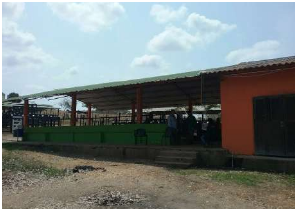
Ilustración 292. Fachadas Bloque 18 Fuente: Equipo de diagnóstico
