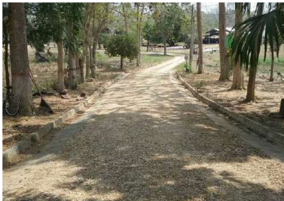
Ilustración 400. Exterior 15. Fuente: Equipo de diagnóstico.
