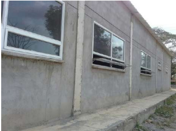
Ilustración 281. Fachadas Bloque 16. Fuente: Equipo de diagnóstico
