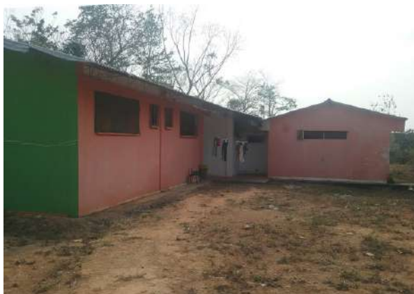
Ilustración 325. Fachadas Bloque 24. Fuente: Equipo de diagnóstico
