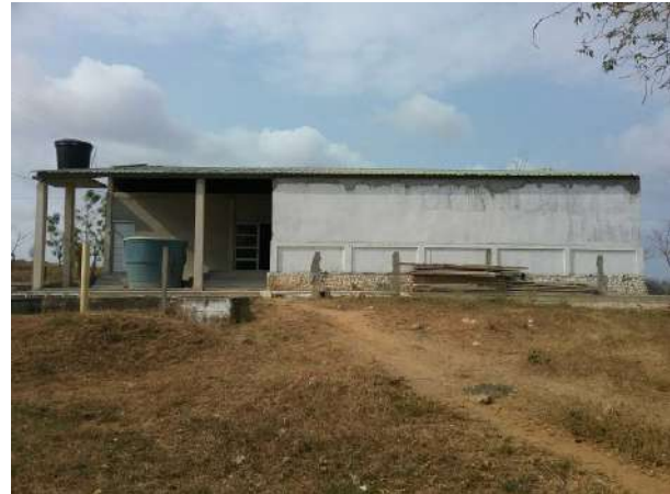
Ilustración 282. Fachadas Bloque 16. Fuente: Equipo de diagnóstico
