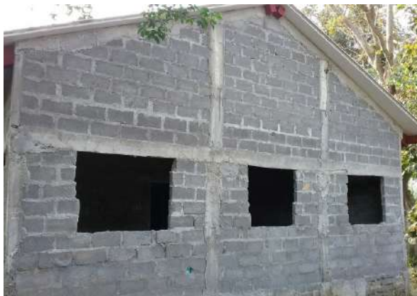
Ilustración 392. Fachadas Bloque 38. Fuente: Equipo de diagnóstico
