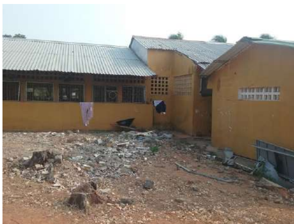
Ilustración 196. Fachadas Bloque 1. Fuente: Equipo de diagnóstico
