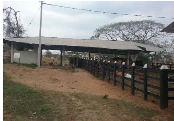
Ilustración 293. Fachadas Bloque 18. Fuente: Equipo de diagnóstico
