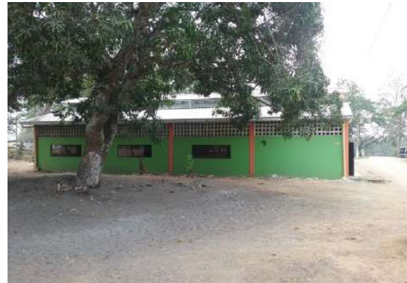
Ilustración 381. Fachadas Bloque 35. Fuente: Equipo de diagnóstico
