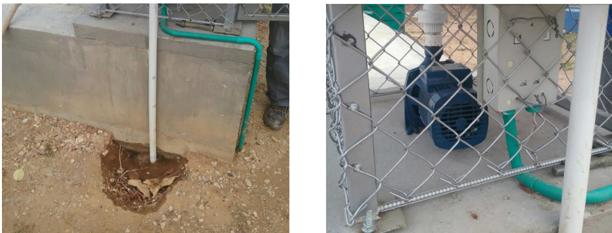
Ilustración 156. Bomba centrífuga para PTAP. Bloque 29. Fuente: Equipo de diagnóstico
