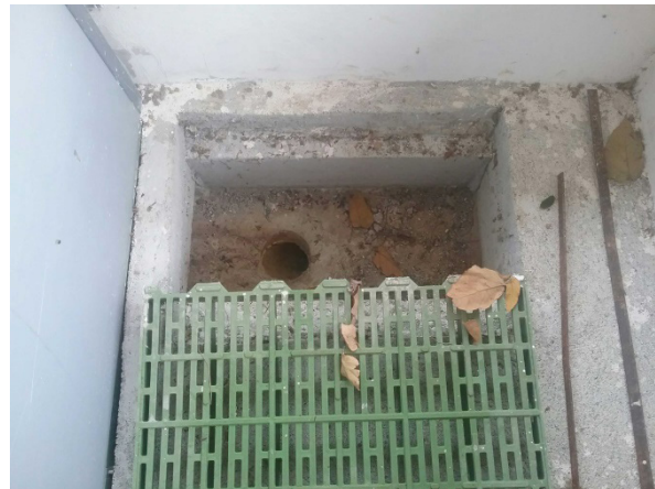
Ilustración 153 . Sumideros y tanque biodigestor. Bloque 28. Fuente: Equipo de diagnóstico
