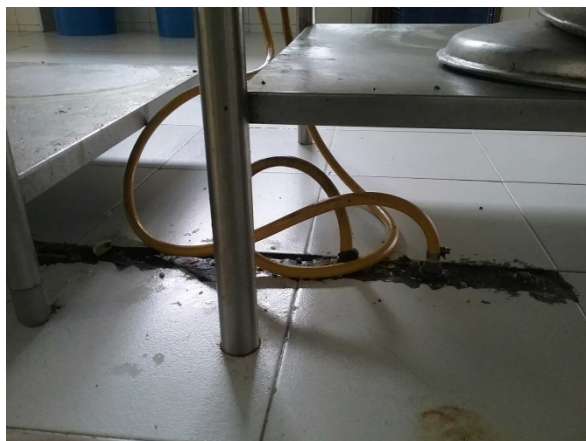
Ilustración 148 Cilindros e instalaciones de gas. Bloque 26. Fuente: Equipo de diagnóstico
