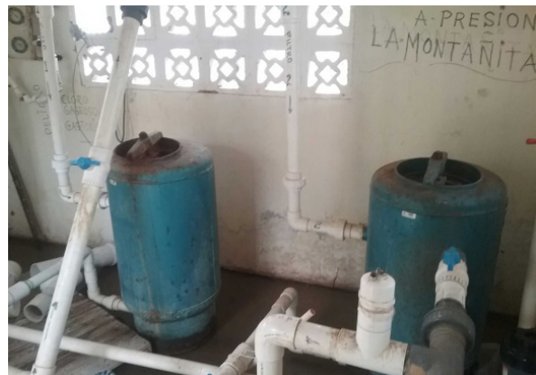
Ilustración 170. Bomba y tuberías. Exterior 9. Fuente: Equipo de diagnóstico
