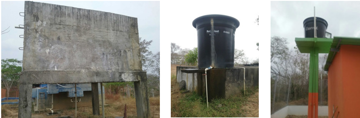
Ilustración 155. Tanques elevados PTAP antigua y nueva. Bloque 29. Fuente: Equipo de diagnóstico
