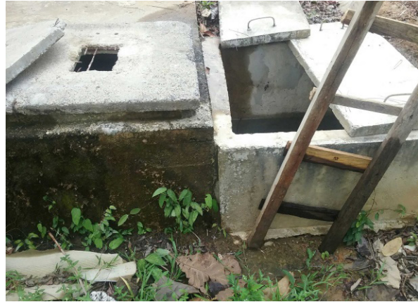
Ilustración 169. Tanque subterráneo. Exterior 9. Fuente: Equipo de diagnóstico
