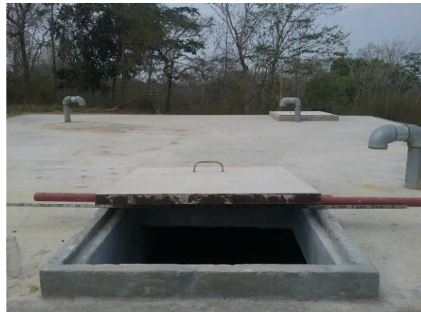
Ilustración 154. Tanques subterráneos PTAP antigua y nueva. Bloque 29. Fuente: Equipo de diagnóstico
