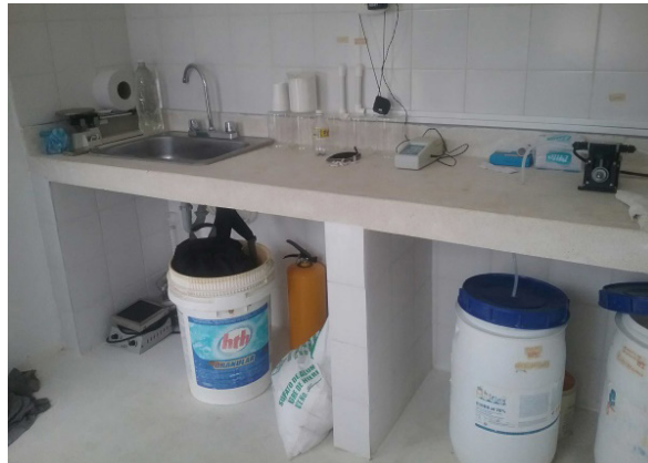
Ilustración 157. Instalaciones interiores caseta de la PTAP. Bloque 29. Fuente: Equipo de diagnóstico
