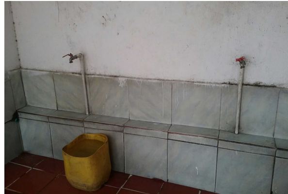
Ilustración 147. Puntos hidráulicos defectuosos y en tubería a la vista. Bloque 26. Fuente: Equipo de diagnóstico
