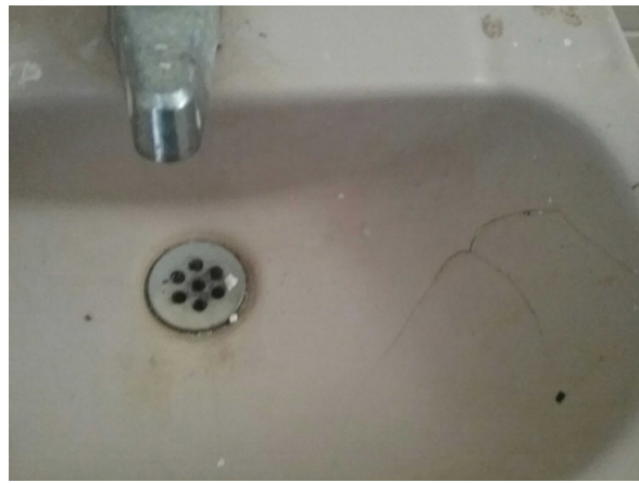
Ilustración 150. Aparatos sanitarios deteriorados. Bloque 27. Fuente: Equipo de diagnóstico
