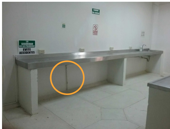
Ilustración 123. Puntos hidráulicos mal instalados. Bloque 15. Fuente: Equipo de diagnóstico
