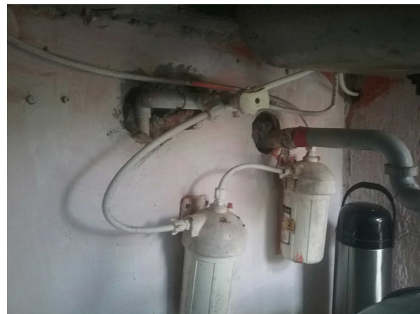
Ilustración 111. Válvula de control de espacio e instalaciones interiores. Bloque 5 Fuente: Equipo de diagnóstico
