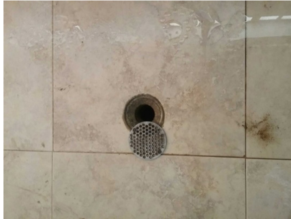
Ilustración 110. Desagüe de piso con rejilla dañada. Bloque 4 Fuente: Equipo de diagnóstico
