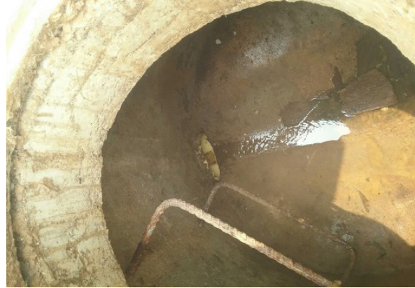
Ilustración 95. Pozo de inspección de la red interna de alcantarillado. Fuente: Equipo de diagnóstico
