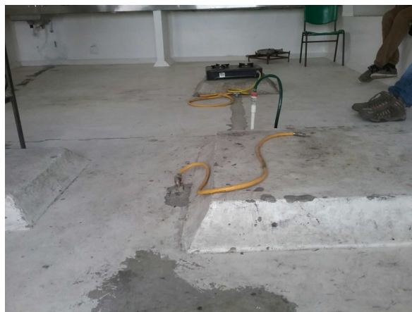
Ilustración 127. Nicho de cilindros e instalaciones de gas. Bloque 15. Fuente: Equipo de diagnóstico
