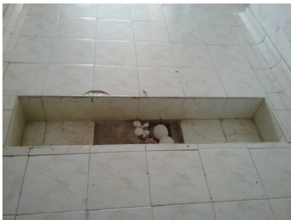
Ilustración 125. Desagües tipo sumidero sin rejilla. Bloque 15. Fuente: Equipo de diagnóstico
