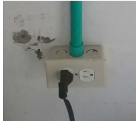
Ilustración 86 tomacorrientes Bloque 35. Fuente: equipo diagnóstico.
