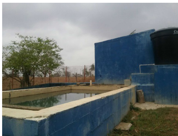
Ilustración 98. Filtro de grava y tanque desarenador PTAP antigua. Fuente: Equipo de diagnóstico
