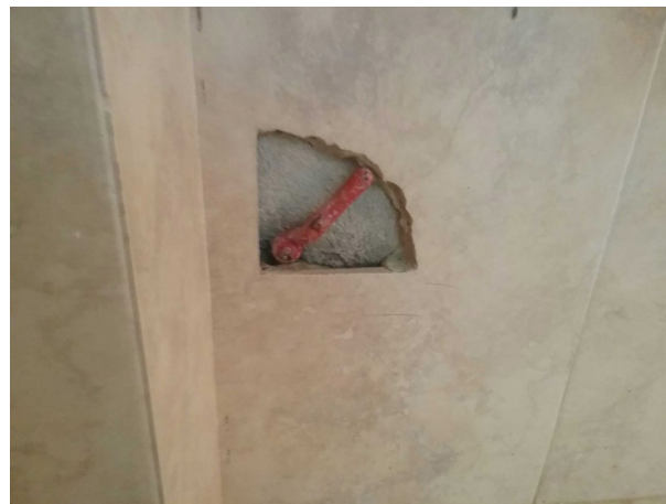
Ilustración 108 Válvula tipo bola para control de espacio. Bloque 4. Fuente: Equipo de diagnóstico.
