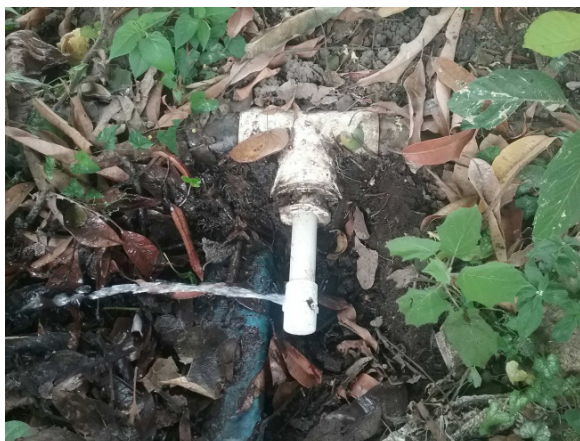
Ilustración 100. Red de agua potable a la vista y deteriorada. Fuente: Equipo de diagnóstico
