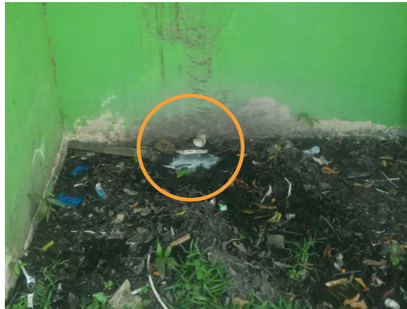
Ilustración 112. Salida de aguas negras de la cocina. Bloque 5 Fuente: Equipo de diagnóstico
