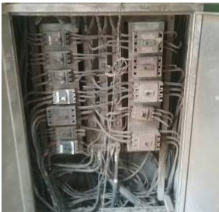
Ilustración 80. Tablero General de Acometidas Fuente: equipo diagnóstico.
