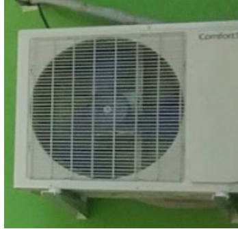
Ilustración 49. Condensadora Bloque 20. Fuente: equipo diagnóstico.
