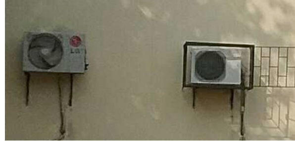
Ilustración 39. Aire acondicionado Bloque 15. Fuente: equipo diagnóstico.
