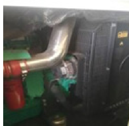
Ilustración 3. Planta Eléctrica. Fuente: equipo diagnóstico.
