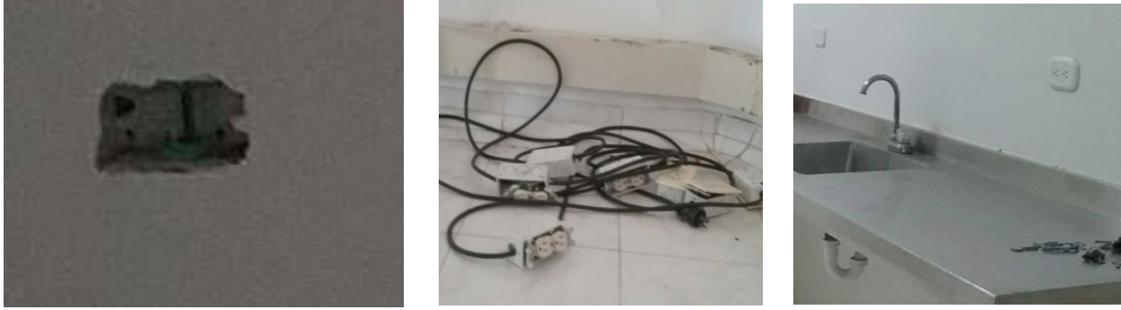
Ilustración 36. Tomacorrientes Bloque 15. Fuente: equipo diagnóstico.
