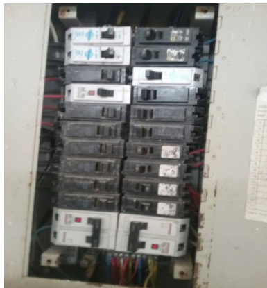
Ilustración 81. Tablero de distribución. Fuente: equipo diagnóstico.
