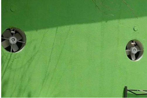
Ilustración 48. Extractores Bloque 20. Fuente: equipo diagnóstico.
