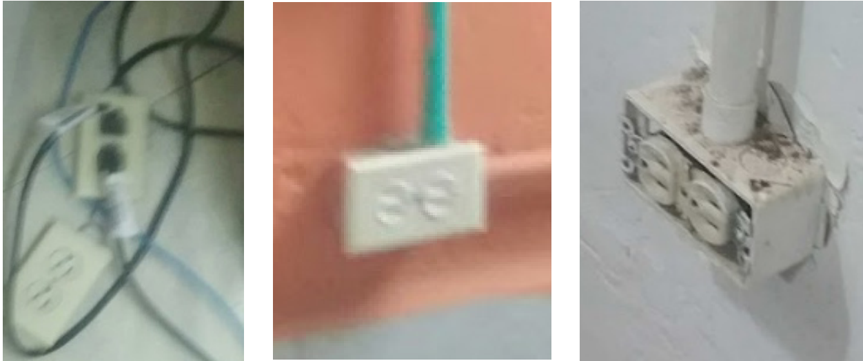
Ilustración 63. Tomacorrientes Bloque 26. Fuente: equipo diagnóstico.
