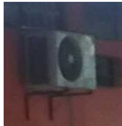
Ilustración 61. Aire acondicionado Bloque 25. Fuente: equipo diagnóstico.
