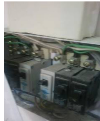
Ilustración 82. Tablero de distribución. Fuente: equipo diagnóstico.
