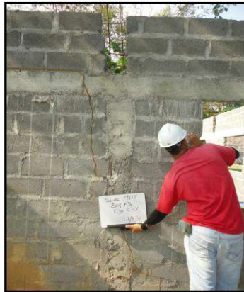
VIGAS Y COLUMNETAS CON HORMIGUEO DEBIDO AL MAL VACIADO DEL CONCRETO, MUROS TOTALMENTE DESPLOMADOS JUNTO CON LOS ELEMENTOS ESTRUCTURALES. LAS COLUMNETAS NO ESTÁN TERMINADAS EN SU TOTALIDAD
