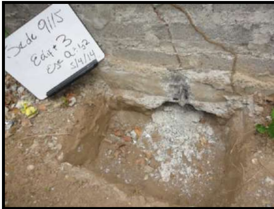
MUROS EN MUY MAL ESTADO, FISURADOS EN SU TOTALIDAD JUNTO CON LAS COLUMNETAS Y VIGAS.
