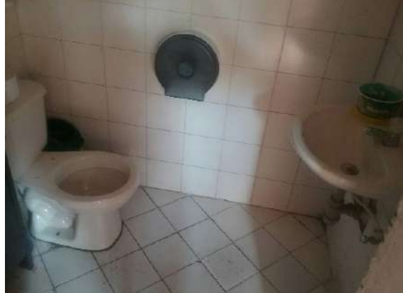
Ilustración 5. Puntos hidráulicos funcionan de manera correcta. Fuente: Equipo de Diagnostico.
