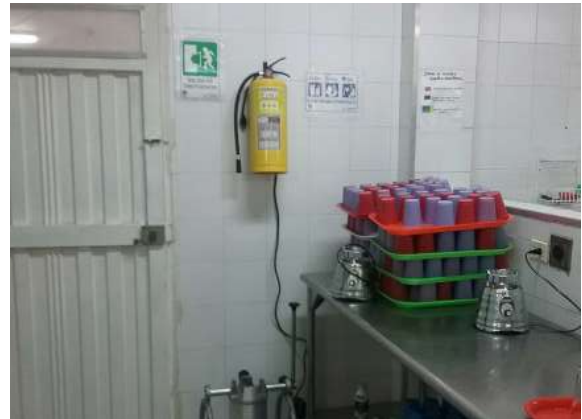
Ilustración 46. Bloque 5. Espacio cocina. Extintor multipropósito. Fuente: Equipo de Diagnostico.
