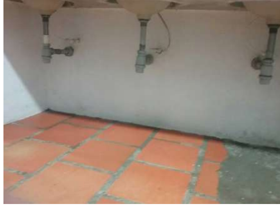
Ilustración 107. Bloque 12. Acoples de puntos hidráulicos en buen estado. Fuente: Equipo de Diagnostico.
