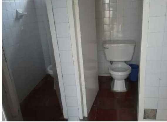
Ilustración 118. Bloque 13. Salidas sanitarias funcionan de manera correcta. Fuente: Equipo de Diagnóstico.
