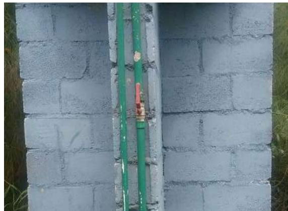
Ilustración 204. Bloque 24. Válvula de control en mal estado. Fuente: Equipo de diagnóstico.
