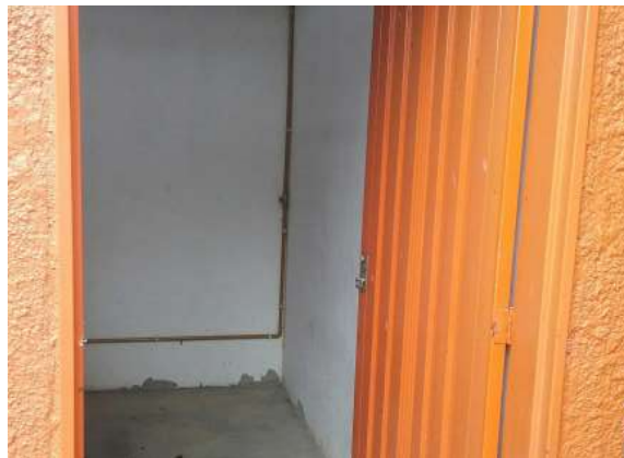
Ilustración 480. Bloque 93. Instalación de gas en tubería de cobre de 3/8". Fuente: Equipo de diagnóstico.
