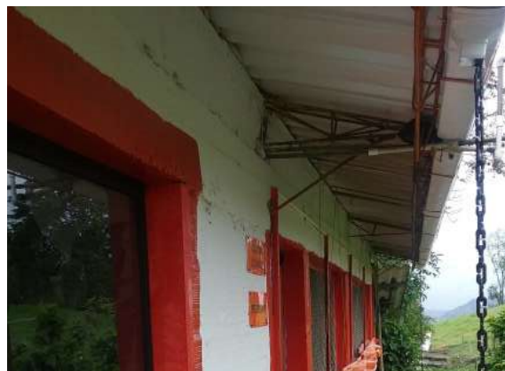
Ilustración 406. Bloque 71. Canaletas y cadenas plásticas para manejo de aguas lluvia. Fuente: Equipo de diagnóstico.
