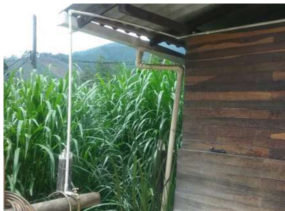
Ilustración 278. Bloque 41. Tubería a la vista en pvcp de 1/2" Fuente: Equipo de diagnóstico.
