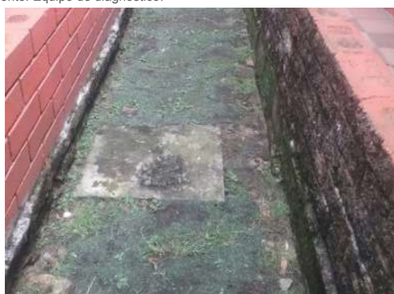
Ilustración 229. Caja de inspección de las cuatro cabañas. Fuente: Equipo de diagnóstico.
