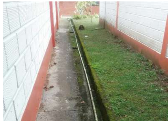
Ilustración 73. Tuberías en pvcp de \frac{1}{2} " a la vista en malas condiciones. Fuente: Equipo de Diagnóstico.
