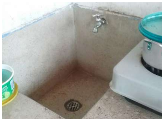
Ilustración 416. Bloque 72. Instalaciones interiores funcionan de manera correcta. Fuente: Equipo de diagnóstico.
