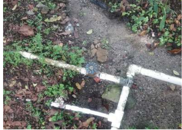
Ilustración 75. Bloque 9. Válvulas de control en mal estado. Fuente: Equipo de Diagnostico.
