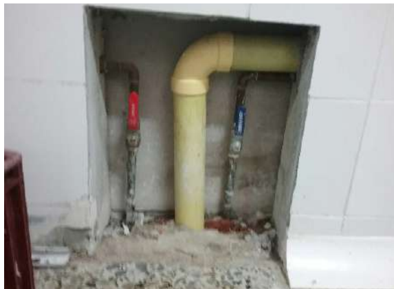
Ilustración 21. Bloque 5. Válvulas de control de agua. Fuente: Equipo de Diagnóstico.
