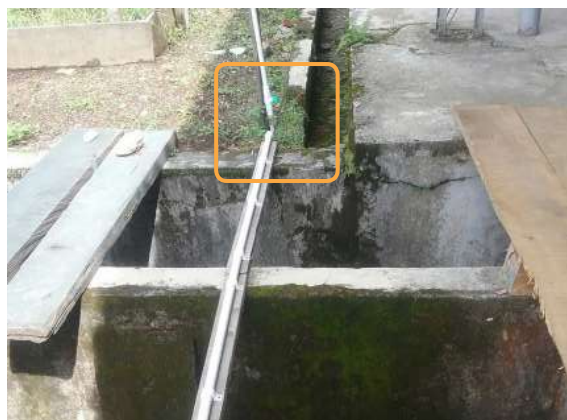
Ilustración 297. Bloque 44. Válvula de control del suministro de agua. Fuente: Equipo de diagnóstico.
