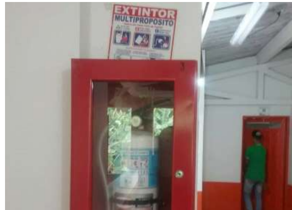
Ilustración 109. Bloque 12. Extintor multipropósito tipo ABC. Fuente: Equipo de Diagnostico.
