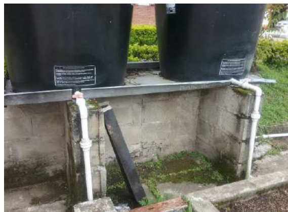
Ilustración 357. Bloque 59. Tubería pvc en mal estado. Fuente: Equipo de diagnóstico.
