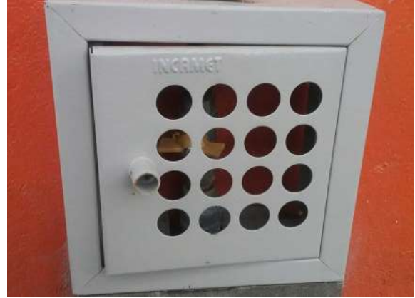
Ilustración 158. Bloque 17. Válvula de control de suministro de gas. Fuente: Equipo de Diagnostico.
