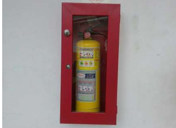
Ilustración 68. Bloque 7. Extintor multipropósito descargado. Fuente: Equipo de Diagnóstico.
