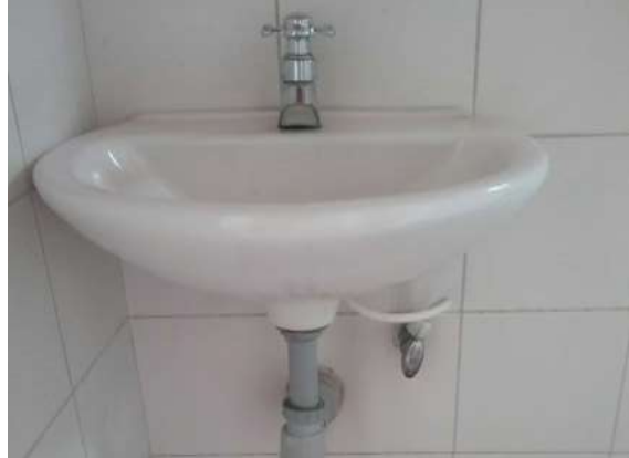
Ilustración 114. Bloque 13. Instalaciones funcionando de manera correcta. Fuente: Equipo de Diagnóstico.
