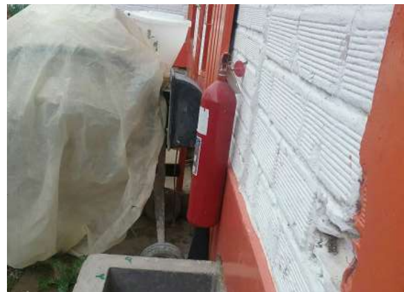
Ilustración 425. Bloque 76. Extintor tipo Co2. Fuente: Equipo de diagnóstico.
