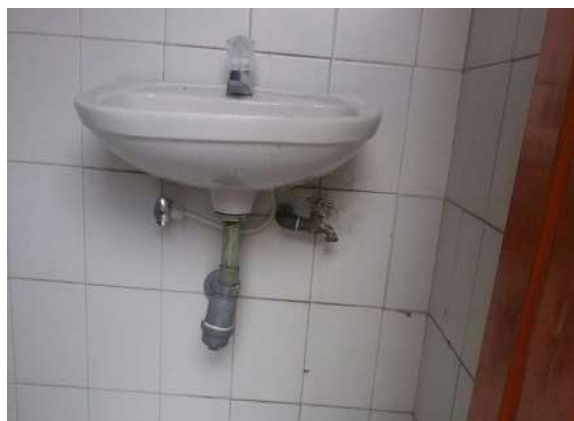
Ilustración 256. Bloque 37. Instalaciones en tubería pvcp de 1/2". Fuente: Equipo de diagnóstico.
