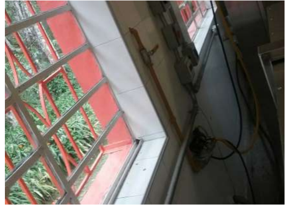
Ilustración 147. Bloque 16. Instalaciones de equipos de panadería. Fuente: Equipo de Diagnostico.
