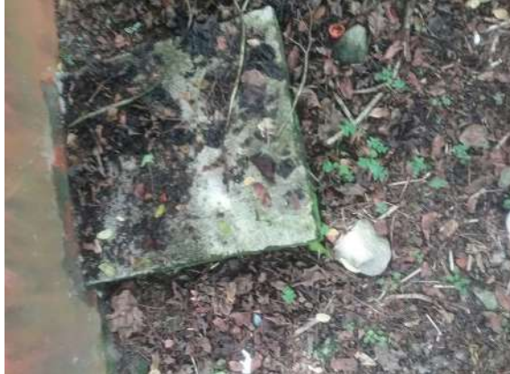
Ilustración 125. Bloque 14. Caja de inspección de aguas negras. Fuente: Equipo de Diagnóstico.
