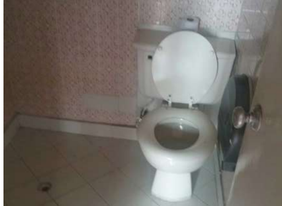
Ilustración 168. Bloque 19. Salida sanitaria de retrete en tubería pvc's de 4". Fuente: Equipo de diagnóstico.
