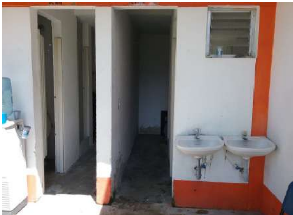
Ilustración 524. Bloque 102. Desagües en tubería pvc's de 2". Fuente: Equipo de diagnóstico.
