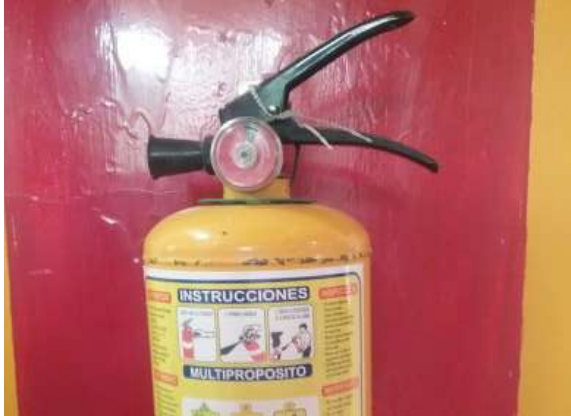
Ilustración 49. Bloque 5. Pasillo piso 3. Extintor multipropósito descargado. Fuente: Equipo de Diagnostico.
