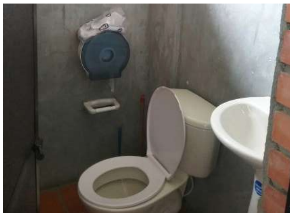
Ilustración 313. Bloque 47. Instalaciones funcionando correctamente. Fuente: Equipo de diagnóstico.
