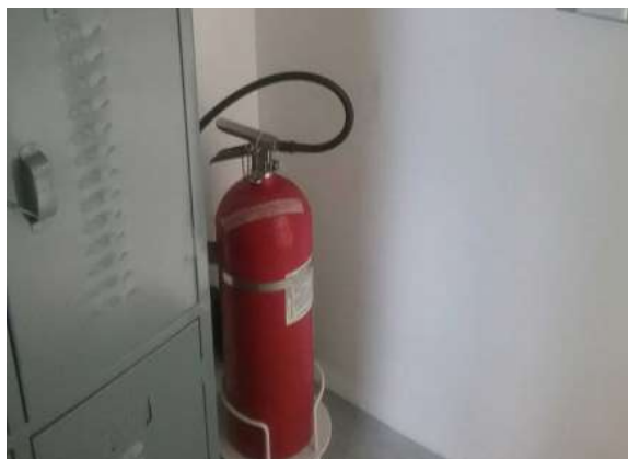
Ilustración 291. Bloque 42. Extintor tipo Co2. Fuente: Equipo de diagnóstico.
