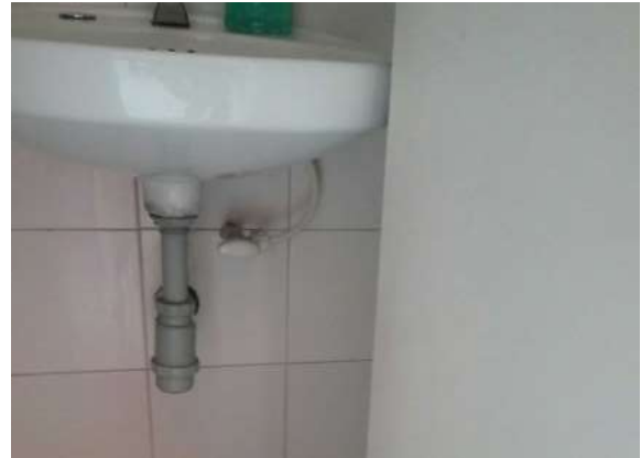
Ilustración 65. Bloque 7. Puntos hidráulicos funcionan de manera correcta. Fuente: Equipo de Diagnostico.
