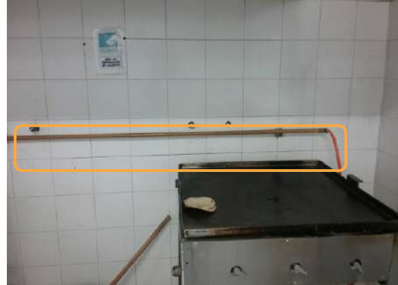
Ilustración 54. Bloque 5. Espacio cocina, restaurante. Instalaciones de gas. Fuente: Equipo de Diagnostico.
