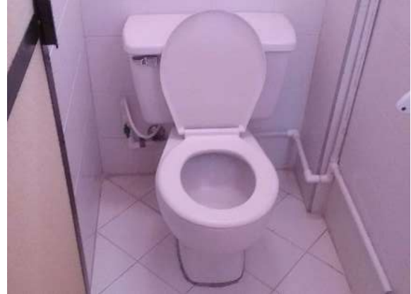
Ilustración 24. Bloque 5. Tubería pvcp de 1/2" a la vista. Fuente: Equipo de Diagnostico.
