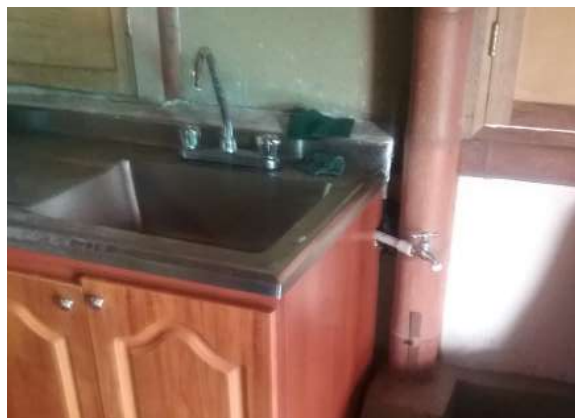
Ilustración 222. Bloque 28. Salida hidráulica improvisada. Fuente: Equipo de diagnóstico.
