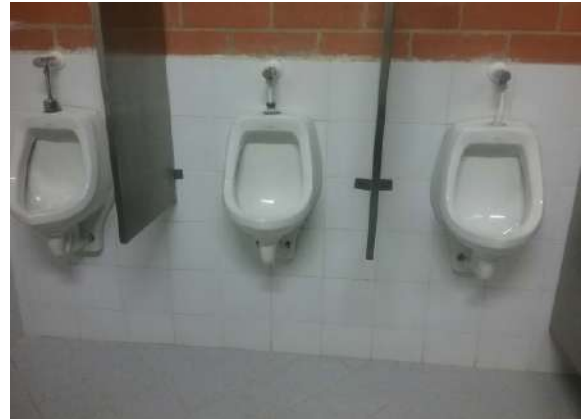
Ilustración 102. Bloque 12. Instalaciones interiores funcionan de manera correcta. Fuente: Equipo de Diagnostico.
