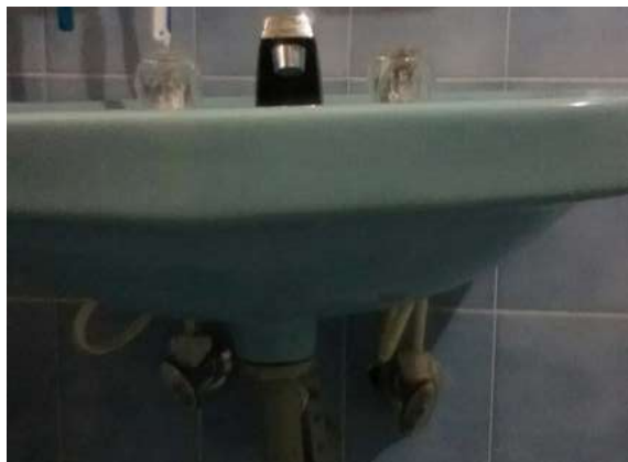
Ilustración 451. Bloque 85. Tubería pvcp de 1/2", incrustada en pared Fuente: Equipo de diagnóstico.
