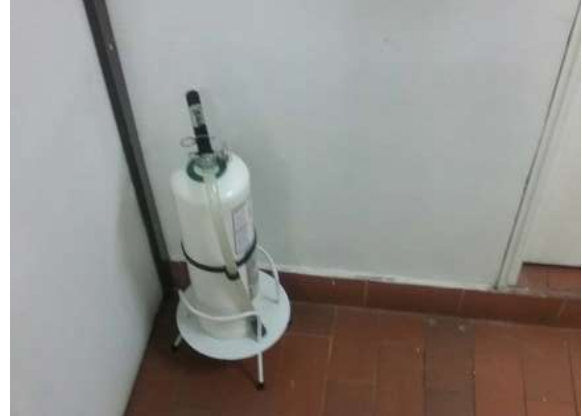
Ilustración 187. Bloque 20. Extintor tipo solkaflam. Fuente: Equipo de Diagnóstico.
