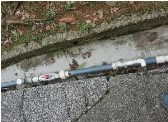
Ilustración 27. Bloque 5. Tubería pvcp de 1" a la vista. Fuente: Equipo de Diagnostico.
