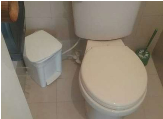
Ilustración 289. Bloque 42. Salida sanitaria de 4". Fuente: Equipo de diagnóstico.
