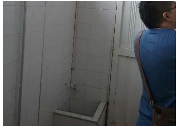
Ilustración 28. Bloque 5. Tubería pvcp de 1/2" a la vista. Fuente: Equipo de Diagnostico.
