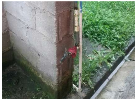
Ilustración 403. Bloque 71. Instalaciones en mal estado. Fuente: Equipo de diagnóstico.
