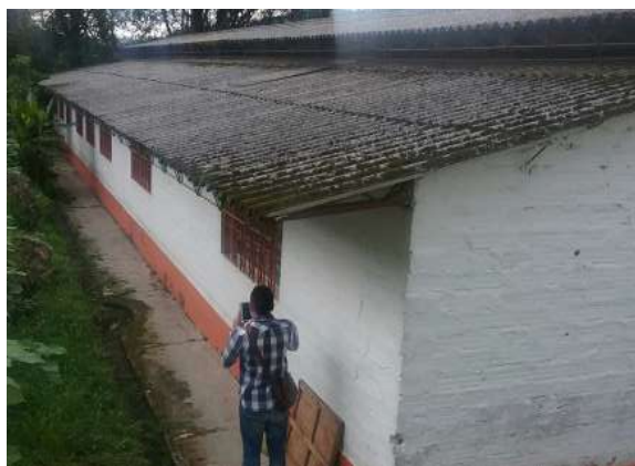
Ilustración 247. Bloque 35. Cubierta sin canaletas de aguas lluvia. Fuente: Equipo de diagnóstico.
