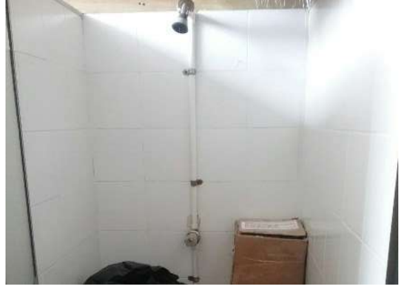
Ilustración 30. Bloque 5. Tubería pvcp de 1/2" a la vista. Fuente: Equipo de Diagnostico.
