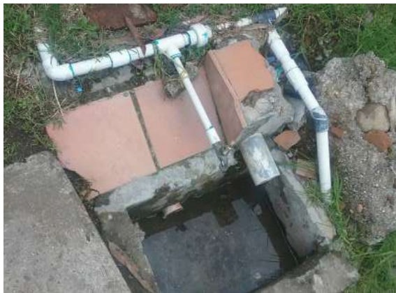
Ilustración 215. Bloque 26. Punto hidráulico en mal estado. Fuente: Equipo de diagnóstico.
