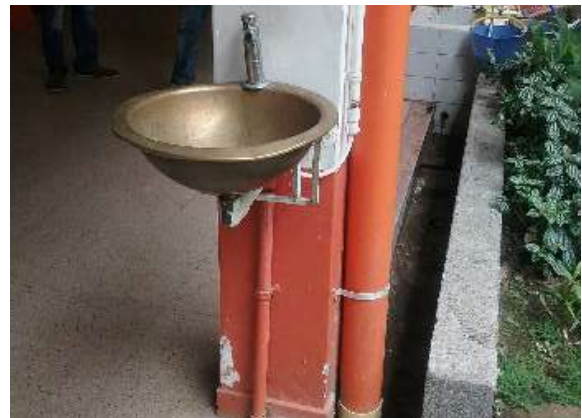
Ilustración 20. Bloque 5. Tubería a la vista pvcp de 1/2". Fuente: Equipo de Diagnóstico.
