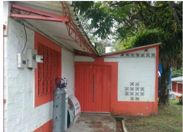
Ilustración 138. cubierta sin canaletas ni bajantes. Fuente: Equipo de Diagnostico.
