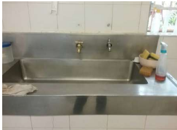
Ilustración 135. Bloque 16. Instalaciones interiores en buen estado. Fuente: Equipo de Diagnostico.
