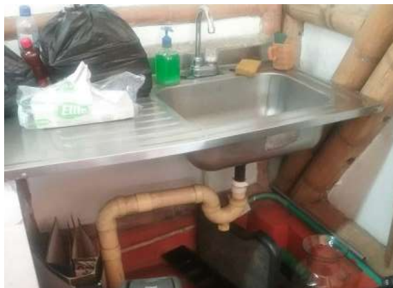
Ilustración 386. Bloque 68. Instalaciones funcionando correctamente. Fuente: Equipo de diagnóstico.
