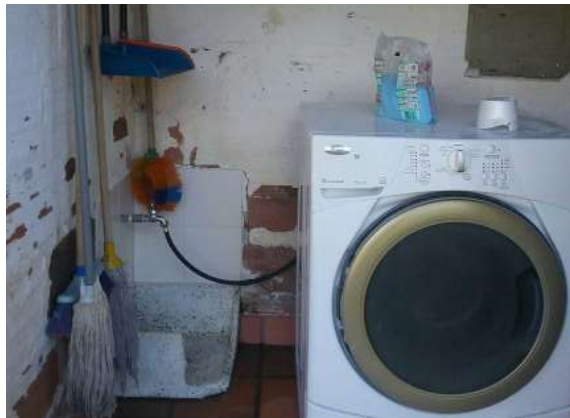
Ilustración 456. Bloque 88. Instalaciones principales funcionando de manera correcta. Fuente: Equipo de diagnóstico.
