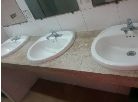
Ilustración 214. Bloque 26. Instalaciones interiores en buen estado. Fuente: Equipo de diagnóstico.
