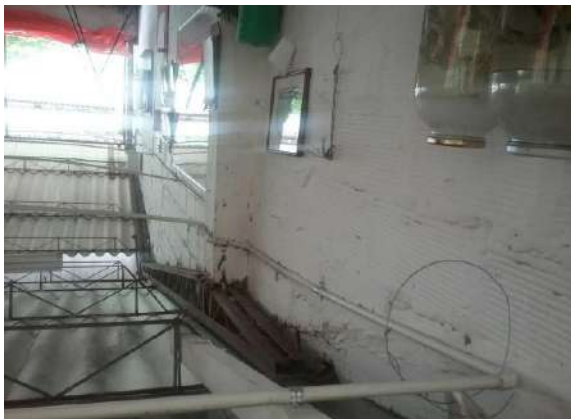
Ilustración 239. Bloque 34. Tuberías a la vista. Fuente: Equipo de diagnóstico.
