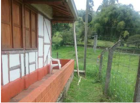
Ilustración 224. Bloque 27. Bajante de aguas lluvias en muy mal estado. Fuente: Equipo de diagnóstico.
