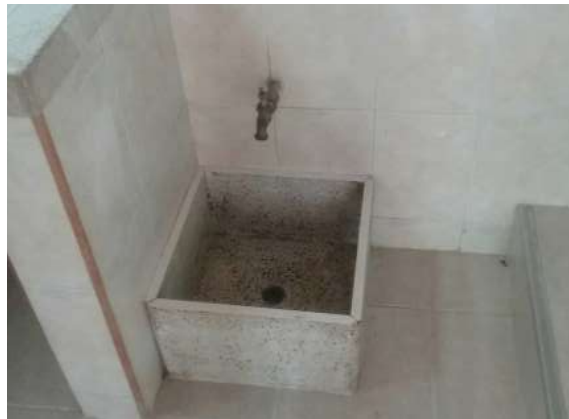
Ilustración 273. Bloque 40. Poceta de aseo funcionan de manera correcta. Fuente: Equipo de diagnóstico.
