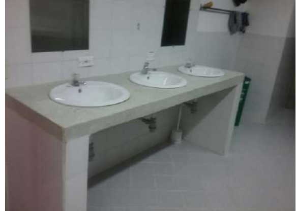
Ilustración 100. Bloque 12. Instalaciones interiores funcionan de manera correcta. Fuente: Equipo de Diagnostico.
