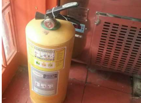
Ilustración 170. Bloque 19. Extintor multipropósito tipo ABC. Fuente: Equipo de diagnóstico.
