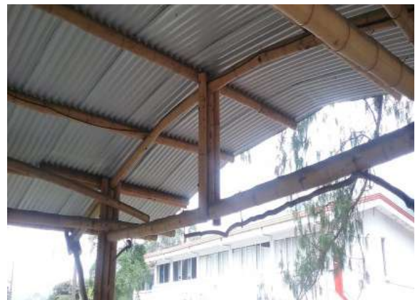
Ilustración 201. Bloque 23. Cubierta en teja de zinc. Fuente: Equipo de diagnóstico.
