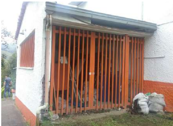
Ilustración 166. Bloque 19. Canaletas de aguas lluvia. Fuente: Equipo de Diagnostico.
