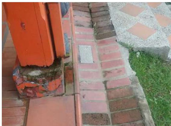
Ilustración 217. Bloque 26. Bajantes en mal estado. Fuente: Equipo de diagnóstico.
