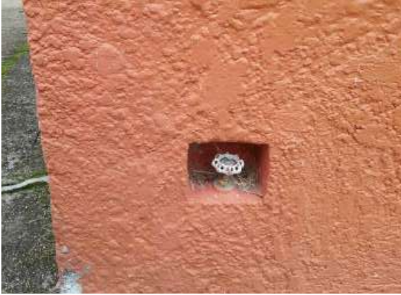
Ilustración 62. Bloque 7. Registro tipo globo de corte general. Fuente: Equipo de Diagnostico.
