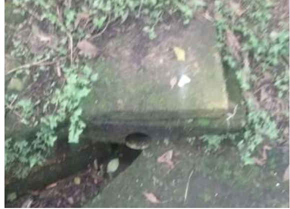
Ilustración 250. Bloque 35. Sumideros de aguas lluvia. Fuente: Equipo de diagnóstico.
