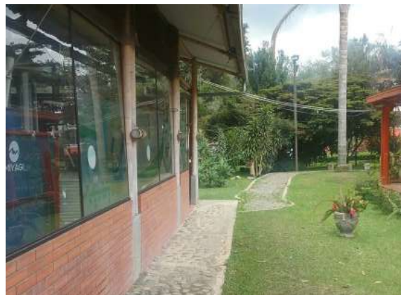
Ilustración 232. Bloque 31. Bajantes en mal estado. Fuente: Equipo de diagnóstico.
