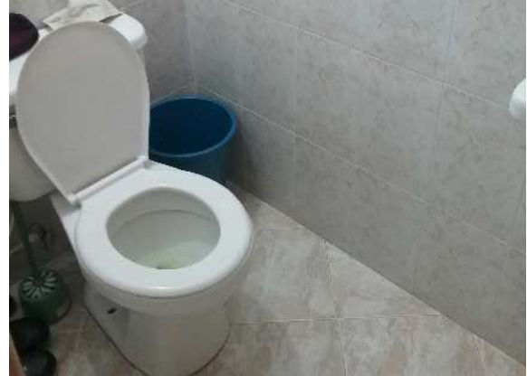
Ilustración 35. Bloque 5. Puntos hidráulicos funcionando correctamente. Fuente: Equipo de Diagnostico.
