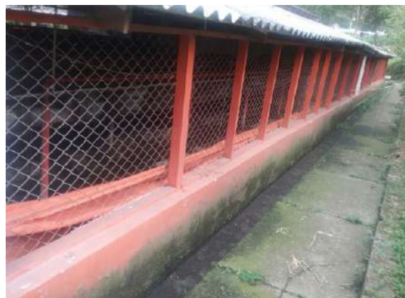
Ilustración 242. Bloque 34. Tejado sin canalización. Fuente: Equipo de diagnóstico.
