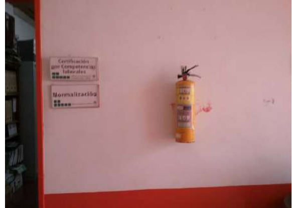
Ilustración 50. Bloque 5. Espacio normalización. Extintor multipropósito. Fuente: Equipo de Diagnostico.
