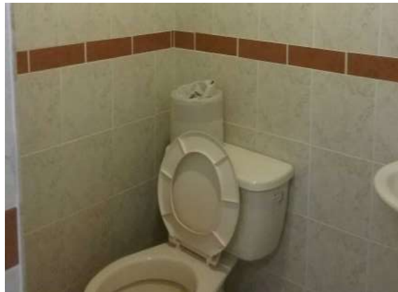
Ilustración 79. Bloque 9. Retrete, salida sanitaria en pvc de 4". Fuente: Equipo de Diagnóstico.
