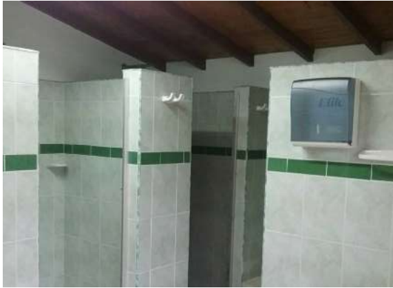
Ilustración 271. Bloque 40. Instalaciones hidráulicas funcionan de manera correcta. Fuente: Equipo de diagnóstico.
