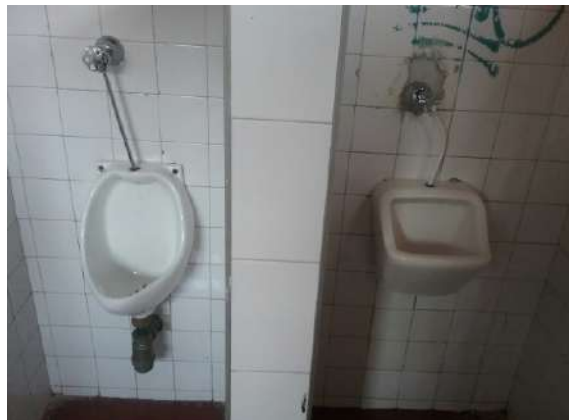
Ilustración 115. Bloque 13. Acoples plásticos en buen estado. Fuente: Equipo de Diagnóstico.
