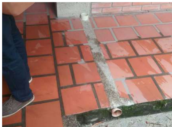
Ilustración 308. Bloque 45. Falta bajante de aguas lluvia. Fuente: Equipo de diagnóstico.
