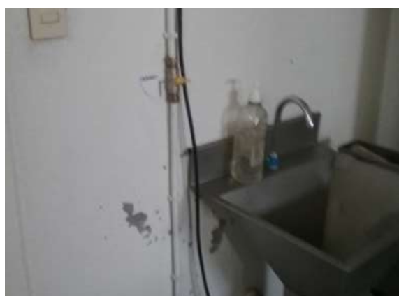
Ilustración 509. Bloque 101. Instalaciones interiores en buen estado. Fuente: Equipo de diagnóstico.
