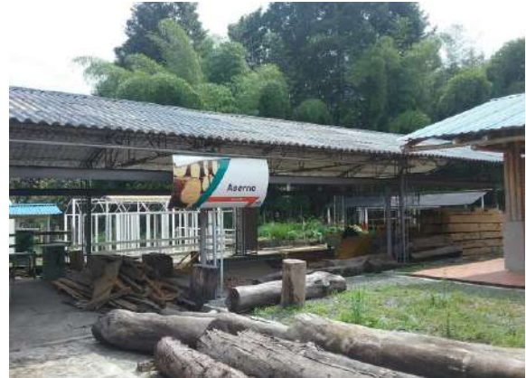
Ilustración 300. Bloque 44. Sin canaletas ni bajantes de aguas lluvia. Fuente: Equipo de diagnóstico.
