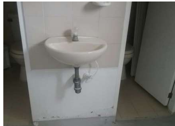
Ilustración 290. Bloque 42. Salida sanitaria de 2" incrustada en muro. Fuente: Equipo de diagnóstico.
