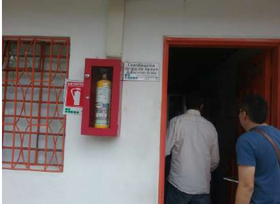
Ilustración 186. Bloque 20 extintor multipropósito en buen estado. Fuente: Equipo de Diagnóstico.
