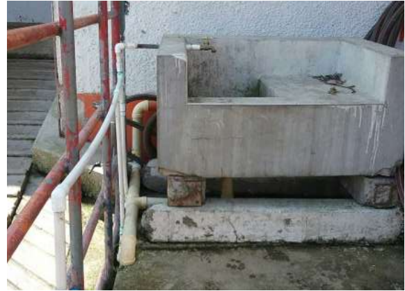
Ilustración 467. Bloque 92. Tuberías pvcp de 1/2" a la vista. Fuente: Equipo de diagnóstico.
