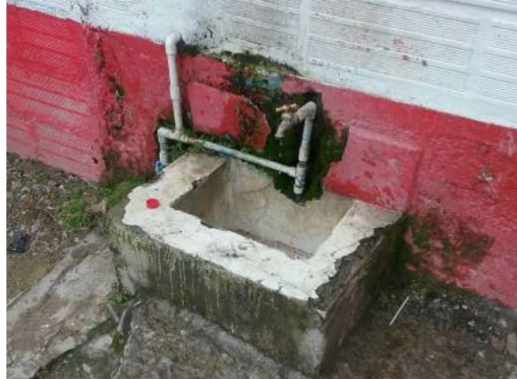
Ilustración 59. Bloque 6. Instalaciones en tubería galvanizada en mal estado. Fuente: Equipo de Diagnostico.
