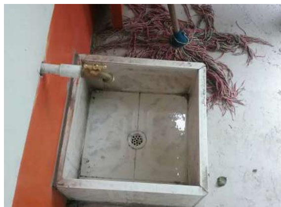
Ilustración 193. Bloque 22. Poceta de aseo en tubería pvcp de ½". Fuente: Equipo de diagnóstico.
