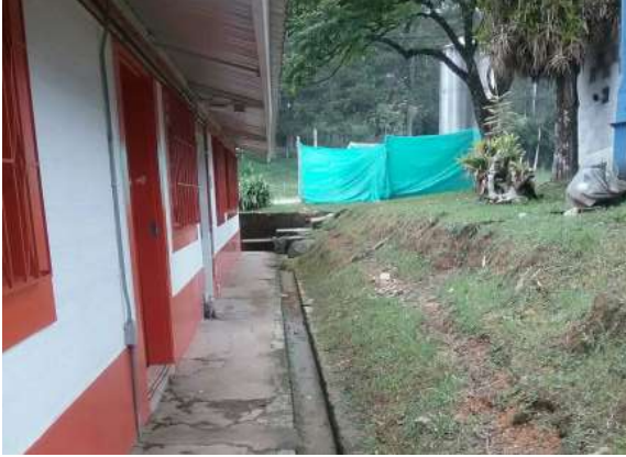
Ilustración 152. Bloque 17. Cubierta sin canaletas. Fuente: Equipo de Diagnostico.
