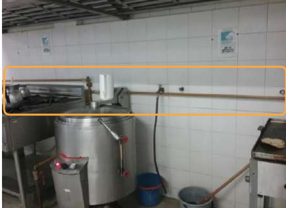
Ilustración 53. Bloque 5. Espacio cocina, restaurante. Instalaciones de gas. Fuente: Equipo de Diagnostico.
