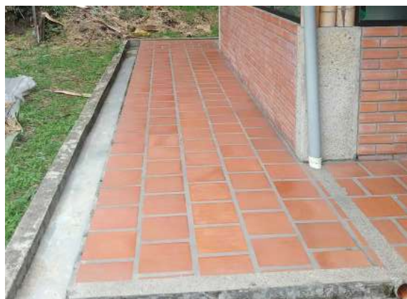
Ilustración 316. Bloque 47. Bajantes de aguas lluvia en pvc de 3". Fuente: Equipo de diagnóstico.
