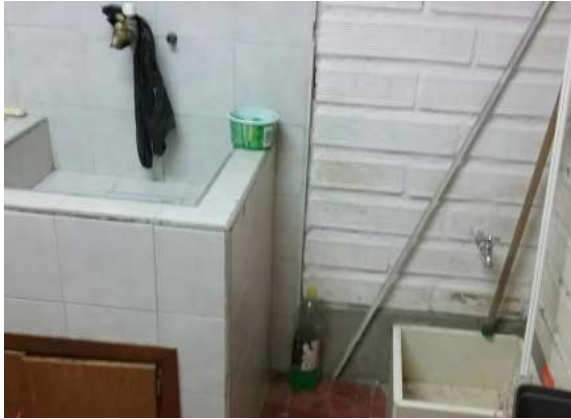
Ilustración 448. Bloque 85. Instalaciones funcionando de manera correcta. Fuente: Equipo de diagnóstico.
