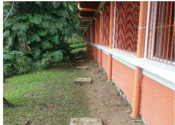
Ilustración 39. Bloque 5. Cajas de inspección de aguas lluvia. Fuente: Equipo de Diagnostico.
