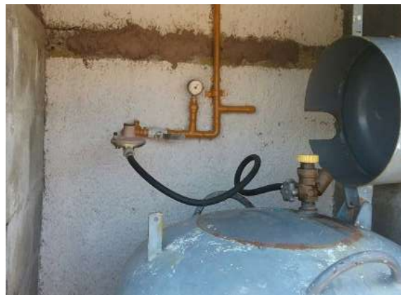
Ilustración 477. Bloque 92. Instalaciones de gas. Fuente: Equipo de diagnóstico.
