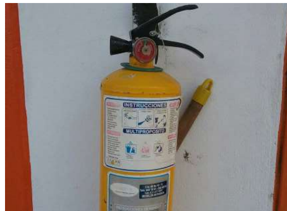
Ilustración 505. Bloque 100. Extintor multipropósito. Fuente: Equipo de diagnóstico.
