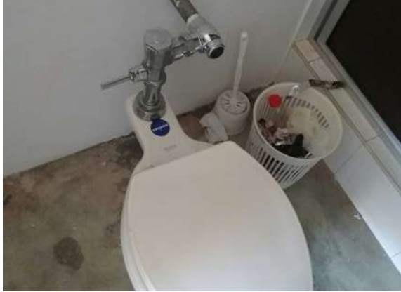
Ilustración 520. Bloque 102. Instalaciones hidráulicas funcionan de manera correcta. Fuente: Equipo de diagnóstico.
