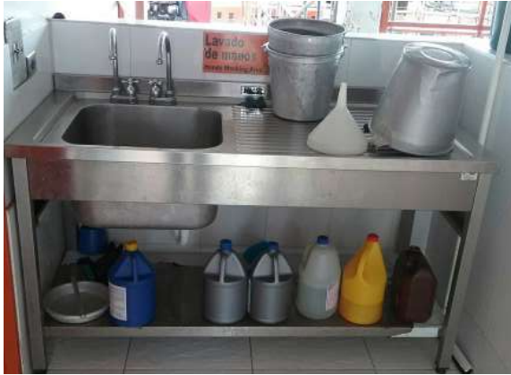
Ilustración 466. Bloque 92. Instalaciones interiores en buen estado. Fuente: Equipo de diagnóstico.
