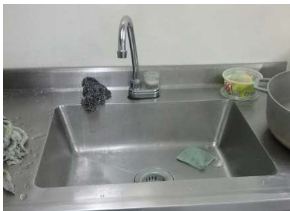
Ilustración 192. Bloque 22. Instalaciones funcionando correctamente. Fuente: Equipo de Diagnóstico.
