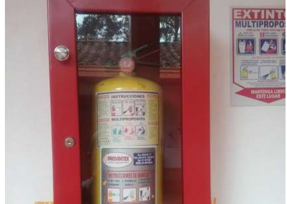
Ilustración 220. Bloque 26. Extintor multipropósito. Fuente: Equipo de diagnóstico.
