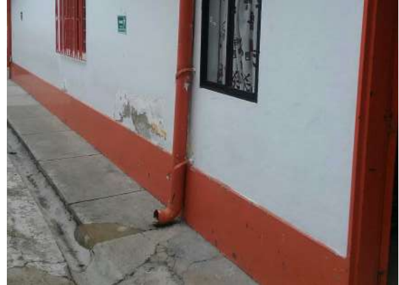
Ilustración 179. Bloque 20. Bajante de aguas lluvia Fuente: Equipo de Diagnostico.
