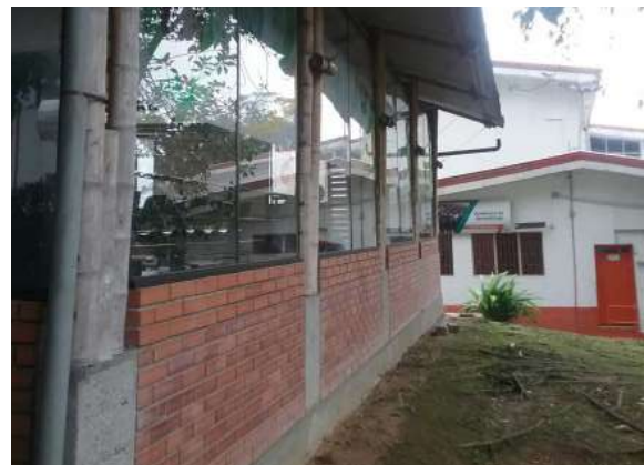
Ilustración 190. Bloque 21. Canaletas de aguas lluvia. Fuente: Equipo de Diagnostico.
