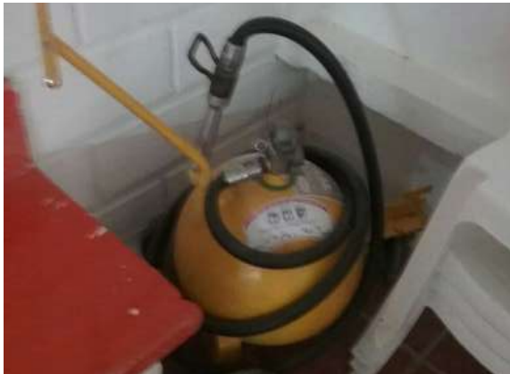
Ilustración 51. Bloque 5. Espacio comedor. Extintor multipropósito tipo satélite Fuente: Equipo de Diagnostico.
