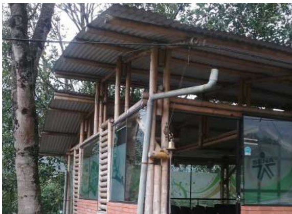
Ilustración 189. Bloque 21. Canaletas y bajantes en mal estado. Fuente: Equipo de Diagnostico.
