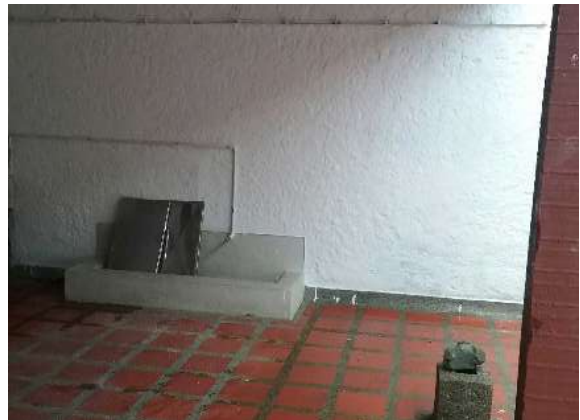
Ilustración 33. Bloque 5. Punto hidráulico. Fuente: Equipo de Diagnostico.
