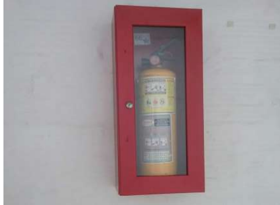
Ilustración 142. Bloque 16. Extintor multipropósito tipo ABC. Fuente: Equipo de Diagnostico.
