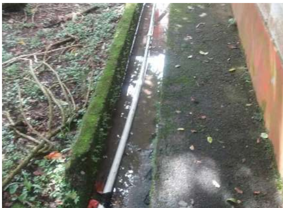
Ilustración 72. Bloque 9. Tuberías en pvcp de \frac{1}{2} " a la vista en malas condiciones. Fuente: Equipo de Diagnóstico.
