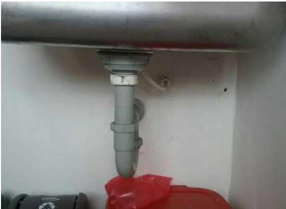
Ilustración 64. Bloque 7. Puntos hidráulicos funcionan de manera correcta. Fuente: Equipo de Diagnostico.
