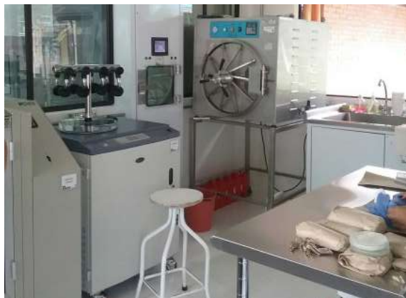
Ilustración 324. Bloque 49. Instalaciones interiores funcionan de manera correcta. Fuente: Equipo de diagnóstico.
