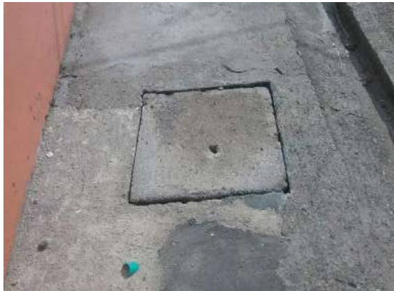
Ilustración 117. Bloque 13. Caja de inspección de aguas negras. Fuente: Equipo de Diagnóstico.
