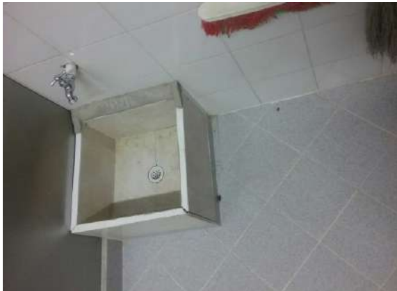
Ilustración 101. Bloque 12. Instalaciones interiores funcionan de manera correcta. Fuente: Equipo de Diagnostico.
