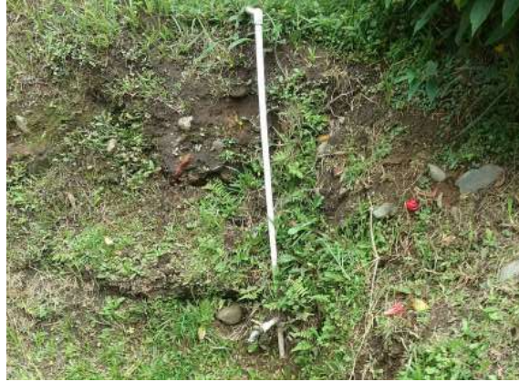
Ilustración 70. Bloque 8. Punto hidráulico en malas condiciones. Fuente: Equipo de Diagnóstico.
