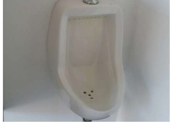
Ilustración 521. Bloque 102. Instalaciones hidráulicas funcionan de manera correcta. Fuente: Equipo de diagnóstico.
