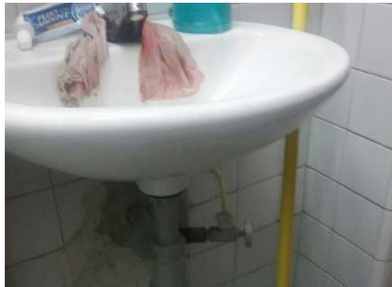
Ilustración 252. Bloque 35. Desagüe de 2" funcionando de manera correcta. Fuente: Equipo de diagnóstico.
