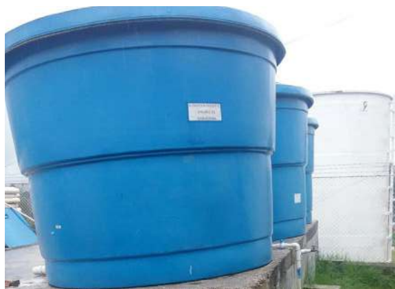
Ilustración 438. Bloque 82. Tanque de almacenamiento de agua potable capacidad 45.000 litros. Fuente: Equipo de diagnóstico.
