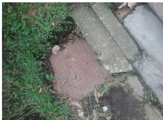
Ilustración 243. Bloque 34. Caja de inspección de aguas negras. Fuente: Equipo de diagnóstico.
