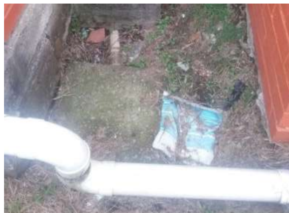
Ilustración 228. Caja de inspección de las cuatro cabañas. Fuente: Equipo de diagnóstico.
