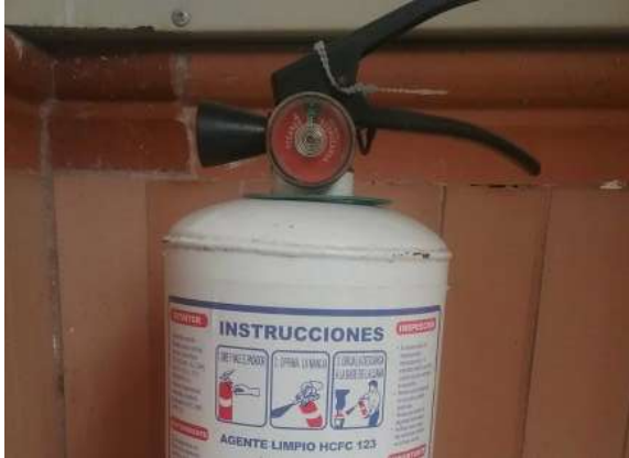
Ilustración 219. Bloque 26. Extintor multipropósito. Fuente: Equipo de diagnóstico.
