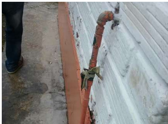
Ilustración 415. Bloque 72. Red principal acero galvanizado. Fuente: Equipo de diagnóstico.
