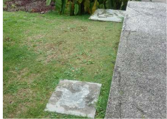
Ilustración 41. Bloque 5. Cajas de inspección aguas residuales. Fuente: Equipo de Diagnostico.
