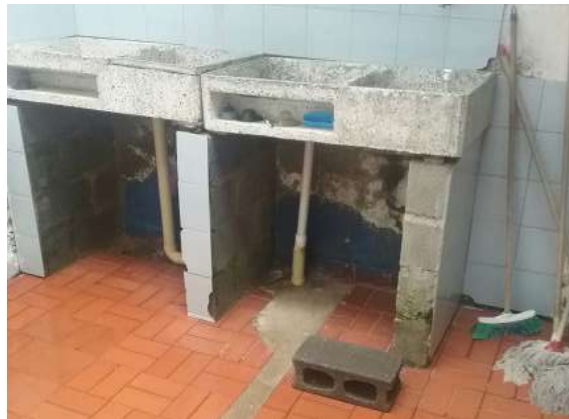
Ilustración 169. Bloque 19. Salidas sanitarias no convencionales. Fuente: Equipo de diagnóstico.
