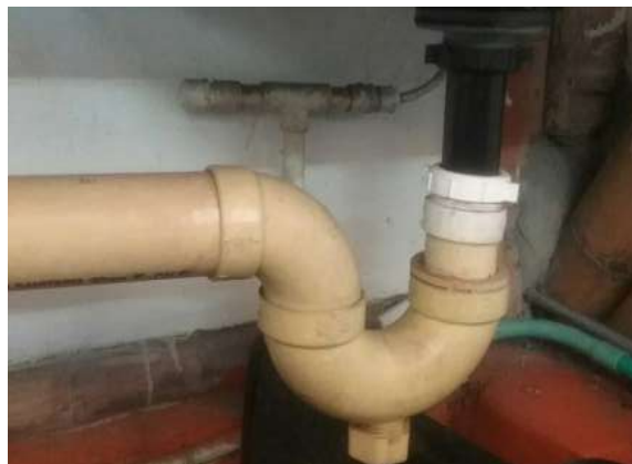
Ilustración 389. Bloque 68. Desagüe no cumple especificaciones técnicas. Fuente: Equipo de diagnóstico.
