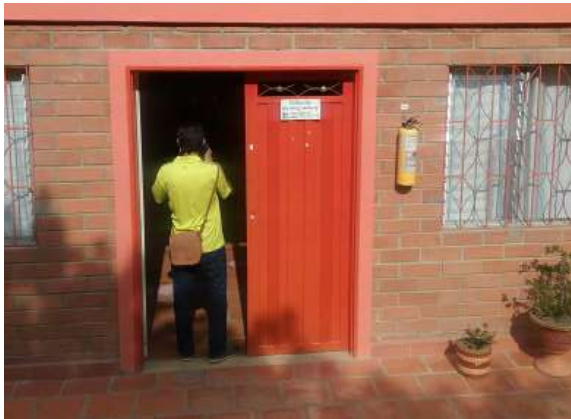
Ilustración 108. Bloque 12. Extintor multipropósito tipo ABC sin señalización. Fuente: Equipo de Diagnostico.
