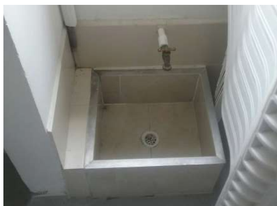
Ilustración 287. Bloque 42. Punto hidráulico en buen estado Fuente: Equipo de diagnóstico.
