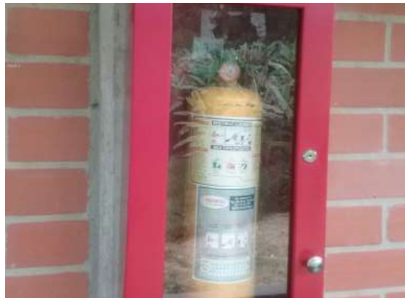
Ilustración 110. Bloque 12. Extintor multipropósito tipo ABC. Fuente: Equipo de Diagnostico.
