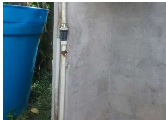
Ilustración 122. Bloque 14. Tuberías en mal estado. Fuente: Equipo de Diagnostico.
