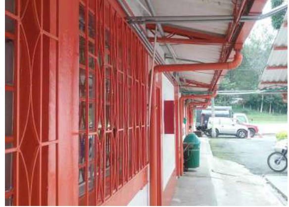
Ilustración 140. Bloque 16. Bajantes de aguas lluvia. Fuente: Equipo de Diagnostico.
