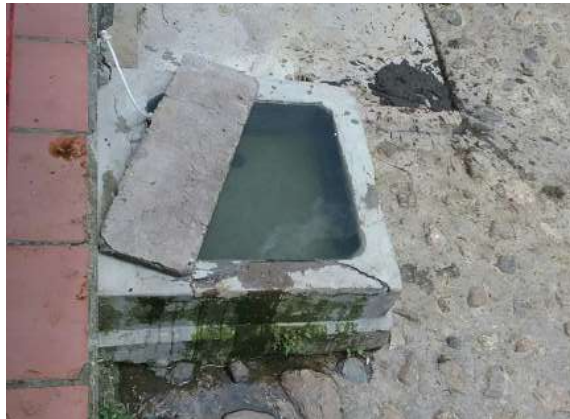
Ilustración 498. Bloque 97. Salida hidráulica en mal estado. Fuente: Equipo de diagnóstico.
