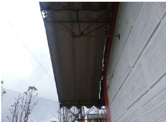
Ilustración 411. Bloque 72. Tejas en mal estado. Fuente: Equipo de diagnóstico.
