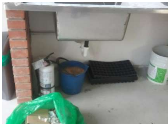
Ilustración 292. Bloque 42. Extintor tipo multipropósito. Fuente: Equipo de diagnóstico.
