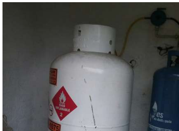
Ilustración 367. Bloque 63. Cilindro de gas de aproximadamente 200 libras. Fuente: Equipo de diagnóstico.
