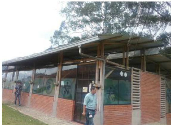
Ilustración 231. Bloque 31. Canaletas en mal estado. Fuente: Equipo de diagnóstico.
