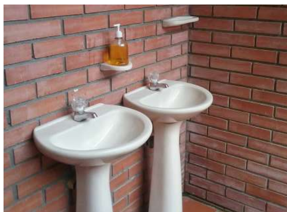
Ilustración 306. Bloque 45. Instalaciones en tubería pvcp de 1/2". Fuente: Equipo de diagnóstico.
