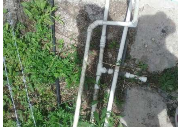
Ilustración 84. Bloque 10. Exterior tuberías a la vista. Fuente: Equipo de Diagnostico.
