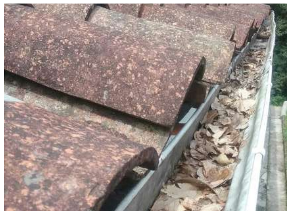
Ilustración 275. Bloque 40. Canaletas taponadas por sedimentos. Fuente: Equipo de diagnóstico.
