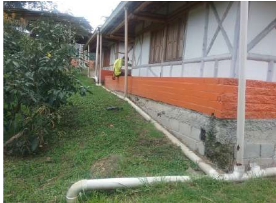
Ilustración 226. Bloque 28. Tuberías y canaletas en mal estado Fuente: Equipo de diagnóstico.
