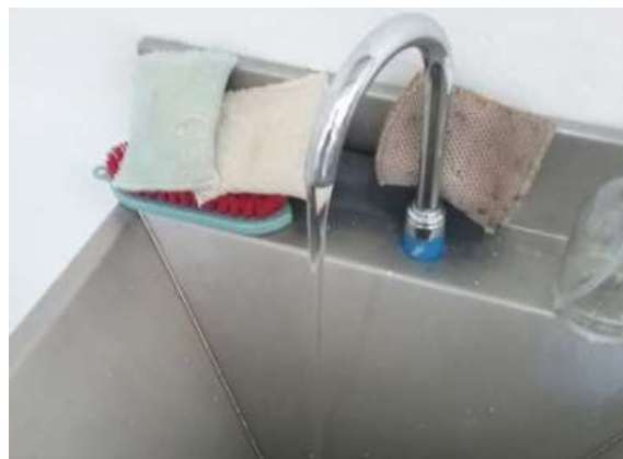
Ilustración 508. Bloque 101. Instalaciones funcionando correctamente. Fuente: Equipo de diagnóstico.
