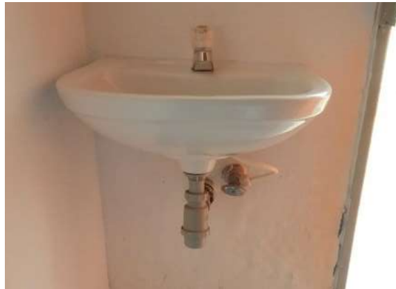
Ilustración 522. Bloque 102. Instalaciones hidráulicas funcionan de manera correcta. Fuente: Equipo de diagnóstico.
