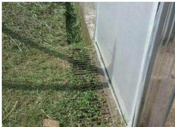
Ilustración 346. Bloque 55. Cunetas perimetrales. Fuente: Equipo de diagnóstico.
