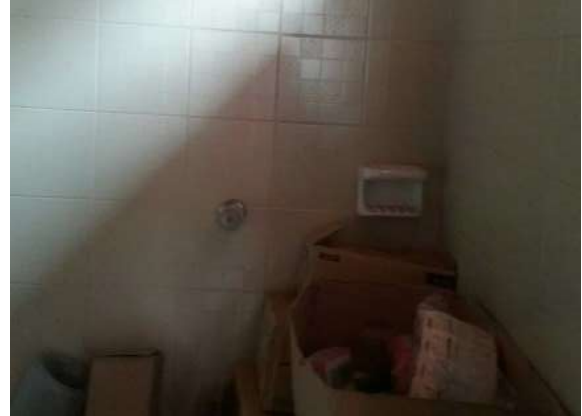
Ilustración 176. Bloque 20. Puntos hidráulicos obstruidos. Fuente: Equipo de Diagnostico.
