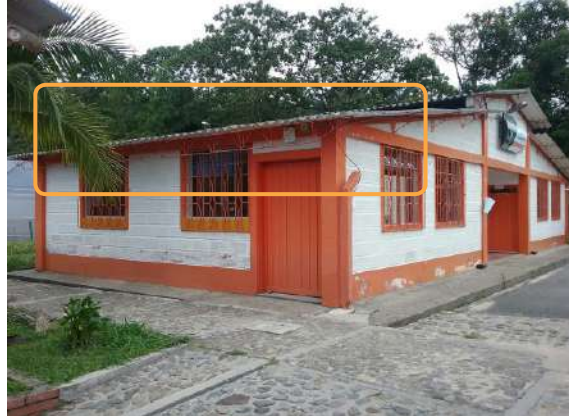
Ilustración 78. Bloque 9. Cubierta sin sistema de recolección de aguas lluvia. Fuente: Equipo de Diagnóstico.
