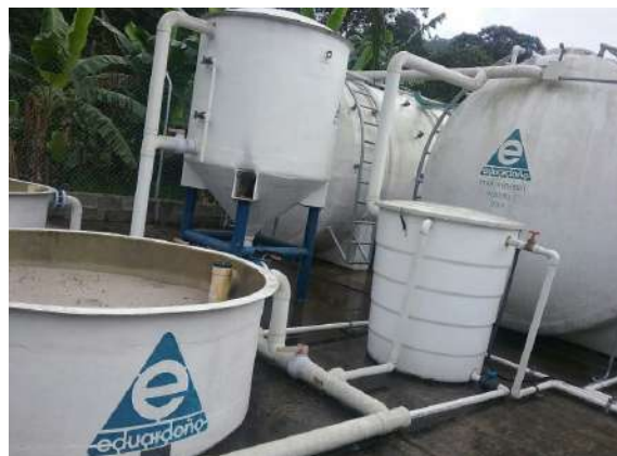
Ilustración 381. Bloque 67. Sistema de tratamiento de agua residual. Fuente: Equipo de diagnóstico.
