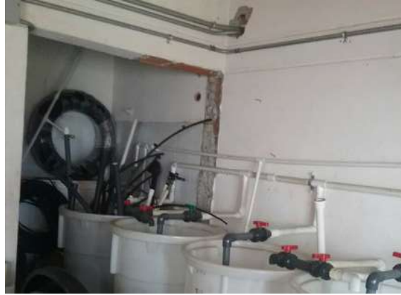
Ilustración 123. Bloque 14. Instalaciones en tubería pvcp de 1” Fuente: Equipo de Diagnostico.
