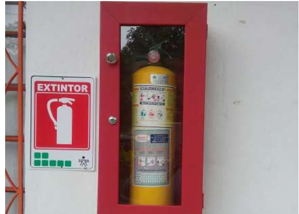
Ilustración 185. Bloque 20 extintor multipropósito en buen estado. Fuente: Equipo de Diagnostico.
