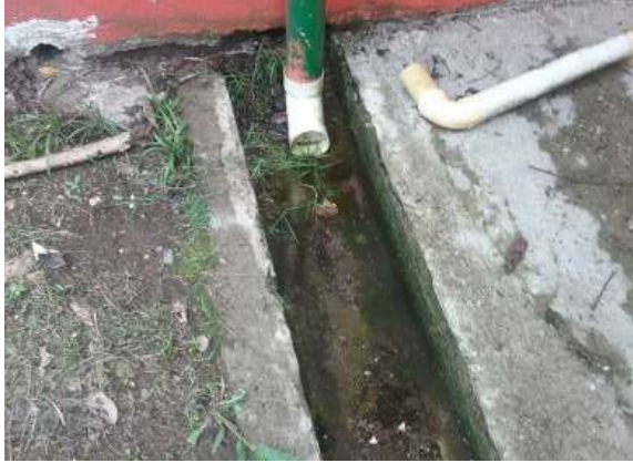
Ilustración 139. bloque 16. Bajantes de aguas lluvia. Fuente: Equipo de Diagnostico.
