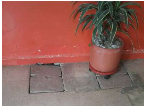
Ilustración 42. Bloque 5. Cajas de inspección aguas residuales. Fuente: Equipo de Diagnostico.
