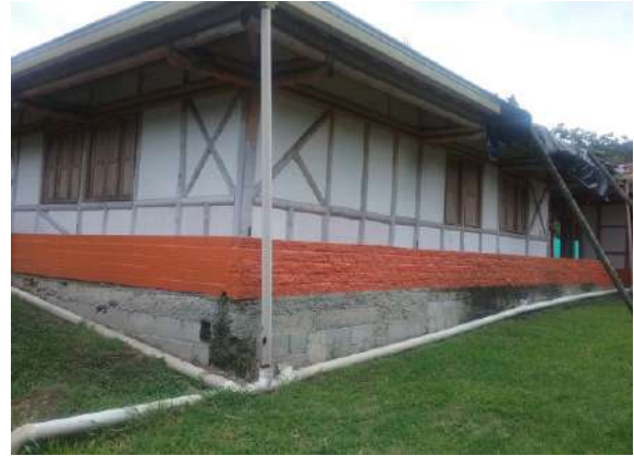
Ilustración 225. Bloque 30. Canaletas dañadas. Fuente: Equipo de diagnóstico.
