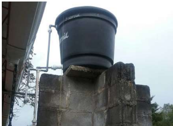
Ilustración 402. Bloque 71. Tanque elevado de 250 litros. Fuente: Equipo de diagnóstico.
