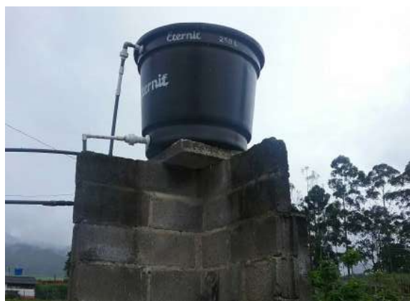
Ilustración 397. Bloque 70. Tanque plástico de 250 litro. Fuente: Equipo de diagnóstico.
