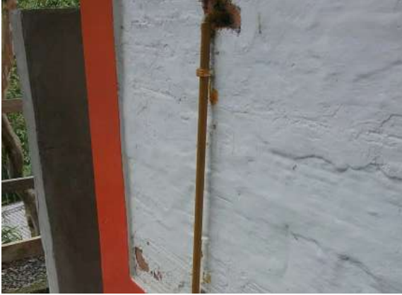
Ilustración 157. Bloque 17. Instalaciones de gas en buen estado. Fuente: Equipo de Diagnostico.
