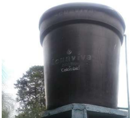
Ilustración 203. Bloque 24. Tanque elevado fuera de servicio. Fuente: Equipo de diagnóstico.
