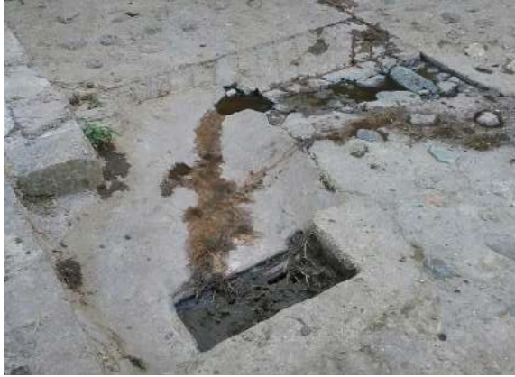
Ilustración 499. Bloque 97. Sumideros de aguas lluvia. Fuente: Equipo de diagnóstico.
