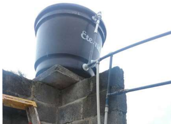
Ilustración 398. Bloque 70. Tubería pvcp en mal estado. Fuente: Equipo de diagnóstico.
