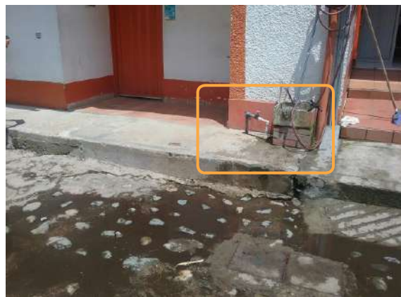
Ilustración 465. Bloque 92. Tuberías en pvcp de 1/2". Fuente: Equipo de diagnóstico.
