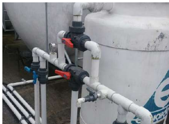
Ilustración 383. Bloque 67. Tuberías funcionan de manera correcta. Fuente: Equipo de diagnóstico.
