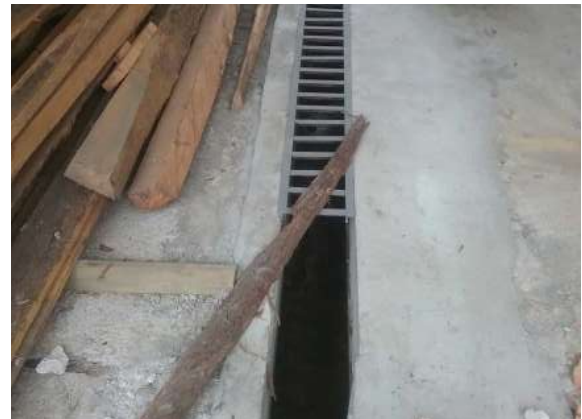
Ilustración 302. Bloque 44. Cuneta sin rejilla de piso. Fuente: Equipo de diagnóstico.
