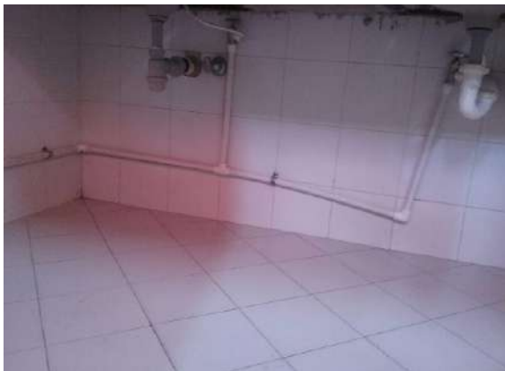
Ilustración 25. Bloque 5. Tuberías a la vista. Fuente: Equipo de Diagnostico.
