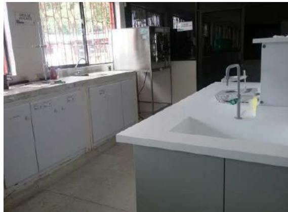
Ilustración 92. Bloque 11. Instalaciones hidráulicas en buen estado. Fuente: Equipo de Diagnóstico.
