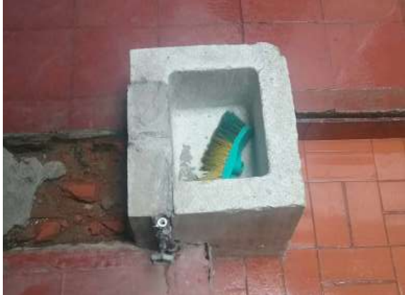
Ilustración 164. Bloque 19. Puntos dañados. Fuente: Equipo de Diagnostico.
