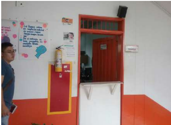
Ilustración 45. Bloque 5. Espacio sistemas. Extintor multipropósito. Fuente: Equipo de Diagnostico.
