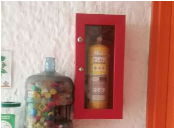
Ilustración 47. Bloque 5. Espacio pasillo entrada principal. Extintor multipropósito. Fuente: Equipo de Diagnostico.
