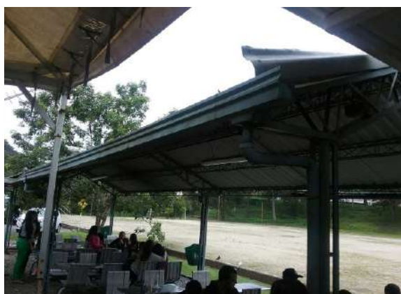
Ilustración 370. Bloque 65. Canaletas de cubierta en mal estado. Fuente: Equipo de diagnóstico.
