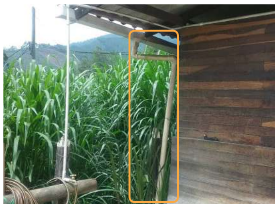
Ilustración 280. Bloque 41. Bajantes de aguas lluvia en mal estado. Fuente: Equipo de diagnóstico.
