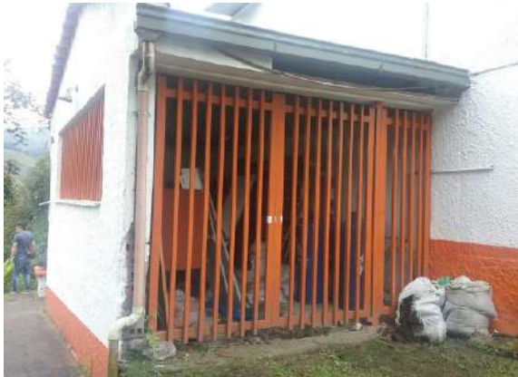
Ilustración 171. Bloque 19. Cuarto donde está ubicado el cilindro de gas. Fuente: Equipo de diagnóstico.
