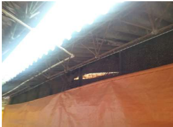
Ilustración 428. Bloque 77. Cubierta sin canaletas de aguas lluvia. Fuente: Equipo de diagnóstico.
