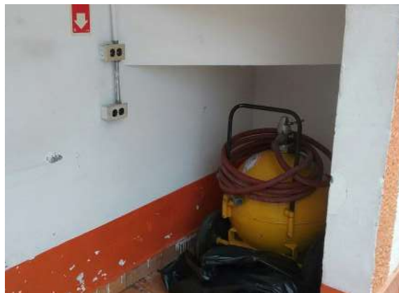
Ilustración 475. Bloque 92. Extintor multipropósito tipo satélite. Fuente: Equipo de diagnóstico.
