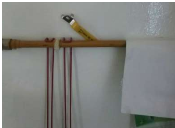
Ilustración 195. Bloque 22. Instalación de gas. Fuente: Equipo de Diagnostico.
