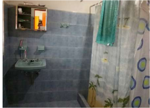
Ilustración 449. Bloque 85. Instalaciones incrustadas en muros. Fuente: Equipo de diagnóstico.
