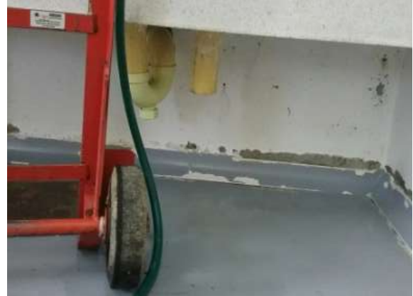
Ilustración 513. Bloque 101. Desagües en tubería pvc de 2". Fuente: Equipo de diagnóstico.
