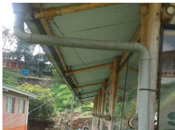
Ilustración 336. Bloque 51. Tubería pvc de 3". Fuente: Equipo de diagnóstico.
