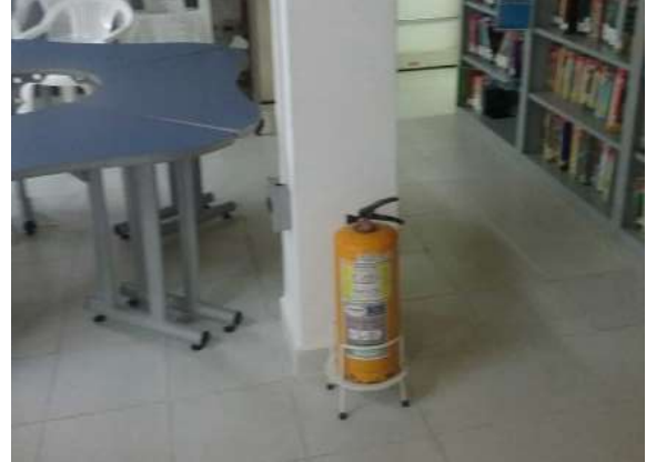
Ilustración 44. Bloque 5. Espacio biblioteca. Extintor multipropósito. Fuente: Equipo de Diagnostico.
