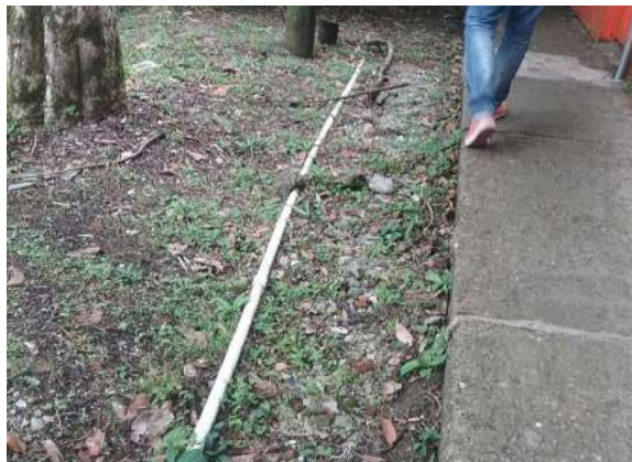
Ilustración 173. Bloque 20. Tubería de 1" pvcp a la vista. Fuente: Equipo de diagnóstico.
