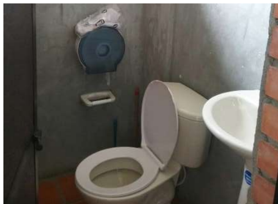
Ilustración 317. Bloque 47. Salidas sanitarias funcionando correctamente. Fuente: Equipo de diagnóstico.
