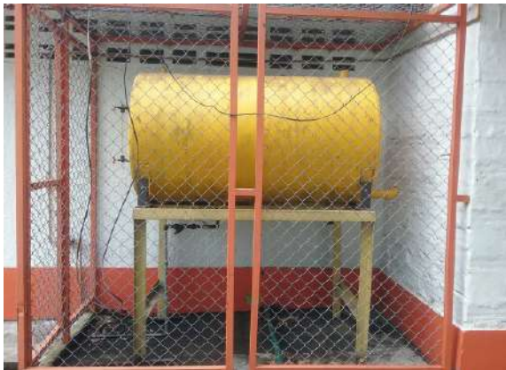
Ilustración 148. Bloque 16. Tanque de almacenamiento de combustible. Fuente: Equipo de Diagnostico.
