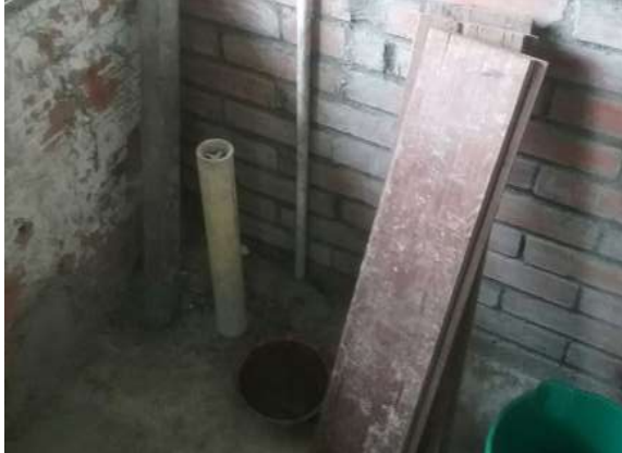
Ilustración 83. Tubería a la vista pvcp de 1/2". Fuente: Equipo de Diagnostico.
