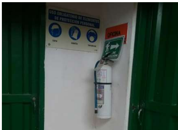
Ilustración 424. Bloque 76 extintor multipropósito. Fuente: Equipo de diagnóstico.
