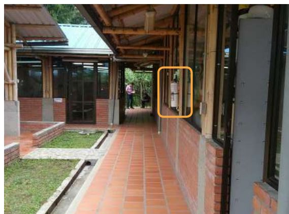
Ilustración 322. Bloque 48. Extintor multipropósito. Fuente: Equipo de diagnóstico.
