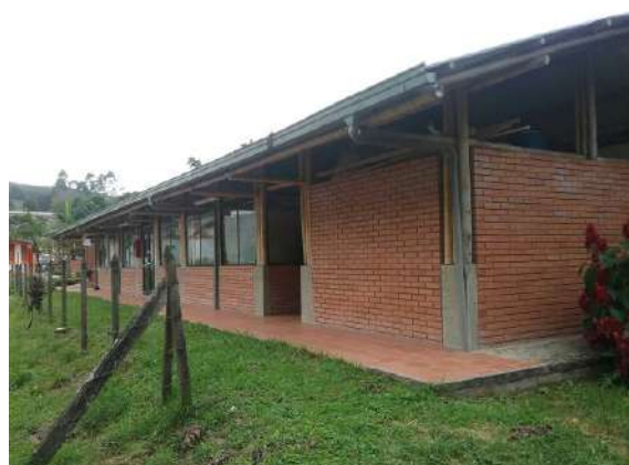
Ilustración 320. Bloque 48. Canaletas de aguas lluvia. Fuente: Equipo de diagnóstico.
