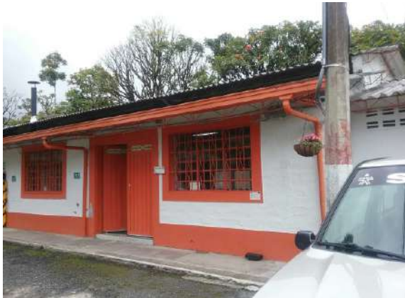
Ilustración 137. Bloque 16. Cubierta con sistema de canaletas y bajantes. Fuente: Equipo de Diagnostico.
