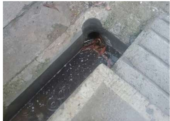
Ilustración 128. Bloque 15. Sifones de piso sin tragantes. Fuente: Equipo de Diagnostico.
