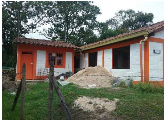
Ilustración 124. Bloque 14. Canaletas de aguas lluvia en buen estado. Fuente: Equipo de Diagnostico.
