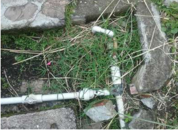
Ilustración 74. Bloque 9. Válvulas de control en mal estado. Fuente: Equipo de Diagnostico.
