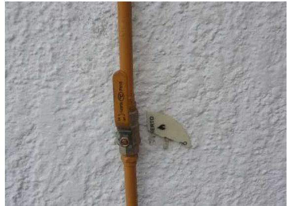
Ilustración 144. Bloque 16. Válvulas de control de gas. Fuente: Equipo de Diagnostico.
