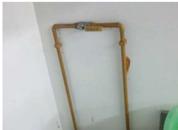
Ilustración 196. Bloque 22. Válvulas de gas. Fuente: Equipo de diagnóstico.
