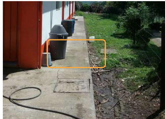
Ilustración 525. Bloque 102. Caja de inspección de aguas residuales. Fuente: Equipo de diagnóstico.
