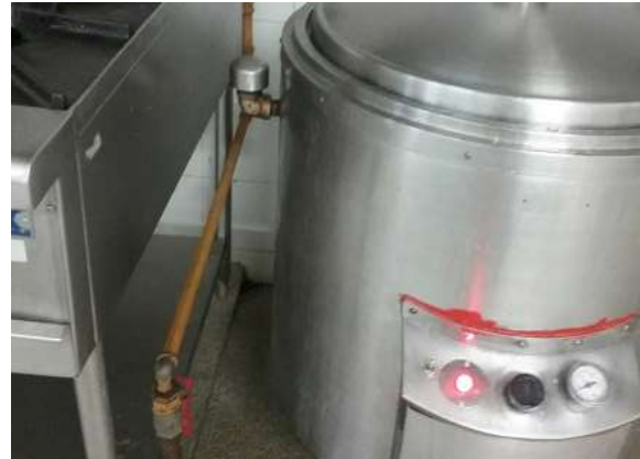
Ilustración 56. Bloque 5. Espacio cocina del restaurante. Aparato Gasodomésticos. Fuente: Equipo de Diagnostico.
