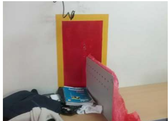
Ilustración 48. Bloque 5. Aula de profesores. Señalización sin extintor. Fuente: Equipo de Diagnostico.
