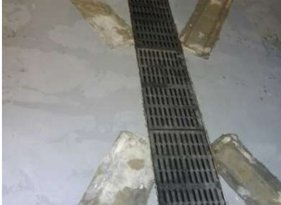
Ilustración 512. Bloque 101. Sumidero interno. Fuente: Equipo de diagnóstico.
