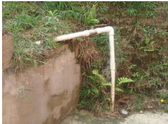
Ilustración 98. Bloque 12. Válvula principal de corte del bloque. Fuente: Equipo de Diagnostico.
