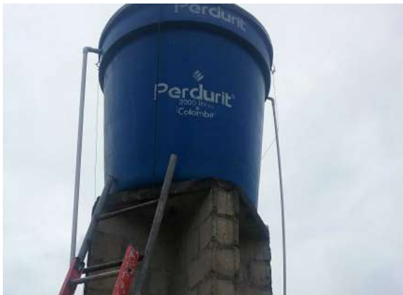
Ilustración 430. Bloque 78. Tanque elevado de 2000 litros. Fuente: Equipo de diagnóstico.
