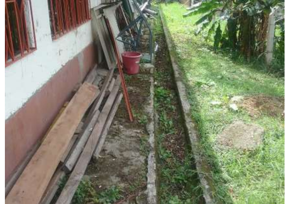
Ilustración 87. Bloque 10. Cunetas de piso en mal estado. Fuente: Equipo de Diagnostico.
