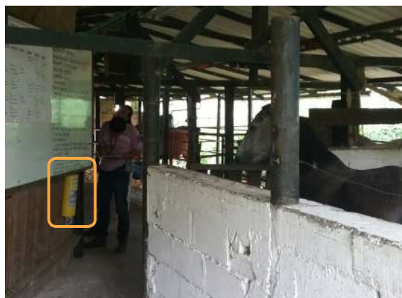
Ilustración 283. Bloque 41. Extintor multipropósito ABC. Fuente: Equipo de diagnóstico.
