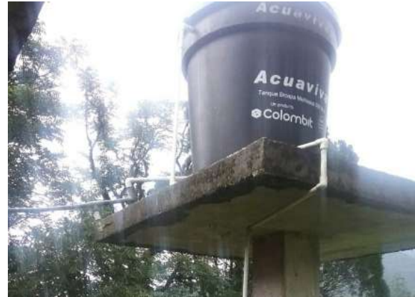
Ilustración 238. Bloque 34. Tubería de 3/8" en mal estado. Fuente: Equipo de diagnóstico.
