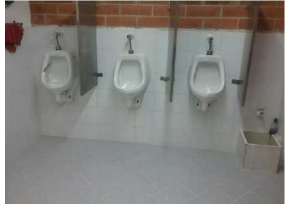
Ilustración 105. Bloque 12. Orinal en mal estado, (roto). Fuente: Equipo de Diagnostico.
