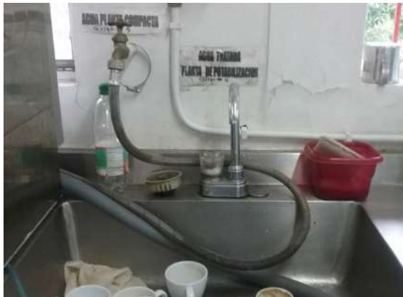
Ilustración 151. Bloque 17. Instalaciones interiores en buen estado. Fuente: Equipo de Diagnóstico.
