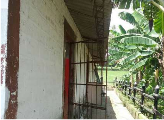
Ilustración 488. Bloque 95. Cubierta sin canaletas de aguas lluvia. Fuente: Equipo de diagnóstico.
