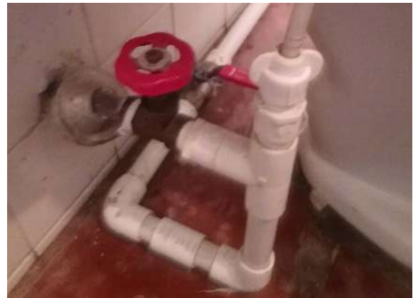
Ilustración 26. Bloque 5. Válvulas de control de espacio. Fuente: Equipo de Diagnostico.
