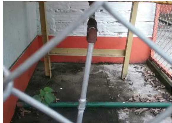
Ilustración 149. Bloque 16. Tubería en acero galvanizado oxidado. Fuente: Equipo de Diagnostico.
