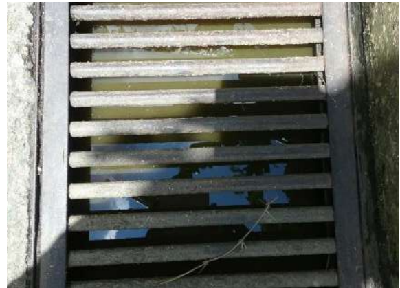
Ilustración 491. Bloque 95. Sumidero de aguas lluvia taponado. Fuente: Equipo de diagnóstico.
