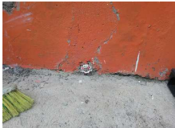
Ilustración 174. Bloque 20. Registro tipo globo para corte general. Fuente: Equipo de diagnóstico.
