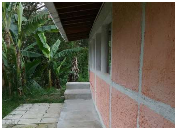
Ilustración 374. Bloque 66. Tuberías pvcp de 1/2" a la vista. Fuente: Equipo de diagnóstico.
