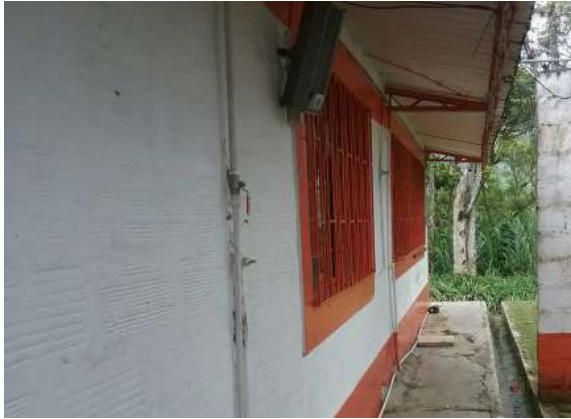
Ilustración 133. Bloque 16. Tuberías pvcp de ½” a la vista en mal estado. Fuente: Equipo de Diagnostico.
