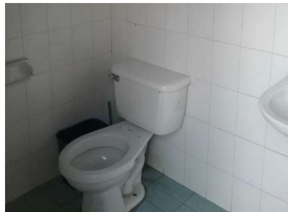
Ilustración 257. Bloque 37. Instalaciones en tubería pvcp de 1/2". Fuente: Equipo de diagnóstico.
