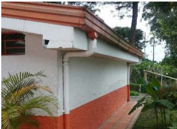
Ilustración 38. Bloque 5. Bajantes de aguas lluvia. Fuente: Equipo de Diagnostico.
