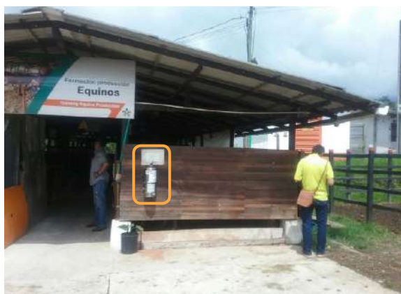
Ilustración 282. Bloque 41. Extintor tipo agua a presión. Fuente: Equipo de diagnóstico.
