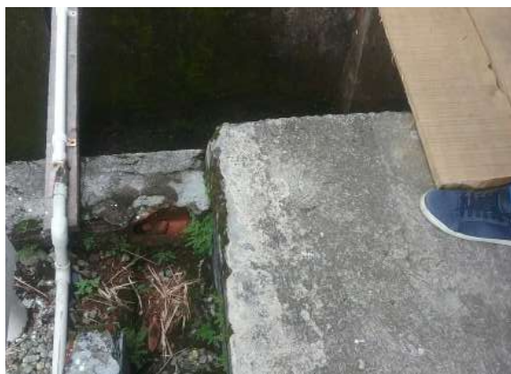
Ilustración 296. Bloque 44. Tubería pvcp de 1/2" a la vista. Fuente: Equipo de diagnóstico.
