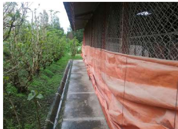
Ilustración 412. Bloque 72. Cubierta sin canaletas de aguas lluvia. Fuente: Equipo de diagnóstico.
