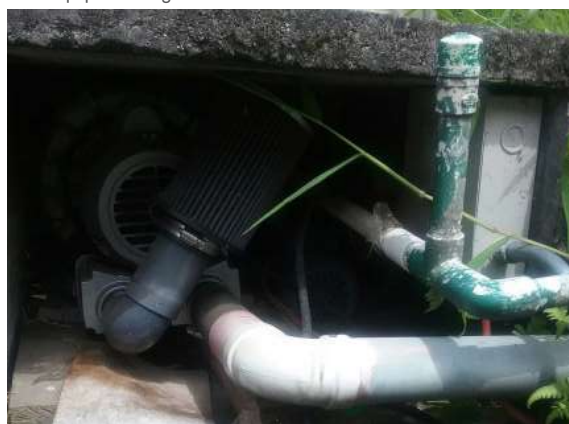
Ilustración 205. Bloque 24. Equipo de presión fuera de servicio. Fuente: Equipo de diagnóstico.
