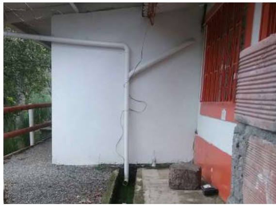
Ilustración 154. Bloque 17. Bajantes de aguas lluvia en tubería pvcs de 3" Fuente: Equipo de Diagnostico.
