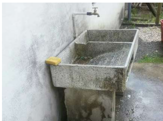
Ilustración 298. Bloque 44. Salidas hidráulicas funcionan de manera correcta. Fuente: Equipo de diagnóstico.
