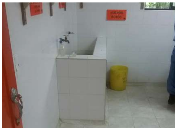
Ilustración 404. Bloque 71. Instalaciones interiores presentan baja presión Fuente: Equipo de diagnóstico.
