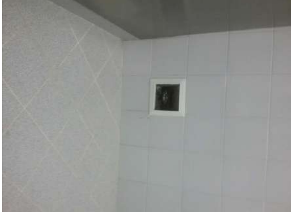
Ilustración 99. Bloque 12. Registros de control de espacios. Fuente: Equipo de Diagnostico.
