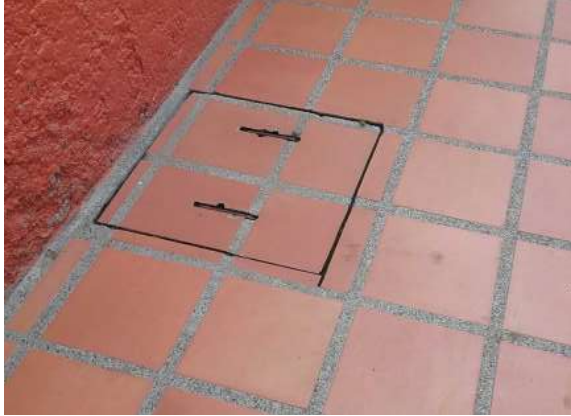
Ilustración 40. Cajas de inspección de aguas residuales. Fuente: Equipo de Diagnostico.
