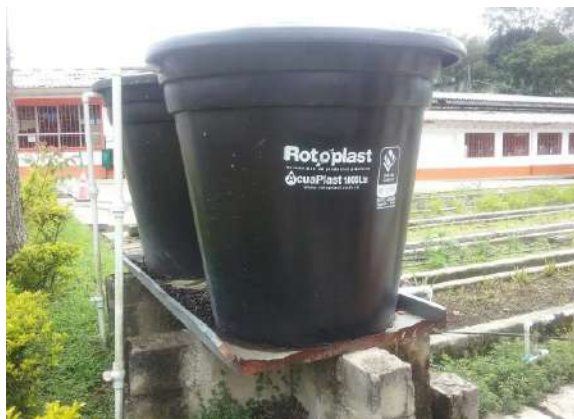
Ilustración 356. Bloque 59. Tanques de 1000 litros. Fuente: Equipo de diagnóstico.
