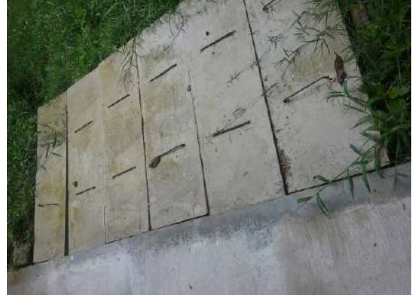
Ilustración 378. Bloque 66. Cajas de inspección. Fuente: Equipo de diagnóstico.
