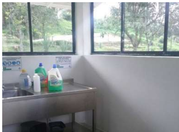
Ilustración 263. Bloque 39. Instalaciones interiores funcionando de manera correcta. Fuente: Equipo de diagnóstico.
