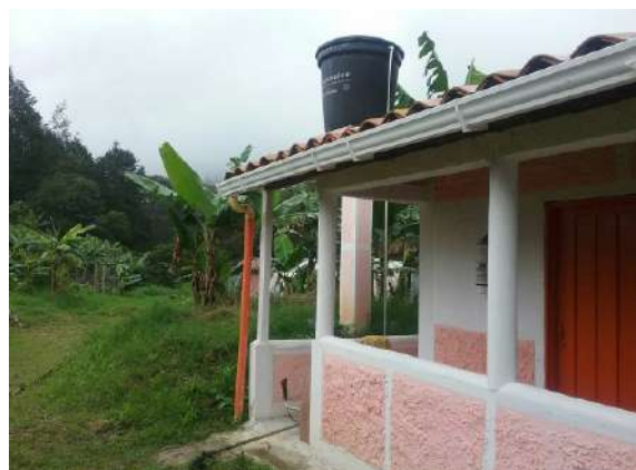
Ilustración 376. Bloque 66. Canaletas de aguas lluvia en buen estado. Fuente: Equipo de diagnóstico.
