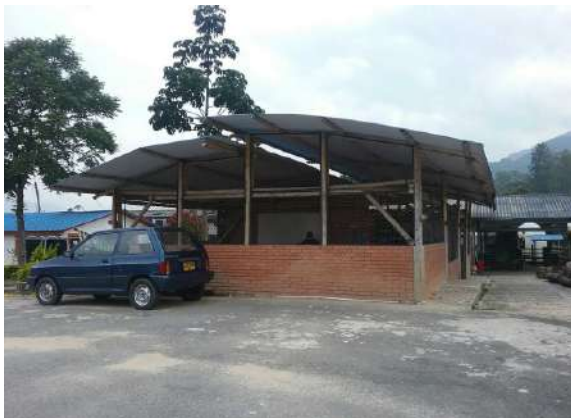
Ilustración 351. Bloque 58. Cubierta a dos aguas en teja de zinc. Fuente: Equipo de diagnóstico.
