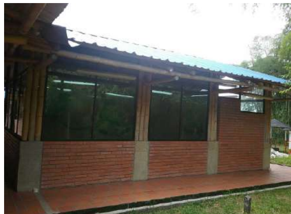
Ilustración 315. Bloque 47 sin canaletas de aguas lluvia. Fuente: Equipo de diagnóstico.
