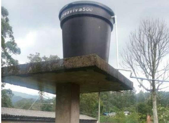
Ilustración 237. Bloque 34. Tanque de almacenamiento. Fuente: Equipo de diagnóstico.
