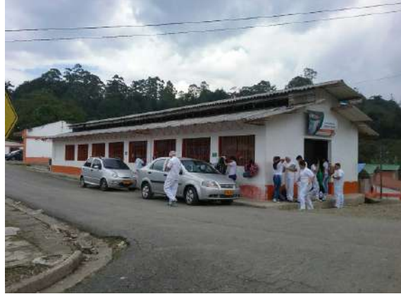
Ilustración 93. Bloque 11. Cubierta sin manejo de aguas lluvia. Fuente: Equipo de Diagnostico.
