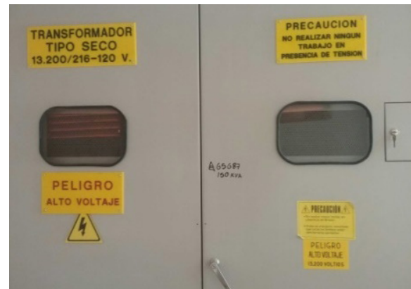
Ilustración 9. Subestación 5 (Transformador tipo seco). Fuente: Equipo Diagnóstico
