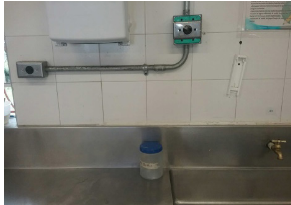
Ilustración 108. Tomacorrientes Fuente: Equipo Diagnóstico
