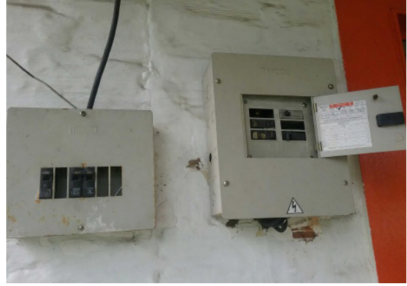
Ilustración 105. Tablero Fuente: Equipo Diagnóstico
