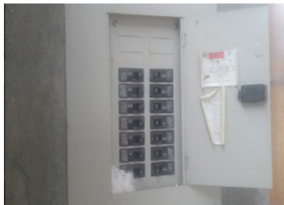
Ilustración 215 Tablero de distribución. Fuente: equipo diagnóstico.
