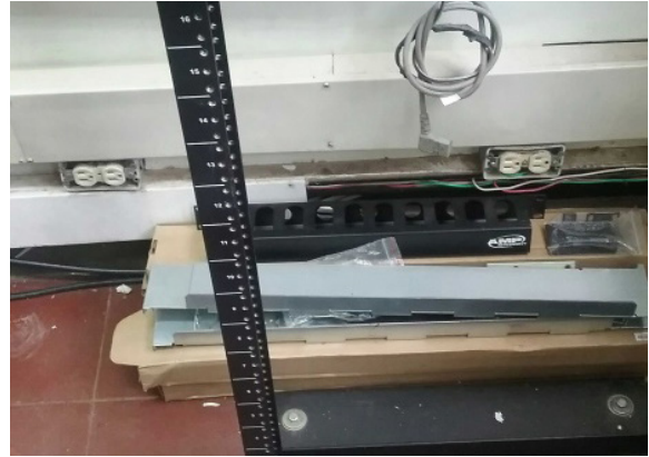
Ilustración 55. Tomacorrientes Fuente: Equipo Diagnóstico
