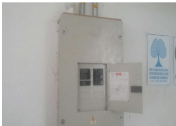
Ilustración 214 Tablero de distribución. Fuente: equipo diagnóstico.
