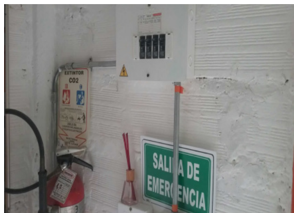
Ilustración 243. Caja de paso sin tapa. Fuente: equipo diagnóstico
