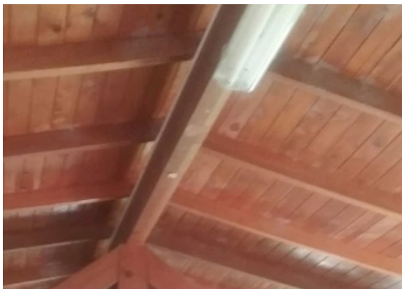
Ilustración 172. Iluminación bloque 40. Fuente: equipo diagnóstico.
