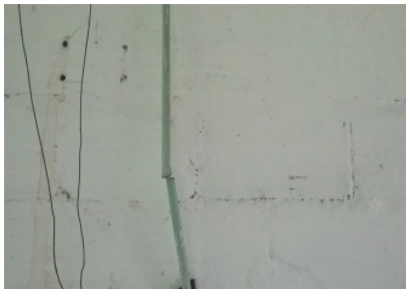
Ilustración 245. Interruptor en malas condiciones Fuente: equipo diagnóstico
