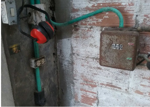
Ilustración 298: tomacorrientes bloque 95. Fuente: equipo de diagnóstico.
