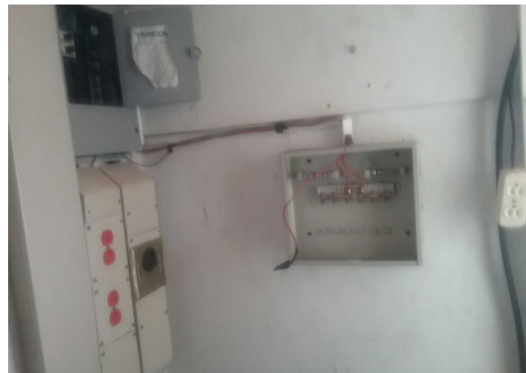
Ilustración 92. Tablero Fuente: Equipo Diagnóstico
