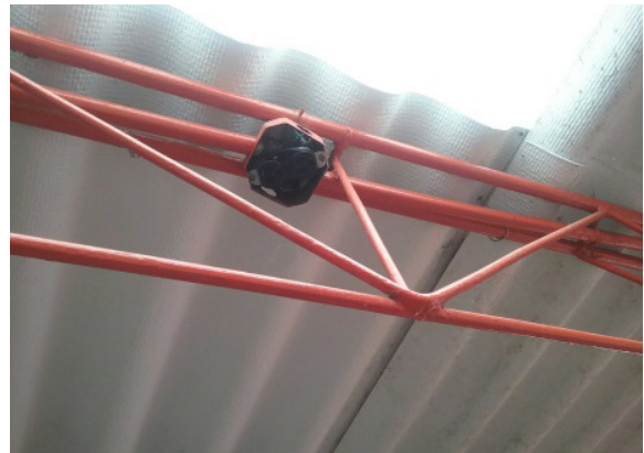
Ilustración 51. Conductores expuestos Fuente: Equipo Diagnóstico
