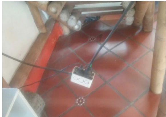
Ilustración 234. Tomacorriente suelto Fuente: equipo diagnóstico
