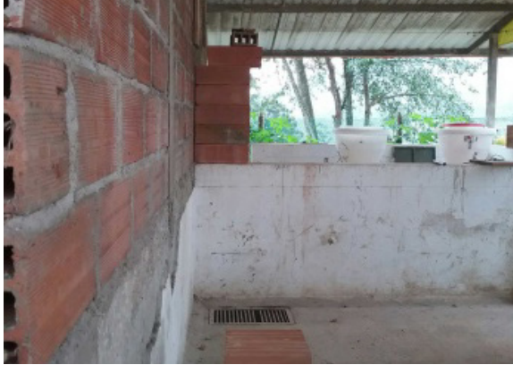
Ilustración 260 Bloque 79. Fuente: equipo diagnóstico.
