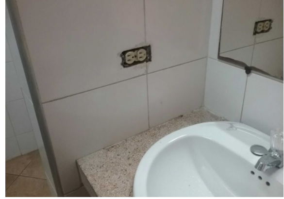
Ilustración 138. Tomacorrientes Fuente: Equipo Diagnóstico
