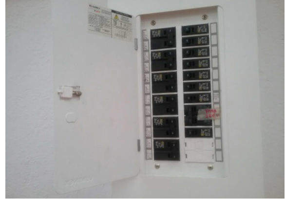
Ilustración 81. Tablero Fuente: Equipo Diagnóstico
