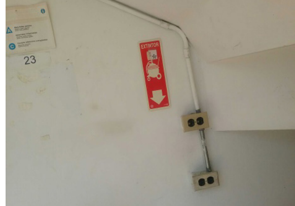
Ilustración 288: Tomacorrientes. Fuente: equipo de diagnóstico
