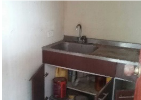
Ilustración 312: tomacorrientes bloque 100. Fuente: equipo de diagnóstico.
