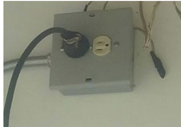
Ilustración 171. Tomacorriente baños bloque 40. Fuente: equipo diagnóstico
