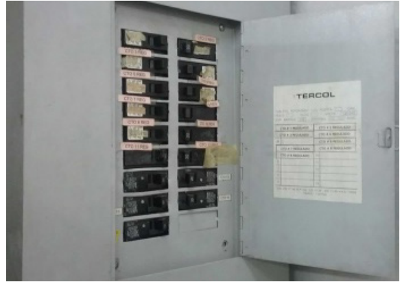
Ilustración 44. Tablero Fuente: Equipo Diagnóstico
