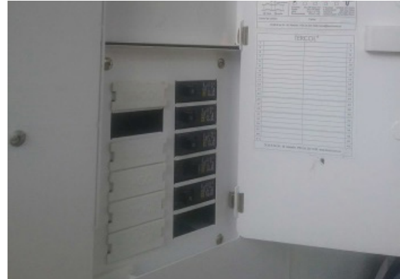
Ilustración 102. Tablero Fuente: Equipo Diagnóstico
