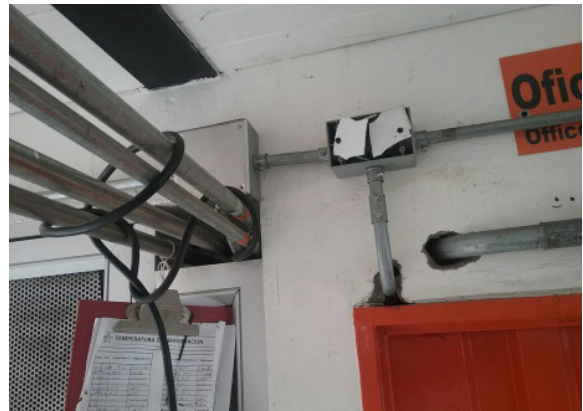
Ilustración 286: Ductería. Fuente: equipo de diagnóstico
