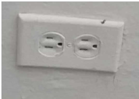
Ilustración 195. Tomacorriente bloque 19 Fuente: equipo diagnóstico.
