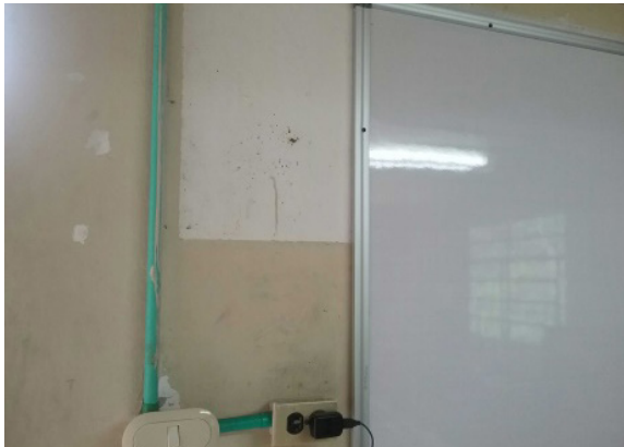
Ilustración 118. Tubería pvc. Fuente: Equipo Diagnóstico
