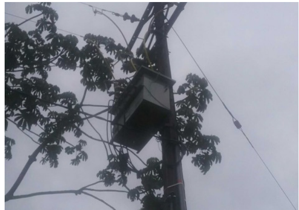
Ilustración 6. Subestación 2. Fuente: Equipo Diagnóstico
