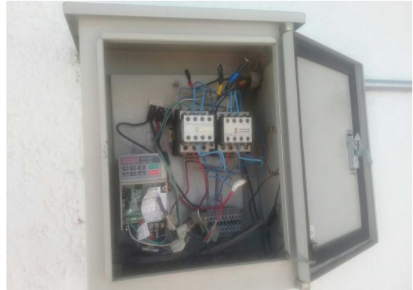
Ilustración 21. Tablero Fuente. Equipo Diagnóstico
