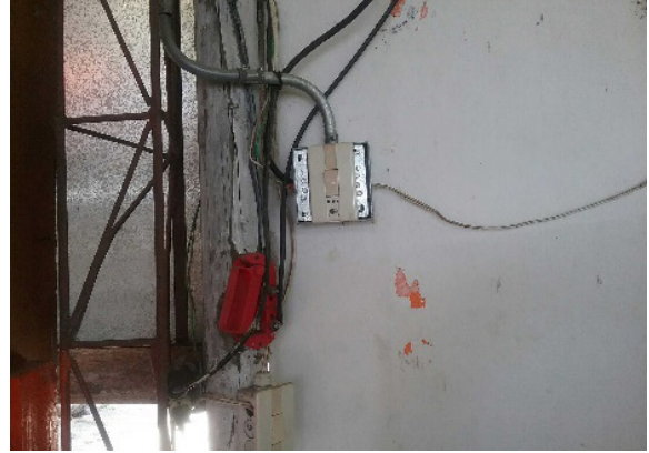
Ilustración 307: Tubería sin marcar. Fuente: equipo de diagnóstico.
