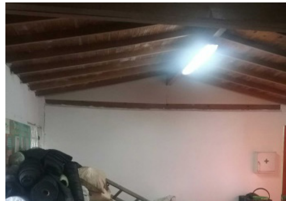
Ilustración 173. Iluminación bloque 40. Fuente: equipo diagnóstico.
