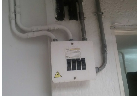
Ilustración 42. Tablero Fuente: Equipo Diagnóstico
