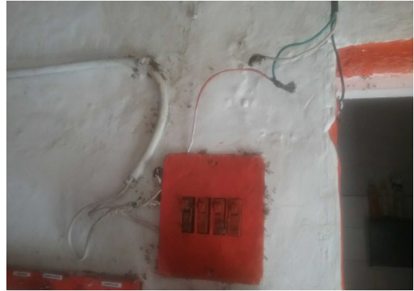
Ilustración 19. Tablero. Fuente. Equipo Diagnóstico
