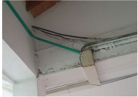
Ilustración 36. Tubería Fuente: Equipo Diagnóstico
