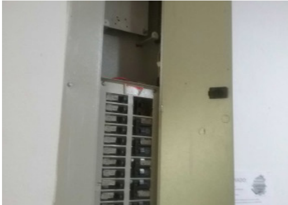
Ilustración 80. Tablero Fuente: Equipo Diagnóstico
