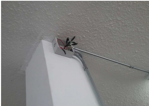
Ilustración 45. Conductores expuestos Fuente: Equipo Diagnóstico
