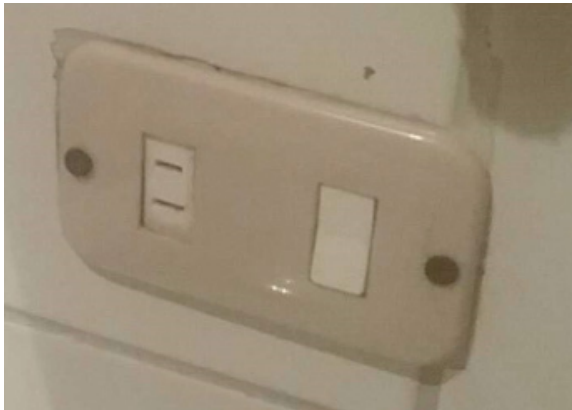
Ilustración 147. Tomacorriente cabaña. Fuente: equipo eléctrico
