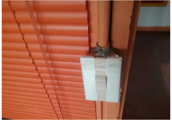
Ilustración 61. Interruptor Fuente: Equipo Diagnóstico
