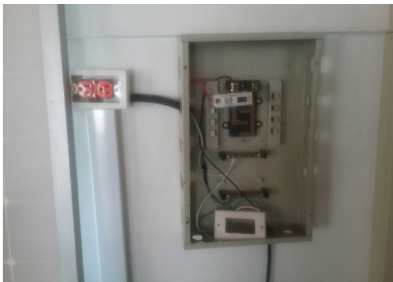
Ilustración 91. Tablero Fuente: Equipo Diagnóstico
