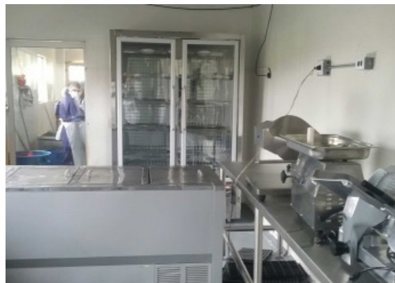
Ilustración 315: Tomacorrientes bloque 101. Fuente: equipo de diagnóstico.
