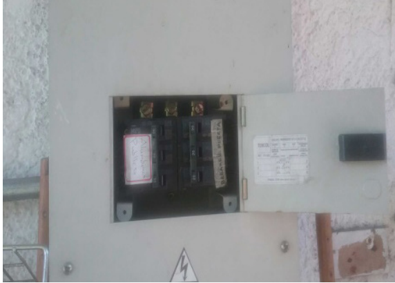
Ilustración 22. Tablero Fuente. Equipo Diagnóstico
