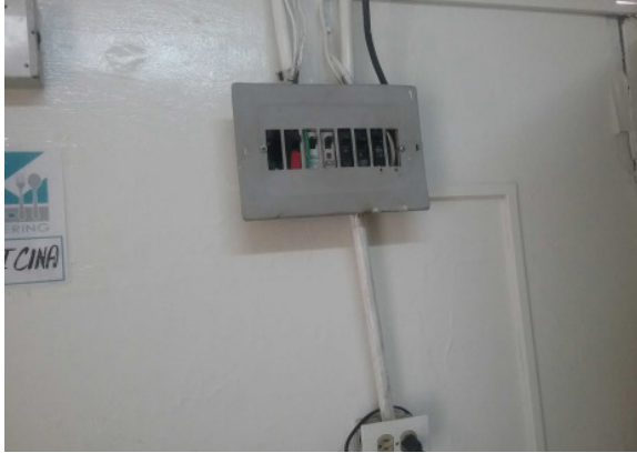
Ilustración 41. Tablero Fuente: Equipo Diagnóstico
