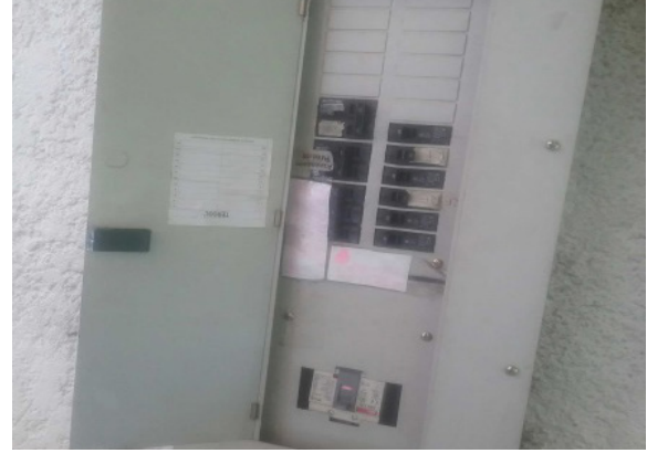
Ilustración 23. Tablero Fuente. Equipo Diagnóstico
