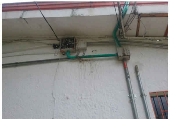
Ilustración 40. Tubería Fuente: Equipo Diagnóstico
