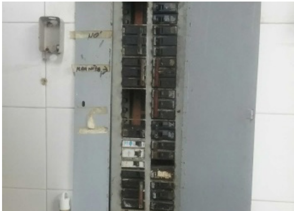
Ilustración 43. Tablero Fuente: Equipo Diagnóstico
