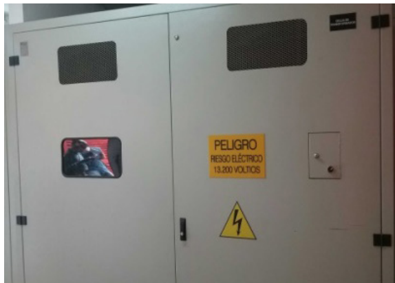
Ilustración 8. Subestación 4 (capsulada). Fuente: Equipo Diagnóstico
