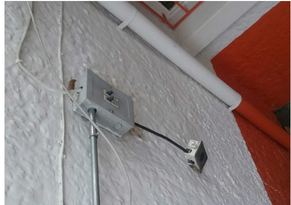
Ilustración 46. Tablero Fuente: Equipo Diagnóstico
