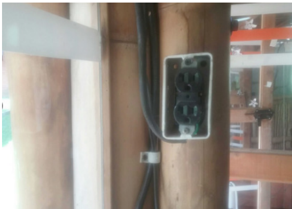
Ilustración 233. Tomacorriente suelto Fuente: equipo diagnóstico
