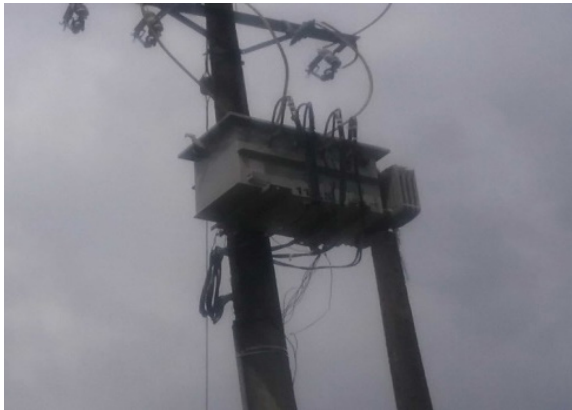
Ilustración 5. Subestación 1 Fuente: Equipo Diagnóstico
