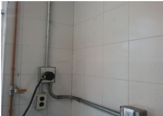
Ilustración 107. Tomacorrientes Fuente: Equipo Diagnóstico
