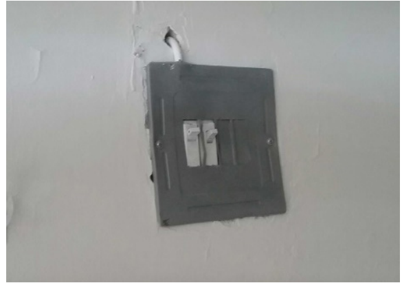
Ilustración 38. Tablero Fuente: Equipo Diagnóstico
