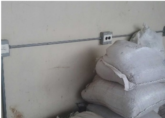
Ilustración 311: tomacorrientes bloque 100. Fuente: equipo de diagnóstico.
