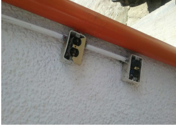
Ilustración 287: Tomacorrientes. Fuente: equipo de diagnóstico
