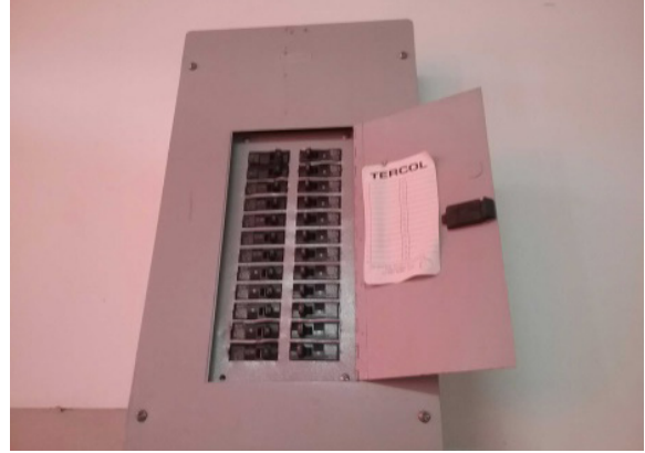
Ilustración 48. Tablero Fuente: Equipo Diagnóstico
