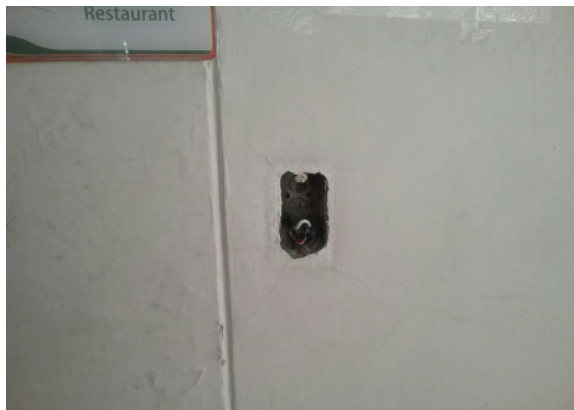
Ilustración 50. Conductores expuestos Fuente: Equipo Diagnóstico
