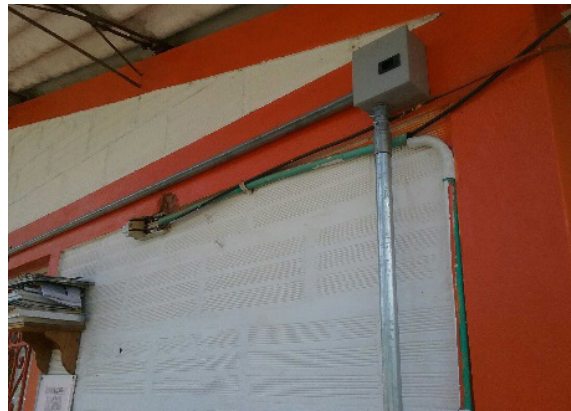
Ilustración 320: Seccionador. Fuente: equipo de diagnóstico.
