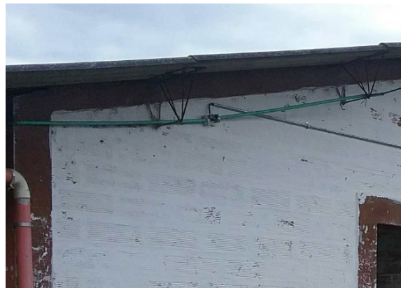
Ilustración 297 Tubería pvc expuesta, caja de paso sin tapa. Fuente: equipo de diagnóstico.
