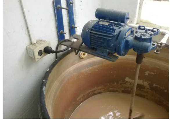
Ilustración 16. Bombas. Fuente: Equipo Diagnóstico.
