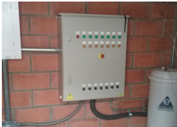
Ilustración 230. Tablero de control de bombas (Tubería emt sin marcar). Fuente: equipo diagnóstico.
