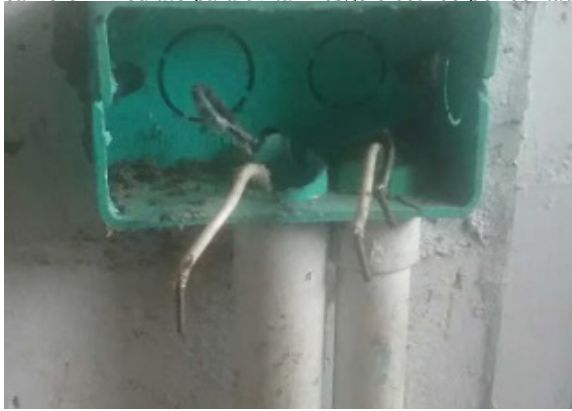
Ilustración 162. Tomacorriente bloque 36. Fuente: equipo diagnóstico
