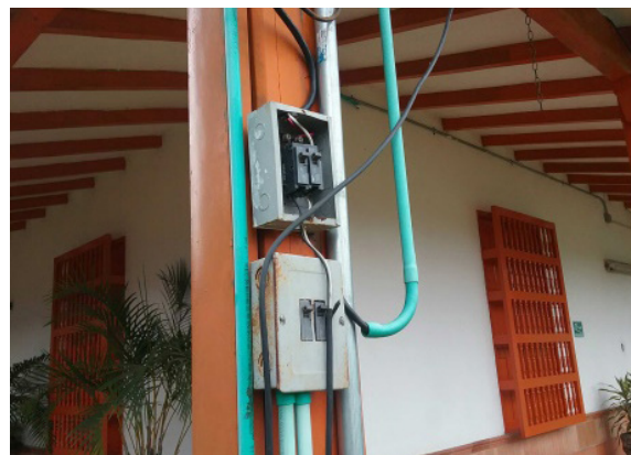
Ilustración 136. Bloque 26 Fuente: Equipo Diagnóstico
