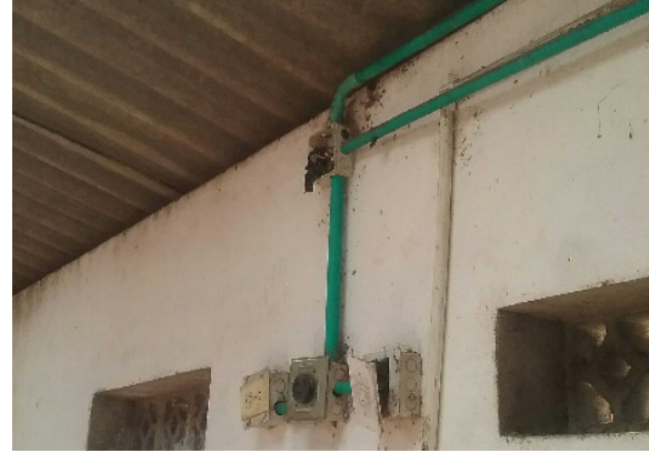
Ilustración 299: tomacorrientes bloque 95. Fuente: equipo de diagnóstico.
