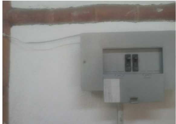
Ilustración 232. Tablero de distribución. Fuente: equipo diagnóstico
