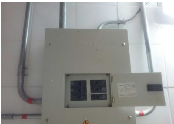
Ilustración 82. Tablero Fuente: Equipo Diagnóstico
