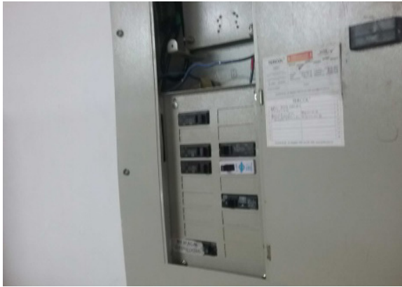
Ilustración 35. Tablero Fuente: Equipo Diagnóstico
