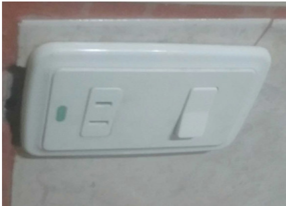
Ilustración 150. Tomacorriente cabaña. Fuente: equipo eléctrico
