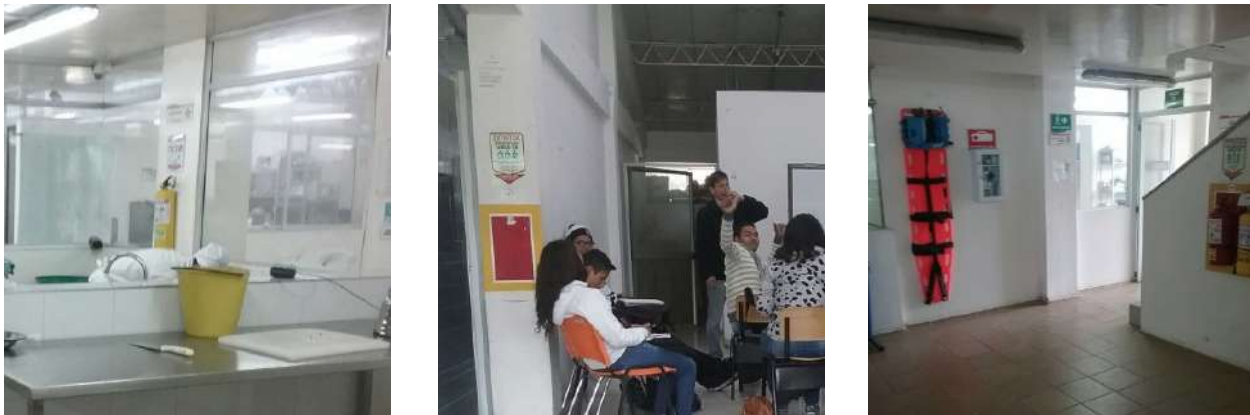
Ilustración 68. Elementos contraincendios, bloque 12. Fuente: Equipo de diagnóstico.
