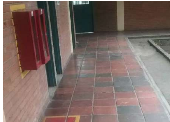
Ilustración 52. Elementos contraincendios bloque 11. Fuente: Equipo de diagnóstico.
