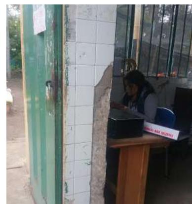
Ilustración 325. Estado actual, bloque 57. Fuente. Equipo de diagnóstico.
