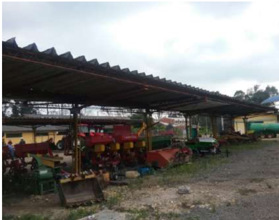
Ilustración 264. Estructura Bloque 68.B Fuente. Equipo de diagnóstico.
