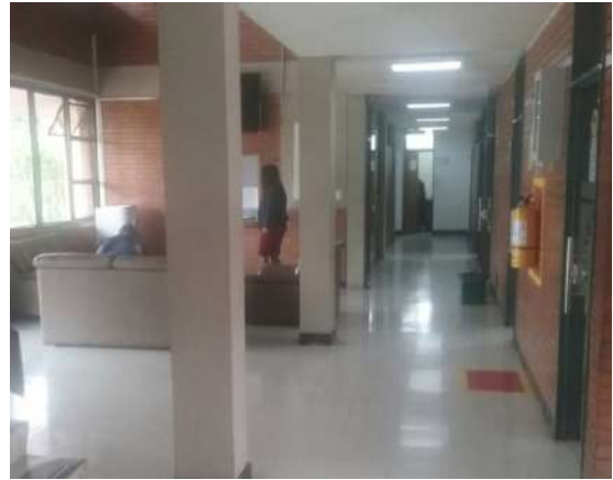
Ilustración 325. Elementos contraincendios, bloque 4. Fuente. Equipo de diagnóstico.
