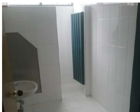
Ilustración 320. Espacios 24 y 25, bloque 4. Fuente. Equipo de diagnóstico.
