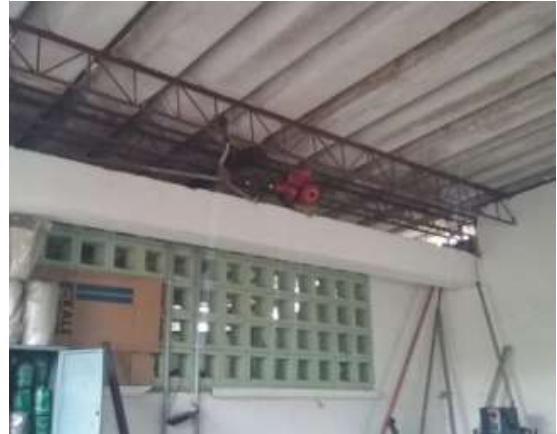
Ilustración 263. Estructura Bloque 68.A Fuente. Equipo de diagnóstico
