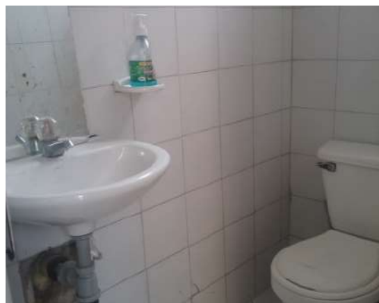
Ilustración 295. Espacios 2 y 6, bloque 1. Fuente. Equipo de diagnóstico.
