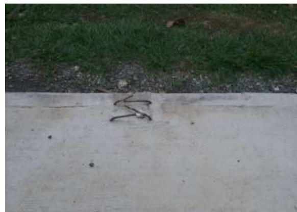
Ilustración 208. Evidencia de acero de refuerzo Fuente. Equipo de diagnóstico
