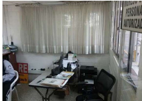
Ilustración 200. Drywall en mal estado bloque 22 Fuente. Equipo de diagnóstico
