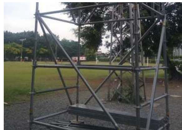
Ilustración 211. Estructura andamio tubular Fuente. Equipo de diagnóstico
