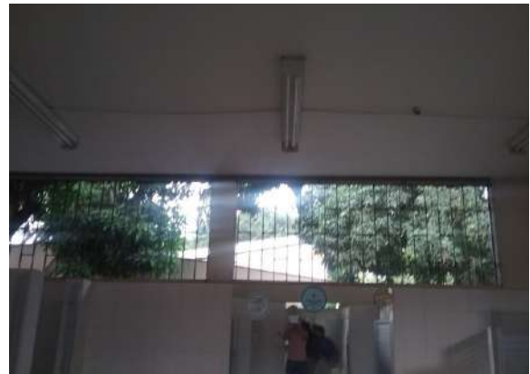
Ilustración 168. Mal instalación en perfilería de Drywall Fuente. Equipo de diagnóstico
