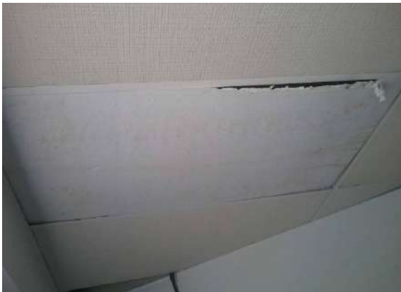
Ilustración 323. Imagen estado del cielos raso espacio 1. Fuente: Equipo diagnóstico
