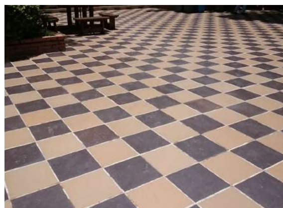
Ilustración 150. Placa de contrapiso Bloque 26 Fuente. Equipo de diagnóstico
