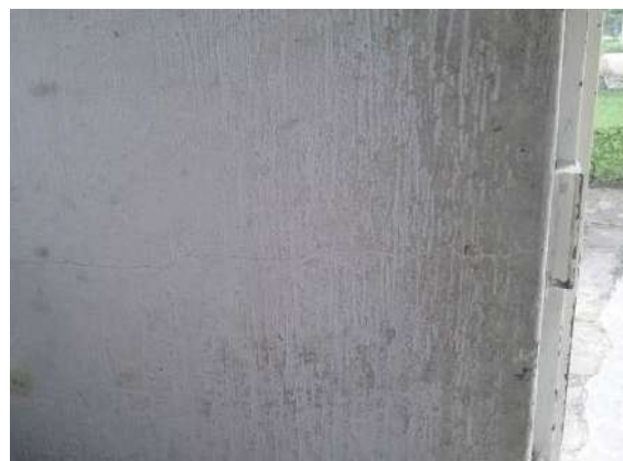
Ilustración 192 Estado de las paredes Fuente: Equipo de Diagnóstico
