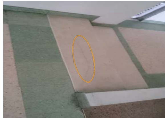
Ilustración 39. Evidencia fisuras en placa contraíso Bloque 2 Fuente. Equipo de diagnóstico
