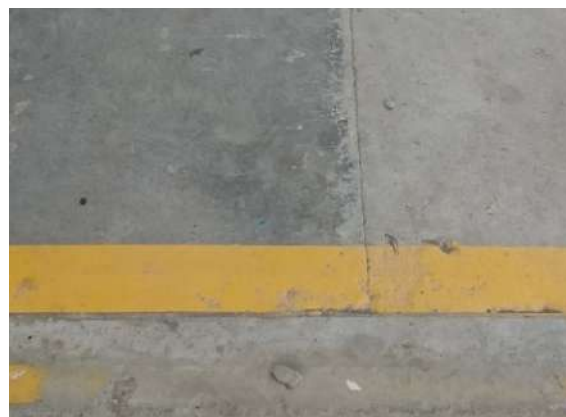
Ilustración 104. Placa de contrapiso Bloque 16 Fuente. Equipo de diagnóstico
