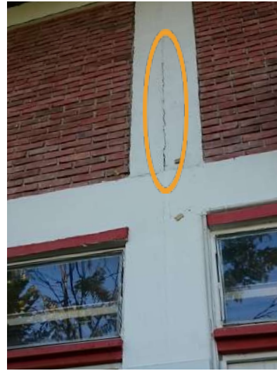
Ilustración 58. Fisura extendida Bloque 6 Fuente. Equipo de diagnóstico
