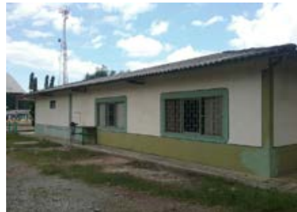
Ilustración 490. Bloque 129. Fuente. Equipo diagnóstico
