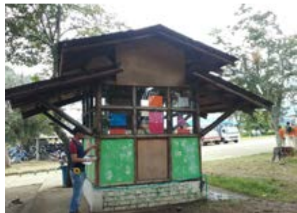
Ilustración 369. Bloque 105. Fuente. Equipo diagnóstico
