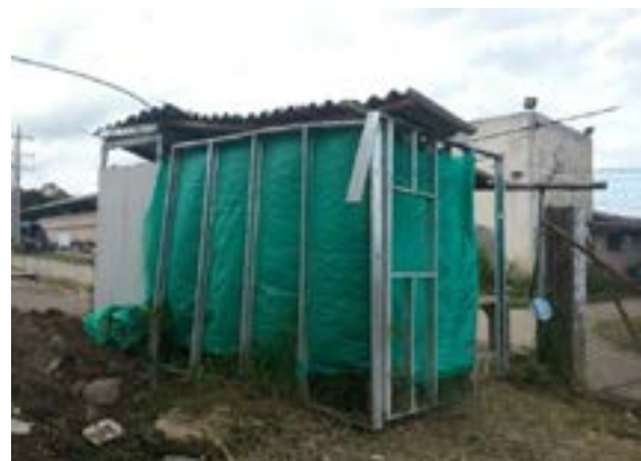
Ilustración 477. Bloque 126. Fuente. Equipo diagnóstico
