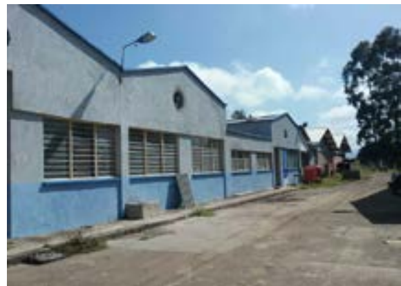
Ilustración 334. Bloque 102. Fuente. Equipo diagnóstico
