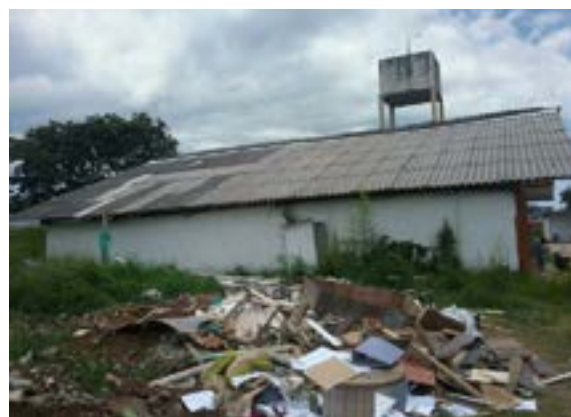
Ilustración 511. Bloque 133. Fuente. Equipo diagnóstico
