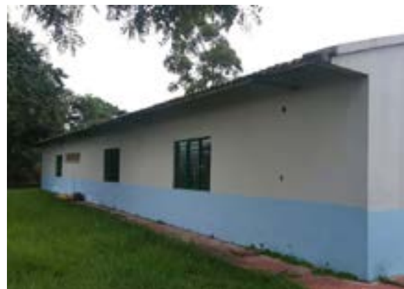
Ilustración 499. Bloque 130. Fuente. Equipo diagnóstico
