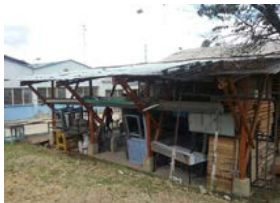
Ilustración 517. Bloque 134. Fuente. Equipo diagnóstico
