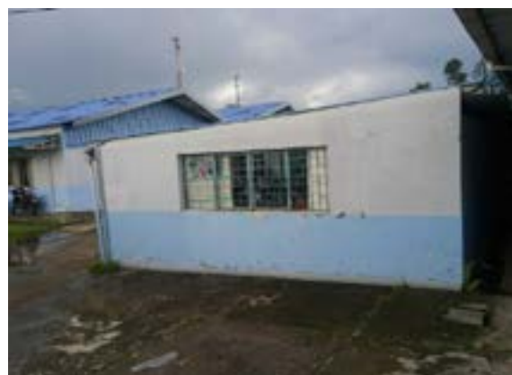
Ilustración 374. Bloque 107. Fuente. Equipo diagnóstico
