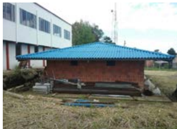
Ilustración 487. Bloque 128. Fuente. Equipo diagnóstico
