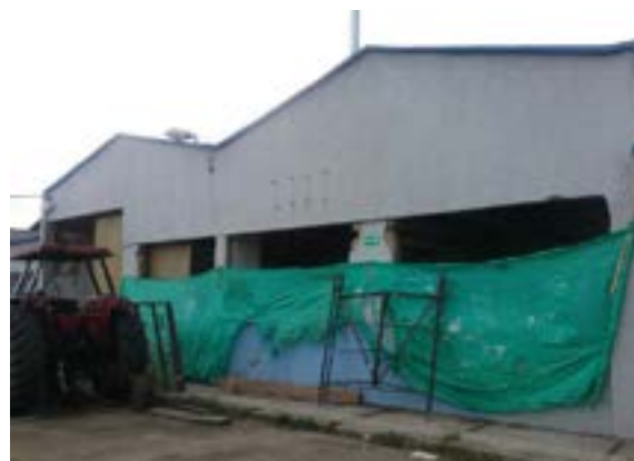
Ilustración 336. Bloque 102. Fuente. Equipo diagnóstico
