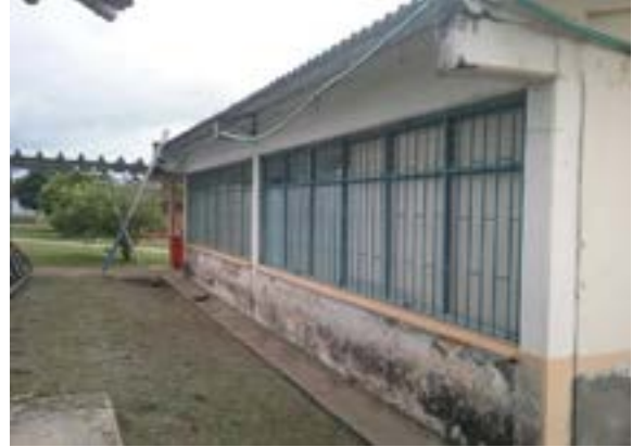
Ilustración 403. Bloque 110. Fuente. Equipo diagnóstico
