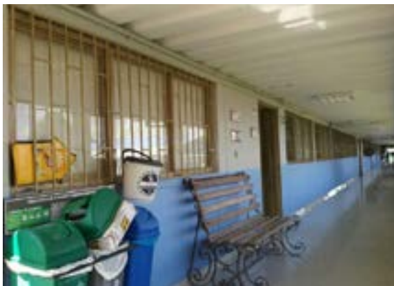
Ilustración 333. Bloque 102. Fuente. Equipo diagnóstico
