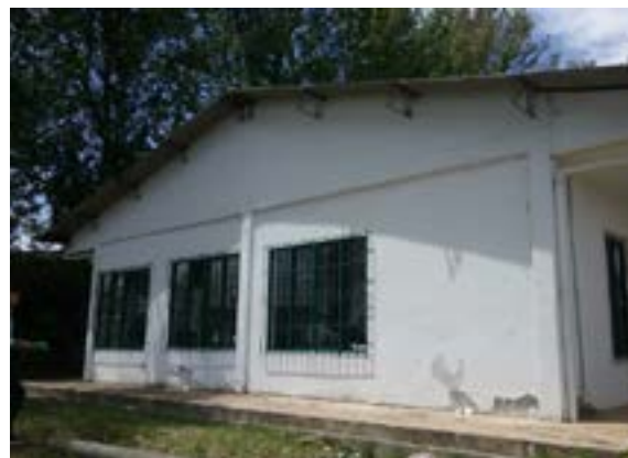
Ilustración 479. Bloque 127. Fuente. Equipo diagnóstico
