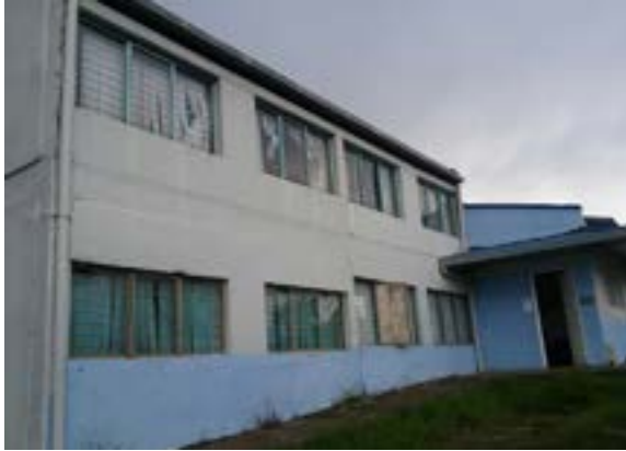
Ilustración 306. Bloque 101. Fuente. Equipo diagnóstico
