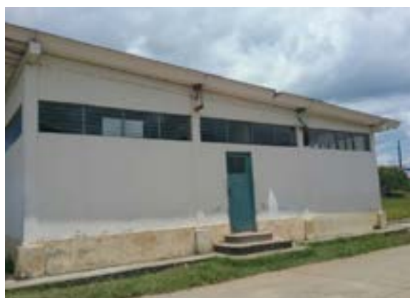
Ilustración 519. Bloque 136. Fuente. Equipo diagnóstico
