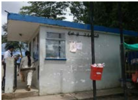
Ilustración 360. Bloque 103. Fuente. Equipo diagnóstico
