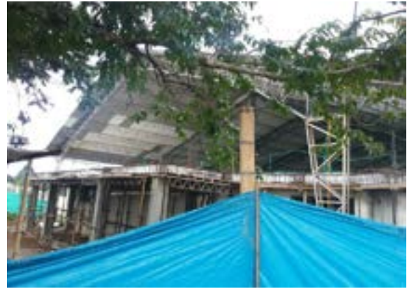
Ilustración 465. Bloque 123. Fuente: Equipo diagnóstico
