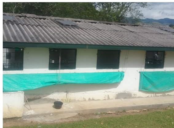
Ilustración 321. Fachadas Bloque 42 Fuente. Equipo de diagnóstico
