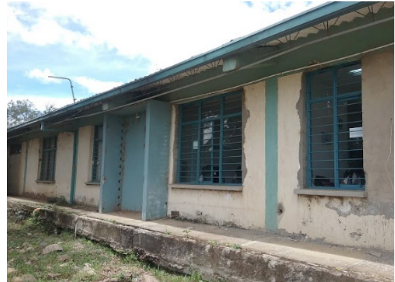
Ilustración 139. Deterioro estructura Bloque 122 Fuente. Equipo de diagnóstico
