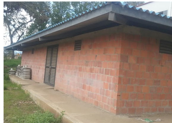
Ilustración 160. Fachadas Bloque 128 Fuente. Equipo de diagnóstico
