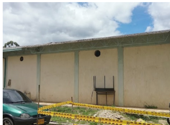
Ilustración 137. Fachadas Bloque 122 Fuente. Equipo de diagnóstico
