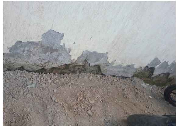
Ilustración 144. Deterioro estructura interior bloque 123 Fuente. Equipo de diagnóstico
