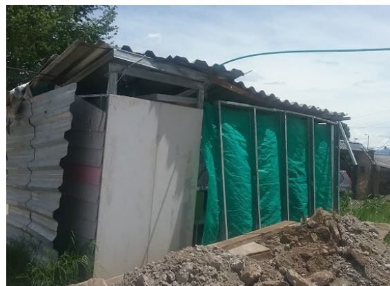
Ilustración 154. Fachadas bloque 126 Fuente. Equipo de diagnóstico
