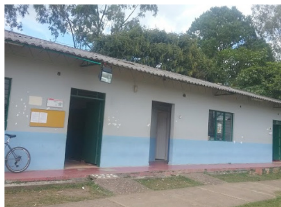
Ilustración 167. Fachadas Bloque 130. Fuente. Equipo de diagnóstico
