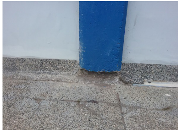
Ilustración 51 Evidencia de no tener continuidad en la estructura Fuente. Equipo de diagnóstico
