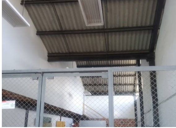
Ilustración 58 Evidencia de signos de humedad y fisuras en elementos no estructurales Fuente. Equipo de diagnóstico
