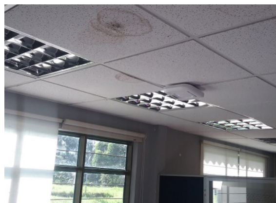
Ilustración 82 Elementos no estructurales en mal estado Fuente. Equipo de diagnóstico
