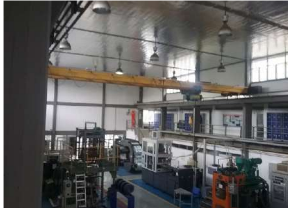
Ilustración 49. Cubierta Asbesto Cemento con estructura con vigas de concreto Fuente. Equipo de diagnóstico
