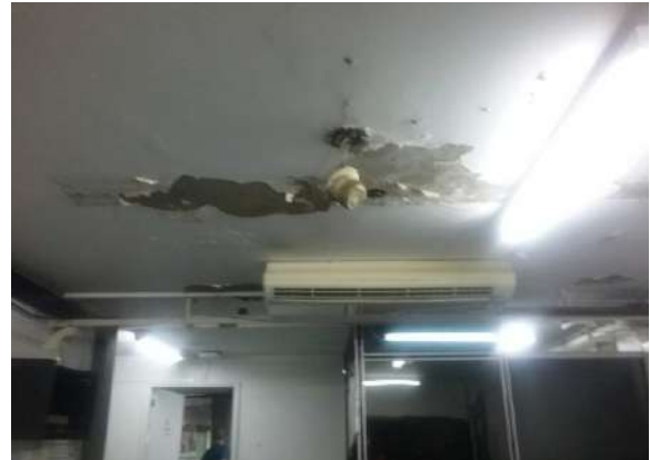
Ilustración 154. Presencia de fisuras y signos de humedad Fuente. Equipo de diagnóstico
