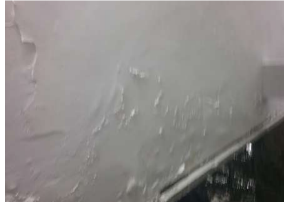
Ilustración 145. Presencia de signos de humedad Fuente. Equipo de diagnóstico
