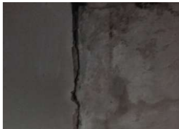
Ilustración 120. Presencia signos de humedad en losa maciza Fuente. Equipo de diagnóstico
