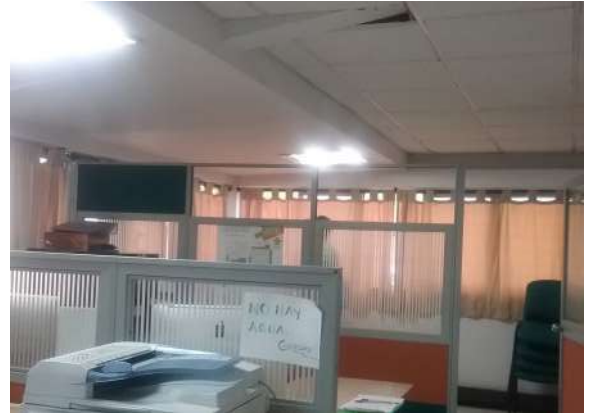
Ilustración 87. Perfilería de Drywall en mal estado Fuente. Equipo de diagnóstico
