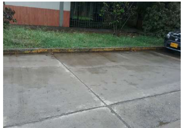
Ilustración 64. Fisuras en andén frontal y pavimento Fuente. Equipo de diagnóstico
