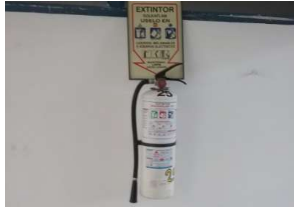
Ilustración 61. Gabinetes y extintores, sin presencia de red contraincendios. Fuente. Equipo de diagnóstico
