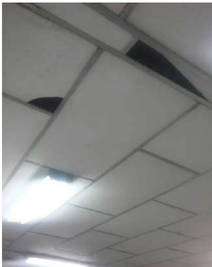
Ilustración 146. Falta de mantenimiento en periferia de Drywall Fuente. Equipo de diagnóstico
