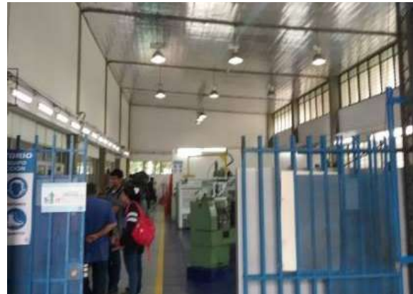
Ilustración 59. Cubierta Asbesto Cemento Fuente. Equipo de diagnóstico
