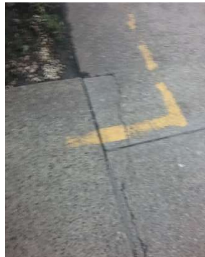
Ilustración 147. Presencia de fisuras en andén Fuente. Equipo de diagnóstico
