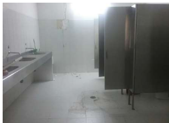
Ilustración 86. Evidencia de fisuras en placa de contrapiso y muro Fuente. Equipo de diagnóstico
