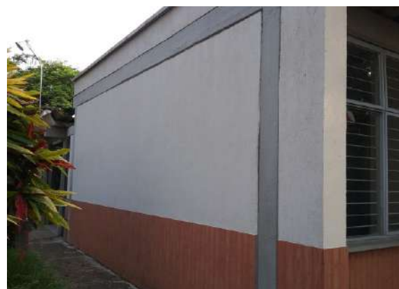
Ilustración 73. Fachadas Bloque 4 Fuente. Equipo de diagnóstico
