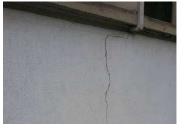
Ilustración 55. fisuras y/o grietas en elementos estructurales Fuente. Equipo de diagnóstico
