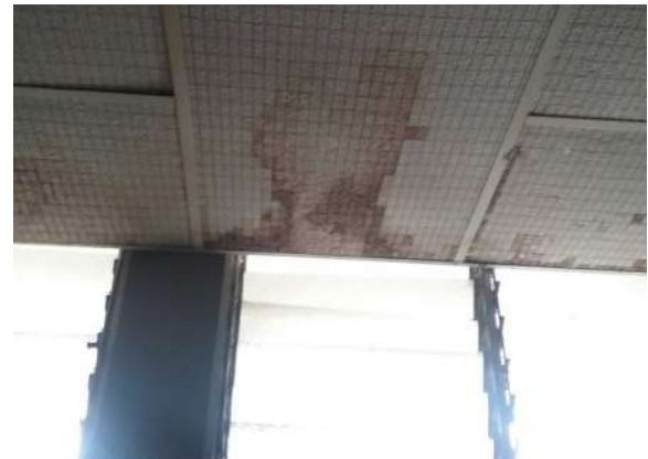
Ilustración 157. Presencia signos de humedad en elementos no estructurales Fuente. Equipo de diagnóstico
