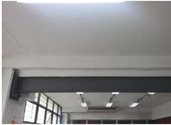
Ilustración 56. Presencia Signos de humedad en la estructura Fuente. Equipo de diagnóstico
