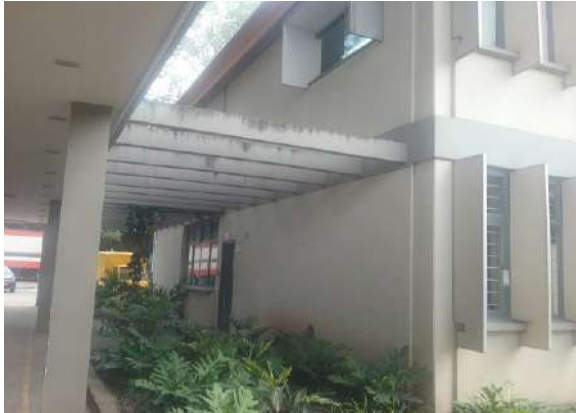
Ilustración 144. Placa de entrepiso Bloque 13 Fuente. Equipo de diagnóstico
