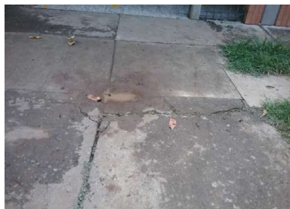
Ilustración 78. Fisuras andén y pavimentó en Bloque 4 y 5 Fuente. Equipo de diagnóstico
