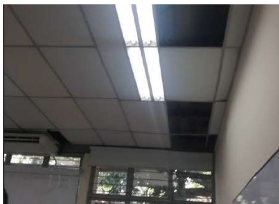
Ilustración 77. Mal procedimiento constructivo Bloque 4 y 5 Fuente. Equipo de diagnóstico
