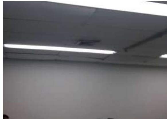
Ilustración 123. Perfilería en Drywall en deterioro Fuente. Equipo de diagnóstico
