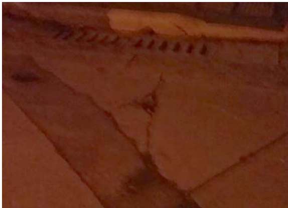
Ilustración 156. Presencia de fisuras en andén Fuente. Equipo de diagnóstico
