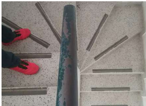
Ilustración 100. Las dimensiones de las escaleras no cumplen con lo estipulado en la norma NSR-10 Fuente. Equipo de diagnóstico
