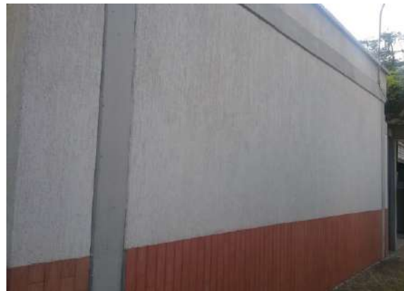
Ilustración 74. Fachadas bloque 5 Fuente. Equipo de diagnóstico
