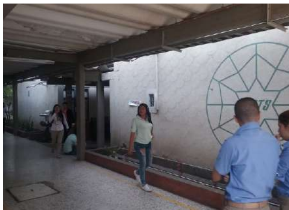
Ilustración 81. Presencia signos de humedad en teja asbesto cemento bloque 5 Fuente. Equipo de diagnóstico
