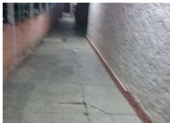
Ilustración 112. Evidencia de fisuras en placa de contrapiso y andén Fuente. Equipo de diagnóstico
