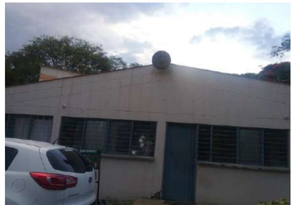
Ilustración 89. Teja de barro en los bordes de la fachada principal Fuente. Equipo de diagnóstico
