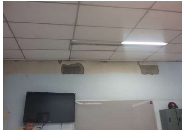
Ilustración 80. Signos de humedad bloque 5 Fuente. Equipo de diagnóstico
