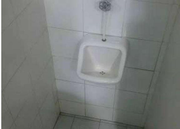
Ilustración 373. Punto Hidráulico en PVCP en 1/2". Fuente. Equipo de diagnóstico
