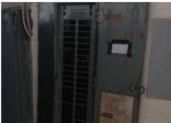
Ilustración 222. Tablero Fuente. Equipo de diagnóstico
