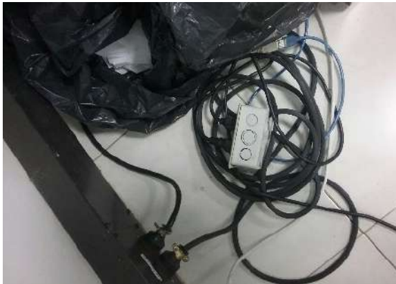
Ilustración 263. tomacorriente Fuente. Equipo de diagnóstico
