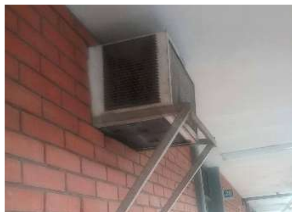
Ilustración 212. condensadora Fuente. Equipo de diagnóstico
