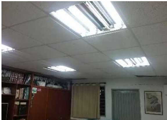
Ilustración 173. luminarias Fuente. Equipo de diagnóstico
