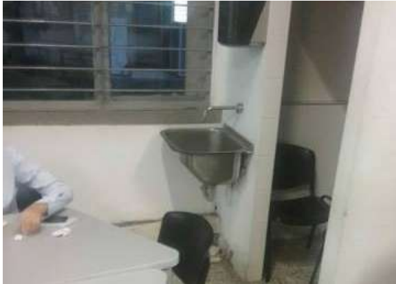
Ilustración 366. Sifón de lavamanos en PVC en 2°. Fuente. Equipo de diagnóstico
