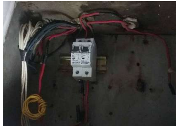
ilustración 277. tablero Fuente. Equipo de diagnóstico
