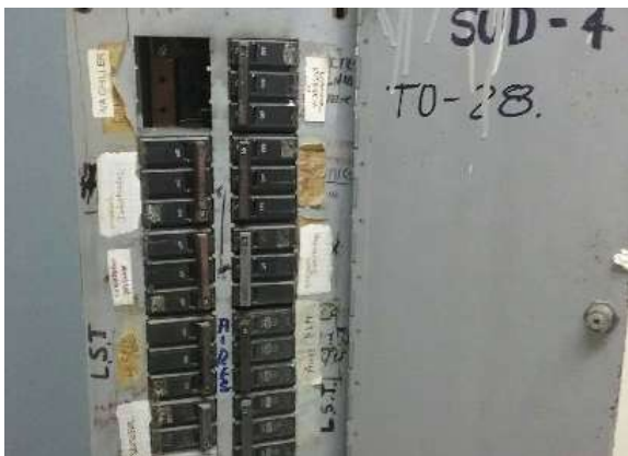
Ilustración 232. Tablero Fuente. Equipo de diagnóstico
