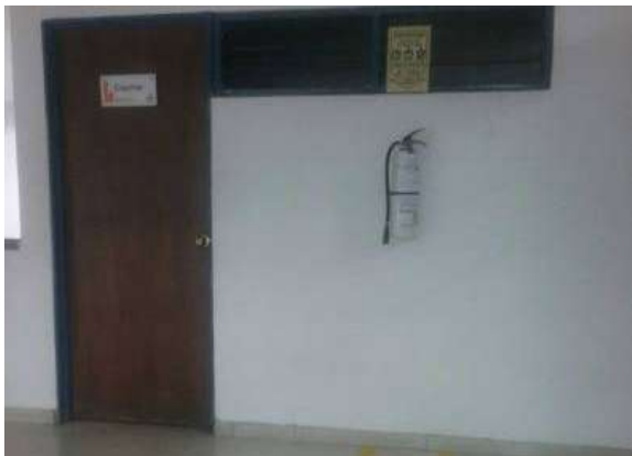
Ilustración 357. Extintor tipo Solkaflam. Fuente. Equipo de diagnóstico
