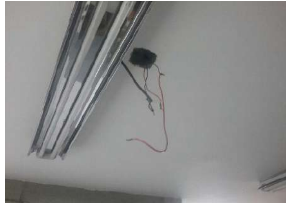
Ilustración 219. luminarias Fuente. Equipo de diagnóstico
