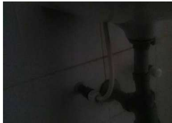
Ilustración 351. Salida en PVCP en 1/2". Fuente. Equipo de diagnóstico
