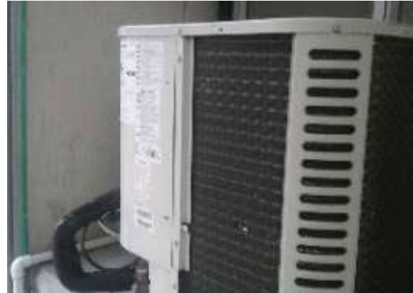
Ilustración 251. condensadoras Fuente. Equipo de diagnóstico
