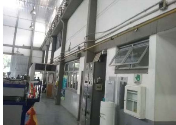
Ilustración 347. Red de gas que pasa el taller en 1". Fuente. Equipo de diagnóstico
