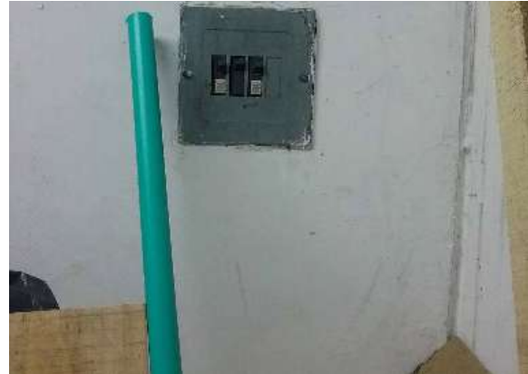
Ilustración 269. tablero Fuente. Equipo de diagnóstico
