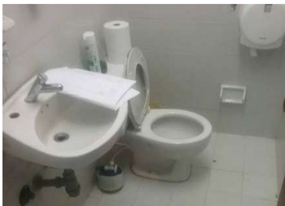
Ilustración 353. Sifón lavamanos en PVCS en 2". Fuente. Equipo de diagnóstico
