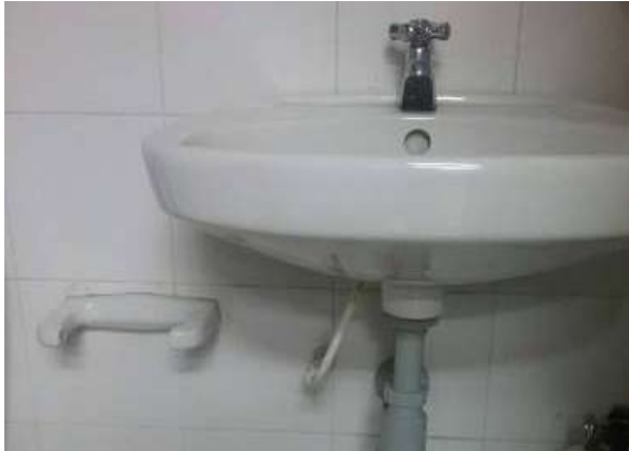
Ilustración 359. Lavamanos baño. Fuente. Equipo de diagnóstico
