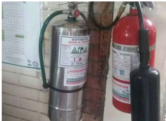
Ilustración 384. Extintores ubicados en el interior del bloque 7. Fuente: equipo de diagnóstico.
