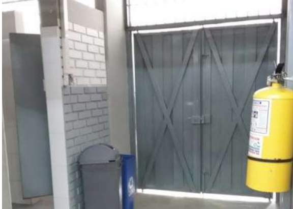
Ilustración 401. Extintor tipo multipropósito. Fuente. Equipo de diagnóstico
