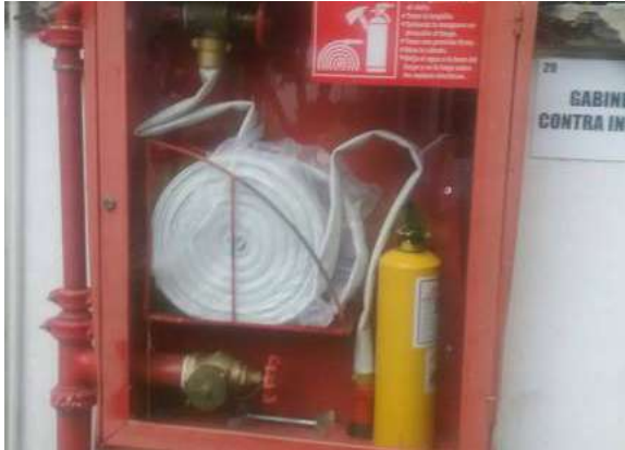
Ilustración 355. Gabinete tipo 3. Fuente. Equipo de diagnóstico
