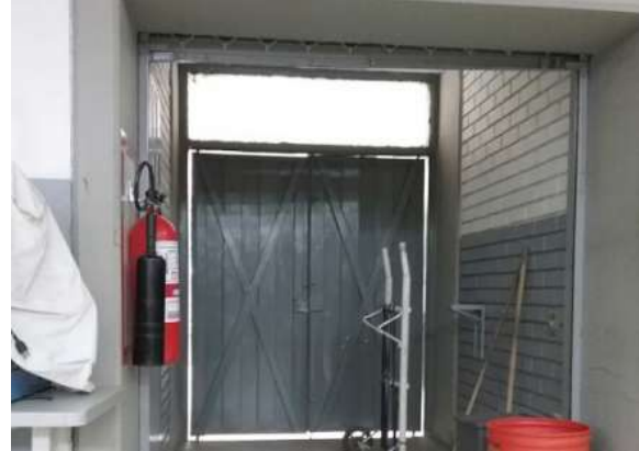
Ilustración 402. Extintor tipo CO2. Fuente. Equipo de diagnóstico
