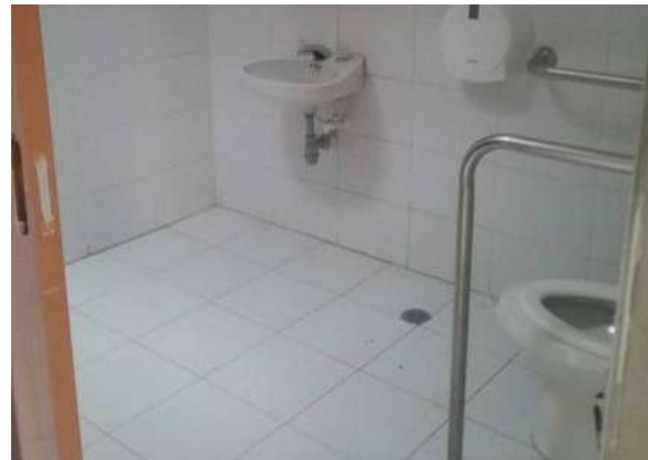
Ilustración 459. Sifón de piso y lavamanos en PVCs. Fuente. Equipo de diagnóstico
