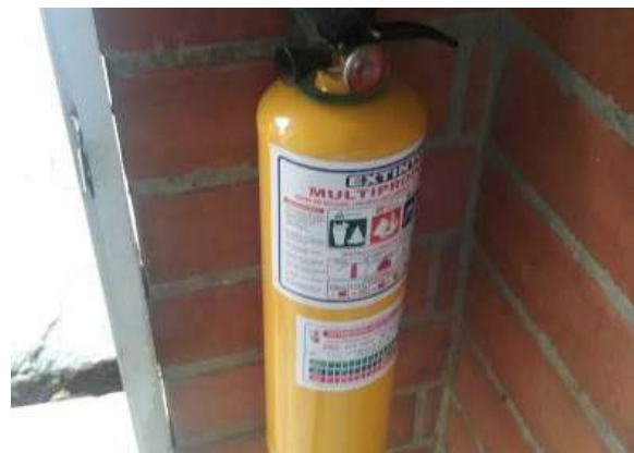
Ilustración 344. Extintor tipo multipropósito. Fuente. Equipo de diagnóstico
