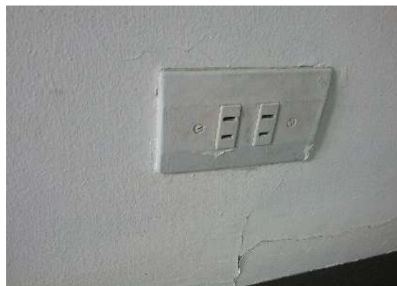
Ilustración 153. Tomacorriente Fuente. Equipo de diagnóstico
