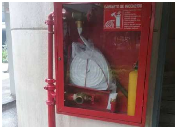
Ilustración 414. Gabinete tipo 3, con sus elementos completos. Fuente: equipo de diagnóstico.
