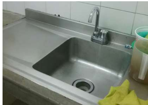
Ilustración 427. Lavaplatos tipo llave en mal estado. Fuente. Equipo de diagnóstico
