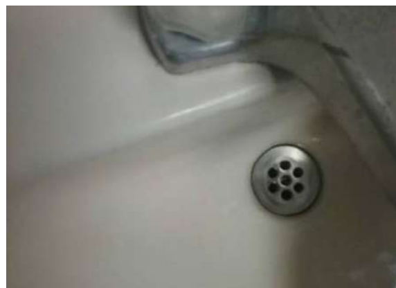
Ilustración 443. Rejilla de Sifón de lavamanos. Fuente. Equipo de diagnóstico
