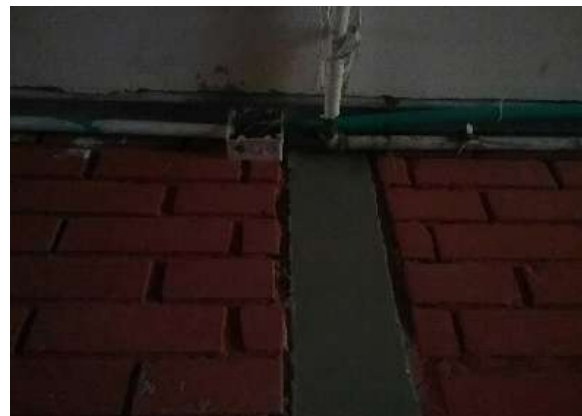
Ilustración 208. Tubería pvc. Fuente. Equipo de diagnóstico
