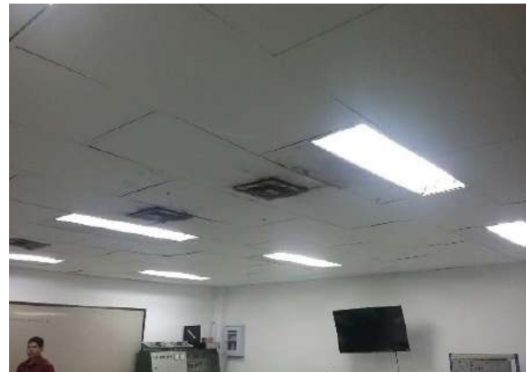
Ilustración 239. luminarias Fuente. Equipo de diagnóstico
