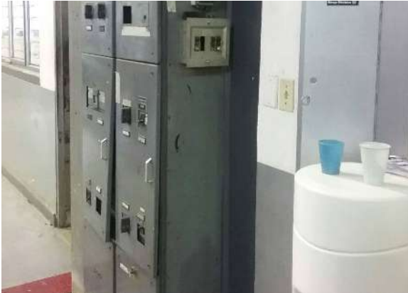
Ilustración 117. Tablero general. Fuente. Equipo de diagnóstico
