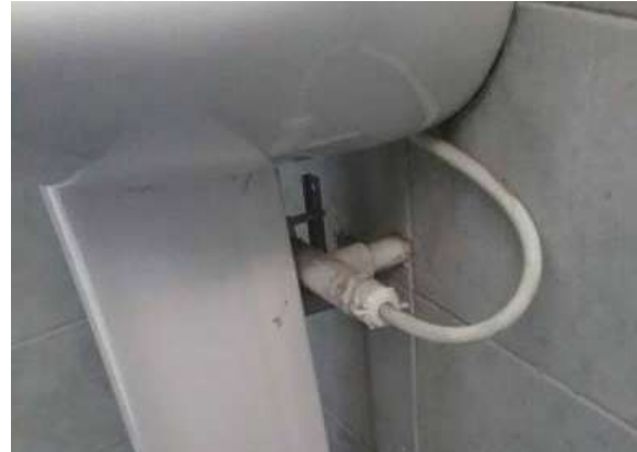
Ilustración 337. Salida en PVC de diámetro de 1/2". Fuente. Equipo de diagnóstico
