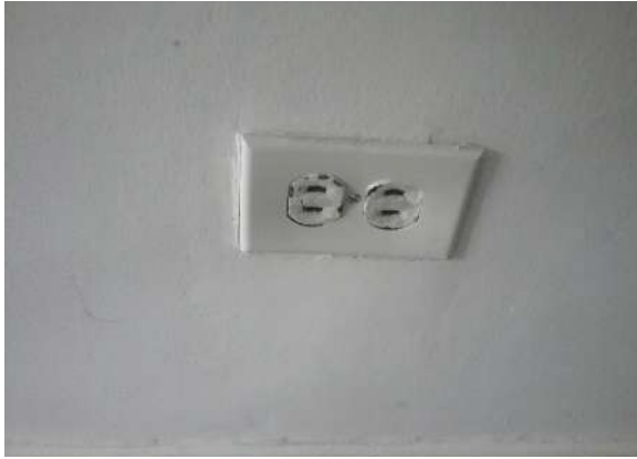
Ilustración 224. tomacorriente Fuente. Equipo de diagnóstico
