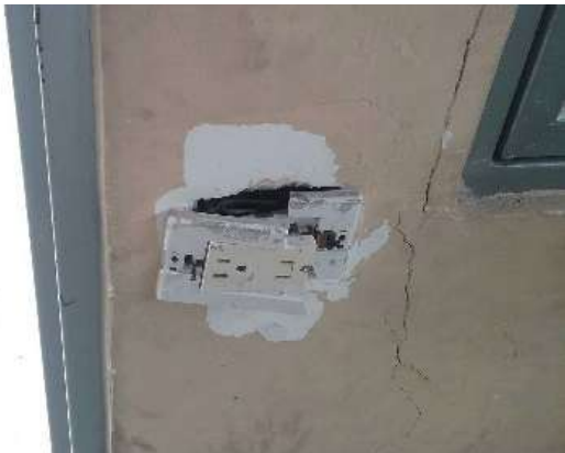
Ilustración 121. tomacorriente Fuente. Equipo de diagnóstico
