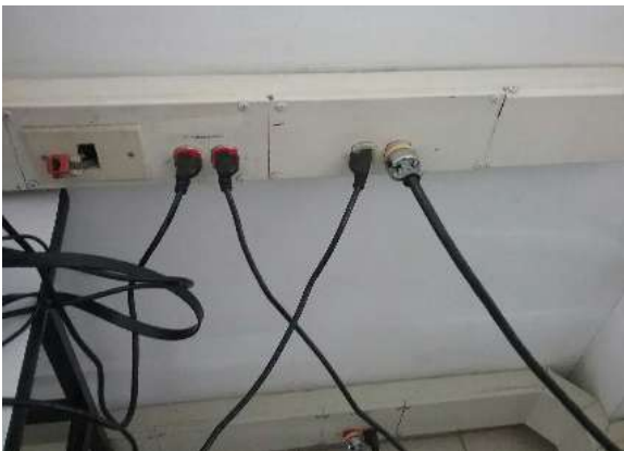
Ilustración 236. tomacorriente Fuente. Equipo de diagnóstico
