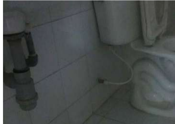
Ilustración 340. Sifón de lavamanos en 2" de PVCS. Fuente. Equipo de diagnóstico
