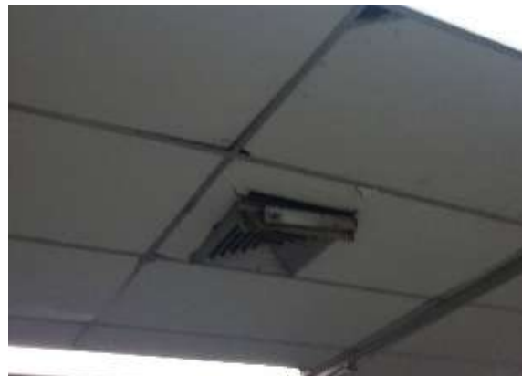
Ilustración 210. luminarias Fuente. Equipo de diagnóstico
