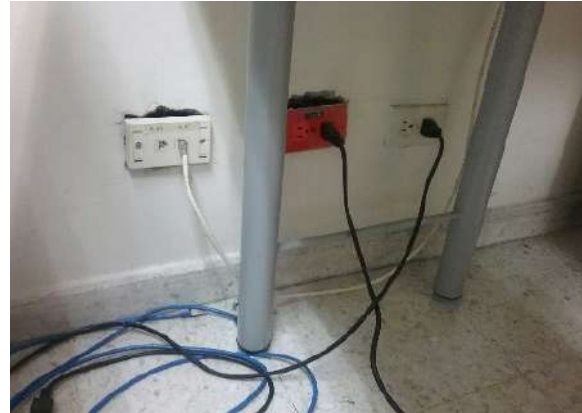
Ilustración 146. Tomacorriente Fuente. Equipo de diagnóstico
