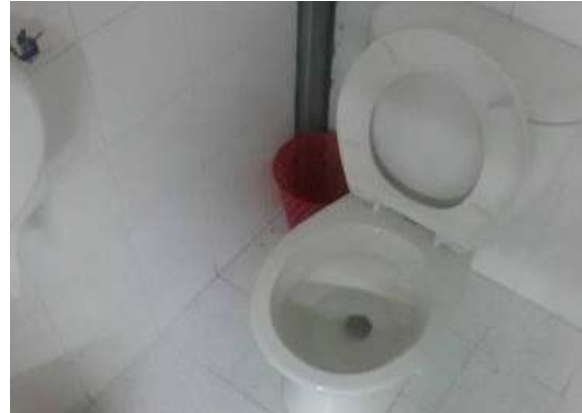
Ilustración 360. Retretes baño. Fuente. Equipo de diagnóstico
