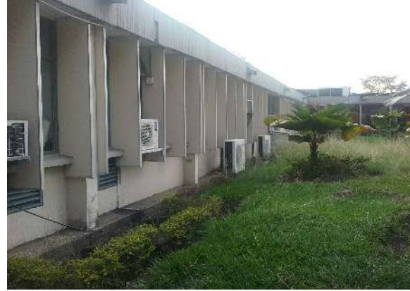
Ilustración 306. Conductores expuestos. Fuente. Equipo de diagnóstico
