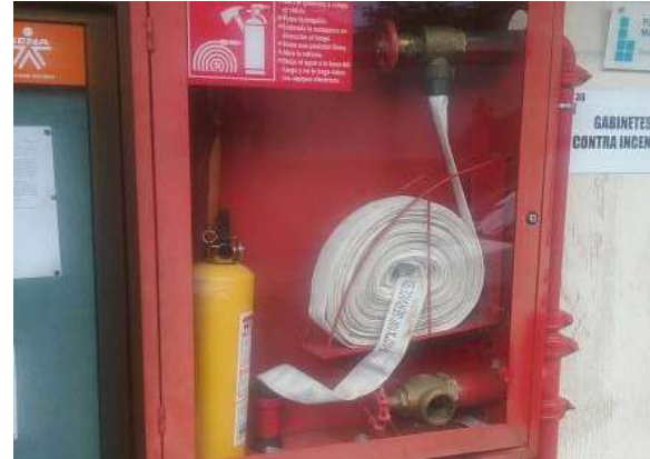
Ilustración 356. Gabinete tipo 3. Fuente. Equipo de diagnóstico
