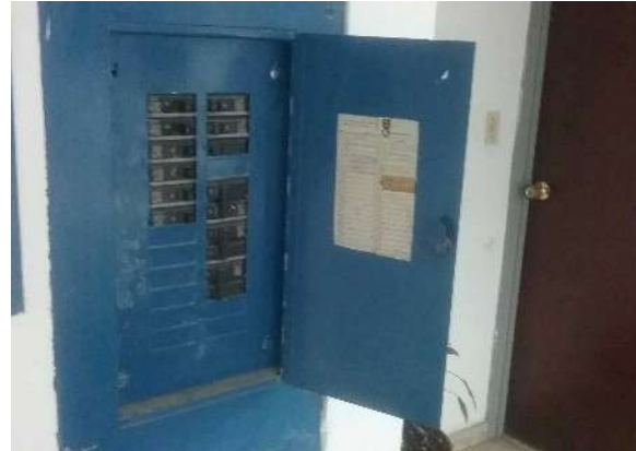
Ilustración 131. tablero de distribución Fuente. Equipo de diagnóstico
