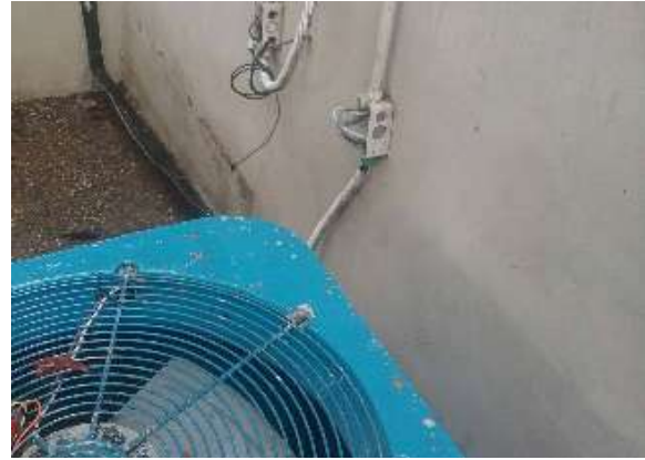
Ilustración 225. Tomacorriente Fuente. Equipo de diagnóstico
