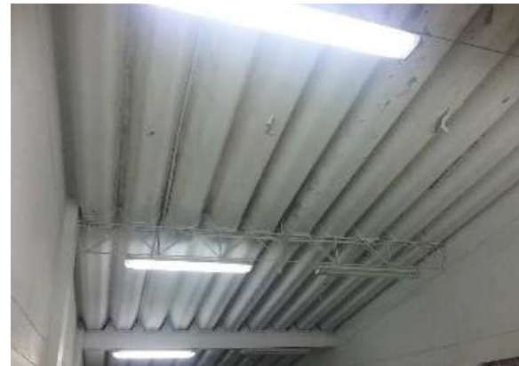
Ilustración 174. luminarias Fuente. Equipo de diagnóstico
