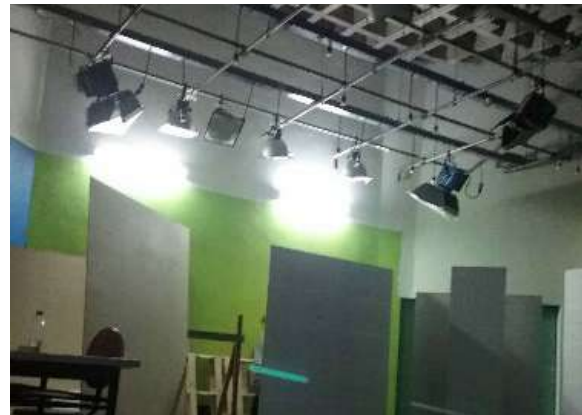
Ilustración 203. luminarias Fuente. Equipo de diagnóstico
