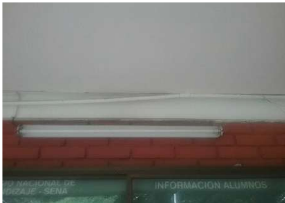
Ilustración 209. luminarias Fuente. Equipo de diagnóstico
