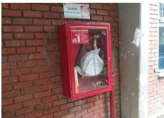
Ilustración 399. Gabinete tipo 3, con sus elementos completos. Fuente. Equipo de diagnóstico
