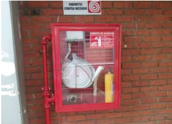
Ilustración 391. Gabinete Tipo 3, en el exterior del bloque 10. Fuente. Equipo de diagnóstico
