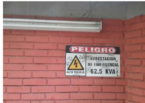
Ilustración 291. Subestación Fuente. Equipo de diagnóstico
