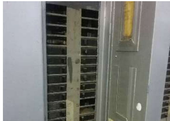
Ilustración 120 tablero Fuente. Equipo de diagnóstico
