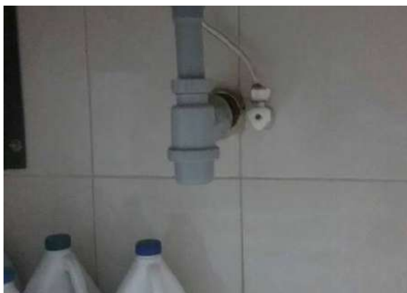
Ilustración 442. Sifón de lavamanos en PVC de 2". Fuente. Equipo de diagnóstico
