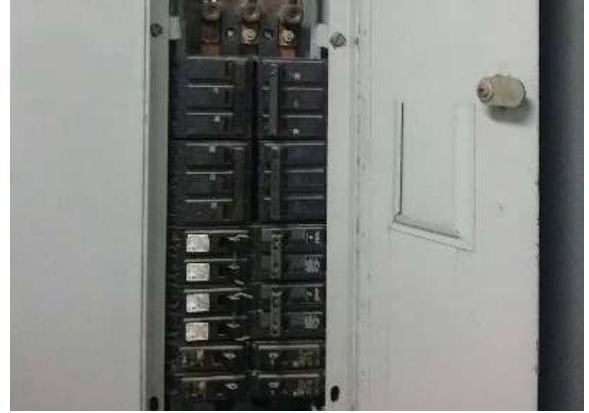
Ilustración 235. tablero Fuente. Equipo de diagnóstico
