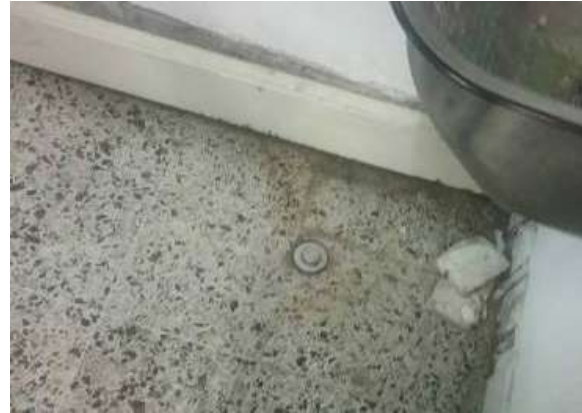
Ilustración 367. Sifón de piso en aluminio en 1°. Fuente. Equipo de diagnóstico
