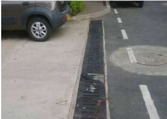
Ilustración 320. Sumidero transversal con rejilla en concreto. Fuente. Equipo de diagnóstico
