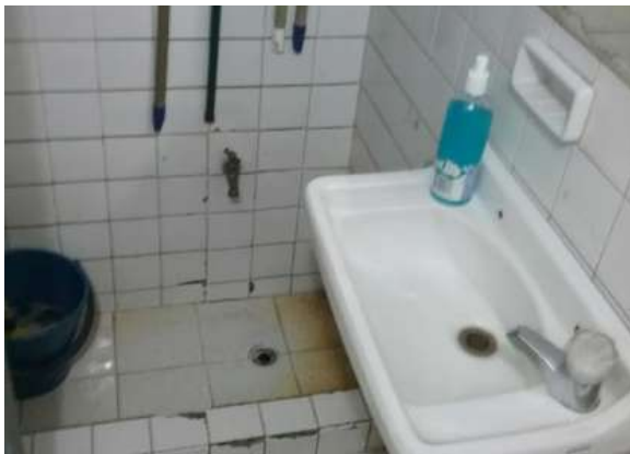
Ilustración 426. Lavamanos de llave en mal estado. Fuente. Equipo de diagnóstico
