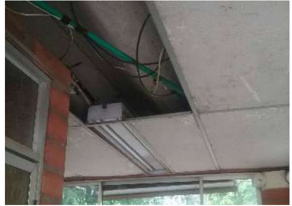
Ilustración 288. luminarias Fuente. Equipo de diagnóstico
