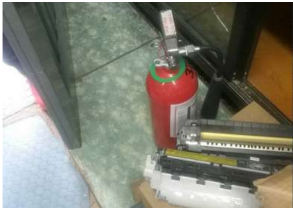
Ilustración 424. Extintor tipo CO2 en el suelo. Fuente. Equipo de diagnóstico
