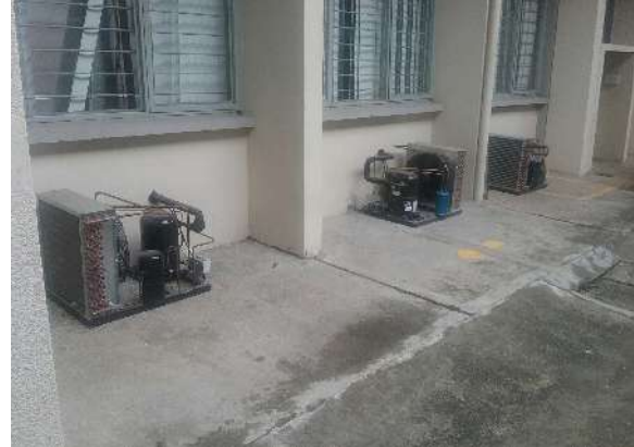
Ilustración 196. condensadoras Fuente. Equipo de diagnóstico
