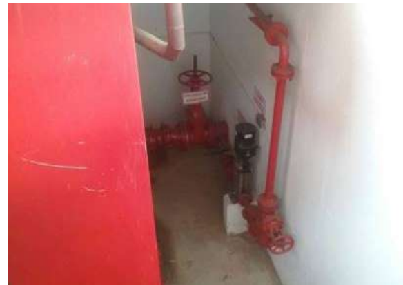
Ilustración 327. Red contra incendio. Fuente. Equipo de diagnóstico
