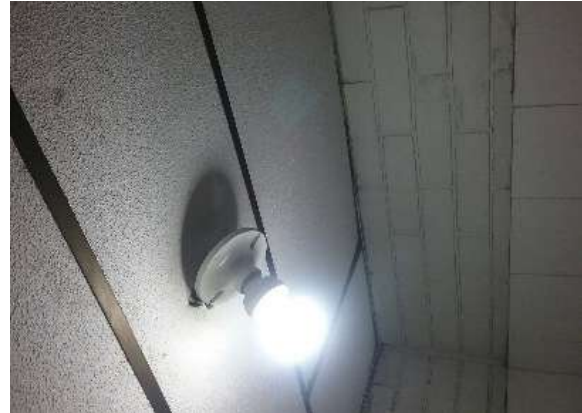
Ilustración 184. luminarias Fuente. Equipo de diagnóstico
