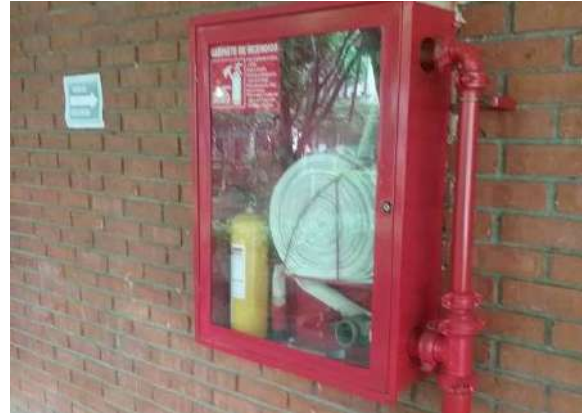
Ilustración 392. Gabinete Tipo 3, en el exterior del bloque 10. Fuente. Equipo de diagnóstico
