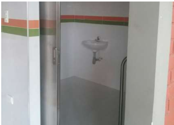
Ilustración 458. Sifón de lavamanos en PVCs de 2". Fuente. Equipo de diagnóstico
