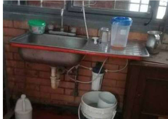
Ilustración 383. Sifón de lavaplatos en PVC de 2". mal estado. Fuente. Equipo de diagnóstico
