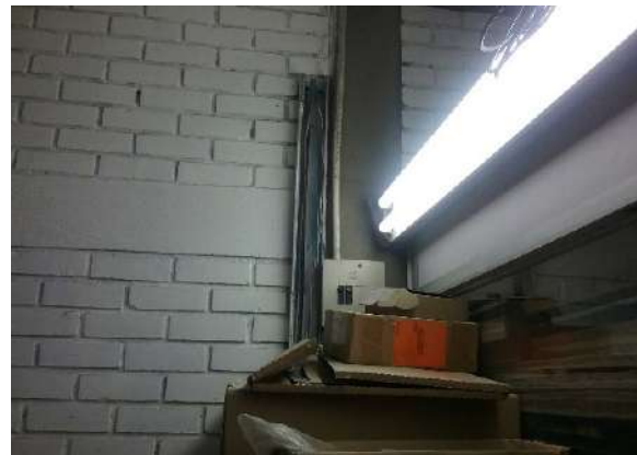
Ilustración 261. tablero Fuente. Equipo de diagnóstico
