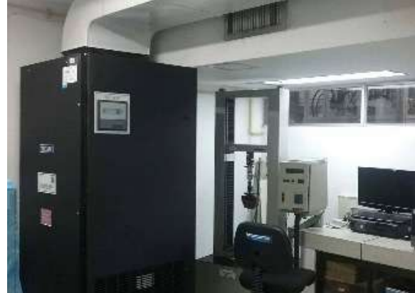
Ilustración 128. Aires acondicionado central Fuente. Equipo de diagnóstico
