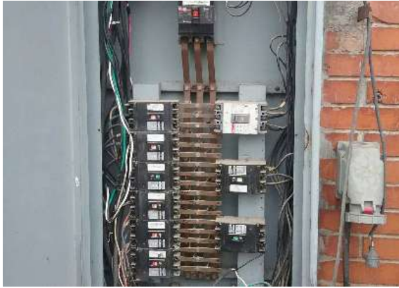
Ilustración 176. Tablero Fuente. Equipo de diagnóstico
