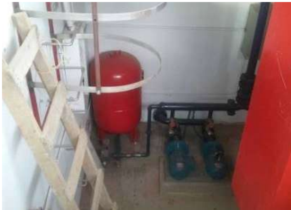
Ilustración 326. Equipo de bombeo contra incendio. Fuente. Equipo de diagnóstico
