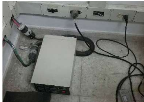
Ilustración 122. Tomacorriente Fuente. Equipo de diagnóstico
