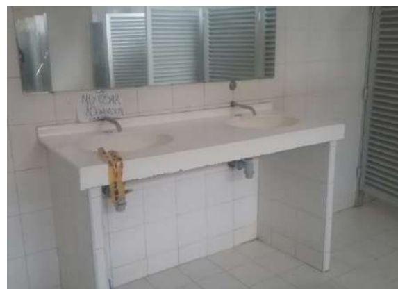
Ilustración 437. Sifón de lavamanos en PVCS de 2". Fuente. Equipo de diagnóstico
