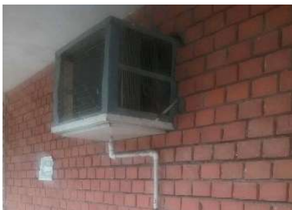
Ilustración 211. condensadora Fuente. Equipo de diagnóstico
