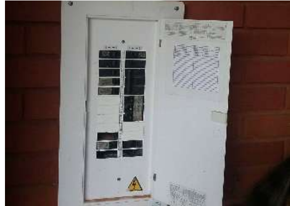
Ilustración 214. tablero Fuente. Equipo de diagnóstico
