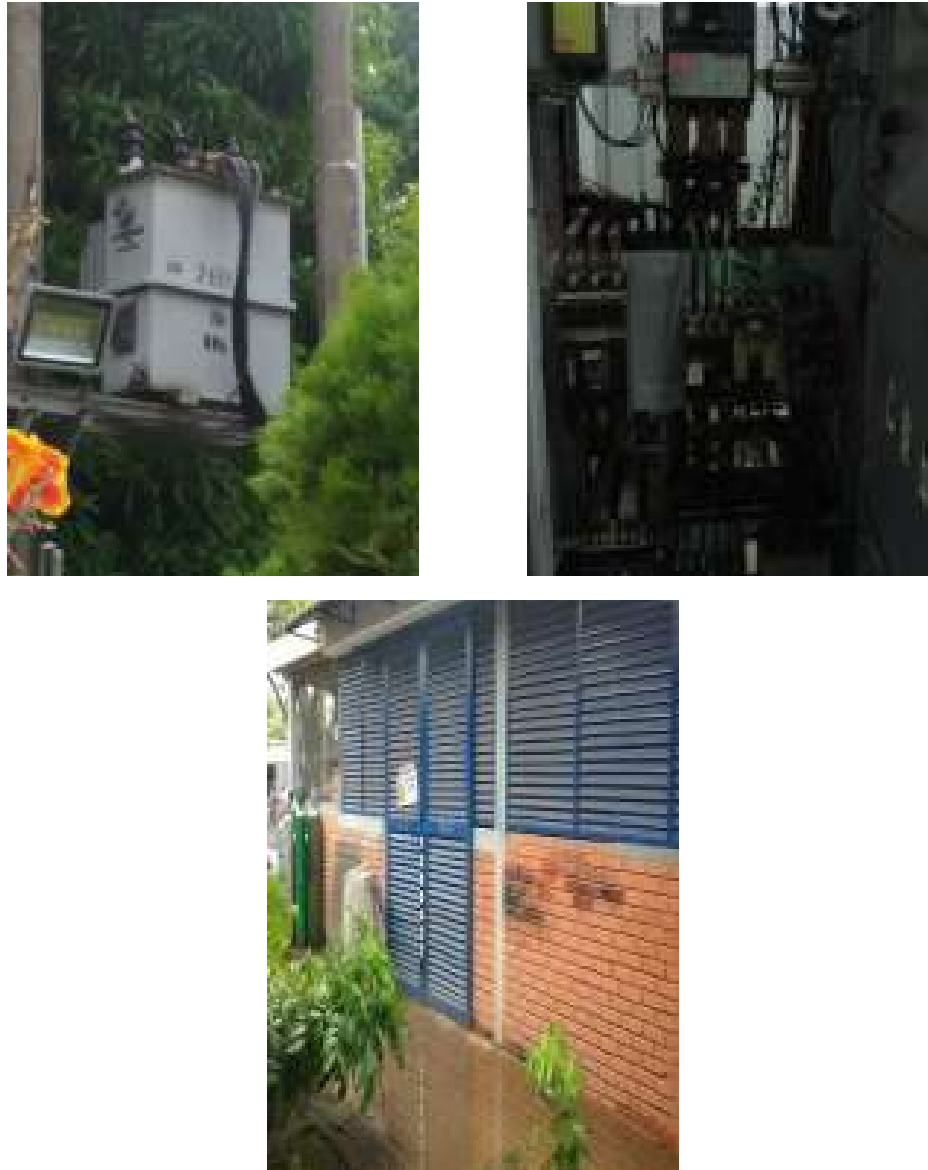
Ilustración 115. subestación. Fuente Fuente: Equipo diagnóstico.
