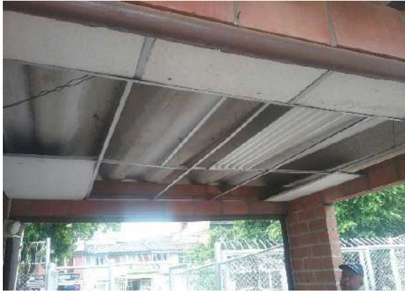
Ilustración 282. luminarias Fuente. Equipo de diagnóstico
