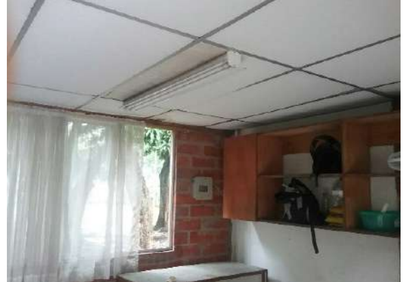
Ilustración 279. Luminarias Fuente. Equipo de diagnóstico
