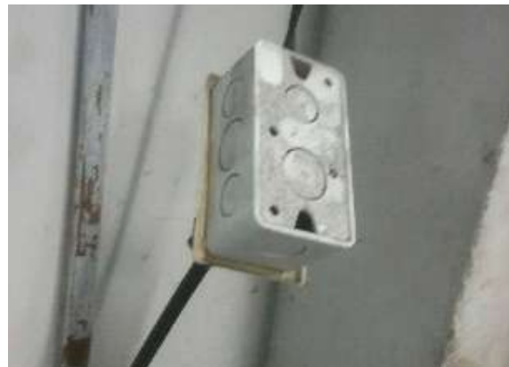
Ilustración 135. Tomacorriente Fuente. Equipo de diagnóstico
