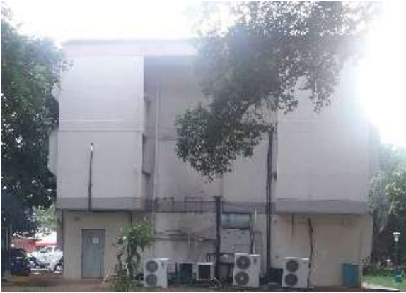
Ilustración 255. condensadoras Fuente. Equipo de diagnóstico
