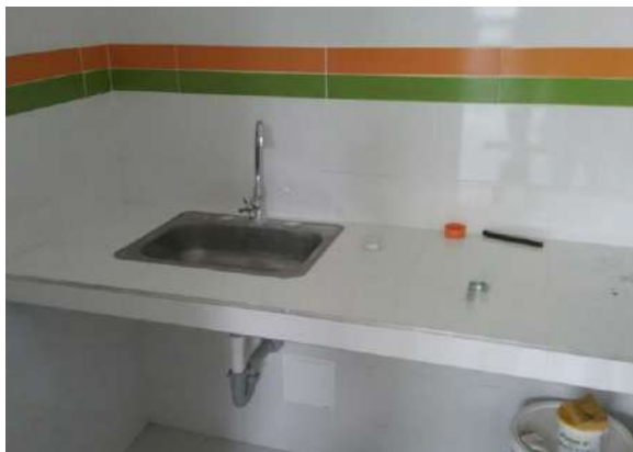
Ilustración 397. Sifón de lavaplatos en PVCs en 2". Fuente. Equipo de diagnóstico
