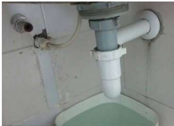
Ilustración 423. Sifón de Lavaplatos en mal estado en PVCS de 2". Fuente: equipo de diagnóstico.
