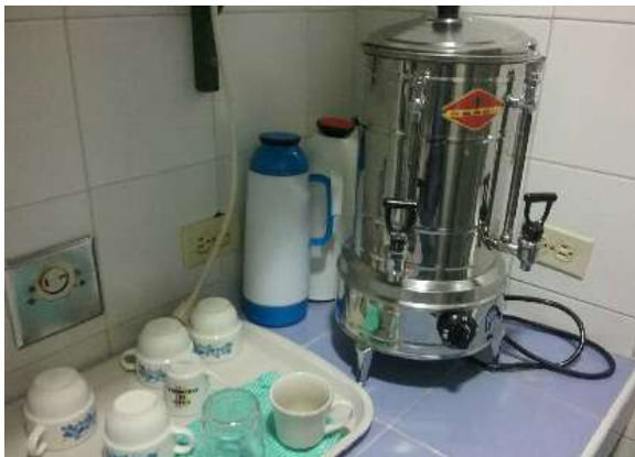
Ilustración 170. tomacorriente Fuente. Equipo de diagnóstico
