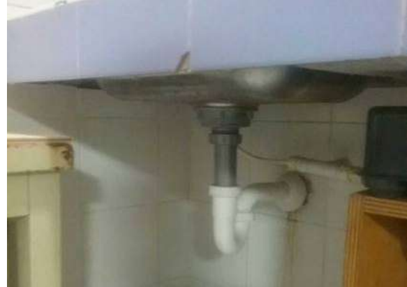
Ilustración 377. Sifón de lavaplatos en PVCs en 2". Fuente. Equipo de diagnóstico
