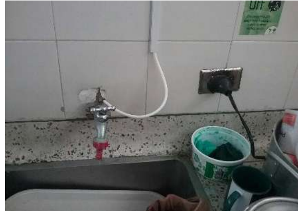
Ilustración 245. Tomacorriente Fuente. Equipo de diagnóstico
