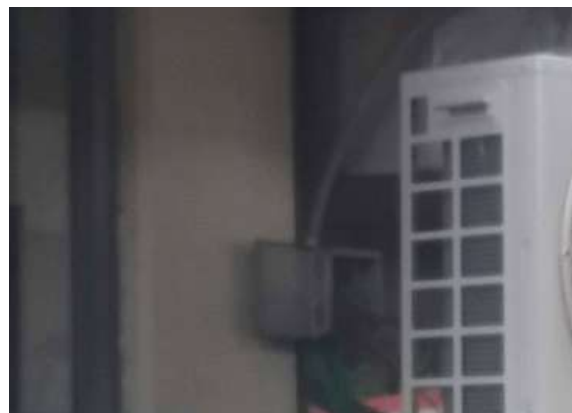
Ilustración 230. condensadora. Fuente. Equipo de diagnóstico
