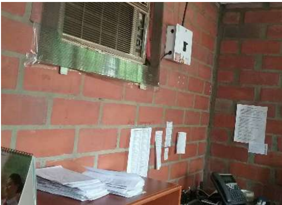
Ilustración 280. Aire acondicionado. Fuente. Equipo de diagnóstico
