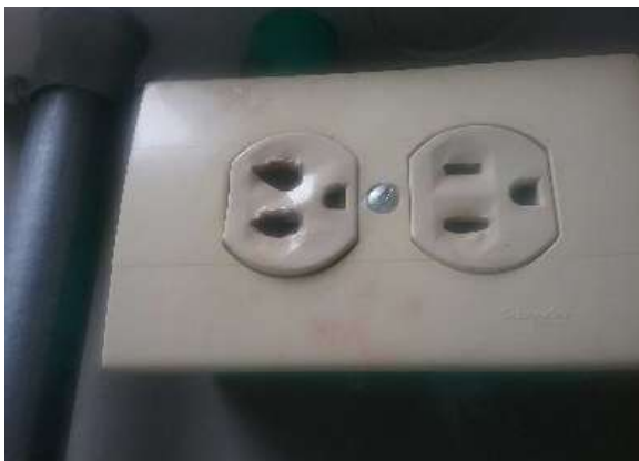
Ilustración 207. tomacorriente Fuente. Equipo de diagnóstico
