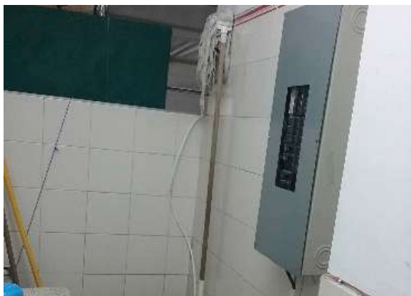
Ilustración 240. Tablero Fuente. Equipo de diagnóstico
