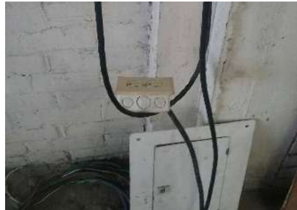
Ilustración 264. tomacorriente Fuente. Equipo de diagnóstico
