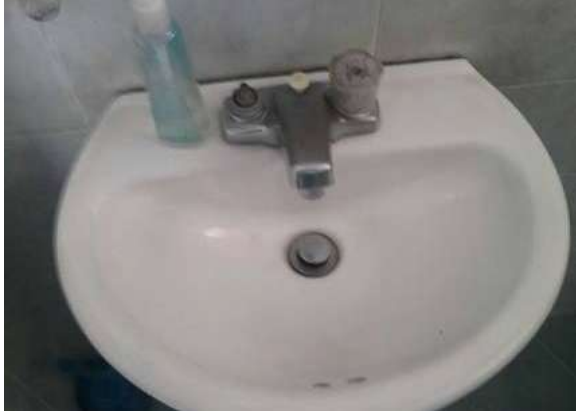
Ilustración 332. Lavamanos baño bloque 1. Fuente. Equipo de diagnóstico
