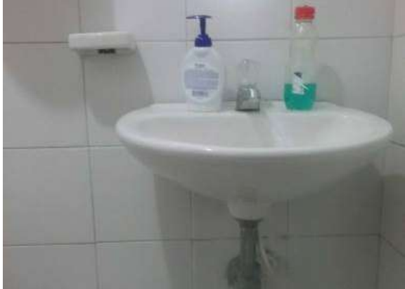
Ilustración 382. Sifón de lavamanos en PVC de 2". Fuente. Equipo de diagnóstico
