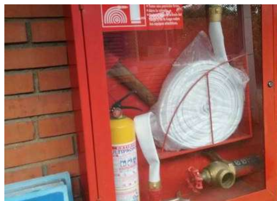
Ilustración 400. Gabinete tipo 3, con sus elementos completos. Fuente. Equipo de diagnóstico
