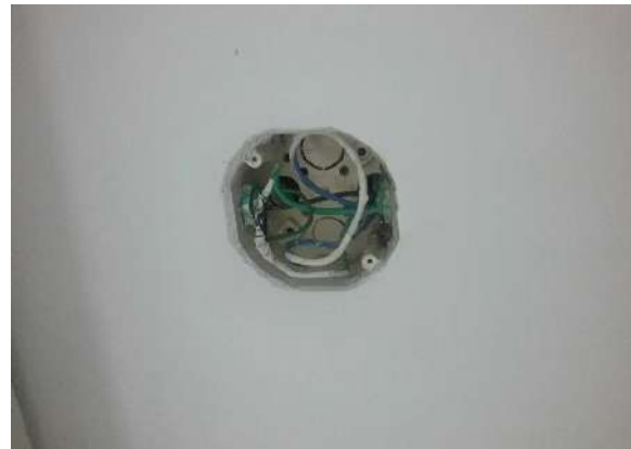
Ilustración 227. luminarias Fuente. Equipo de diagnóstico
