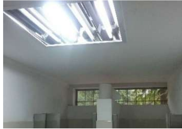
Ilustración 266. Luminarias Fuente. Equipo de diagnóstico
