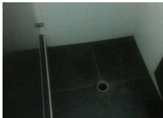
Ilustración 354. Sifón de piso faltante en 3". Fuente. Equipo de diagnóstico
