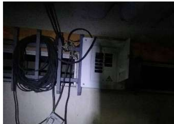
Ilustración 168. tablero Fuente. Equipo de diagnóstico
