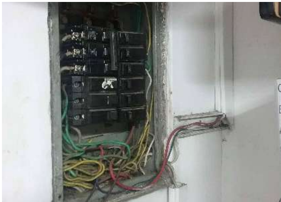
Ilustración 276. Tablero Fuente. Equipo de diagnóstico
