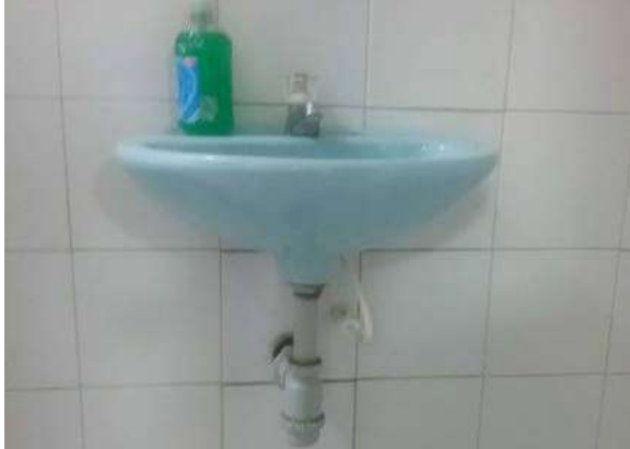
Ilustración 376. Sifón de lavamanos en PVCs en 2". Fuente. Equipo de diagnóstico
