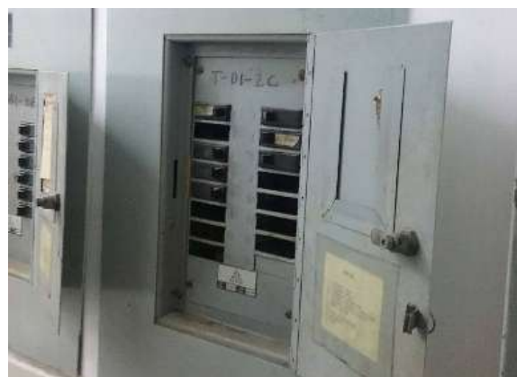
Ilustración 243. tablero Fuente. Equipo de diagnóstico
