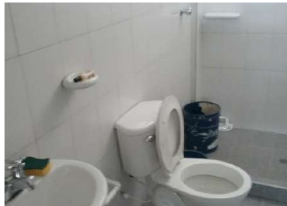
Ilustración 398. Desagüe de retrete. Fuente. Equipo de diagnóstico
