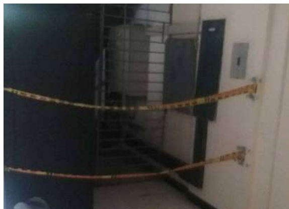
Ilustración 623. tablero Fuente. Equipo de diagnóstico
