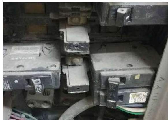
Ilustración 233. tablero Fuente. Equipo de diagnóstico
