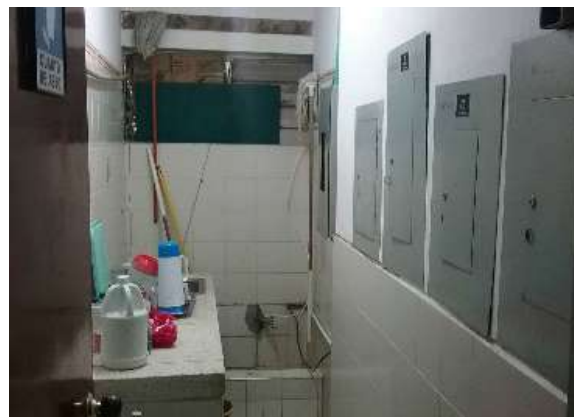
Ilustración 241. tableros Fuente. Equipo de diagnóstico
