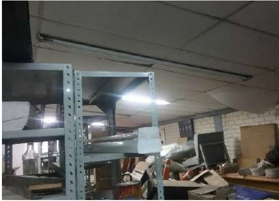
Ilustración 265. Luminarias Fuente. Equipo de diagnóstico
