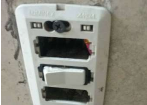
Ilustración 257. interruptor Fuente. Equipo de diagnóstico
