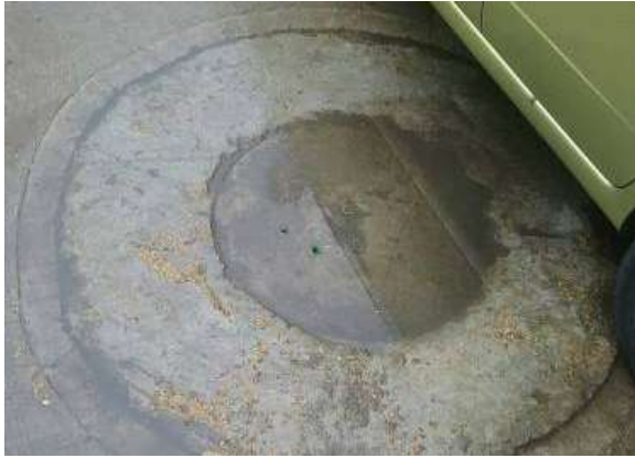
Ilustración 322. Sumidero transversal con rejilla en concreto. Fuente. Equipo de diagnóstico
