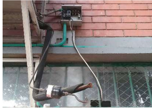
Ilustración 177. tablero Fuente. Equipo de diagnóstico
