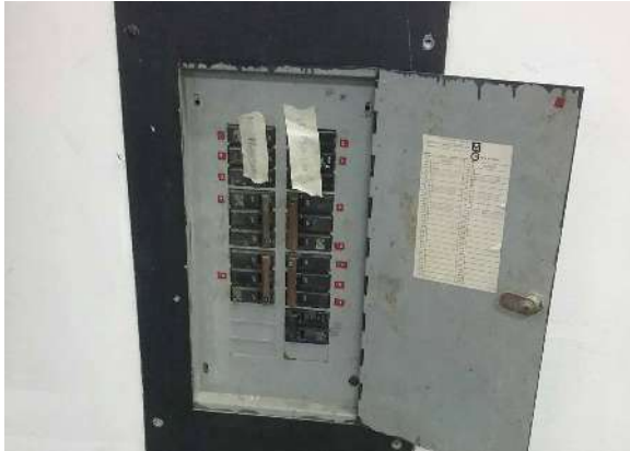
Ilustración 130. Tablero de distribución Fuente. Equipo de diagnóstico
