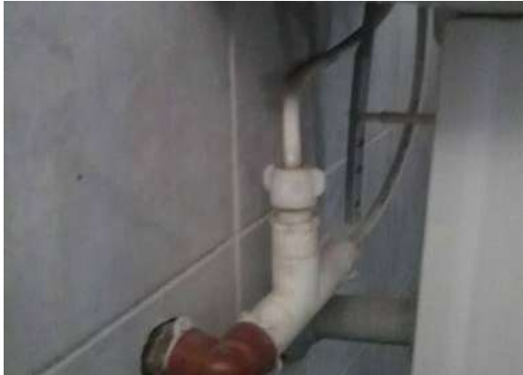
Ilustración 336. Salida en PVC de diámetro de 1/2". Fuente. Equipo de diagnóstico
