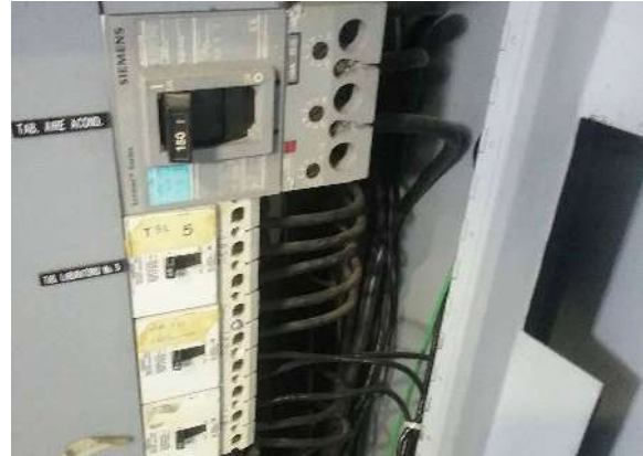
Ilustración 118. tablero general. Fuente. Equipo de diagnóstico
