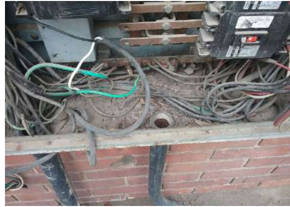
Ilustración 179. tablero Fuente. Equipo de diagnóstico
