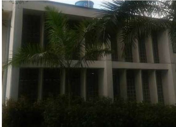
Ilustración 330. tanque elevado ubicado en la cubierta del bloque 1. Fuente. Equipo de diagnóstico.
