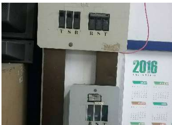
Ilustración 242. Tablero. Fuente. Equipo de diagnóstico
