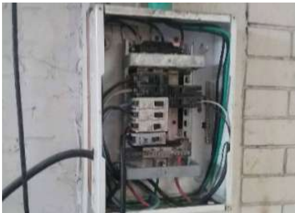
Ilustración 260. Tablero Fuente. Equipo de diagnóstico
