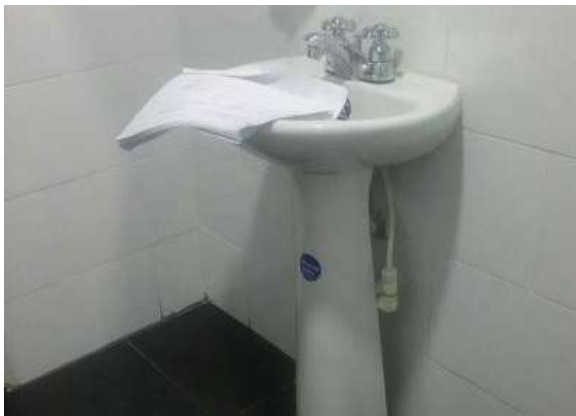
Ilustración 350. Salida en PVCP en 1/2". Fuente. Equipo de diagnóstico
