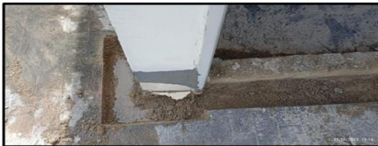
Foto 1. Afectación de humedad en terraza por presunto flujo subsuperficial en las capas existentes (tableta – Mortero – Concreto – Metaldeck)
