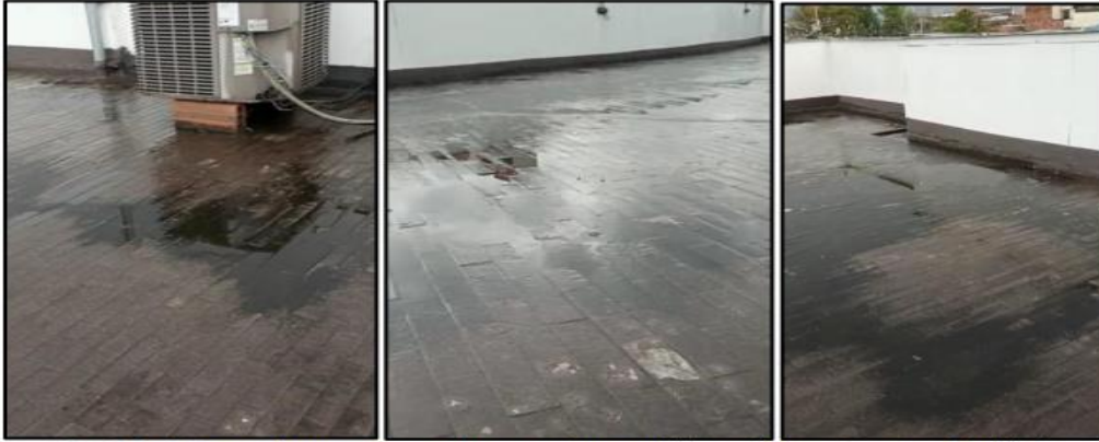
Foto 2, 3 y 4. Empozamiento en terraza en las capas existentes (tableta – Mortero – Concreto – Metaldeck)
