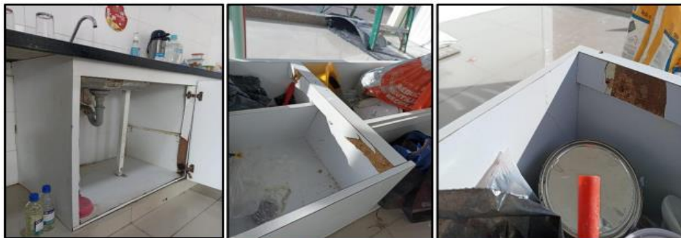
Foto 7, 8 y 9. Estado del gabinete y grifería zona de cocina.
