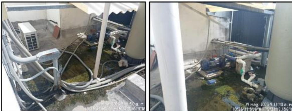
Foto 5 y 6. Humedad sistema de bombeo en terraza
