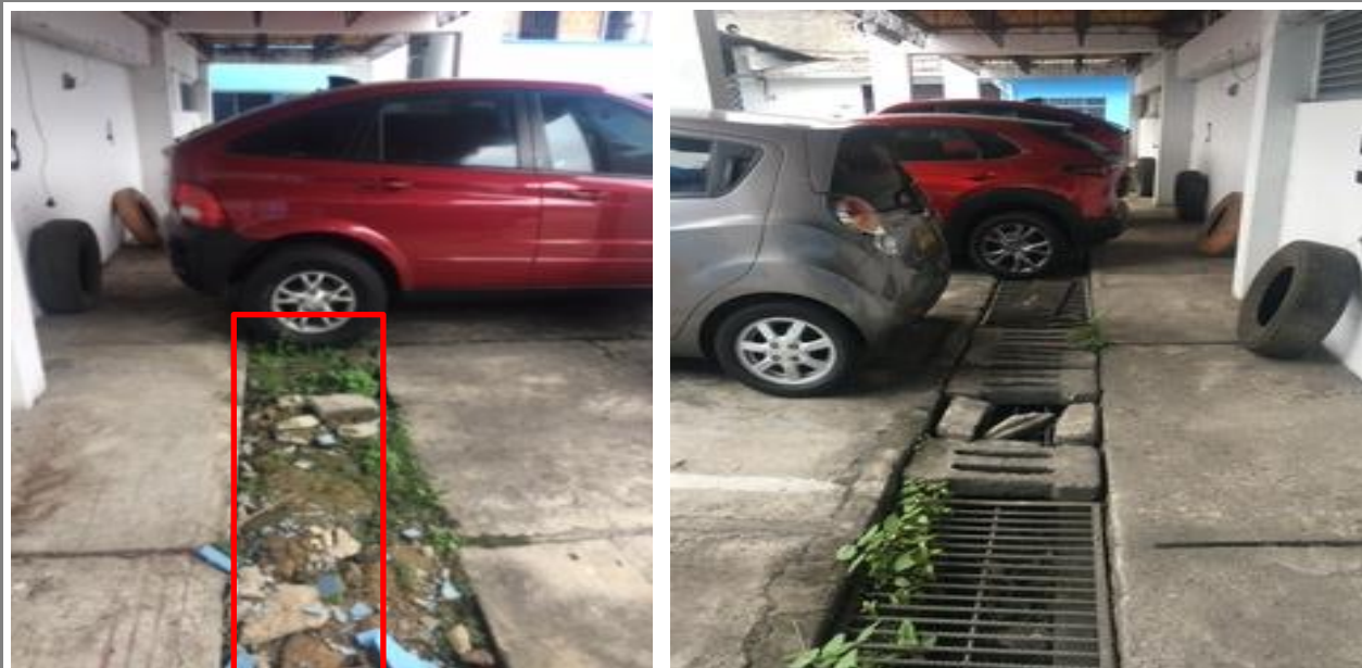
No.5 Sistema de control de aguas lluvias en parqueadero tapadoy colapsado.
