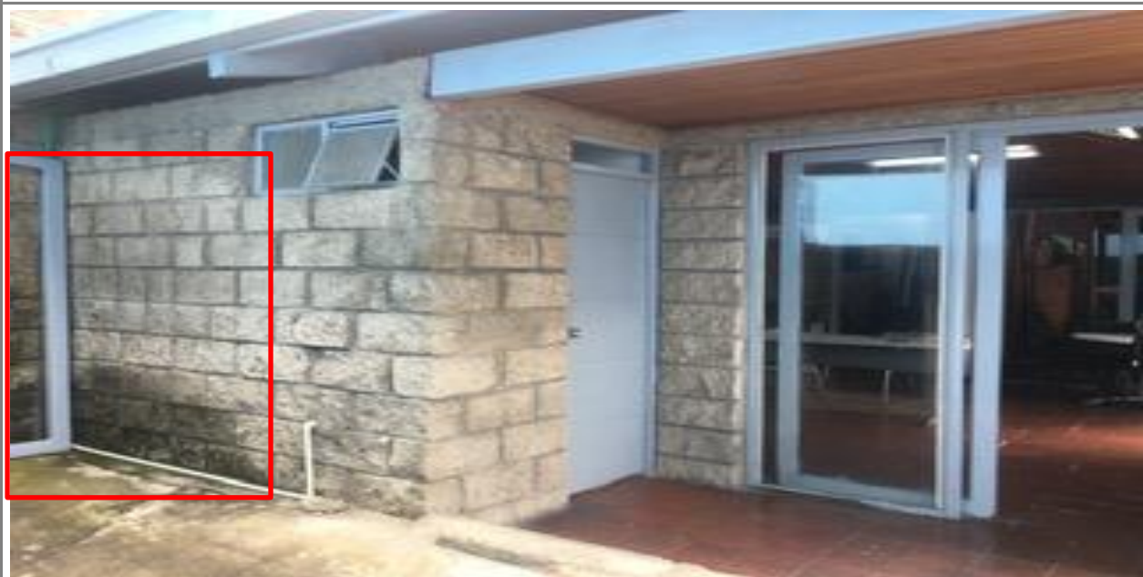
No.7 Humedad externa Oficina de Direccion del Ministerio de Trabajo
