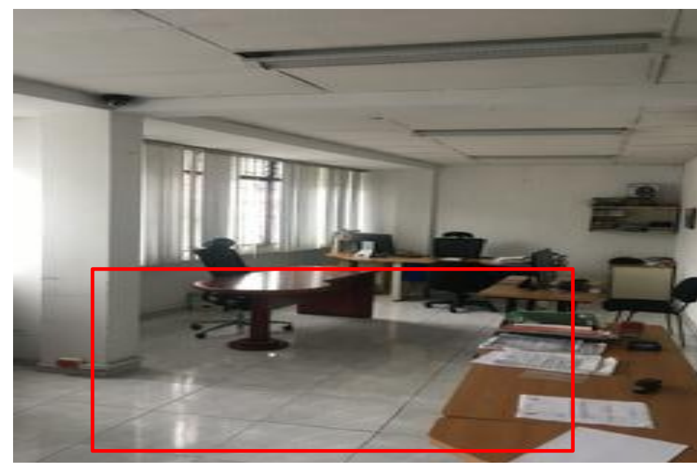
No. 32 Placa piso Nivel 2 desnivelado y con ondulaciones y fisuras
