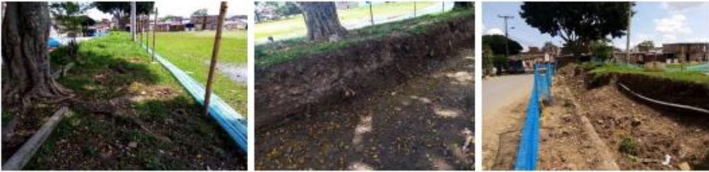
Raíces de árboles y tubería de PVC 2" CICLORUTA TRAMO NORTE
