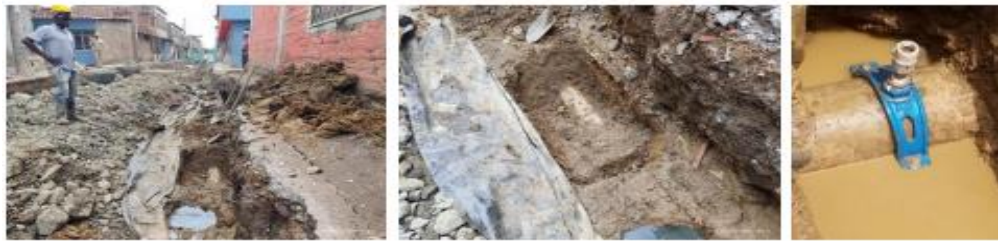
Tubería en Asbesto Cemento de 6" Red de Acueducto – Costado Derecho Calle 72P – Fase 2
