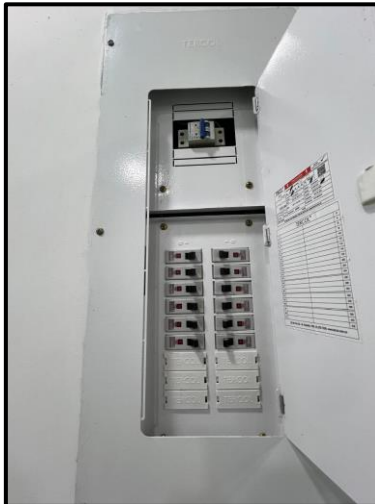
Ilustración 5 Tablero de circuitos instalado con breakers
