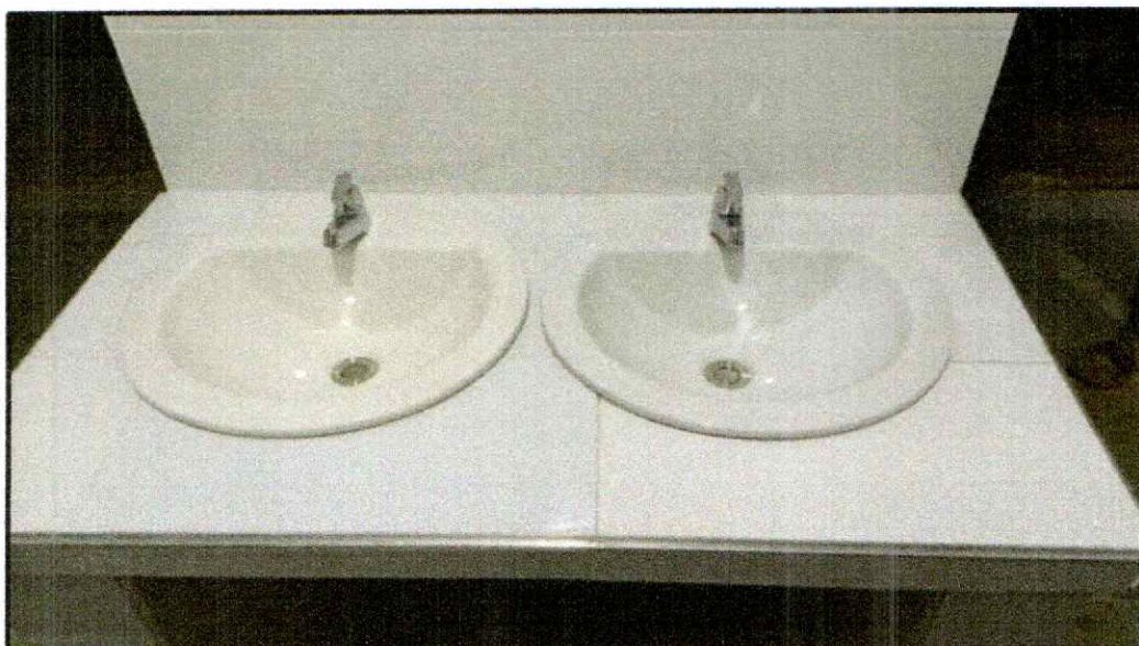
Ilustración 8 Lavamanos batería sanitaria principal
