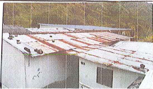
CUBIERTAS EN MAL ESTADO
