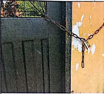
PUERTAS SIN CHAPAS, PROBLEMAS DE INSEGURIDAD
