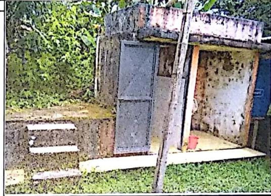
DETERIORO UNIDAD SANITARIA
