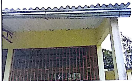
CANALES DE AGUAS LLUVIAS, SE REQUIERE MEJORAMIENTO
