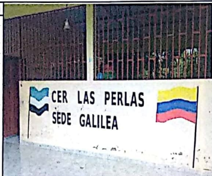
DETERIORO EN LA PINTURA DE LA PLANTA FÍSICA
