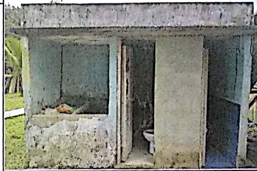
DETERIORO UNIDAD SANITARIA
