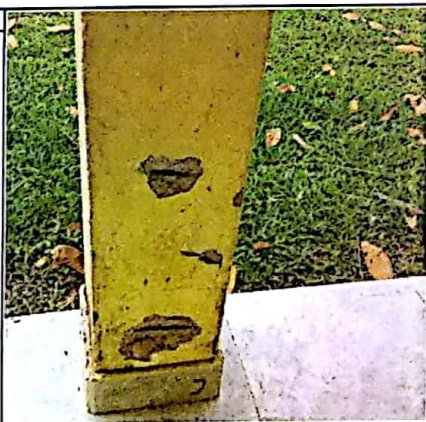
COLUMNA AULA 1 - CORREDOR CON PERDIDA DE RECUBRIMIENTO
