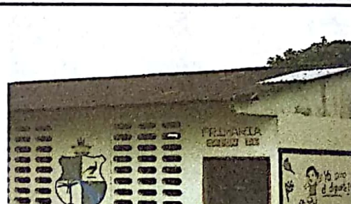
FOTO #4: CUBIERTA DEL BLOQUE 1 DETERIORADA
