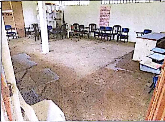
SE REQUIERE ENCHAPE DE PISO AULAS, ACTUALMENTE EN OBRA NEGRA.
