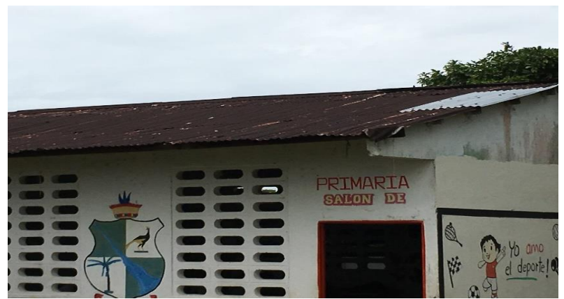
FOTO #4: CUBIERTA DEL BLOQUE 1 DETERIORADA
