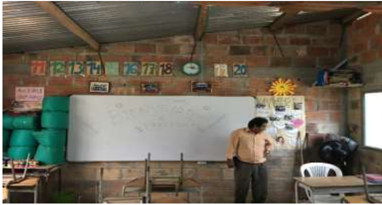
FOTO #5: MUROS DEL SALON PREESCOLAR SIN PAÑETES Y SIN PINTURA
