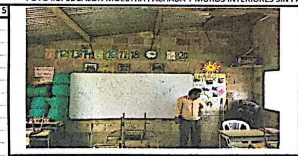
FOTO #5: MUROS DEL SALON PREESCOLAR SIN PAÑETES Y SIN PINTURA
