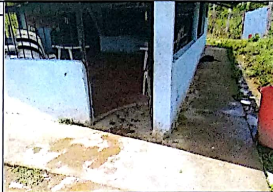
DETERIORO EN EL ENCHAFE DE PISO DEL RESTAURANTE.
