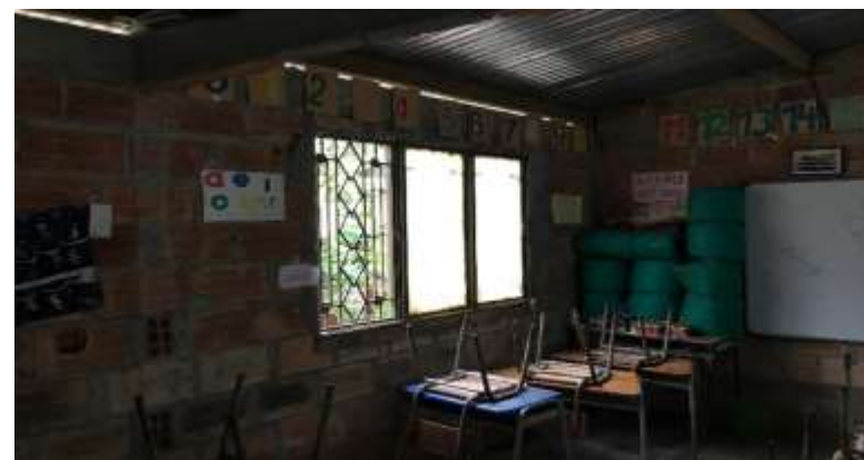
FOTO #6: NECESITA MAS ILUMINACION.
