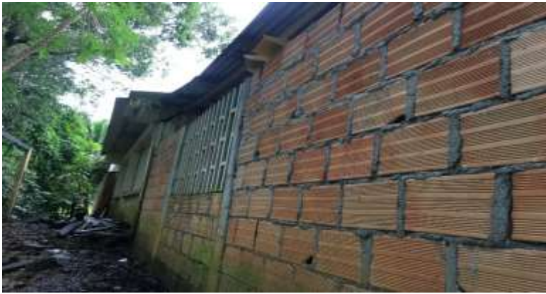
FOTO #3: EL SALON MUESTRA FACHADA Y MUROS INTERIORES SIN PAÑETS
