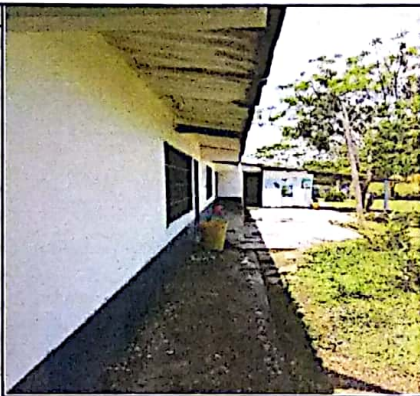
SE REQUIERE CANALES DE AGUAS LLUVIAS. A1, A2, A3.
