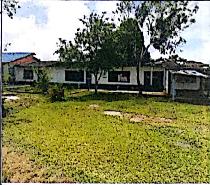
SE PRESENTA DETERIORO EN LAS CUBIERTAS DE LAS AULAS 1 Y 2. TEJADO
