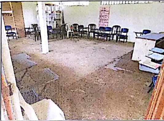
SE REQUIERE ENCHAFE DE PISO AULAS, ACTUALMENTE EN OBRA NEGRA.
