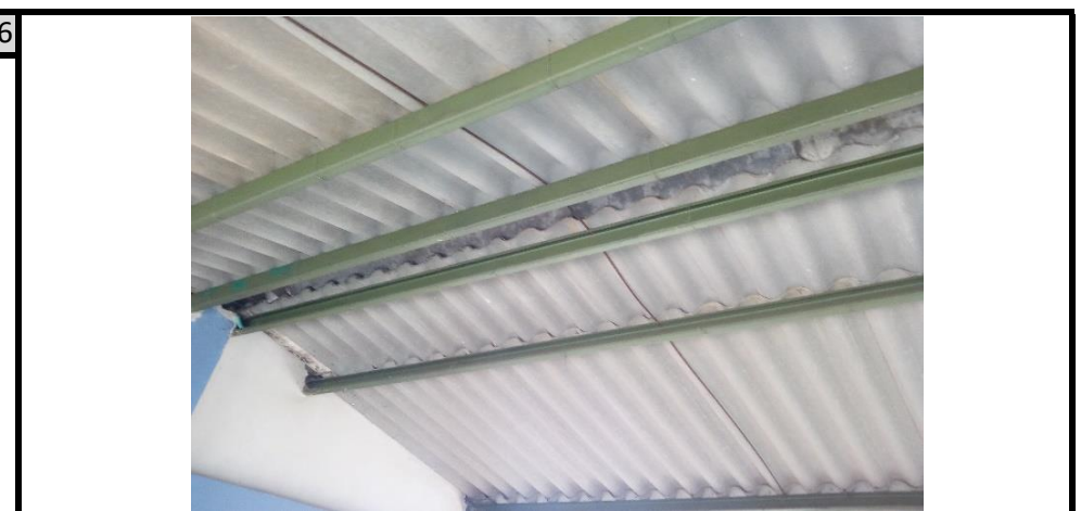
AULA MULTIPLE SIN INSTALACIONES ELECTRICAS NI LUMINARIAS
