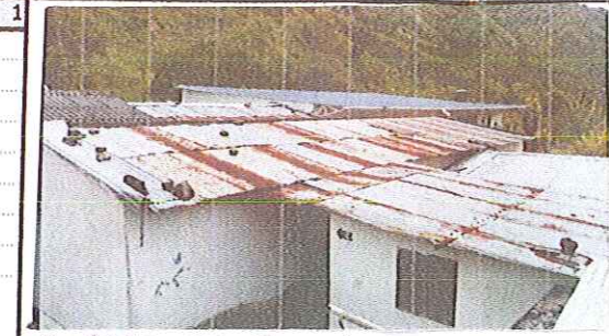
CUBIERTAS EN MAL ESTADO
