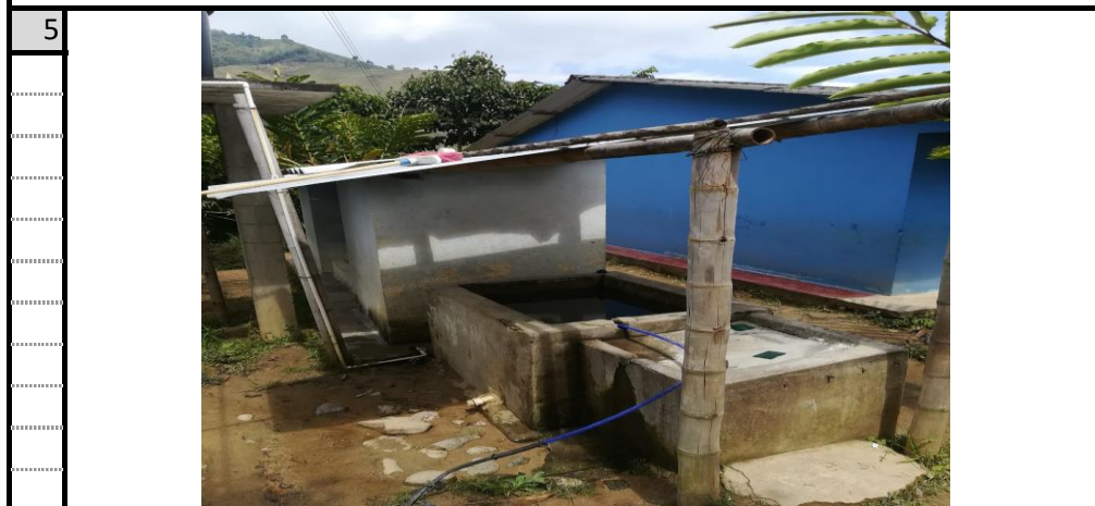
SANITARIO EN MAL ESTADO
