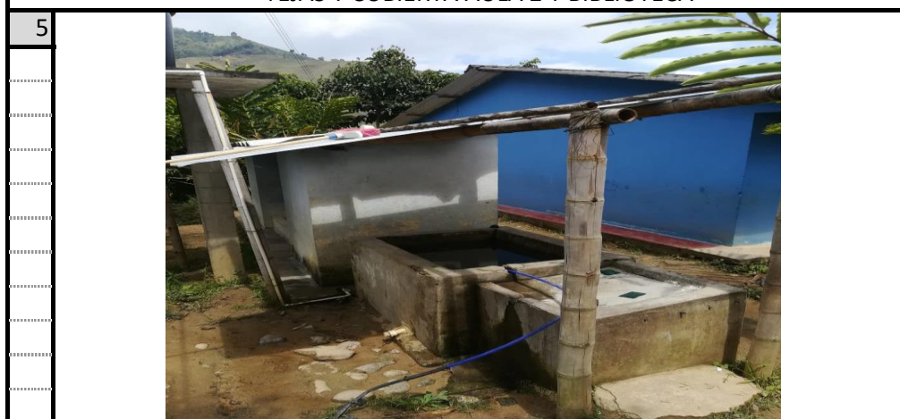
SANITARIO EN MAL ESTADO
