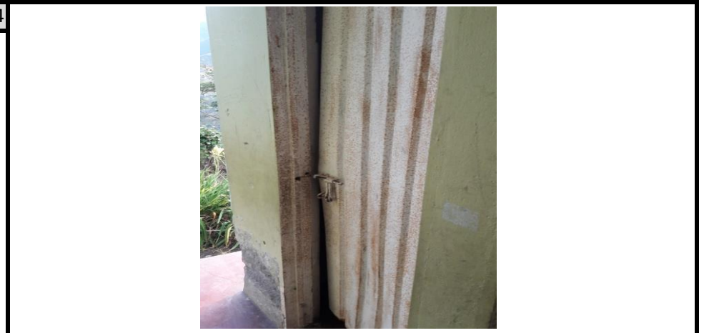
PUERTA ACCESO BATERIA S
