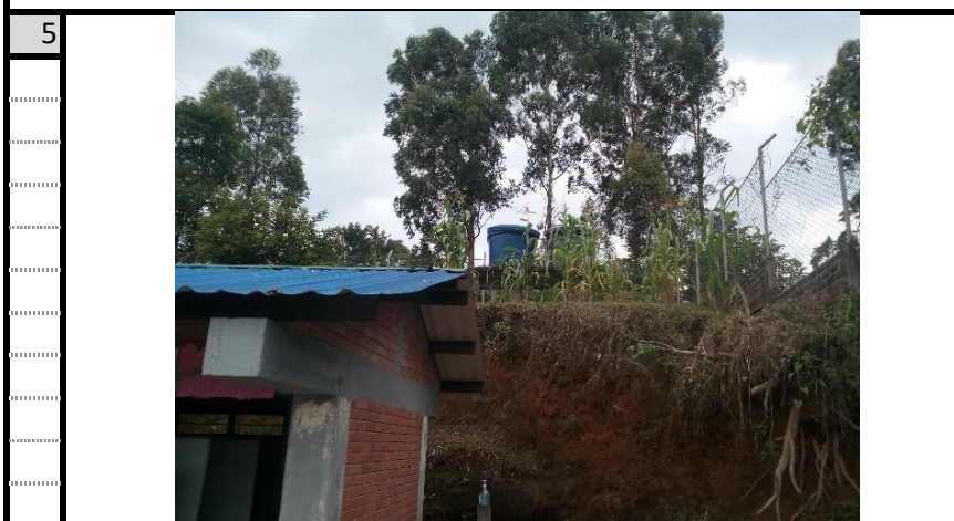
CUBIERTA DE BATERIA SANITARIA SIN CANAL
