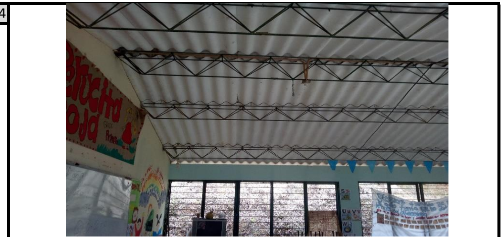
AULA 2 CON PESIMAS INSTALACIONES ELECTRICAS
