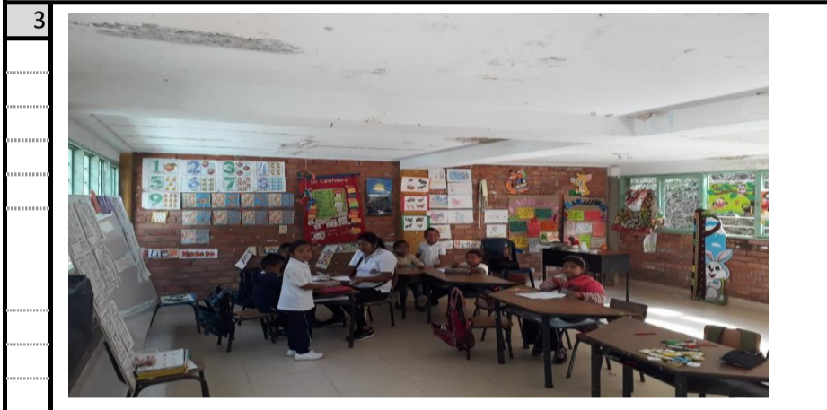
AULA 5 CON PROBLEMAS DE HUMEDAD EN SU LOSA
