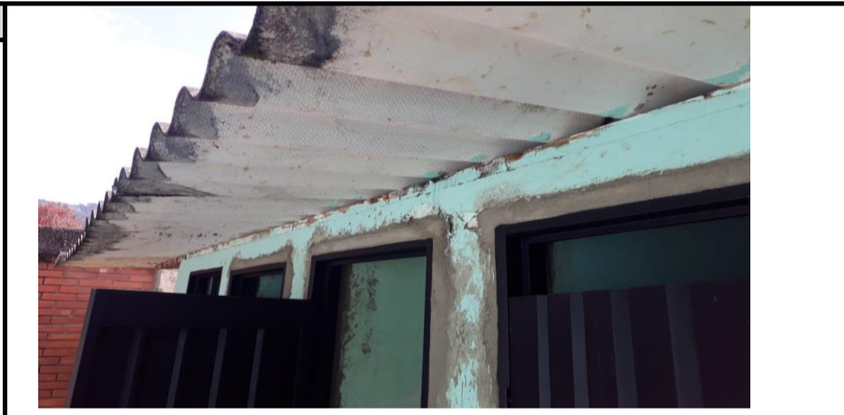
BATERIA SANITARIA REQUIERE ESTUCADA PINTADA
