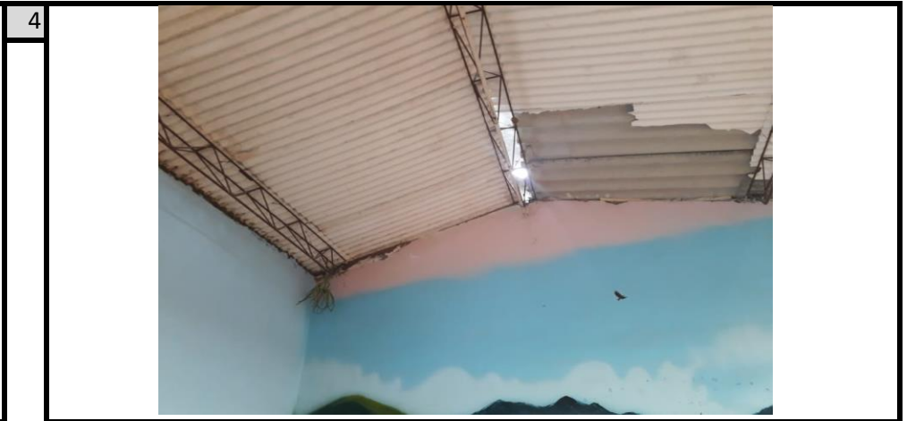
AULA 2 CON PESIMAS INSTALACIONES ELECTRICAS
