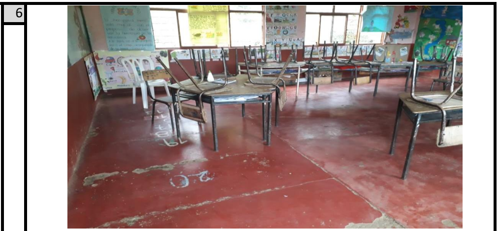
AULA MULTIPLE SIN INSTALACIONES ELECTRICAS NI LUMINARIAS
