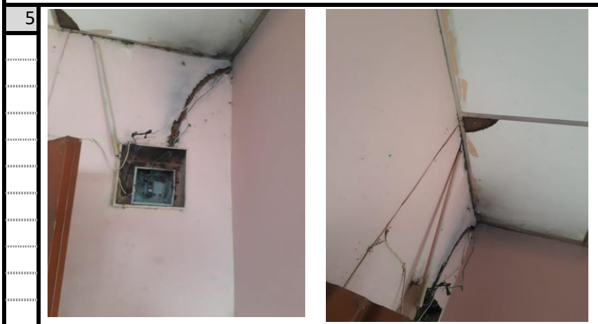
CUBIERTA DE BATERIA SANITARIA SIN CANAL
